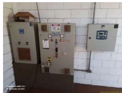
Foto 10 - Quadro de comando da captação.
