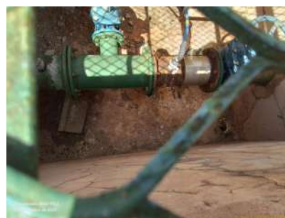
Foto 15 - Ponto para adição de reagente químico utilizado no tratamento.
