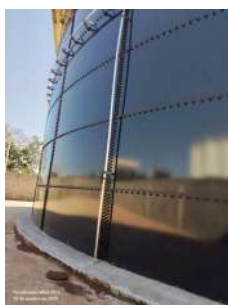
Foto 3 - Detalhe do condutor para aterramento da estrutura.
