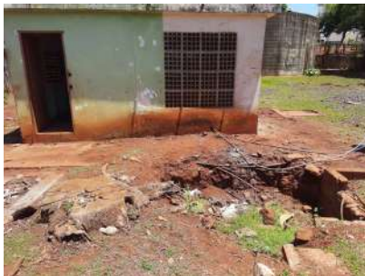
Foto 1 - Buraco no solo, ao lado do poço.
