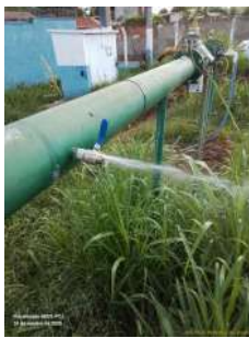
Foto 10 - Torneira para coleta de água bruta.
