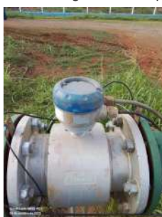
Foto 8 - Macromedidor instalado na captação.
