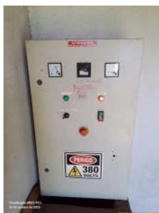
Foto 7 - Painele de comando da bomba instalada em série à captação.
