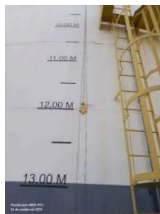
Foto 11 - Indicador de nível do reservatório.
