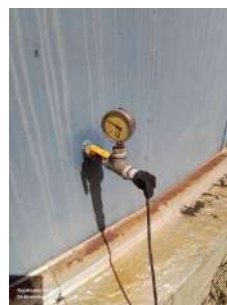
Foto 6 - Manômetro para inferência de nível do reservatório.
