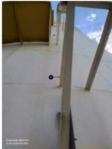
Foto 1 - Ausência de condutor (ilhosos vazias) para SPDA.
