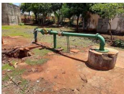
Foto 8 - Vista geral da captação.
