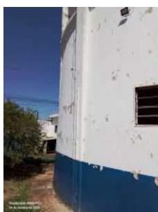
Foto 6 - Detalhe mostrando condutor do sistema de aterramento da estrutura.
