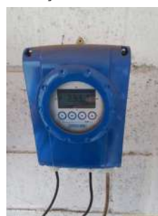
Foto 5 - Painel do macromedidor instalado na captação;
