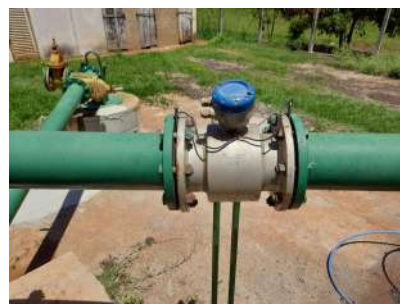
Foto 2 - Sensor do macromedidor instalado na tubulação da captação.
