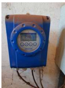
Foto 3 - Painel do macromedidor da captação.
