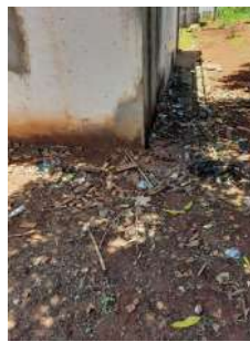
Foto 4 - Sujeira e lixo no exterior da EEA.
