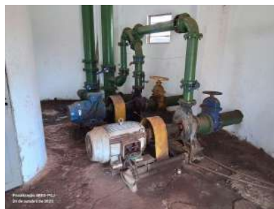
Foto 13 - Conjuntos motobomba localizados na parte interna do reservatório.
