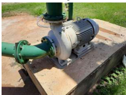
Foto 3 - Conjunto motobomba da EEA.
