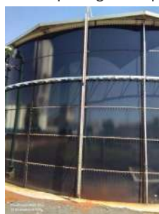
Foto 9 - Medidor de nível instalado no reservatório
