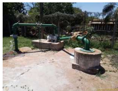
Foto 4 - Vista geral da captação e conjunto motobomba na sequência.
