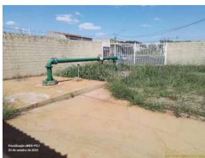
Foto 1 - Vista evidenciando mato alto na área da captação.
