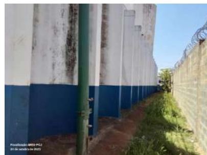
Foto 4 - Detalhe evidenciando vazamento em outra lateral do reservatório, com formação de lodo na superfície da alvenaria.
