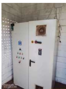
Foto 4 - Painel de comando da captação.
