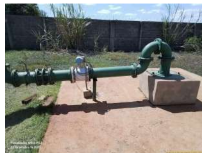
Foto 4 - Vista geral da captação.
