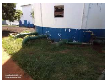
Foto 7 - Tubulações de saída de água do reservatório.
