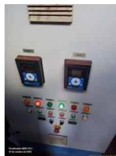
Foto 2 - Quadro de comando das bombas.
