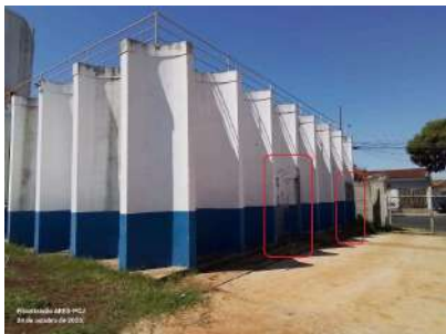
Foto 1 - Vista evidenciando vazamentos numa das laterais do reservatório.
