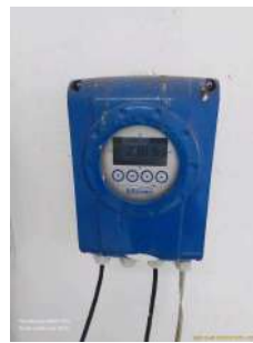
Foto 11 - Painel do macromedidor.
