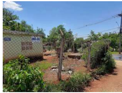
Foto 2 - Dano no cercamento de alambrado.
