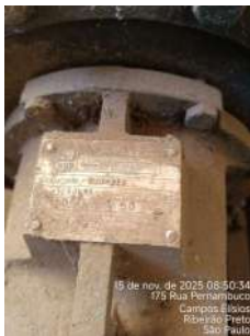
Foto 3 - Fotografia apresentada pelo prestador, referente a conjunto bomba e motor reservas, mantidos para atendimento à unidade fiscalizada.
