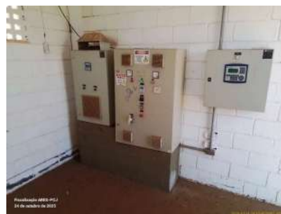
Foto 10 - Painéis de comando da captação.
