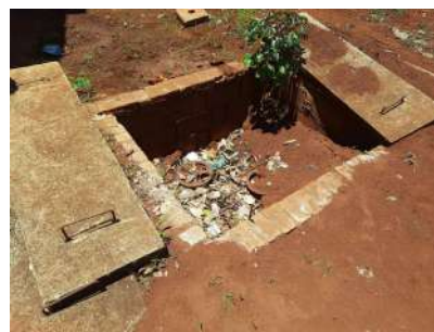
Foto 10 - Caixa de passagem localizada na área da captação, exibindo acúmulo de sujeira e terra em seu interior.
