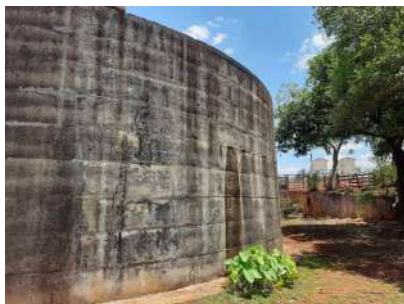
Foto 1 - Vazamento no reservatório.
