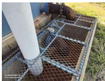
Foto 10 - Saídas do tubo de exaustão e do tubo de drenagem do reservatório.
