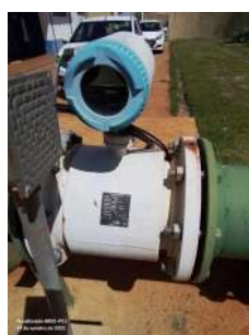
Foto 7 - Macromedidor instalado na captação.
