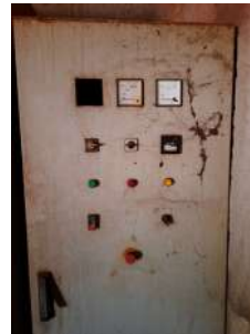
Foto 7 - Quadro de comando da unidade.
