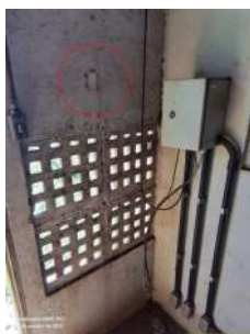
Foto 1 - Ausência do painel do macromedidor. Detalhe evidencia local onde o mesmo estava instalado.
