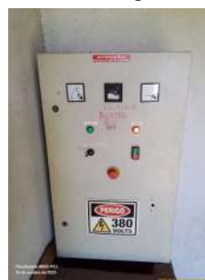
Foto 6 - Painel de comando da unidade.
