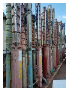
Foto 12 - Bombas reserva armazenadas em unidade da Saerp na Rua Pernanbuco.
