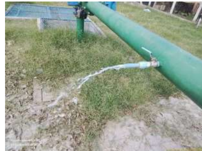
Foto 9 - Torneira para coleta de água bruta.
