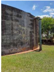
Foto 3 - Tubulação de entrada de água no reservatório.
