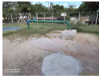
Foto 7 - Vista geral da captação.
