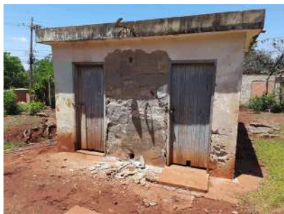
Foto 1 - Edificação que abriga os reagentes e dosadores empregados na cloração e fluoretação trancado.
