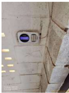
Foto 6 - Painel do sistema de alarme da unidade.
