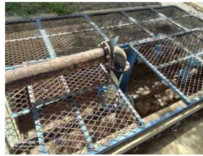
Foto 12 - Registros de manobra em caixa de passagem próxima ao reservatório.
