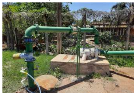
Foto 4 - Vista geral EEA.
