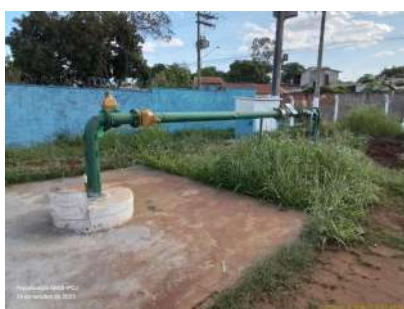
Foto 6 - Vista geral da captação.
