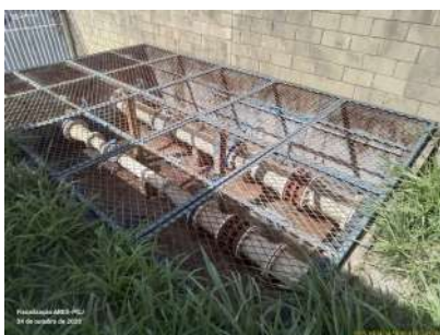
Foto 7 - Caixa de passagem com registros de manobra.
