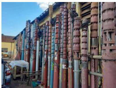
Foto 12 - Bombas reserva mantidas em estoque na unidade da Saerp na Rua Pernambuco.
