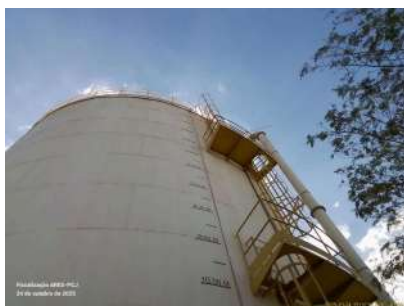
Foto 12 - Escala do indicador de nível do reservatório. Guarda corpo instalado no topo do reservatório.
