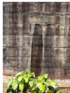
Foto 2 - Vazamento no reservatório.
