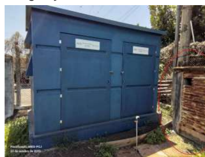
Foto 3 - Porta do abrigo da entrada de energia apresentando corrosão.
