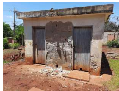
Foto 8 - Vista externa da casa de química, mostrando desprendimento do revestimento da alvenaria e portas de madeira sem pintura ou qualquer proteção.
