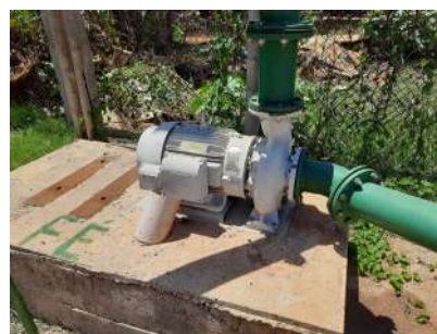
Foto 2 - Conjunto motobomba da EEA.
