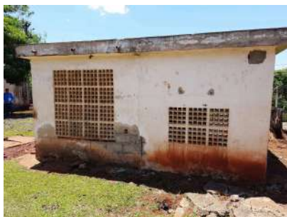
Foto 7 - Vista externa da casa de química, mostrando desprendimento do revestimento da alvenaria.
