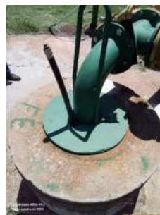
Foto 6 - Tubo medidor de nível instalado na captação.
