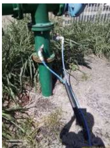
Foto 9 - Ponto para adição de reagentes químicos utilizado no tratamento.
