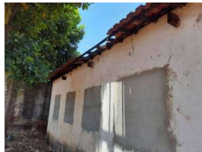
Foto 6 - Ausência de telhas no beiral da edificação que abriga a EEA.
