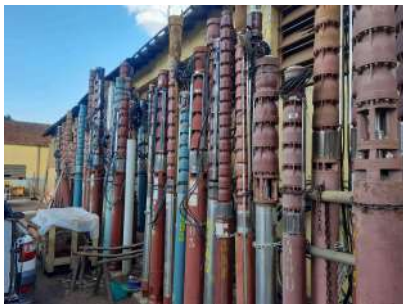
Foto 14 - Bombas reserva armazenadas em unidade da Saerp na Rua Pernanbuco.
