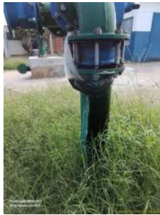
Foto 1 - Vazamento de água na tubulação do cavalete do poço. Observa-se um pedaço de plástico envolvendo o ponto de vazamento e a formação de lodo por onde a água escorre.
