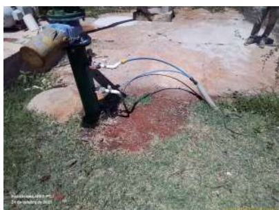
Foto 11 - Tubulação para adição de reagentes na tubulação após o conjunto motobomba.
