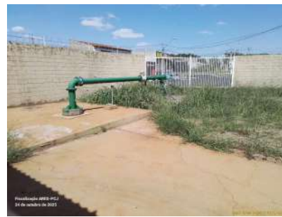
Foto 5 - Vista geral da captação.
