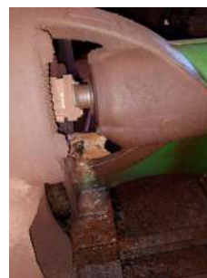
Foto 2 - Vazamento de óleo no eixo do motor da bomba principal.
