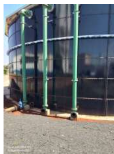
Foto 2 - Detalhe exibindo tubulações de entrada no reservatório (duas provisionadas para eventual uso futuro).
