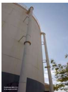
Foto 9 - Tubo extravasor (esquerda) e alimentação (direita)
