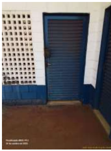
Foto 1 - Edificação que abriga os reagentes químicos e dosadores empregados na cloração e fluoretação se encontrava fechada no momento da fiscalização.
