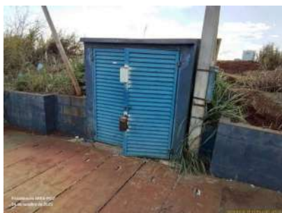
Foto 1 - Vista geral da unidade. A construção de alvenaria abriga o painel de comando da EEA, enquanto que as bombas estão instaladas logo à
