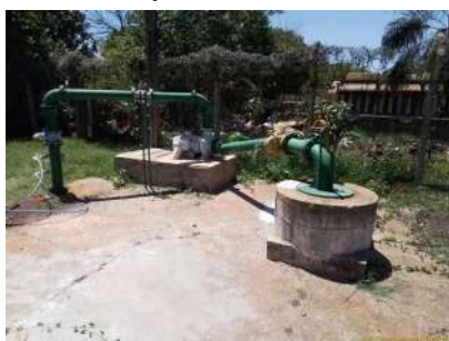
Foto 5 - Vista da EEA instalada na saída da captação.
