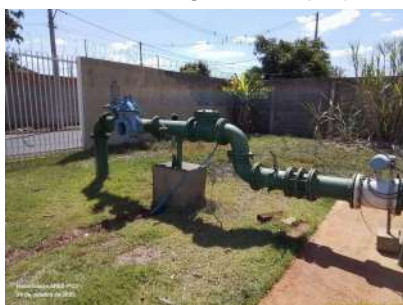
Foto 5 - Vista geral da captação.
