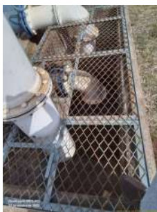
Foto 4 - Saídas do tubo extravasor e tubo de drenagem do reservatório.
