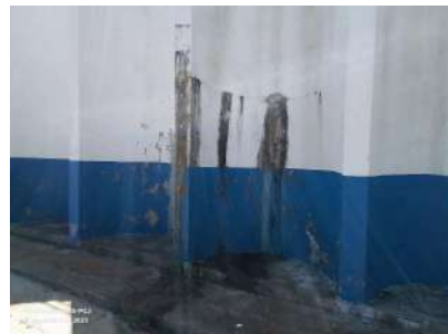
Foto 2 - Detalhe mostrando vazamento no reservatório.
