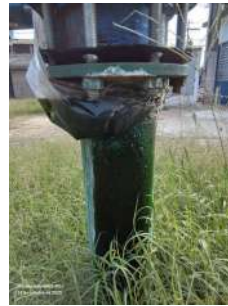
Foto 2 - Vazamento de água na tubulação do cavalete do poço. Observa-se um pedaço de plástico envolvendo o ponto de vazamento e a formação de lodo por onde a água escorre.
