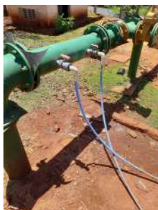
Foto 5 - Ponto onde ocorre adição de reagentes químicos cloro e flúor à água captada.
