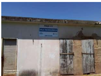
Foto 1 - Edificação em alvenaria apresentando avançado sinal de deterioração (portas de metal apresentando corrosão, portas de madeira sem proteção por pintura e apodrecendo, revestimento da alvenaria se desfazendo)
