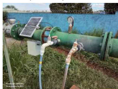
Foto 9 - Pontos para adição dos reagentes utilizados no tratamento da água.
