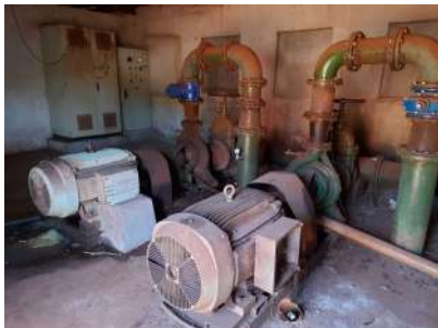
Foto 1 - Conjunto motobomba principal (esquerda) e reserva (direita).
