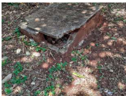
Foto 11 - Caixa de passagem localizada na área da captação, danificada.
