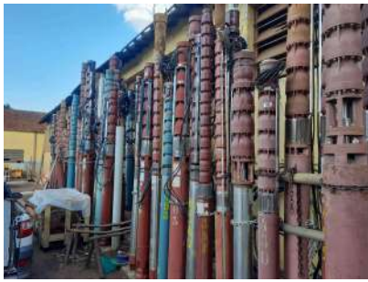
Foto 12 - Bombas reserva mantidas em estoque na unidade da Saerp na Rua Pernambuco.
