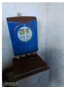
Foto 3 - Painele de macromedidor instalado na unidade.
