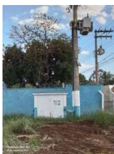
Foto 4 - Transformador e abrigo da entrada de energia.
