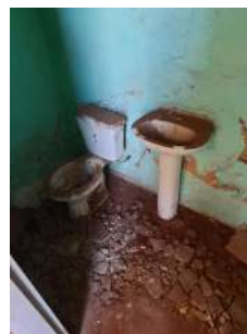
Foto 6 - Interior do banheiro localizado na mesma edificação que abriga o quadro de comando, com entulho que se desprendeu da laje.
