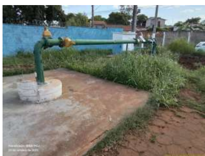
Foto 1 - Vista evidenciando crescimento de vegetação na área ao redor da captação.
