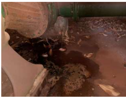
Foto 3 - Sujeira acumulada no interior da EEA.
