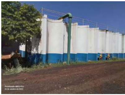
Foto 1 - Vista geral da lateral do reservatório, exibindo tubo de alimentação.
