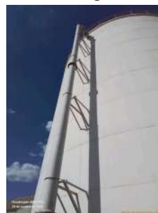
Foto 5 - Tubo extravasor do reservatório.
