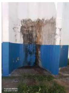
Foto 3 - Detalhe mostrando vazamento no reservatório.
