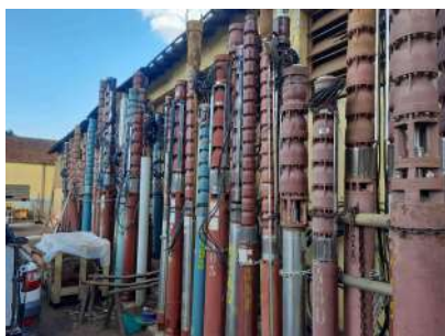
Foto 13 - Bombas reserva armazenadas em unidade da Saerp na Rua Pernambuco.
