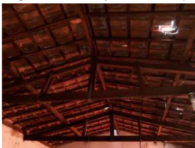
Foto 7 - Telhas quebradas na edificação que abriga a EEA.
