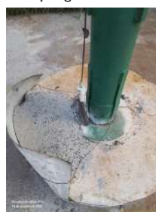
Foto 7 - Tubo para medição de nível da captação.
