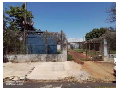
Foto 2 - Portão metálico com corrosão e acúmulo de vegetação morta sobre o alambrado.
