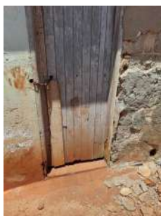
Foto 9 - Porta de madeira da edificação que abriga os produtos químicos, exibindo mal conservação.
