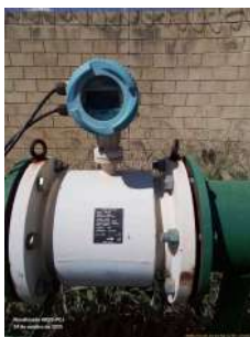
Foto 7 - Macromedidor instalado na captação.
