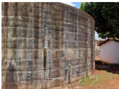
Foto 3 - Imagem mostrando três pontos de vazamentos no reservatório.
