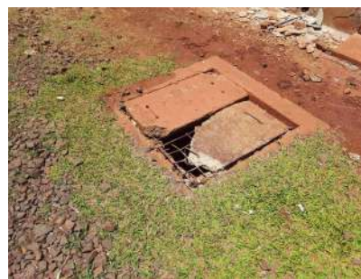
Foto 4 - Tampa de concreto armado, de caixa de passagem, quebrada.
