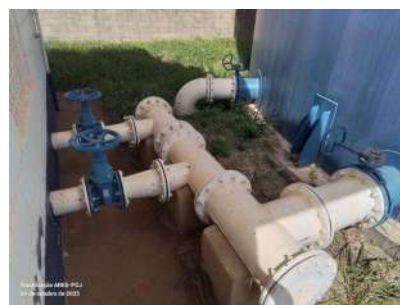
Foto 6 - Saídas do reservatório para alimentação da rede e da EEA instalada na mesma área.
