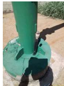
Foto 6 - Tubo para medição de nível com tampão rosqueável.
