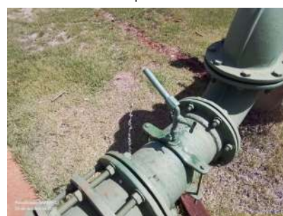
Foto 8 - Torneira para coleta de água bruta.
