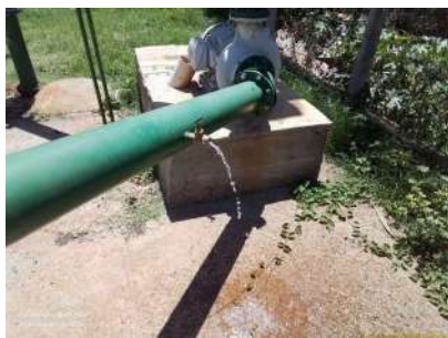
Foto 5 - Torneira para coleta de água bruta.
