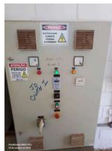
Foto 11 - Paineis de comando da captação.
