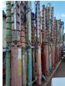
Foto 13 - Bombas reserva armazenadas em unidade da Saerp na Rua Pernanbuco.
