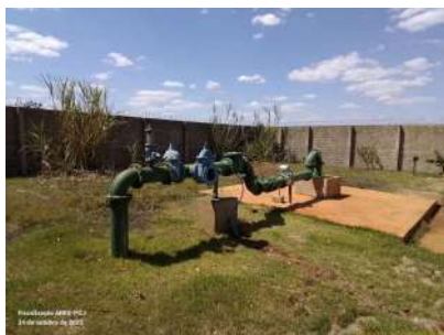
Foto 3 - Vista geral da captação.
