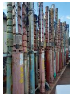
Foto 11 - Bombas reserva mantidas em estoque na unidade da Saerp na Rua Pernambuco.
