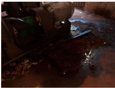
Foto 1 - Acúmulo de água sobre o piso em razão da drenagem inadequada da água de lubrificação de gaxetas.
