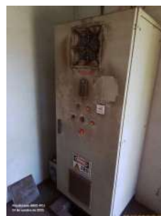
Foto 8 - Painele de comando da bomba da captação.
