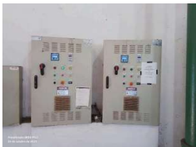
Foto 12 - Quadros de comando localizados na parte interna da base do reservatório.
