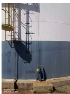
Foto 7 - Medidor de nível instalado no reservatório.
