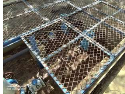
Foto 13 - Registros de manobra em caixa de passagem próxima ao reservatório.
