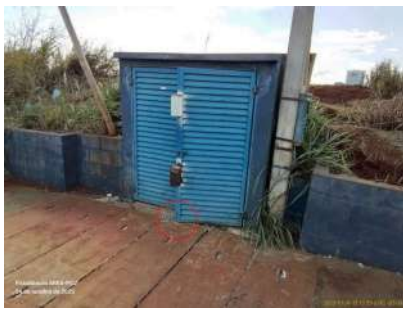
Foto 1 - Vista geral da EEA. Não é possível abrir completamente as portas do abrigo onde está instalado o painel de comando das bombas, visto que a parte inferior das portas interfere com as placas de concreto armado no pavimento (destaque).
