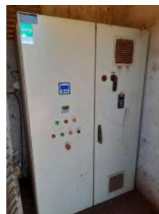
Foto 6 - Painel de comando da captação.
