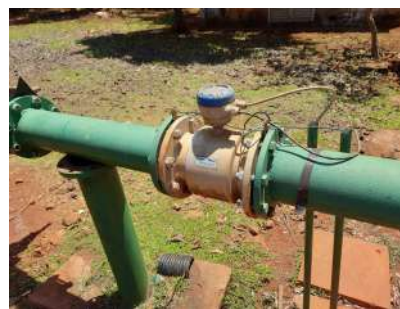
Foto 4 - Macromedidor instalado na captação.
