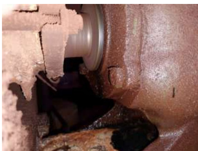
Foto 1 - Vazamento de óleo no eixo do motor da bomba principal.
