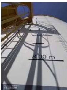
Foto 1 - Ausência de condutor (ilhosos vazias) do SPDA.
