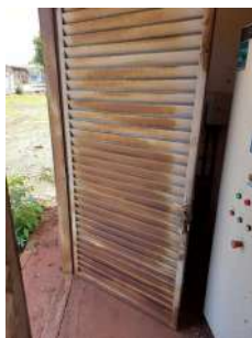
Foto 5 - Porta da edificação que abriga o painel de comando da unidade, com corrosão.
