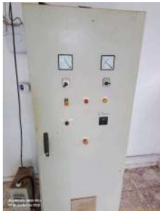
Foto 12 - Painel de comando da captação.
