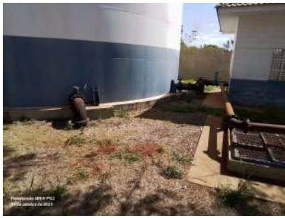
Foto 11 - Vista apresentando saídas do reservatório, uma delas alimenta EEA instalada na edificação à direita na imagem.
