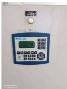
Foto 12 - Detalhe do comando da captação.
