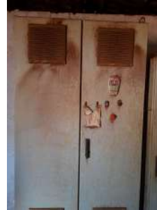
Foto 6 - Quadro de comando da unidade.
