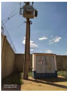
Foto 4 - Transformador e abrigo da entrada de energia.
