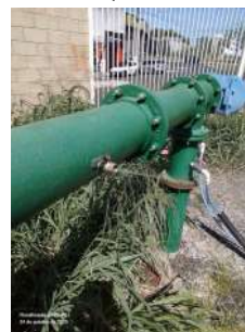
Foto 8 - Torneira para coleta de água bruta.
