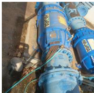
Foto 1 - Evidência de vazamentos aparentes.
