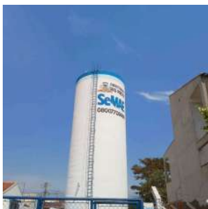
Foto 1 - Escada com guarda fora das especificações da NBR 12217/1994.
