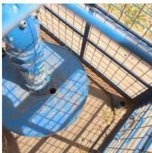
Foto 1 - Evidência da falta de tubulação para medição de nível do lençol freático.
