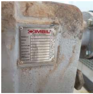
Foto 12 - Detalhe da placa de identificação da bomba do CMB-01 (marca IMBIL).
