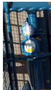
Foto 10 - Vista do macromedidor de vazão.
