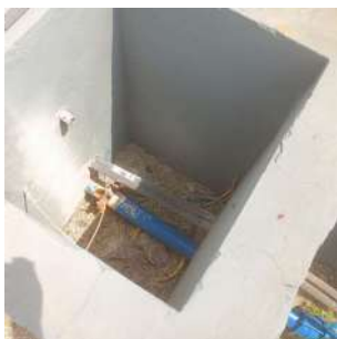
Foto 7 - Detalhe do ponto de dosagem de cloro.
