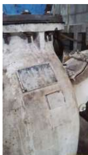
Foto 17 - Detalhe da placa de identificação da bomba.
