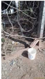
Foto 3 - Evidência de reparo improvisado com arame farpado emaranhado na base do cercamento, representando um risco de acidente e demonstrando a ineficácia da proteção.
