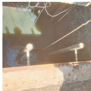
Foto 16 - Vista superior do poço de sucção, evidenciando o nível do esgoto bruto.
