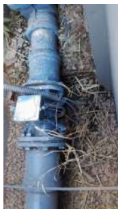
Foto 3 - Evidência de vazamentos aparentes próximos ao macromedidor de vazão.
