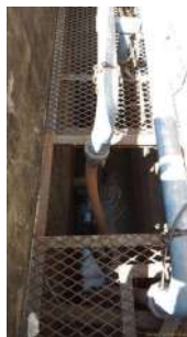
Foto 3 - Detalhe da abertura na plataforma sem qualquer dispositivo auxiliar de içamento, aumentando o risco da atividade.
