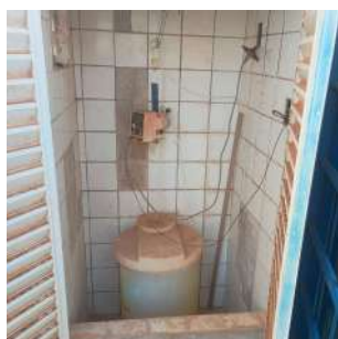
Foto 11 - Armazenamento e dosagem de cloro.
