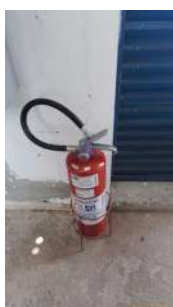
Foto 6 - Detalhe do extintor de incêndio, mostrando sua localização próxima ao acesso
