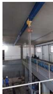
Foto 13 - Vista complementar do sistema de içamento, evidenciando a estrutura do trilho
