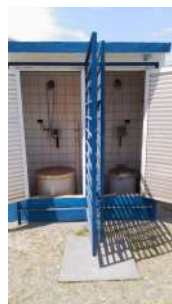
Foto 15 - Local de armazenamento e dosagem de produtos químicos.
