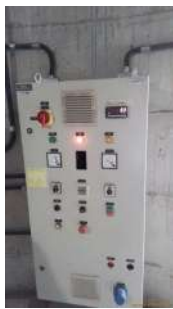
Foto 15 - Vista interna do reservatório: detalhe do quadro de automação e instrumentação.
