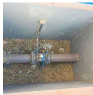
Foto 12 - Macromedidor de saída.
