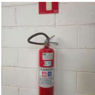
Foto 11 - Extintor de incêndio próximo ao local.
