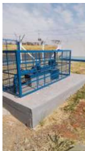
Foto 9 - Detalhe da condição da laje de proteção.
