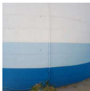
Foto 12 - Em detalhe a fita condutora do Sistema de Proteção contra Descargas Atmosféricas (SPDA)
