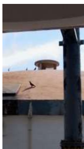
Foto 6 - Vista da tampa de inspeção com tela de proteção contra entrada de animais.
