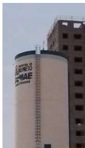
Foto 12 - Em detalhe o posicionamento da haste do Sistema de Proteção contra Descargas Atmosféricas (SPDA).
