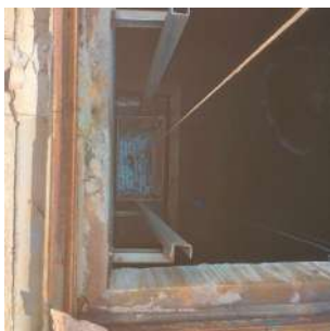
Foto 18 - Vista interna do poço de sucção e do cesto de retenção de sólidos, mostrando corrosão severa na estrutura metálica de suporte e na face interna da tampa.
