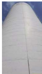
Foto 5 - Detalhe da fita do SPDA.
