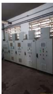
Foto 21 - Vista dos Quadros de Comando Elétrico (QCE) na casa de bombas.
