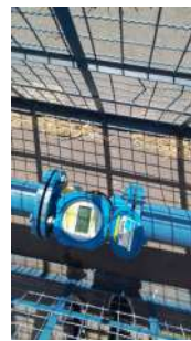
Foto 4 - Vista do macromedidor de vazão.
