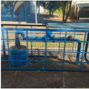
Foto 4 - Detalhe da gaiola de proteção ao redor do cavalete do poço.
