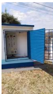
Foto 9 - Vista do local de armazenamento e de dosagem de cloro e flúor. Local estava fechado.
