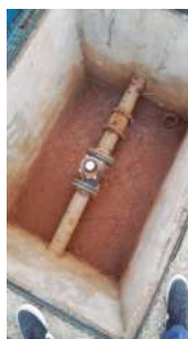
Foto 8 - Vista do macromedidor da vazão de saída do reservatório.
