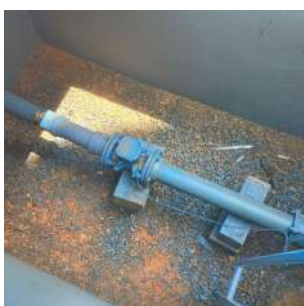
Foto 9 - Vista do macromedidor de saída do reservatório.
