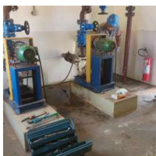
Foto 9 - Vista geral do barrilete de recalque com as duas linhas de bombeamento em paralelo..
