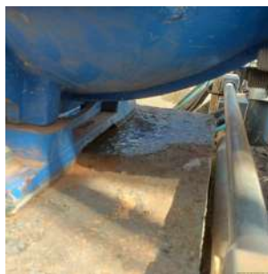
Foto 4 - Evidência de vazamentos aparentes.
