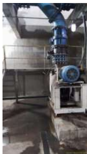
Foto 1 - Vista do conjunto motobomba, evidenciando o piso molhado e com manchas, indicativo de vazamento.
