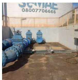
Foto 8 - Detalhe do sistema de adutoras e válvulas de manobra na base do reservatório.
