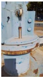
Foto 6 - Em detalhe a tubulação para monitoramento do nível do lençol freático.
