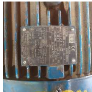
Foto 12 - Detalhe da placa de identificação do motor elétrico do CMB-02.
