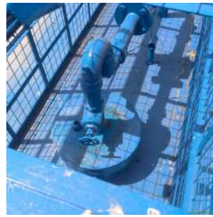
Foto 7 - Em detalhe a tubulação para monitoramento do nível do lençol freático e ponto para coleta de água bruta.
