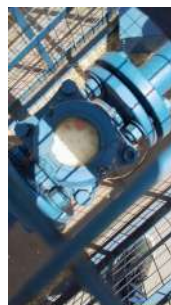
Foto 2 - Evidência de trincas no visor do macromedidor.
