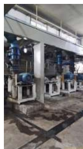
Foto 18 - Vista dos conjuntos motobomba instalados na casa de bombas.
