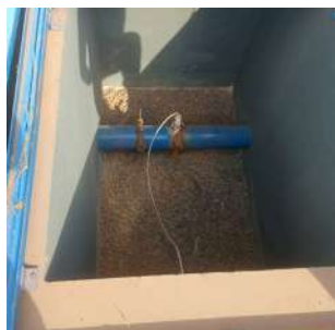
Foto 10 - Detalhe do ponto de dosagem de produto químico.
