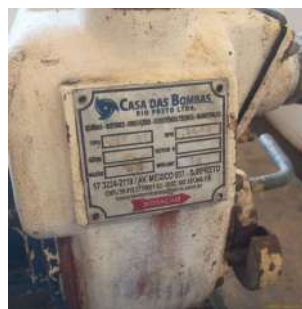
Foto 12 - Detalhe da placa de identificação da bomba do CMB-02
