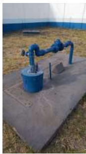
Foto 3 - Detalhe da condição da laje de proteção.
