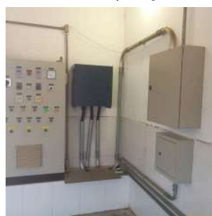
Foto 8 - Vista do Quadro de Comando Elétrico (QCE) e do Quadro de Transferência Automática (QTA) na casa de bombas.
