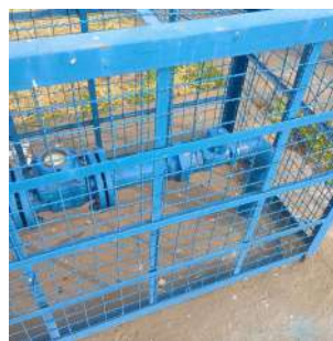
Foto 5 - Vista do macromedidor de vazão e da gaiola de proteção ao redor do cavalete do poço.
