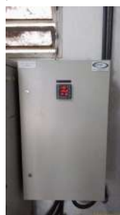
Foto 22 - Detalhe do painel de controle e automação.
