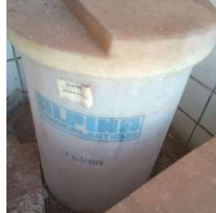
Foto 2 - Evidência da má condição de limpeza do local.
