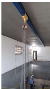
Foto 12 - Detalhe do sistema de içamento para manutenção dos conjuntos motobomba, composto por talha, trilho (monovia) e correntes
