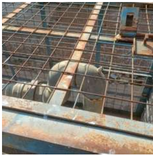
Foto 5 - Detalhe do ponto de coleta de água bruta.
