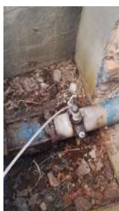
Foto 1 - vazamento na dosagem de cl
