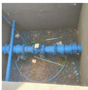
Foto 7 - Vista do macromedidor da vazão de saída do reservatório.
