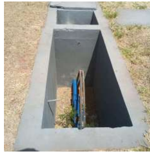
Foto 2 - Detalhe da ausência de tampa ou grade horizontal sobre a caixa de passagem de válvulas.
