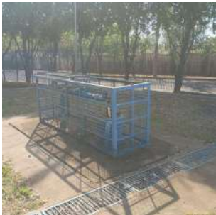
Foto 2 - Detalhe da gaiola de proteção ao redor do cavalete do poço.
