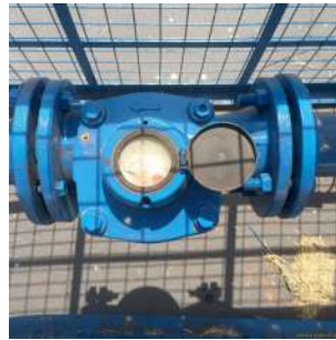
Foto 2 - Macromedidor sem visibilidade e/ou quebrado.
