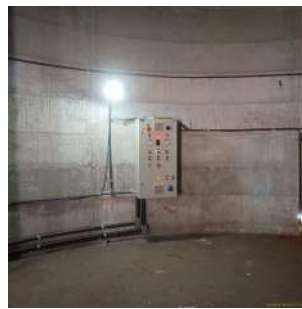
Foto 9 - Vista interna do reservatório: detalhe do quadro de automação e instrumentação.
