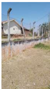
Foto 3 - Vista geral do trecho do cercamento danificado.
