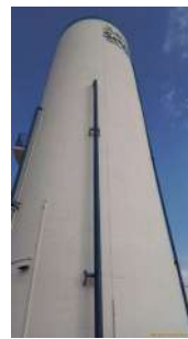
Foto 16 - Detalhe da fita Sistema de Proteção contra Descargas Atmosféricas (SPDA).
