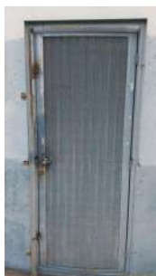
Foto 9 - Portão de acesso interno soldado como alternativa para impedir furtos
