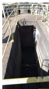
Foto 8 - Vista do caval de distribuição de esgoto para desarenadores.
