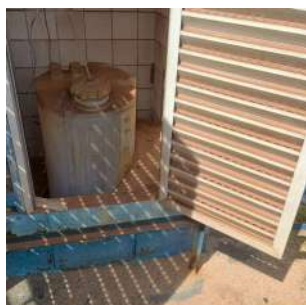
Foto 1 - Evidência do armazenamento de areia na casa de produtos-químicos.
