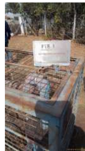
Foto 4 - Detalhe da estrutura metálica da gaiola de proteção, evidenciando o estágio avançado do processo de oxidação e a necessidade de tratamento de superfície e pintura.
