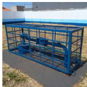
Foto 3 - Detalhe da gaiola de proteção ao redor do cavalete do poço.
