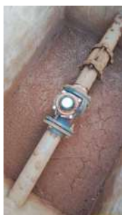
Foto 7 - Vista do macromedidor da vazão de saída do reservatório.
