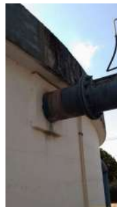
Foto 4 - Evidência de vazamentos aparentes.
