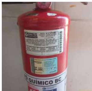
Foto 15 - Registro do extintor de incêndio (Pó Químico BC), dentro do prazo de validade, localizado na casa de bombas.
