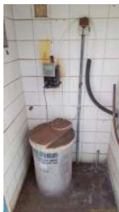
Foto 15 - Armazenamento e dosagem de Flúor.
