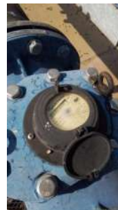
Foto 10 - Vista do macromedidor de vazão.
