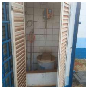
Foto 10 - Armazenamento e dosagem de Flúor.
