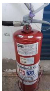
Foto 7 - Registro do extintor de incêndio (Pó Químico BC), dentro do prazo de validade, localizado na casa de bombas.
