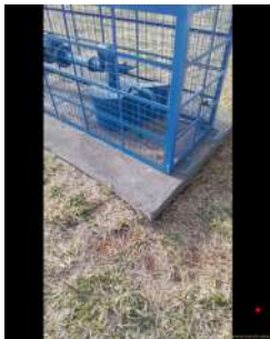
Foto 2 - Detalhe da condição da laje de proteção.
