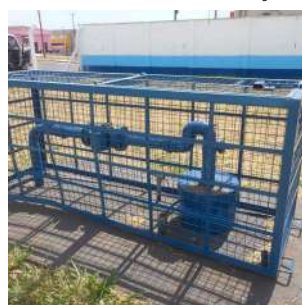
Foto 7 - Detalhe da condição da laje de proteção.
