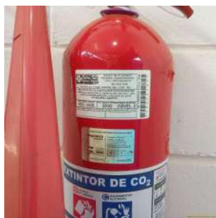
Foto 3 - Extintor de incêndio dentro da validade próximo ao local.
