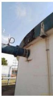
Foto 1 - Evidência de vazamentos aparentes.
