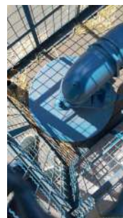
Foto 8 - Detalhe do ponto de coleta de água bruta.
