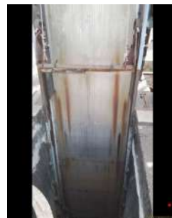
Foto 2 - Vista complementar da peneira de retenção de sólidos, confirmando a passagem de sólidos devido à inoperância do sistema de peneiramento.
