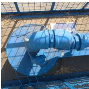
Foto 6 - Detalhe do ponto de coleta de água bruta.
