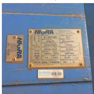
Foto 11 - Delahe da especificação do conjunto moto-bomba com registro de patrimônio do SE
