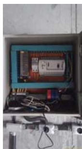
Foto 13 - Painel de controle do reservatório.
