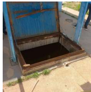
Foto 17 - Outro ângulo da tampa do poço de sucção, reforçando o comprometimento estrutural devido à corrosão.
