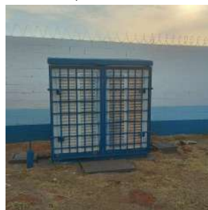
Foto 9 - Vista do local de armazenamento e de dosagem de cloro e flúor.
