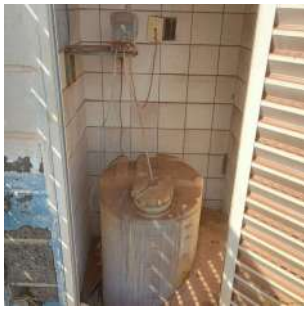
Foto 8 - Armazenamento e dosagem de Flúor.
