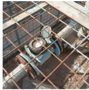
Foto 6 - Vista do macromedidor de vazão.
