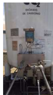
Foto 13 - Detalhe do painel de instrumentação e controle do tanque de Dióxido de Carbono (CO2).
