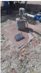
Foto 4 - Detalhe da condição da laje de proteção.
