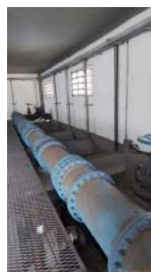
Foto 11 - Vista da tubulação de recalque na casa de bombas.
