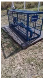
Foto 3 - Detalhe da condição da laje de proteção.
