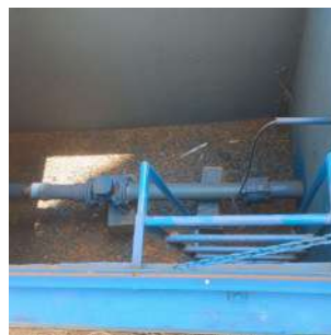
Foto 8 - Vista do macromedidor de saída do reservatório.
