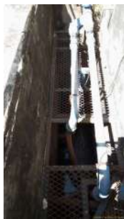
Foto 1 - Vista do poço de sucção, evidenciando a ausência de um ponto de ancoragem ou estrutura dedicada para o içamento dos conjuntos motobomba.
