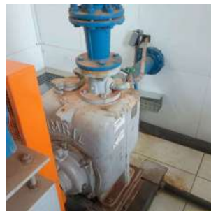
Foto 11 - Vista do conjunto motobomba 02 (CMB-02).
