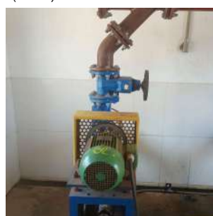
Foto 10 - Vista do conjunto motobomba 01 (CMB-01) e da tubulação de recalque.
