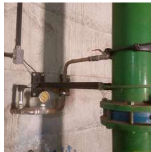
Foto 11 - Vista interna do reservatório: detalhe do sensor de nível para controle operacional.
