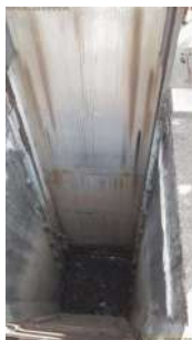
Foto 1 - Vista da peneira de retenção de sólidos, evidenciando o esgoto bruto e a ausência de retenção de sólidos no canal.
