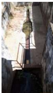
Foto 1 - Vista do canal de entrada da EEE, evidenciando a ausência de um sistema de gradeamento grosseiro antes da caixa de areia (desarenador), que precede o poço de sucção.
