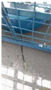
Foto 1 - Evidência da fissura na laje de proteção do poço.
