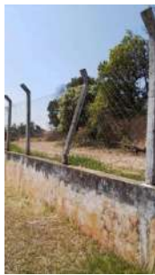
Foto 1 - Evidência de mourão quebrado e inclinação da estrutura do cercamento.
