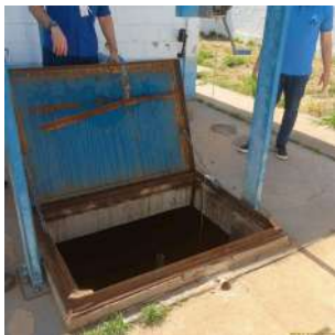
Foto 16 - Detalhe da tampa do poço de sucção, exibindo processo de corrosão avançada na estrutura metálica.
