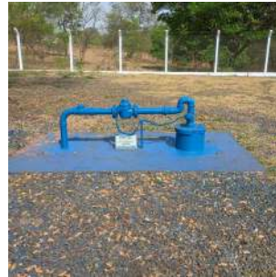
Foto 4 - Detalhe da condição da laje de proteção.
