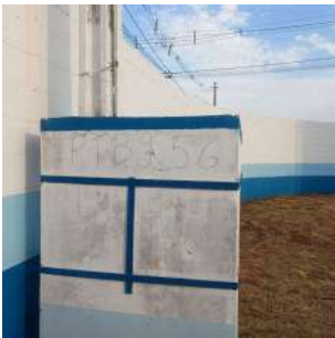
Foto 1 - Detalhe da indicação improvisada do poço.
