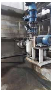
Foto 3 - Vista do conjunto motobomba, evidenciando o piso molhado e com manchas, indicativo de vazamento.
