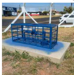
Foto 5 - Detalhe da gaiola de proteção ao redor do cavalete do poço.
