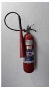
Foto 9 - Registro do extintor de incêndio (Pó Químico BC), dentro do prazo de validade, localizado na casa de bombas.
