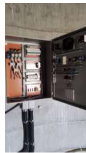
Foto 9 - Detalhe da ausência de Soft-Starter por roubo ao local.
