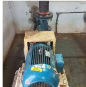
Foto 8 - Vista do conjunto motobomba 02 (CMB-02).
