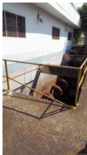
Foto 10 - guarda corpo bambo e enferrujado
