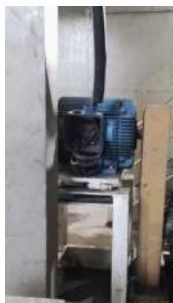
Foto 12 - Detalhe da caixa de comando, evidenciando a falta de tampa.
