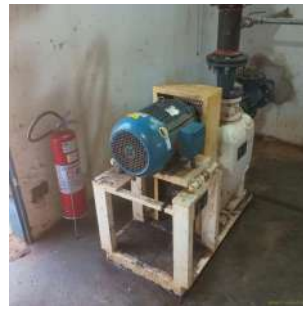
Foto 7 - Vista do conjunto motobomba 01 (CMB-01) e do extintor de incêndio.
