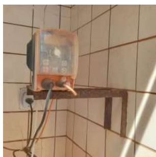
Foto 3 - Evidência da condição do suporte da bomba (corrosão avançada).
