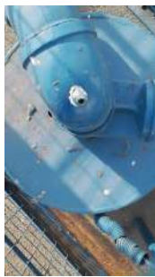
Foto 3 - Detalhe do ponto de coleta de água bruta.
