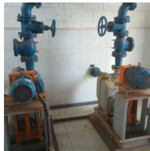
Foto 8 - Detalhe dos conjuntos motobomba em operação no local.
