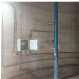
Foto 8 - Vista do quadro elétrico e sensor de nível para controle operacional.
