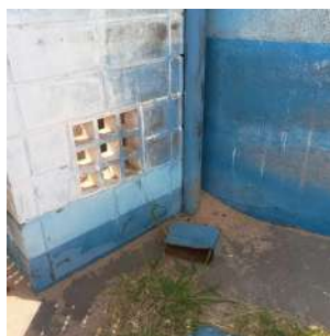
Foto 2 - Evidência de acúmulo de areia e crescimento de vegetação na base da estrutura, junto à parede do reservatório.
