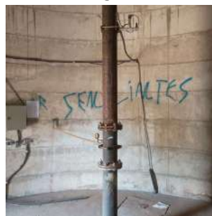
Foto 4 - Vista interna do reservatório: detalhe do sensor para medição de nível do reservatório.
