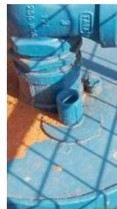
Foto 2 - Detalhe do tubo de aferição de nível sem a tampa de vedação, configurando um ponto de vulnerabilidade para a contaminação da água.
