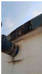
Foto 3 - Evidência de vazamentos aparentes.
