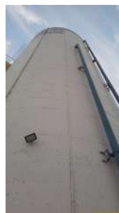
Foto 3 - Vista da fita do SPDA.
