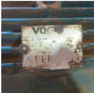
Foto 9 - Detalhe da placa de identificação do motor elétrico (VOG) do CMB-01.
