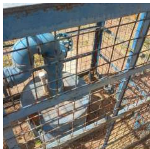
Foto 5 - Em detalhe a tubulação para monitoramento do nível do lençol freático.
