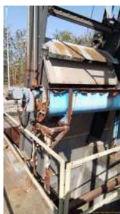
Foto 1 - Vista de parte da estrutura da peneira de remoção de sólidos, evidenciando o estado de corrosão e o dispositivo de remoção de areia inoperante.
