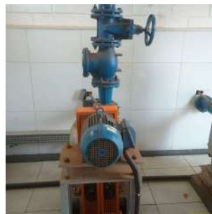
Foto 9 - Vista do conjunto motobomba 01 (CMB-01), com destaque para a válvula de gaveta e a válvula de retenção na linha de recalque.
