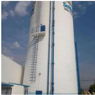
Foto 1 - Evidência de lances de escada alinhados de forma inadequada no mesmo eixo.
