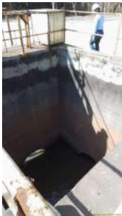
Foto 1 - Vista superior do canal de entrada da EEE, evidenciando o esgoto bruto.
