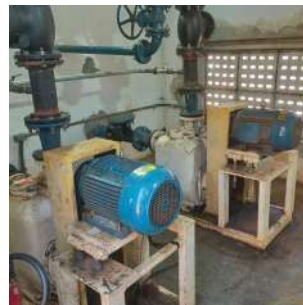
Foto 5 - Vista dos conjuntos motobomba de superfície (sucção a seco) instalados na casa de bombas. O sistema é composto por duas unidades de bombeamento, responsáveis pela elevação do esgoto para a linha de recalque.
