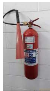
Foto 7 - Vista de um dos extintores do local.
