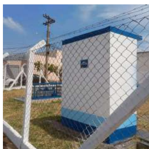
Foto 1 - Em detalhe a placa de identificação do poço.
