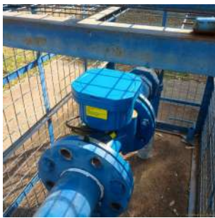
Foto 5 - Vista do macromedidor de vazão.
