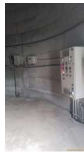
Foto 16 - Vista interna do reservatório: detalhe do quadro de automação e instrumentação.
