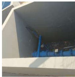
Foto 2 - Detalhe do interior da caixa de passagem, mostrando a profundidade e os equipamentos expostos. A ausência de tampa ou grade de proteção é uma falha crítica de segurança.
