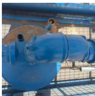
Foto 4 - Detalhe do ponto de coleta de água bruta.
