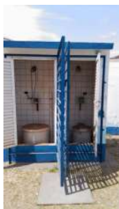
Foto 14 - Local de armazenamento e dosagem de produtos químicos.
