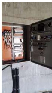
Foto 8 - Evidência do furto do painel elétrico de controle .
