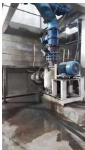
Foto 5 - Vista do conjunto motobomba, evidenciando o piso molhado e com manchas, indicativo de vazamento.
