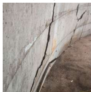
Foto 3 - Detalhe de outra rachadura significativa na estrutura interna.
