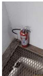
Foto 10 - Detalhe do extintor de incêndio, mostrando sua localização próxima ao acesso.
