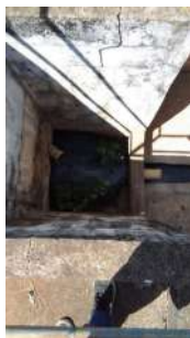
Foto 1 - Vista do canal de entrada da EEE, evidenciando a chegada do esgoto bruto diretamente à caixa de areia, sem a passagem por um sistema de gradeamento para retenção de sólidos grosseiros.
