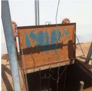
Foto 1 - Evidência de corrosão avançada na estrutura metálica da tampa do poço de sucção.
