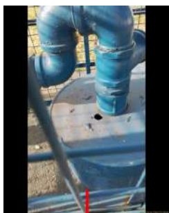
Foto 1 - Vista superior da laje do poço, evidenciando a ausência de um tubo piezométrico para medição de nível.
