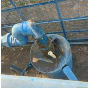
Foto 1 - Evidência de vazamentos aparentes.
