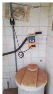
Foto 2 - Evidência da necessidade de limpeza imediata da bombas dosadoras e da casa de armazenamento/dosagem de cloro e flúor.
