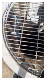
Foto 2 - Evidência da ausência de guarda corpo.
