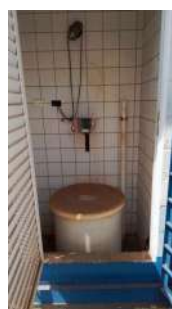
Foto 13 - Armazenamento e dosagem de cloro
