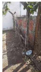
Foto 2 - Evidência da necessidade de manutenção no cercamento.
