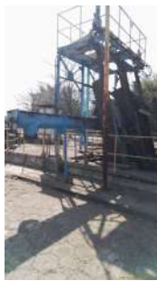
Foto 3 - Vista geral da estrutura do sistema de peneiramento, evidenciando o estado de sucateamento e a inoperância do equipamento.
