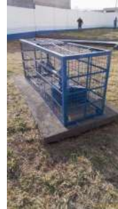
Foto 6 - Detalhe da gaiola de proteção ao redor do cavalete do poço.
