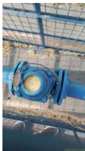
Foto 1 - Detalhe do visor do macromedidor com visibilidade prejudicada, impossibilitando a coleta de leitura.
