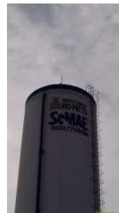
Foto 18 - Em detalhe o posicionamento da haste do Sistema de Proteção contra Descargas Atmosféricas (SPDA).
