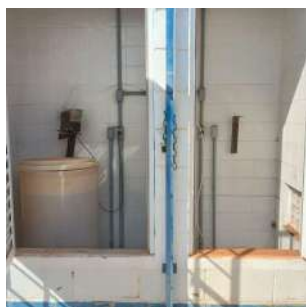
Foto 1 - Evidência da ausência de tanque de armazenamento e de dosagem de flúor.
