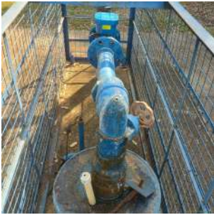
Foto 3 - Em detalhe a tubulação para monitoramento do nível do lençol freático.
