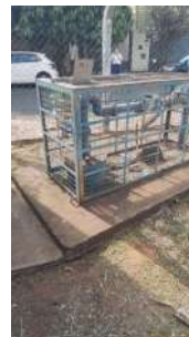
Foto 5 - Detalhe da condição da laje de proteção.
