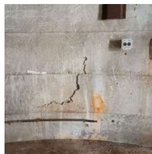
Foto 2 - Detalhe de fissura na parede de concreto, indicando patologia estrutural.
