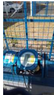
Foto 12 - Detalhe do macromedidor de vazão.
