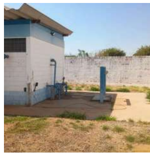
Foto 5 - Vista externa do poço de sucção.
