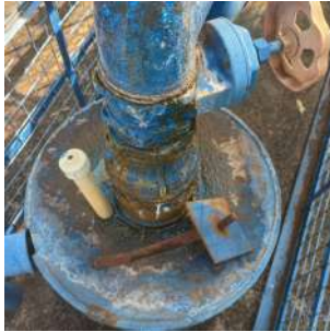
Foto 3 - Evidência de vazamentos aparentes.
