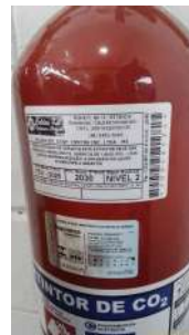
Foto 8 - Extintor de incêndio com manutenção de 2o e 3o nível dentro da validade.
