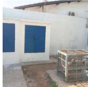
Foto 8 - Vista do painel de comando elétrico do poço.
