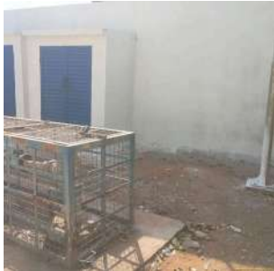
Foto 7 - Detalhe da condição da laje de proteção.
