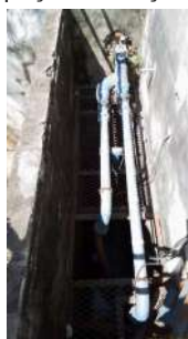
Foto 3 - Detalhe da tubulação de recalque.
