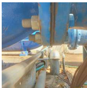
Foto 5 - Evidência de vazamentos aparentes.
