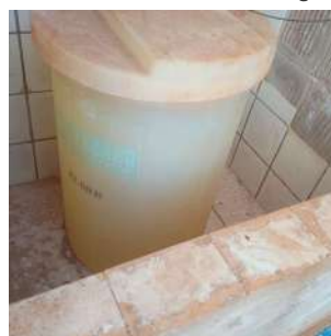
Foto 12 - Armazenamento de cloro.
