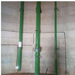
Foto 10 - Detalhe das tubulações de entrada e saída do reservatório.
