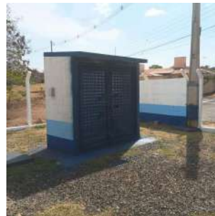
Foto 9 - Vista do local de armazenamento e de dosagem de cloro e flúor. Local estava fechado.
