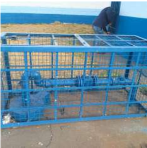
Foto 3 - Detalhe da condição da laje de proteção.
