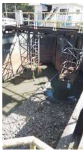
Foto 8 - Vista do desarenador, mostrando o grande acúmulo de areia no fundo.
