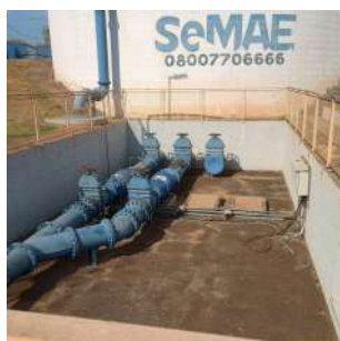
Foto 5 - Detalhe do sistema de adutoras e válvulas de manobra na base do reservatório.
