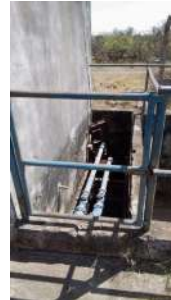
Foto 12 - Estrutura de acesso (guarda-corpo e piso metálico) sobre o poço de sucção.
