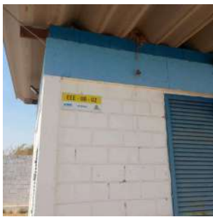
Foto 4 - Detalhe da identificação da unidade (EEE SETJARDIM 08-02).
