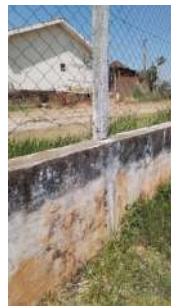
Foto 2 - Detalhe de outro ponto do cercamento com danos na estrutura e na tela.
