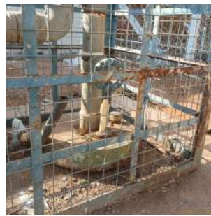
Foto 2 - Detalhe da lateral da estrutura, com pontos de corrosão avançada e descascamento da pintura.
