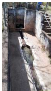
Foto 2 - Detalhe do desarenador que precede o poço de sucção.
