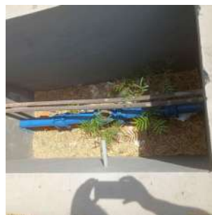
Foto 6 - Tubulação de entrada de água no reservatório.
