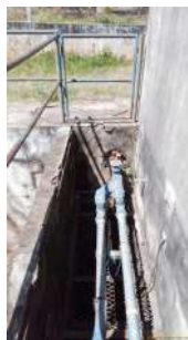
Foto 2 - Plataforma de acesso sobre o poço de sucção, onde se confirma a inexistência de um sistema de içamento (talha, pórtico ou monovia).
