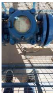
Foto 1 - Evidência de trincas no visor do macromedidor.
