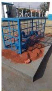
Foto 1 - Acúmulo de terra na laje do reservatório, indicativo de atividade de insetos e falha no procedimento de limpeza.
