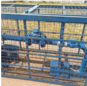
Foto 8 - Vista do macromedidor de vazão.
