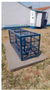
Foto 6 - Detalhe da gaiola de proteção ao redor do cavalete do poço.
