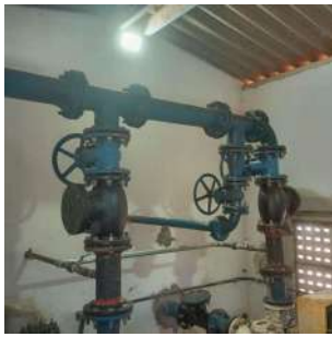
Foto 6 - Vista do barrilete de recalque da estação elevatória, evidenciando a interligação das linhas de bombeamento em paralelo..
