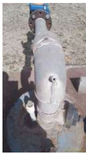
Foto 5 - Detalhe do ponto de coleta de água bruta.
