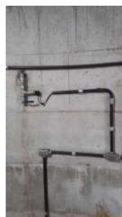
Foto 14 - Vista do cabeamento do sensor de nível para controle operacional.
