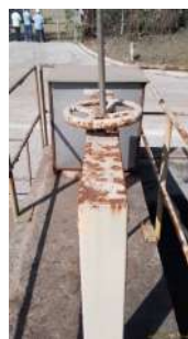
Foto 2 - Detalhe da comporta, mostrando a corrosão e o registro de abertura enferrujado e com dificuldade de manobra.
