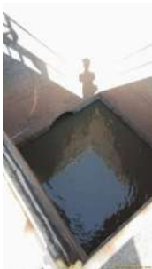
Foto 2 - Vista superior do poço de sucção (poço úmido).
