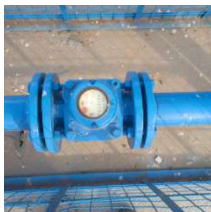
Foto 6 - Vista do macromedidor de vazão.
