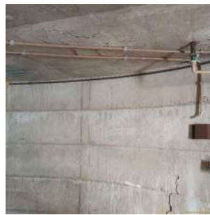
Foto 5 - Vista geral do interior do reservatório, evidenciando rachaduras na parede e a necessidade de manutenção.
