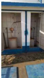
Foto 5 - Vista do local de armazenamento e de dosagem de cloro e flúor.
