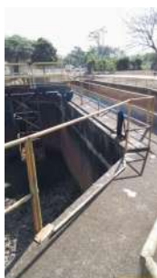
Foto 6 - Detalhe do guarda-corpo, evidenciando a corrosão e a falta de manutenção.
