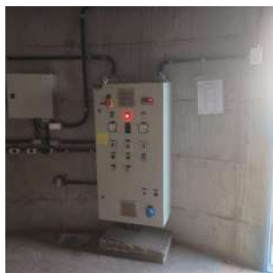
Foto 8 - Vista interna da Sala do painel de comando elétrico do poço de captação subterrânea.
