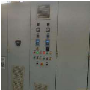
Foto 1 - Detalhe do painel de comando e controle da estação elevatória de água tratada
