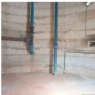
Foto 9 - Detalhe das tubulações de entrada e saída do reservatório.
