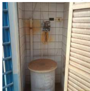
Foto 7 - Constatou-se a necessidade de limpeza imediata da bombas dosadoras e da casa de armazenamento/dosagem de cloro e flúor.
