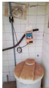
Foto 16 - Armazenamento e dosagem de cloro.
