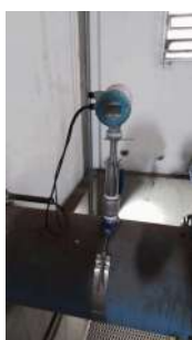
Foto 19 - Detalhe do macromedidor de vazão.
