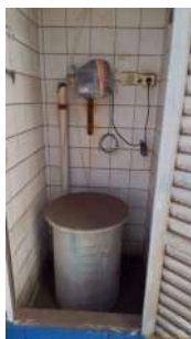
Foto 3 - Evidência da necessidade de limpeza imediata da bombas dosadoras e da casa de armazenamento/dosagem de cloro e flúor.
