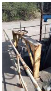
Foto 3 - Vista complementar da comporta, reforçando o estado de deterioração.
