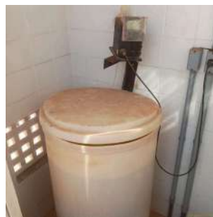
Foto 18 - Armazenamento e dosagem de cloro
