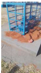
Foto 12 - Detalhe da condição da laje de proteção.
