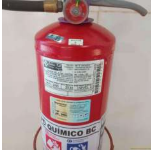
Foto 14 - Registro do extintor de incêndio (Pó Químico BC), dentro do prazo de validade, localizado na casa de bombas.
