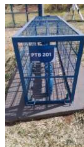
Foto 11 - Em detalhe a placa de identificação do poço.
