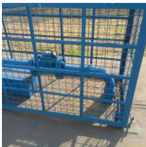
Foto 4 - Vista do macromedidor de vazão.
