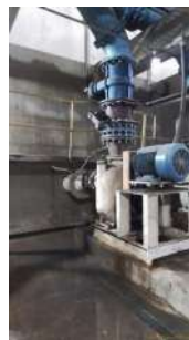
Foto 4 - Vista do conjunto motobomba, evidenciando o piso molhado e com manchas, indicativo de vazamento.
