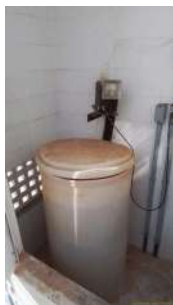
Foto 1 - Tanque de armazenamento de cloro sem identificação.
