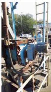
Foto 5 - Detalhe do sistema de peneiramento, mostrando a rosca sem fim inoperante e a corrosão da estrutura.
