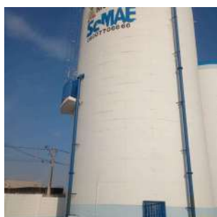
Foto 4 - Em detalhe a fita condutora do Sistema de Proteção contra Descargas Atmosféricas (SPDA) e o guarda corpo na escada e plataforma intermediária na parte superior do reservatório.
