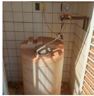
Foto 9 - Armazenamento e dosagem de cloro
