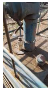
Foto 2 - Em detalhe a tubulação para monitoramento do nível do lençol freático.
