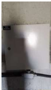
Foto 1 - Painel de controle.
