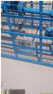
Foto 1 - Em detalhe a placa de identificação do poço.
