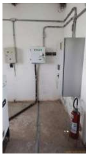
Foto 8 - Vista interna da casa de bombas, mostrando o Grupo Motor Gerador (GMG) e o Quadro de Transferência Automática (QTA).
