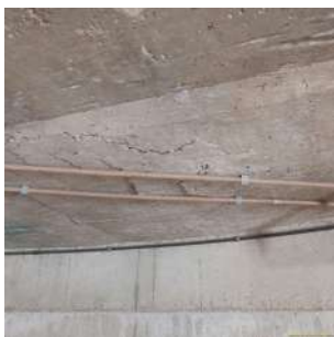
Foto 6 - Evidência de fissura na parede de concreto.
