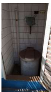
Foto 12 - Armazenamento e dosagem de Cloro.
