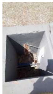
Foto 11 - - Detalhe do ponto de dosagem de cloro e flúor.
