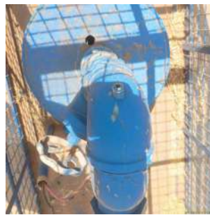
Foto 7 - Em detalhe da ausência de tubulação para monitoramento do nível do lençol freático.
