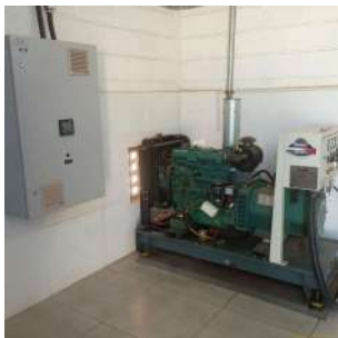
Foto 7 - Vista interna da casa de bombas, mostrando o Grupo Motor Gerador (GMG) e o Quadro de Transferência Automática (QTA).
