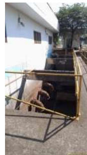
Foto 11 - Detalhe do guarda-corpo, evidenciando a corrosão e o estado de conservação precário.
