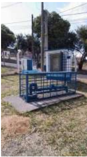
Foto 2 - Detalhe da gaiola de proteção ao redor do cavalete do poço.
