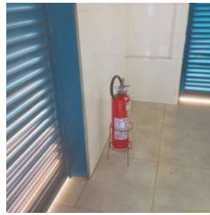
Foto 13 - Detalhe do extintor de incêndio, mostrando sua localização próxima ao acesso.
