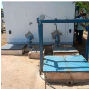
Foto 4 - Vista da tubulação de recalque, válvulas e da estrutura de acesso ao poço de sucção.
