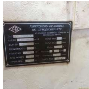
Foto 10 - Detalhe da placa de identificação da bomba (KSB) do CMB-01.
