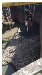
Foto 7 - Vista do desarenador, mostrando o grande acúmulo de areia no fundo.
