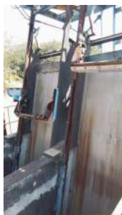
Foto 4 - Vista frontal da estrutura da peneira de remoção de sólidos, evidenciando o estado de corrosão e o dispositivo de remoção de areia inoperante.
