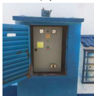
Foto 4 - Painel de controle do poço.
