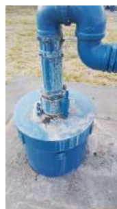
Foto 2 - Evidência de vazamentos aparentes.
