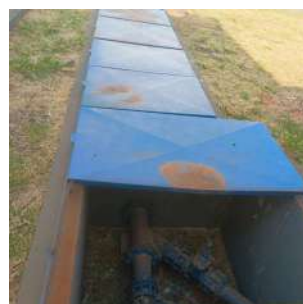
Foto 13 - Caixa de passagem de tubulação com tampa.
