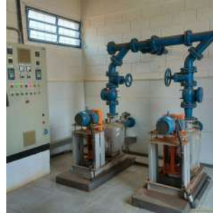
Foto 15 - Vista geral do barrilete de recalque com as duas linhas de bombeamento e seus respectivos manômetros.
