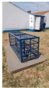
Foto 7 - Vista da gaiola de proteção ao redor do cavalete do poço.
