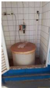
Foto 7 - Armazenamento e dosagem de Cloro.
