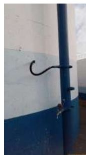
Foto 13 - Detalhe do sensor de nível para controle operacional.
