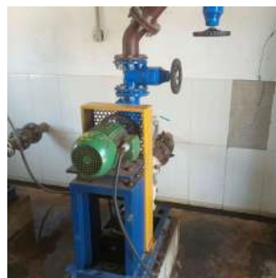
Foto 14 - Vista do conjunto motobomba 01 (CMB-01) e da tubulação de recalque.
