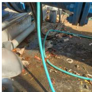
Foto 3 - Evidência de vazamentos aparentes.
