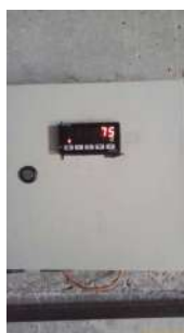
Foto 14 - Vista interna do reservatório: detalhe do sensor de nível para controle operacional.
