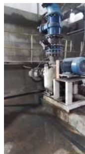
Foto 2 - Vista do conjunto motobomba, evidenciando o piso molhado e com manchas, indicativo de vazamento.
