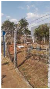
Foto 1 - Vista geral do cercamento, evidenciando mourão de concreto quebrado e a inclinação da estrutura, o que compromete a integridade de todo o perímetro.
