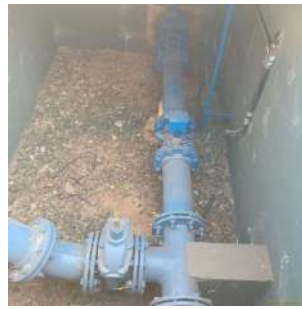
Foto 10 - Em detalhe o macromedidor de vazão de saída do reservatório Marilda Melo
