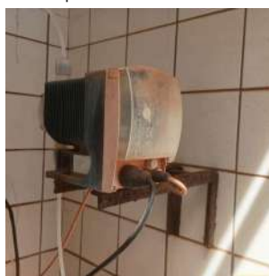
Foto 4 - Evidência do acúmulo excessivo de sujeira sobre a bomba dosadora, impossibilitando a visualização do display e a verificação de seus parâmetros operacionais.
