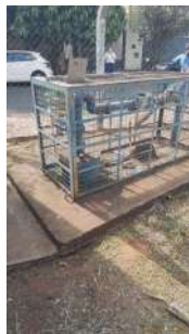
Foto 3 - Vista geral da gaiola de proteção, onde se observa o processo de corrosão e o destacamento da película de tinta.
