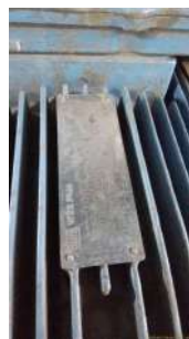
Foto 16 - Detalhe da placa de identificação do motor elétrico do conjunto motobomba.
