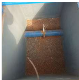
Foto 11 - Detalhe do ponto de dosagem de outro ponto de produto químico.
