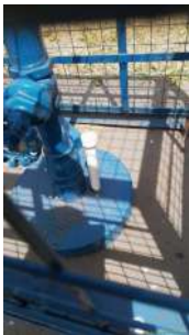
Foto 3 - Em detalhe a tubulação para monitoramento do nível do lençol freático.
