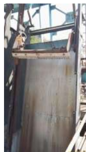
Foto 5 - Vista frontal da estrutura da peneira de remoção de sólidos, evidenciando o estado de corrosão e o dispositivo de remoção de areia inoperante.
