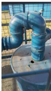
Foto 3 - Evidência da ausência da tubulação de monitoramento do nível do leçol freático.
