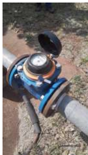
Foto 7 - Vista do macromedidor da vazão.
