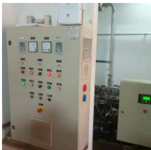
Foto 13 - Vista do Quadro de Comando Elétrico (QCE) e do Quadro de Transferência Automática (QTA) na casa de bombas.
