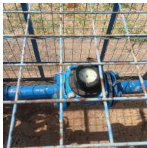
Foto 6 - Vista do macromedidor de vazão.
