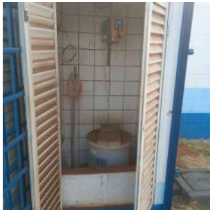
Foto 3 - Evidência de acúmulo de poeira na casa de químicos.
