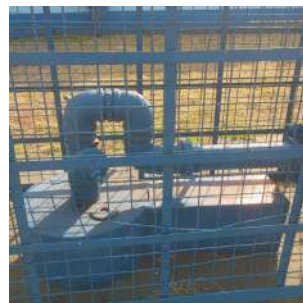
Foto 5 - Em detalhe a tubulação para monitoramento do nível do lençol freático (sem tampa)
