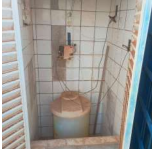
Foto 1 - Evidência da má condição de limpeza do local.
