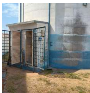
Foto 7 - Vista do local de armazenamento e de dosagem de cloro e flúor.
