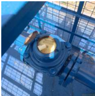
Foto 8 - Vista do macromedidor de vazão.
