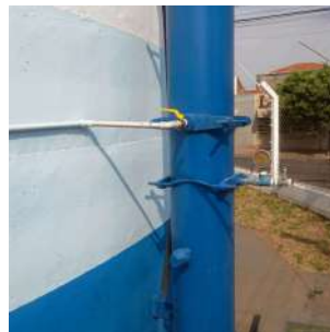
Foto 5 - Em detalhe manômetro e registro para coleta de água para análise.
