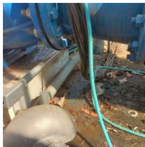
Foto 2 - Evidência de vazamentos aparentes.
