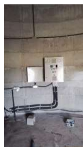
Foto 7 - Vista interna do reservatório: detalhe do quadro de automação e instrumentação.
