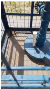
Foto 4 - Em detalhe a tubulação para monitoramento do nível do lençol freático.
