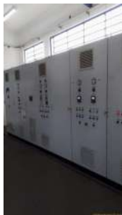
Foto 9 - Vista interna da Sala do painel de comando elétrico do poço de captação subterrânea.
