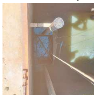
Foto 17 - Vista complementar do poço de sucção.
