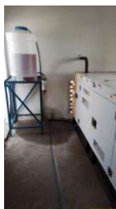
Foto 5 - Vista interna da casa de bombas, mostrando o Grupo Motor Gerador (GMG) para fornecimento de energia em emergência e o respectivo tanque de diesel diário.
