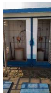
Foto 4 - Vista do local de armazenamento e de dosagem de cloro e flúor.
