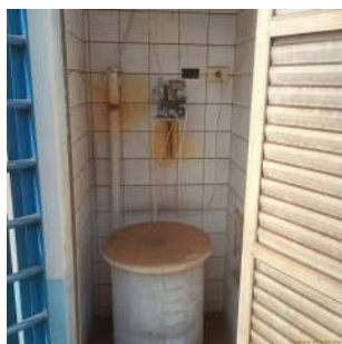
Foto 8 - Armazenamento e dosagem de Flúor.
