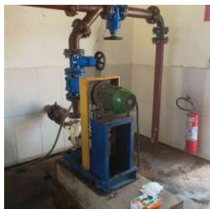
Foto 13 - Vista do conjunto motobomba 02 (CMB-02) e da tubulação de recalque.
