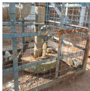
Foto 4 - Em detalhe a tubulação para monitoramento do nível do lençol freático.
