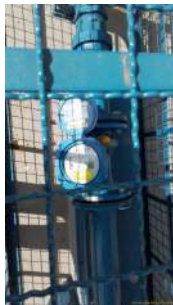
Foto 11 - Vista do macromedidor de vazão.
