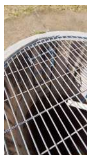
Foto 4 - Evidência da ausência de guarda corpo.
