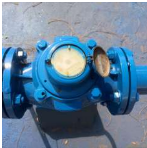
Foto 6 - Vista do macromedidor de vazão.
