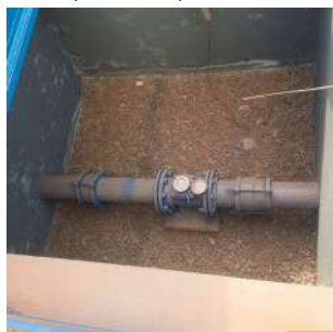
Foto 12 - Detalhe do macromedidor para medição da vazão de entrada da água captada pelos poços.
