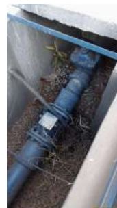
Foto 2 - Evidência de vazamentos aparentes próximos ao macromedidor de vazão.
