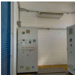
Foto 13 - Painel de automação do poço.
