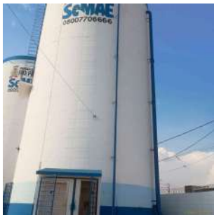
Foto 3 - Vista do local de armazenamento e de dosagem de cloro e flúor localizado na base do reservatório.
