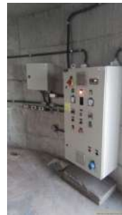
Foto 4 - Vista interna do reservatório: detalhe do quadro de automação e instrumentação.
