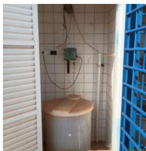
Foto 9 - Armazenamento e dosagem de cloro
