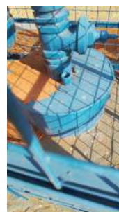
Foto 11 - Em detalhe a tubulação para monitoramento do nível do lençol freático.
