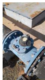
Foto 11 - Vista do macromedidor de vazão.
