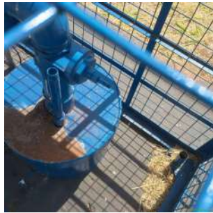
Foto 1 - Tubo de verificação de nível do reservatório encontrado sem a devida tampa de proteção.
