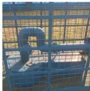
Foto 2 - Evidência da falta de vedação na extremidade do tubo de aferição de nível.
