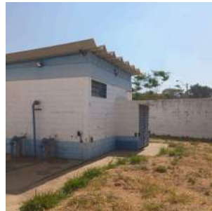
Foto 6 - Vista lateral da casa de bombas e poço de sucção.
