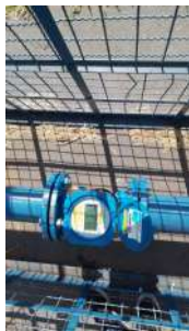
Foto 5 - Vista do macromedidor de vazão.
