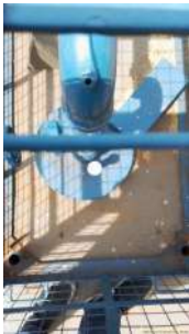
Foto 2 - Detalhe do ponto de coleta de água bruta.
