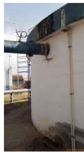
Foto 2 - Evidência de vazamentos aparentes.
