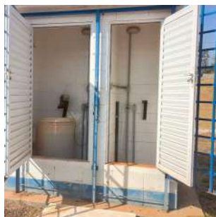
Foto 17 - Vista da Local de armazenamento e dosagem de produtos químicos com detalhe para a ausência do tanque de armazenamento de flúor.
