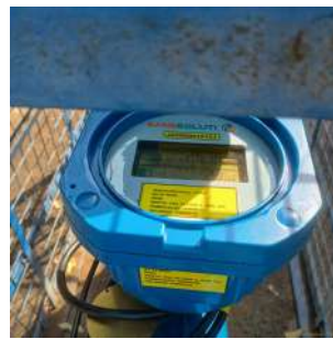
Foto 6 - Vista do macromedidor de vazão.
