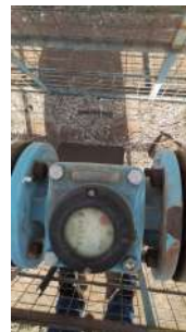
Foto 4 - Vista do macromedidor de vazão.
