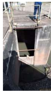
Foto 9 - Vista da estrutura, evidenciando a ausência de comporta em um dos canais.
