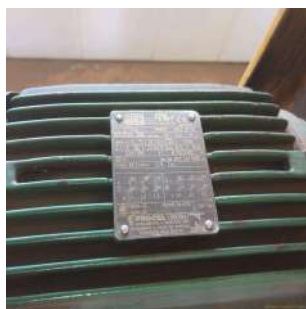
Foto 11 - Detalhe da placa de identificação da bomba do CMB-01.
