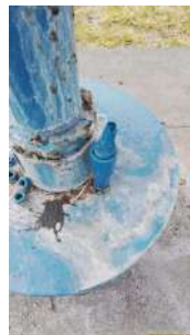
Foto 8 - Em detalhe a tubulação para monitoramento do nível do lençol freático.
