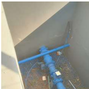
Foto 3 - Vista geral da área operacional, evidenciando a caixa de passagem de válvulas completamente aberta e sem qualquer tipo de proteção contra quedas, configurando risco iminente de acidente.
