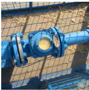
Foto 8 - Vista do macromedidor de vazão.
