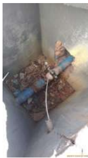
Foto 5 - Ponto de dosagem de Cloro.
