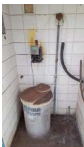
Foto 1 - Evidência da necessidade de limpeza imediata da bombas dosadoras e da casa de armazenamento/dosagem de cloro e flúor.
