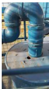
Foto 2 - Evidência da ausência da tubulação de monitoramento do nível do lençol freático.
