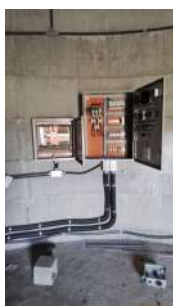
Foto 3 - Evidência do furto do painel elétrico de controle .
