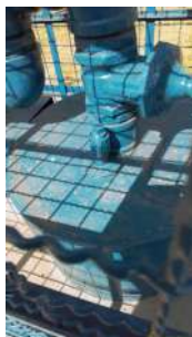
Foto 13 - Em detalhe a tubulação para monitoramento do nível do lençol freático.
