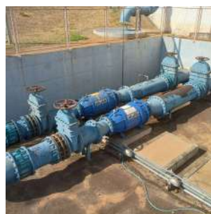
Foto 6 - Detalhe do sistema de adutoras e válvulas de manobra na base do reservatório.
