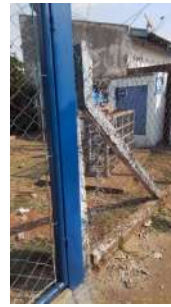
Foto 2 - Detalhe da cerca ao lado do portão de acesso, mostrando a falta de alinhamento e a precariedade da sustentação, indicando falha estrutural e de conservação.
