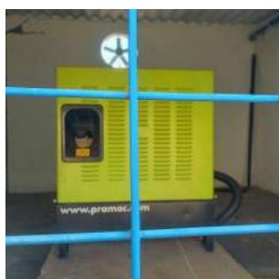
Foto 7 - Detalhe de gerador
