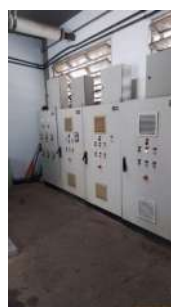
Foto 20 - Vista do Quadro de Comando Elétrico (QCE) na casa de bombas.
