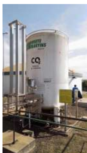
Foto 12 - Sistema de armazenamento e dosagem de Dióxido de Carbono (CO2).
