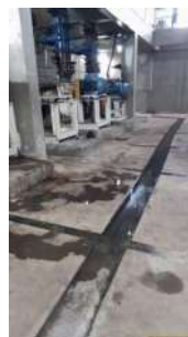
Foto 6 - Vista do piso da casa de bombas, evidenciando o escoamento de efluente/água, confirmando a existência de vazamento aparente.
