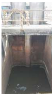
Foto 5 - Vista superior do poço de sucção (poço úmido).
