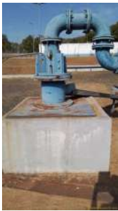
Foto 4 - Detalhe da condição da laje de proteção.
