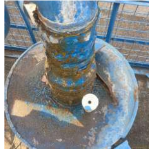
Foto 2 - Evidência de vazamentos aparentes.
