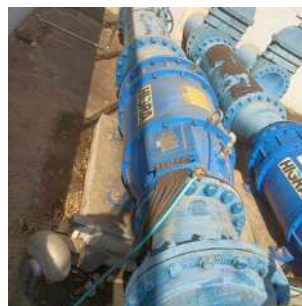
Foto 10 - Detalhe do conjunto motobomba 1 (marca Hidra).
