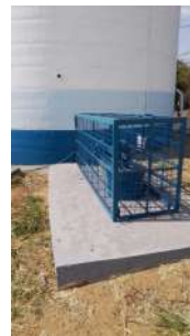
Foto 8 - Detalhe da gaiola de proteção ao redor do cavalete do poço.
