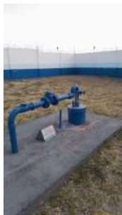
Foto 7 - Detalhe do poço sem a gaiola de proteção ao redor do cavalete.
