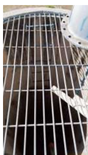
Foto 3 - Evidência da ausência de guarda corpo.
