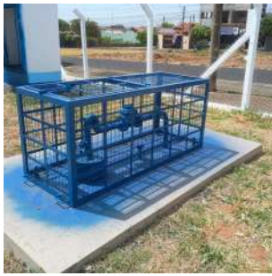
Foto 6 - Detalhe da condição da laje de proteção.
