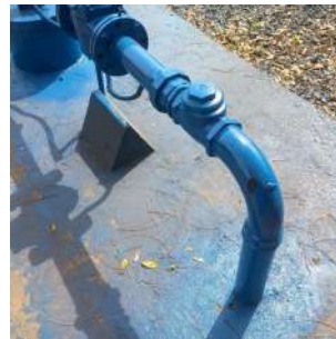
Foto 7 - Detalhe do ponto de coleta de água bruta.
