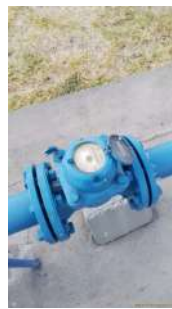
Foto 4 - Vista do macromedidor de vazão.
