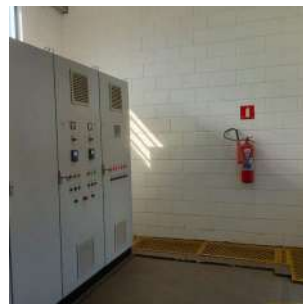
Foto 14 - Vista interna da Sala do painel de comando elétrico do poço de captação subterrânea.
