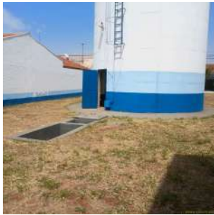
Foto 1 - Evidência da ausência de tampa ou grade horizontal sobre a caixa de passagem de válvulas.
