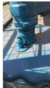
Foto 6 - Em detalhe a tubulação para monitoramento do nível do lençol freático.
