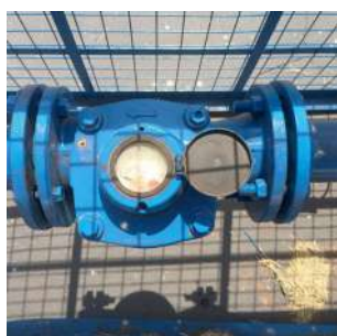
Foto 6 - Vista do macromedidor de vazão.
