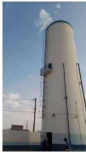
Foto 1 - Evidência de lances de escada alinhados de forma inadequada no mesmo eixo.
