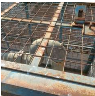
Foto 3 - Vista superior mostrando a oxidação nas grade
