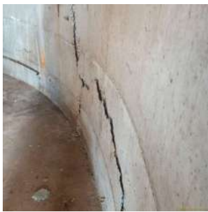
Foto 4 - Detalhe de outra rachadura significativa na estrutura interna.
