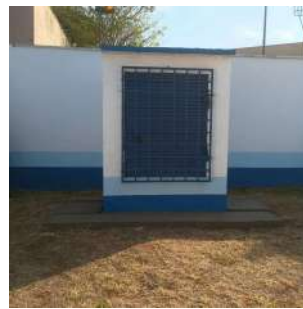
Foto 9 - Vista do painel de comando elétrico do poço.
