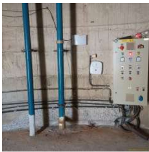
Foto 5 - Vista interna do reservatório: detalhe do quadro de automação e instrumentação, incluindo sensor de nível e manômetro da tubulação.
