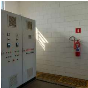
Foto 2 - Vista interna da Sala do painel de comando elétrico da estação elevatória.
