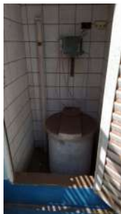
Foto 1 - Evidência da necessidade de limpeza imediata da bomba dosadora e da casa de armazenamento/dosagem de cloro e flúor.
