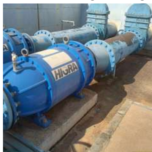
Foto 9 - Detalhe do conjunto motobomba 2 (marca Hidra).
