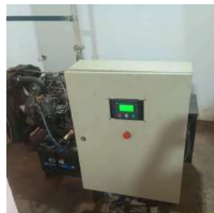
Foto 14 - Detalhe do painel de controle e automação da EEE.
