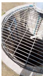
Foto 1 - Evidência da ausência de guarda corpo.
