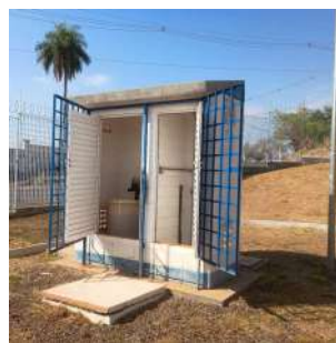
Foto 16 - Vista do local de armazenamento e de dosagem de cloro e flúor.
