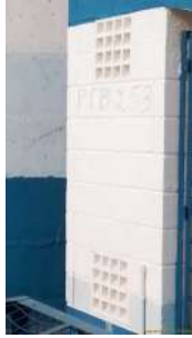
Foto 1 - Evidência da falta de placa de identificação padronizada. A identificação da unidade (PTB 253) foi feita fora padrão SEMAE exigido.
