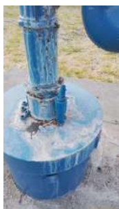
Foto 1 - Evidência de vazamentos aparentes.
