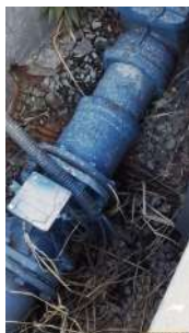
Foto 1 - Vista do macromedidor da vazão de saída do reservatório.
