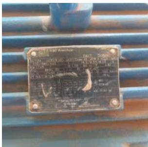
Foto 10 - Detalhe da placa de identificação do motor elétrico do CMB-01.
