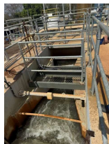
Foto 11 - Entrada de água bruta
