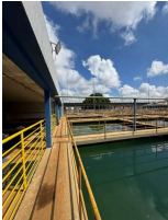
Foto 5 - Vista dos decantadores
