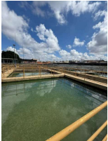
Foto 6 - Vista dos decantadores
