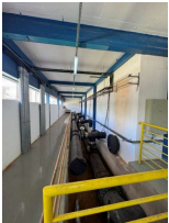
Foto 2 - Vista geral interna dos filtros
