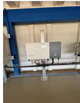
Foto 19 - Bateria da energia solar
