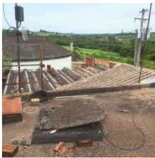
Foto 1 - Vista geral da laje do reservatório, sem guarda-corpo.
