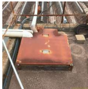
Foto 10 - Tampa de inspeção, com oxidação em estágio avançado.
