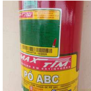
Foto 18 - Extintor de incêndio próximo ao abrigo de produtos químicos.
