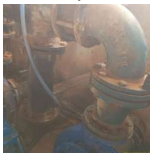
Foto 4 - Detalhe do vazamento no barrilete dos conjuntos 3 e 4.
