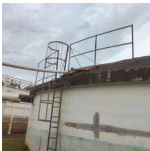
Foto 1 - Situação da tampa de inspeção.
