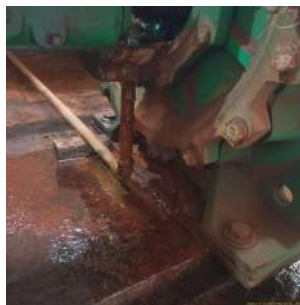
Foto 2 - Drenagem da água de lubrificação de gaxeta da bomba do conjunto 2.
