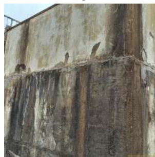
Foto 6 - Vazamentos no tanque de equalização (intermediário) entre filtros e reservatório retangular.
