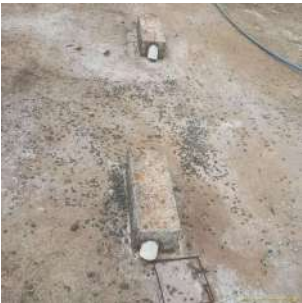
Foto 2 - Ausência de tela de proteção nos tubos de ventilação do reservatório 1.
