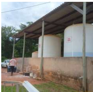
Foto 23 - Armazenamento de tanques de recebimento de produtos químicos.
