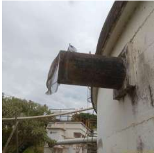
Foto 3 - Stiução de uma das telas de proteção.
