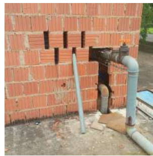
Foto 4 - Tubulações de sucção e recalque da EEAT.
