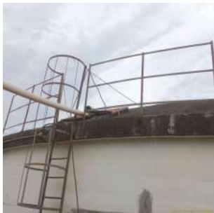
Foto 5 - Tampa de inspeção entreaberta.
