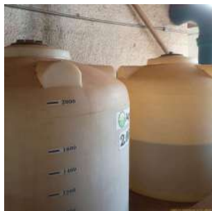
Foto 1 - Ausência de identificação dos produtos químicos armazenados nos tanques, incluindo detalhe sobre periculosidade.
