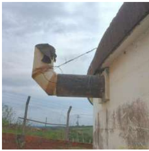
Foto 1 - Stiução de uma das telas de proteção.
