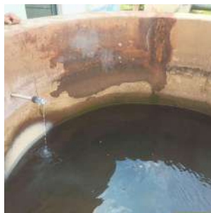
Foto 10 - Vista interna do tanque de floculação.
