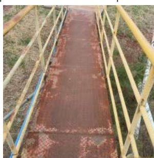
Foto 5 - Passarela oxidada, com risco de corrosão e acidentes.
