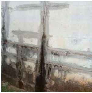
Foto 1 - Vazamento aparente na lateral do reservatório.
