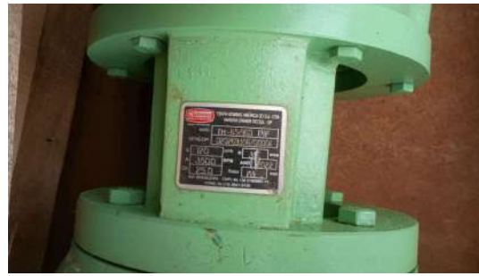
Foto 13 - Placa de especificações técnicas da bomba de um dos equipamentos reservas.
