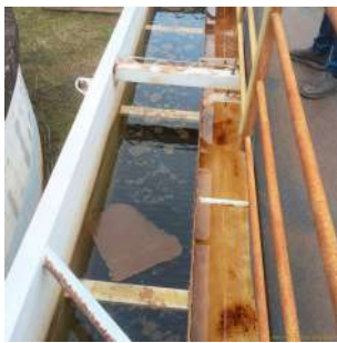
Foto 15 - Unidade de decantação da ETA.
