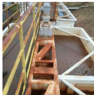
Foto 14 - Flocculadores e decantadores da ETA.
