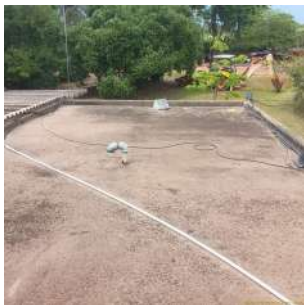
Foto 3 - Vista geral da laje do reservatório, sem guarda-corpo.
