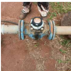
Foto 1 - Vazamento próximo ao macromedidor.
