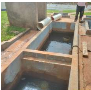
Foto 3 - Detalhe da tubulação em ferro que vai direto pro reservatório retangular, sem passar pelas
