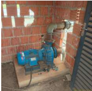
Foto 5 - Conjunto motobomba instalado na EEAT 1.
