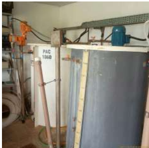
Foto 19 - Tanques de armazenamento de produtos químicos.
