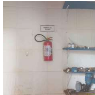
Foto 56 - Extintor de incêndio próximo às bombas dosadoras de produtos químicos.
