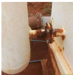
Foto 2 - Detalhe da estrutura oxidada.
