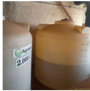
Foto 51 - Tanques de flúor.
