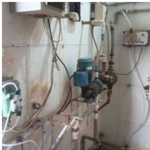
Foto 55 - Bombas dosadoras de produtos químicos.
