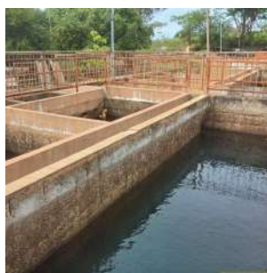
Foto 18 - Vista geral das unidades de decantação
