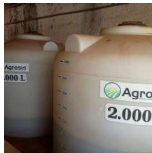
Foto 2 - Ausência de identificação dos produtos químicos armazenados nos tanques, incluindo detalhe sobre periculosidade.
