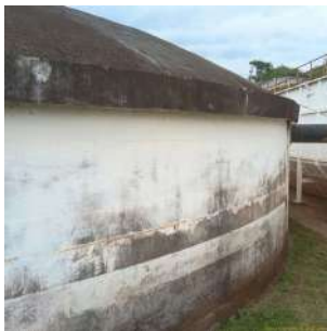
Foto 3 - Vazamento aparente na lateral do reservatório.
