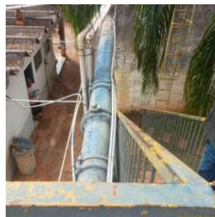
Foto 27 - Tubulação em ferro fundido que abastece o reservatório retangular com água bruta.
