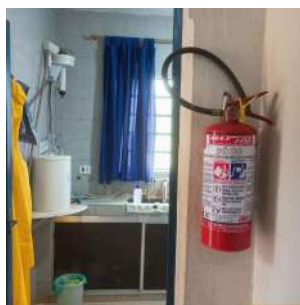
Foto 31 - Laboratório físico químico da ETA.
