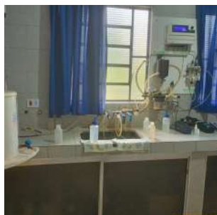
Foto 32 - Laboratório físico químico da ETA.
