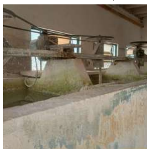
Foto 12 - Tanques de preparo de solução de cal.
