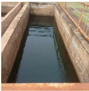
Foto 20 - Vista geral das unidades de decantação
