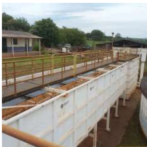
Foto 9 - Vista geral da ETA.
