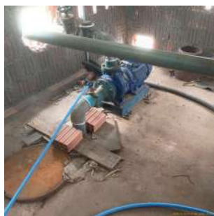
Foto 1 - Situação do piso no entorno da tubulação de sucção.
