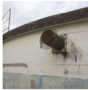
Foto 2 - Stiução de uma das telas de proteção.
