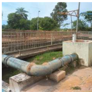
Foto 15 - Tubulações me ferro fundido da saída do tanque de distribuição e chegada na etapa de decantação da ETA.
