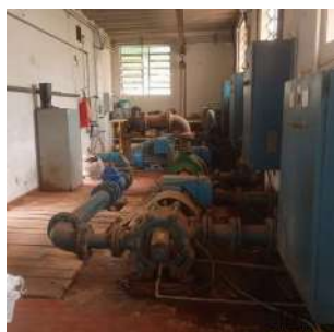
Foto 3 - Vista interna da casa de bombas.
