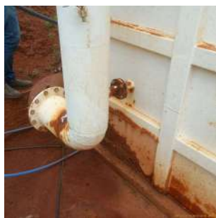
Foto 1 - Oxidação da estrutura na parte externa da ETA.
