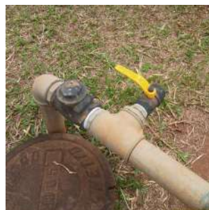
Foto 4 - Torneira para tomada de água bruta.
