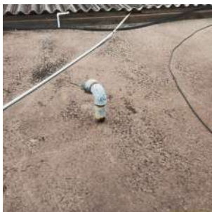
Foto 1 - Tubo de ventilação.
