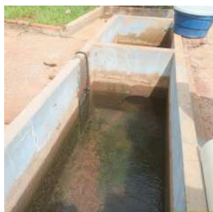
Foto 8 - À esquerda: comporta vedando parcialmente a derivação da água bruta que é direcionada para o processo completo de tratamento da ETA, sendo que a maior parte do volume afluyente tem sido direcionado direto para o reservatório retangular.
