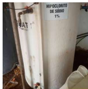
Foto 22 - Tanques de armazenamento de produtos químicos.
