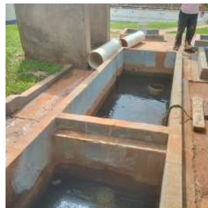
Foto 2 - Tubulação (cor azul) que direciona diretamente para o reservatório.
