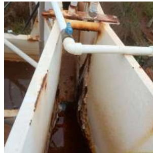
Foto 12 - Ponto de chegada da água bruta (captação não estava em operação no momento da visita).
