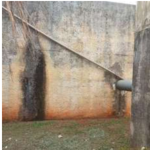
Foto 1 - Vazamentos na lateral do reservatório.
