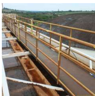
Foto 4 - Vista interna das estruturas, com sinais de oxidação e ausência de limpeza adequadas.
