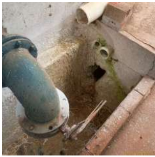
Foto 7 - Líquido oriundo do preparo de cal que escoia constantemente
