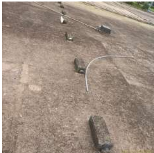
Foto 3 - Ausência de tela de proteção nos tubos de ventilação do reservatório 2.
