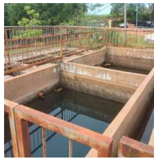
Foto 21 - Decantadores da ETA Convencional.
