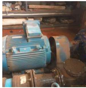
Foto 15 - Quarto conjunto motobomba.
