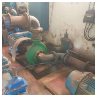
Foto 7 - Segundo conjunto motobomba.
