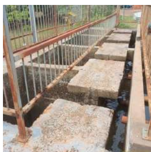
Foto 1 - Situação dos guarda-corpos.
