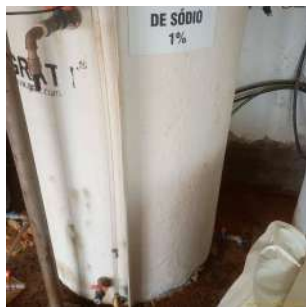
Foto 1 - Tanque de hipoclorito.
