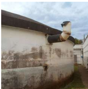
Foto 5 - Vazamento aparente na lateral do reservatório.
