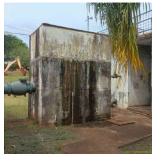
Foto 4 - Vazamentos no tanque de equalização (intermediário) entre filtros e reservatório retangular.
