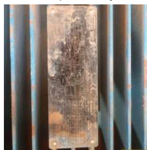
Foto 13 - Placa de especificações técnicas do motor do terceiro conjunto motobomba.
