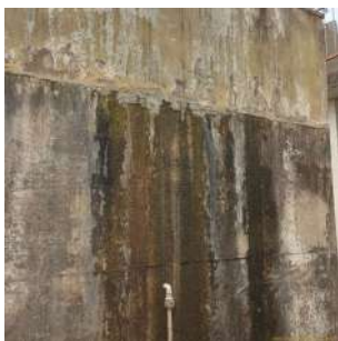
Foto 5 - Vazamentos no tanque de equalização (intermediário) entre filtros e reservatório retangular.
