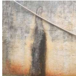
Foto 2 - Vazamentos na lateral do reservatório.
