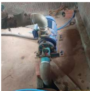
Foto 7 - Primeiro conjunto motobomba.
