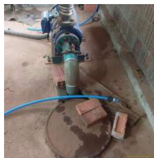
Foto 2 - Situação do piso no entorno da tubulação de sucção.
