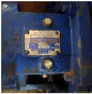
Foto 14 - Placa de especificações técnicas da bomba do terceiro conjunto motobomba.
