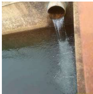
Foto 19 - Chegada da água na etapa de decantação. Detalhe para a baixa vazão, pois a maior parte da água bruta é direcionada para o reservatório retangular.
