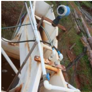
Foto 11 - Ponto de chegada da água bruta (captação não estava em operação no momento da visita).
