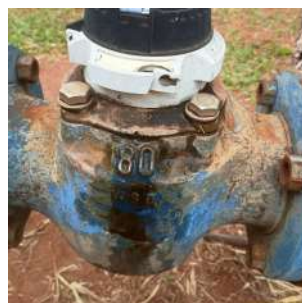
Foto 2 - Detalhe do vazamento.
