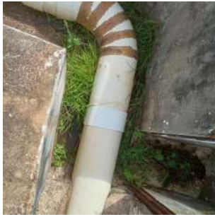
Foto 1 - Vazamento na junção da tubulação pós chegada.
