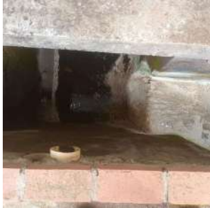
Foto 9 - Líquido oriundo do preparo de cal que escoia constantemente
