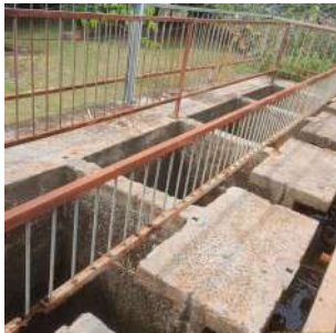
Foto 22 - Filtros da ETA Convencional.
