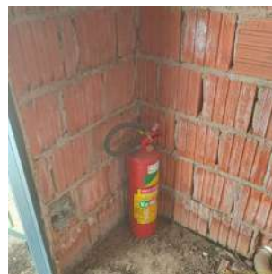
Foto 7 - Extintor de incêndio da EEAT.
