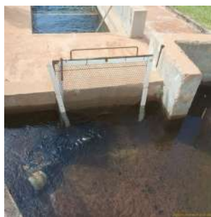
Foto 5 - Gradeamento improvisado entre trechos do canal de passagem da água bruta.
