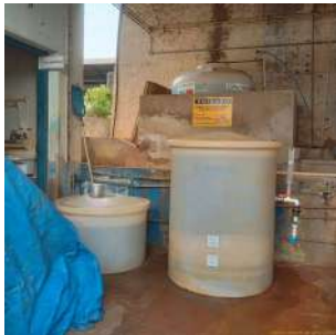
Foto 53 - Tanques de armazenamento de produtos químicos para geração de hipoclorito de sódio.
