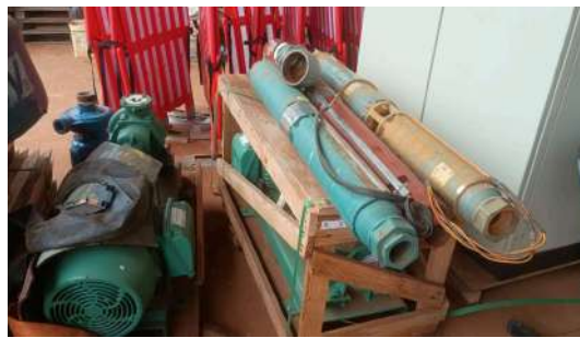
Foto 6 - Bomba reserva em estoque na ETA (cor verde).
