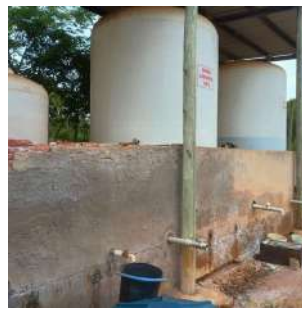
Foto 26 - Armazenamento de tanques de recebimento de produtos químicos.
