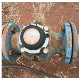
Foto 3 - Macromedidor do poço.
