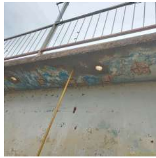
Foto 4 - Situação da alvenaria na parte inferior da passarela do entorno da ETA.
