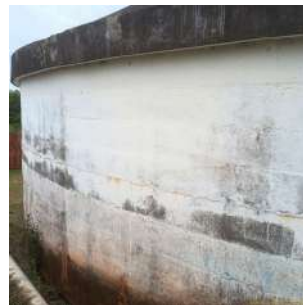
Foto 4 - Vazamento aparente na lateral do reservatório.
