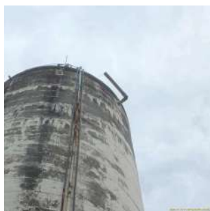
Foto 3 - Ausência de tela de proteção no tubo extravasor.
