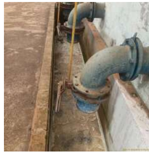
Foto 8 - Líquido oriundo do preparo de cal que escoia constantemente
