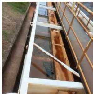
Foto 3 - Vista interna das estruturas, com sinais de oxidação e ausência de limpeza adequadas.
