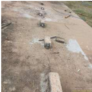
Foto 1 - Ausência de tela de proteção nos tubos de ventilação do reservatório 1.
