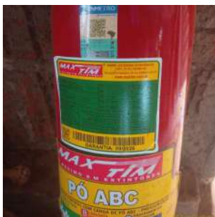
Foto 5 - Selo de validade do extintor de incêndios.
