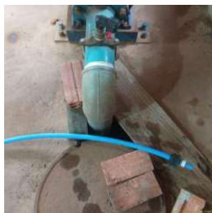
Foto 3 - Situação do piso no entorno da tubulação de sucção.
