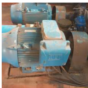
Foto 12 - Terceiro conjunto motobomba.
