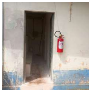
Foto 13 - Extintor de incêndio do prédio de armazenamento e preparo de cal.
