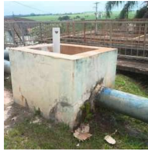
Foto 2 - Vazamentos no tanque de distribuição pré decantadores.
