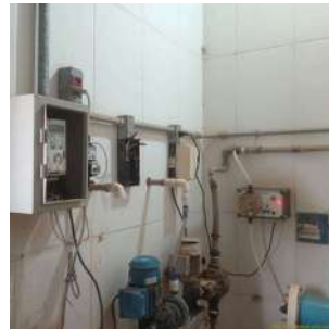
Foto 54 - Bombas dosadoras de produtos químicos.
