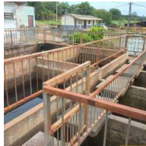
Foto 23 - Decantadores e filtros da ETA Convencional.
