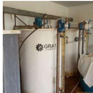
Foto 20 - Tanques de armazenamento de produtos químicos.
