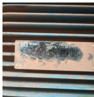
Foto 6 - Placa de especificações técnicas da bomba do primeiro conjunto motobomba.
