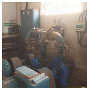
Foto 11 - Terceiro e quarto conjuntos motobomba.
