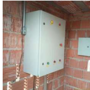
Foto 6 - Painel elétrico e de comando da EEAT.
