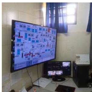
Foto 44 - Sala do sistema de telemetria dos reservatórios de Brotas.
