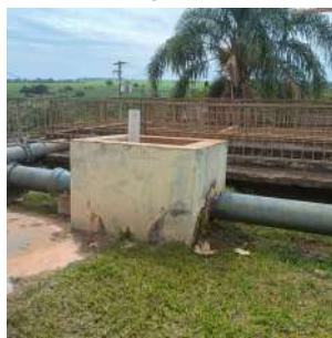
Foto 16 - Tubulações me ferro fundido da saída do tanque de distribuição e chegada na etapa de decantação da ETA.
