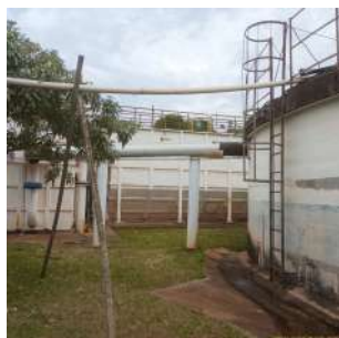
Foto 1 - Vista geral da ETA Compacta.
