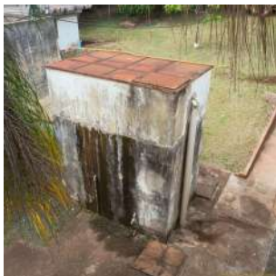
Foto 24 - Tanque intermediário (equalização) entre os filtros e o reservatório de água tratada.
