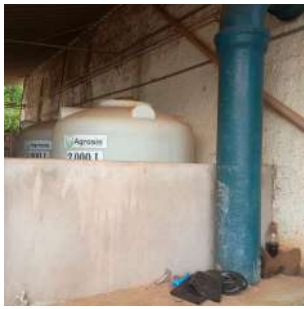
Foto 50 - Baías e tanques de armazenamento de produtos químicos.
