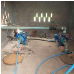
Foto 3 - Vista interna da casa de bombas.
