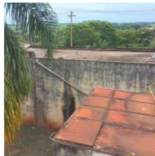
Foto 25 - Vista do tanque intermediário e o reservatório retangular.
