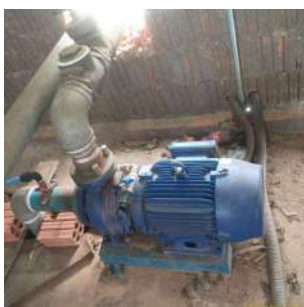
Foto 9 - Segundo conjunto motobomba.
