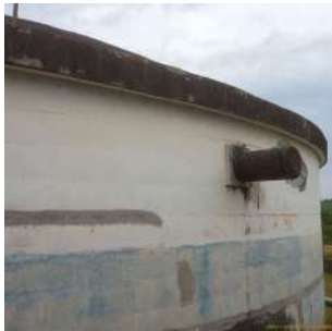
Foto 4 - Tela de proteção no tubo extravasor, porém de maneira inadequada.
