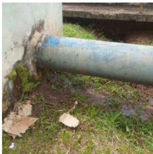
Foto 3 - Vazamentos no tanque de distribuição pré decantadores.
