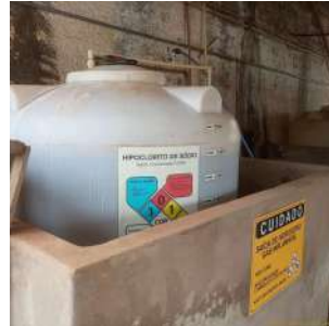
Foto 52 - Tanque de hipoclorito de sódio.
