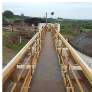
Foto 10 - Vista geral da ETA.
