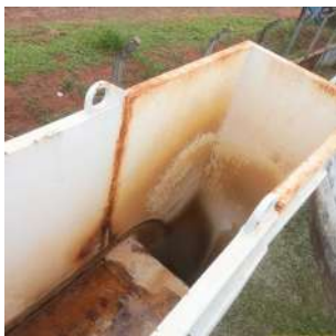
Foto 13 - Ponto de chegada da água bruta (captação não estava em operação no momento da visita).
