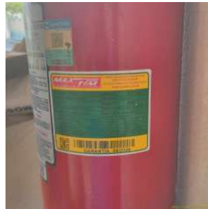
Foto 18 - Validade do extintor de incêndios da EEAT.
