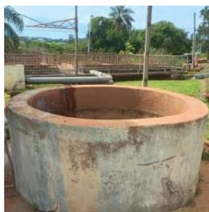
Foto 9 - Tanque de dosagem de cal e floculação.
