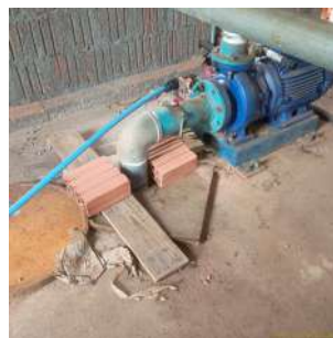
Foto 4 - Situação do piso no entorno da tubulação de sucção.
