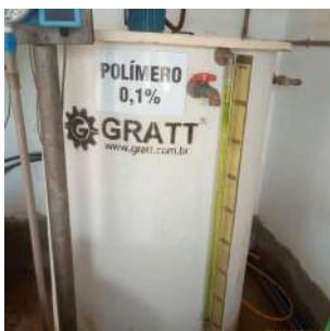
Foto 21 - Tanques de armazenamento de produtos químicos.
