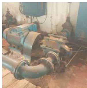
Foto 4 - Primeiro conjunto motobomba da EEAT.
