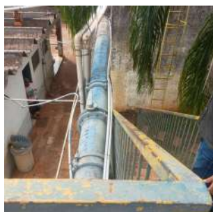
Foto 3 - Tubulação (cor azul) que direciona diretamente para o reservatório.
