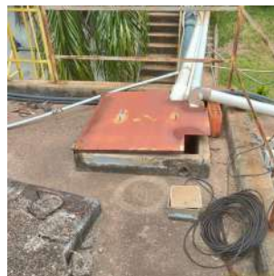
Foto 2 - Situação da tampa de inspeção.
