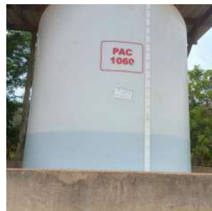
Foto 24 - Armazenamento de tanques de recebimento de produtos químicos.
