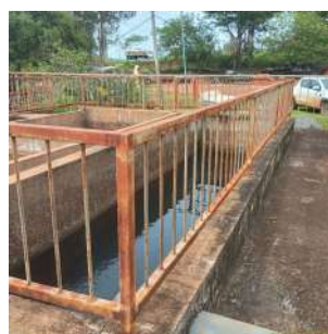
Foto 2 - Situação dos guarda-corpos.
