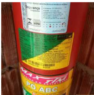
Foto 8 - Selo de validade do extintor.
