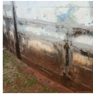
Foto 2 - Vazamento aparente na lateral do reservatório.
