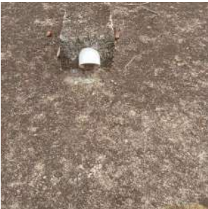
Foto 4 - Ausência de tela de proteção nos tubos de ventilação do reservatório 2.
