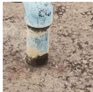
Foto 2 - Detalhe do ponto corroído do tubo de ventilação.
