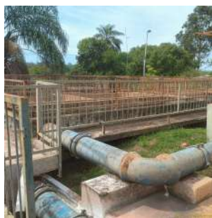
Foto 14 - Tubulações me ferro fundido da saída do tanque de distribuição e chegada na etapa de decantação da ETA.
