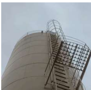
Foto 12 - Escada e guarda-corpo do reservatório.
