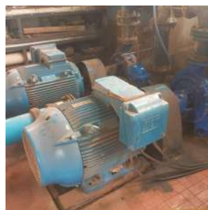
Foto 10 - Terceiro e quarto conjuntos motobomba.
