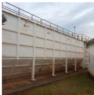
Foto 2 - Vista geral da ETA Compacta.
