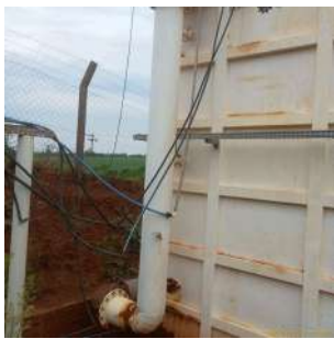
Foto 5 - Tubulação de chegada da água bruta.
