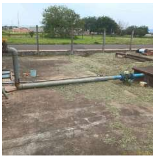
Foto 3 - Tubulação de recalque da EEAT.
