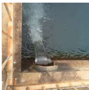
Foto 17 - Chegada da água na etapa de decantação. Detalhe para a baixa vazão, pois a maior parte da água bruta é direcionada para o reservatório retangular.
