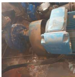
Foto 6 - Vazamento excessivo próximo à gaxeta do conjunto 4.
