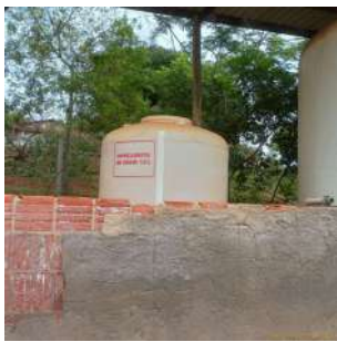
Foto 25 - Armazenamento de tanques de recebimento de produtos químicos.
