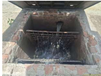
Foto 4 - Chegada de esgoto bruto e gradeamento.
