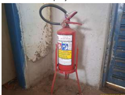
Foto 9 - Extintor de Incêndio no interior da casa de bombas da captação I.
