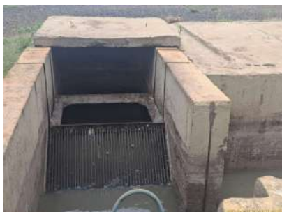
Foto 5 - Gradeamento grosso na chegada do esgoto bruto.
