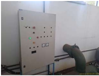
Foto 6 - PAINEL DE COMANDO DA UNIDADE.
