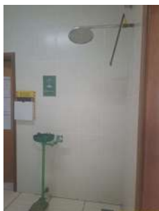
Foto 19 - Chuveiro de emergência e lava olhos no laboratório da unidade.
