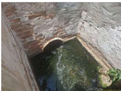
Foto 13 - Saída esgoto tratado.
