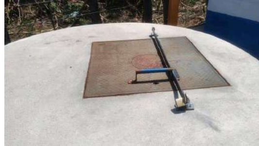
Foto 4 - Registro fotográfico enviado pelo prestador, antes da conclusão do relatório de fiscalização, evidenciando instalação de trava e cadeado no acesso ao poço de sucção.
