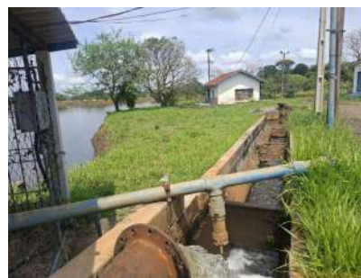
Foto 4 - Tomada de água para a casa de bombas da captação I.
