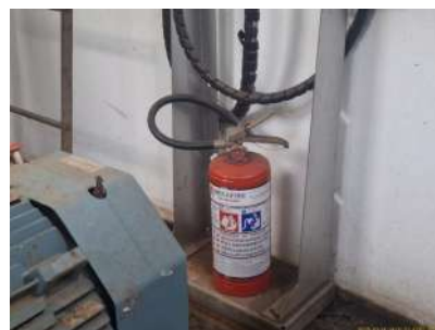
Foto 5 - Extintor de incêndio com pressão e validade adequadas, disponível na unidade.
