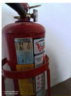
Foto 6 - Extintor de incêndio com pressão e validade adequadas, disponível na unidade.
