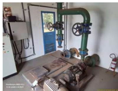
Foto 4 - Conjunto motobomba da unidade.
