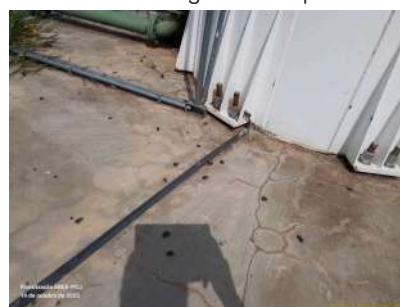
Foto 5 - Detalhe do aterramento do reservatório.
