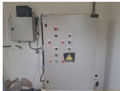
Foto 6 - Painel de comando da unidade.
