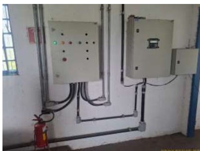
Foto 13 - Painel de comando na casa de bombas na captação II.
