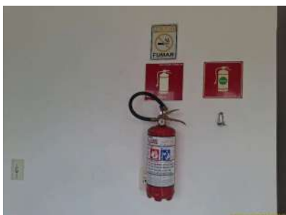
Foto 15 - Extintor de incêndio no laboratório da ETE.
