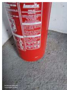
Foto 7 - Extintor com pressão e validade adequadas, disponível na unidade.
