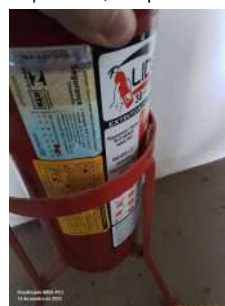
Foto 7 - EExtintor de incêndio com pressão e validade adequadas, disponível na unidade.
