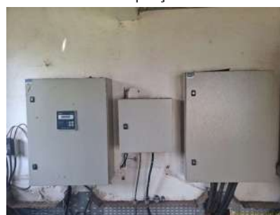
Foto 10 - Painel de comando na casa de bombas na captação I.
