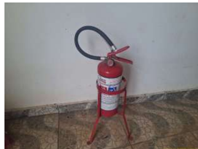
Foto 7 - Extintor de incêndio disponível na unidade.
