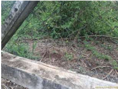
Foto 1 - Abertura no alambrado que cerca a área, evidenciada durante a fiscalização.
