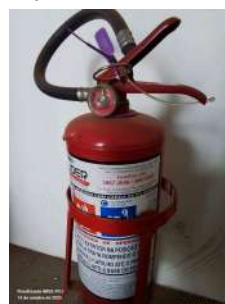
Foto 5 - Extintor de incêndio com pressão e validade adequadas, disponível na unidade.
