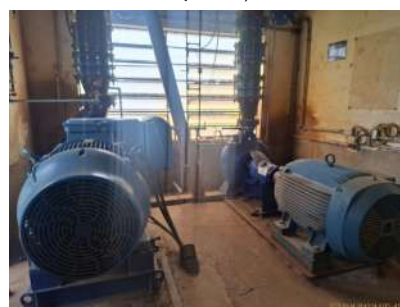
Foto 8 - Conjuntos motobomba principal e reserva na captação I.
