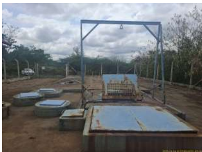
Foto 5 - Vista da área interna da estação elevatória, evidenciando trave para suporte de talha quando da manutenção.
