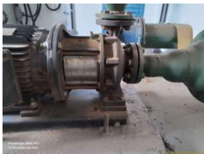
Foto 10 - Detalhe da interface motor bomba em funcionamento.
