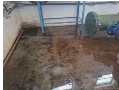
Foto 2 - Acúmulo de água no piso da unidade.
