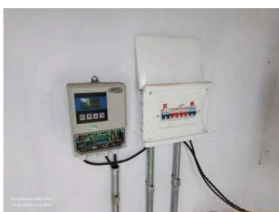
Foto 8 - Equipamento para medição de nível (telemetria).
