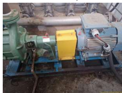
Foto 4 - Detalhe conjunto motobomba da EEA.
