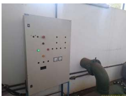
Foto 3 - Painel de comando da unidade.
