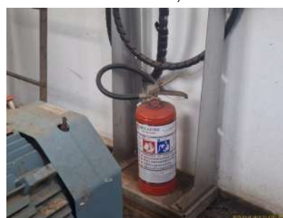
Foto 4 - Extintor de incêndio com pressão e validade adequadas, disponível na unidade.
