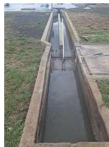
Foto 6 - Gradeamento fino e desarenador antes da lagoa de estabilização.
