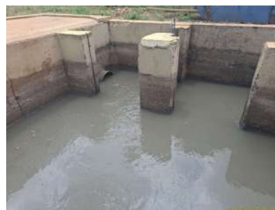
Foto 4 - Chegada esgoto bruto.
