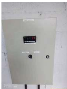
Foto 7 - Painel de telemetria do nível do reservatório.
