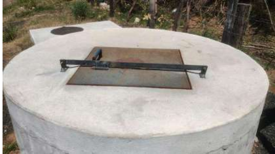
Foto 3 - Registro fotográfico enviado pelo prestador, antes da conclusão do relatório de fiscalização, evidenciando instalação de trava e cadeado no acesso ao poço de sucção.
