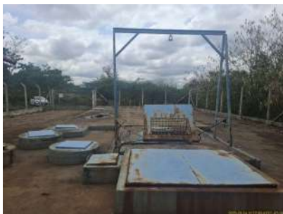
Foto 1 - As três tampas à esquerda exibem pintura recente. As outras tampas e a estrutura metálica apresentam corrosão.
