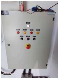
Foto 3 - Painel de controle e telemetria da EEE.
