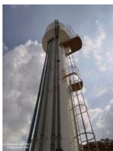
Foto 6 - À direita, tubos de alimentação e à esquerda tubos de saída de água do reservatório.
