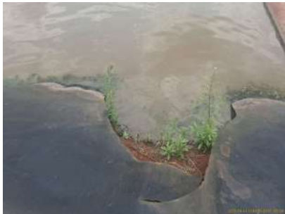
Foto 1 - Rompimento da manta de impermeabilização em uma das lagoas da unidade.
