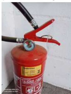
Foto 6 - Extintor com pressão e validade adequadas, disponível na unidade.
