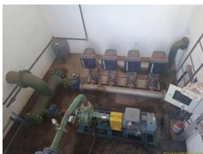
Foto 3 - Vista interna da unidade (conjunto motobomba da EEA na parte inferior).
