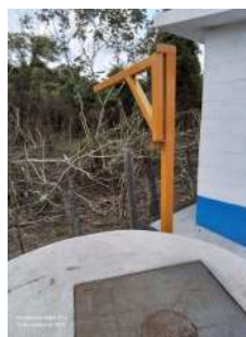
Foto 5 - Vista da parte externa do poço de sucção da EEE. Detalhe evidencia braço para içamento de bombas em ocorrências de manutenção.
