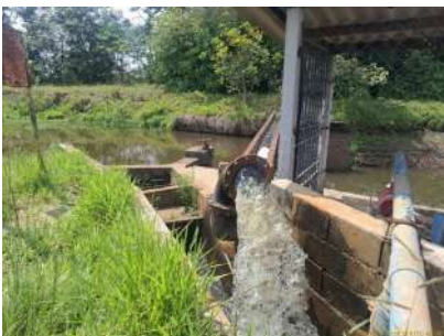
Foto 2 - Chegada da água bruta vinda da captação São Valentim, usada em complementação a captação da unidade fiscalizada.
