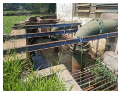
Foto 6 - Ponto de sucção da água bruta na captação I (água tomada do córrego que chega na represa).
