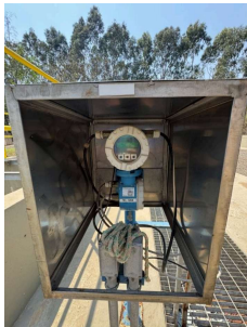
Foto 21 - Macromedidor de saída
