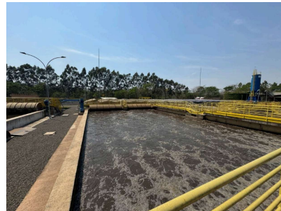
Foto 12 - Vista do tanque de aeração
