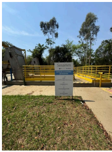
Foto 5 - Elevatória de Esgoto
