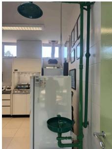
Foto 29 - Chuveiro de emergência
