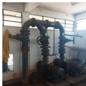
Foto 4 - Vista geral da elevatória.
