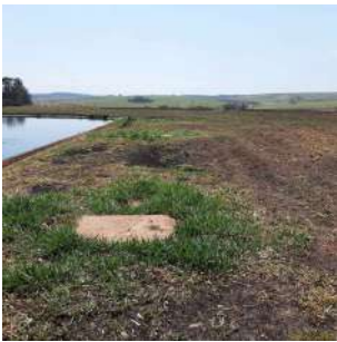
Foto 1 - Tampas de proteção das tubulações que conduzem o esgoto bruto para a primeira lagoa.
