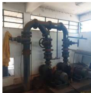
Foto 4 - Vista geral da elevatória.
