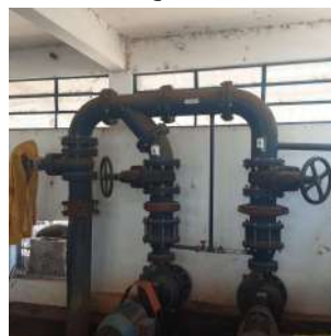
Foto 5 - Vista geral da elevatória.
