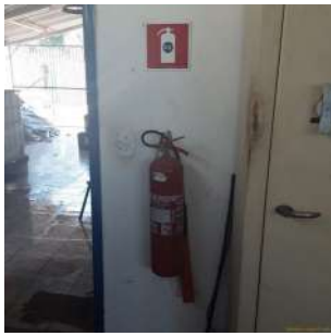
Foto 8 - Extintor de incêndio instalado na sala das elevatórias, próximo ao painel elétrico.
