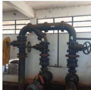
Foto 5 - Vista geral da elevatória.
