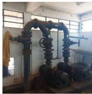
Foto 4 - Vista geral da elevatória.
