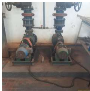
Foto 6 - Há dois conjuntos moto-bomba instalados, um em funcionamento e o segundo como reserva.
