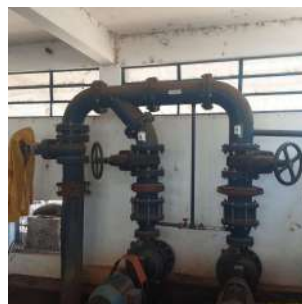
Foto 5 - Vista geral da elevatória.
