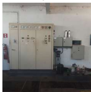
Foto 7 - Painéis elétricos instalados no interior da edificação.
