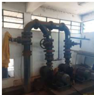
Foto 4 - Vista geral da elevatória.
