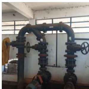
Foto 5 - Vista geral da elevatória.
