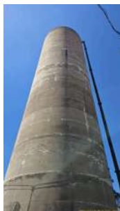
Foto 1 - Vazamento na lateral do reservatório
