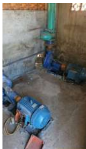
Foto 1 - Conjunto de bombas da elevatória
