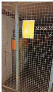
Foto 21 - Cilindros de cloro gás
