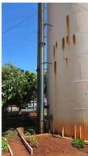
Foto 5 - Tubulações de alimentação
