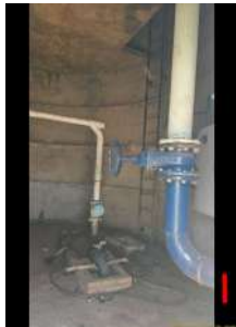
Foto 3 - Parte interna da estrutura (não há utilização de bomba, é por gravidade)
