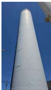
Foto 5 - Reservatório Campo Verde
