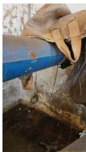
Foto 1 - Vazamento antigo na casa de bombas
