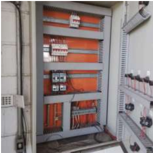
Foto 3 - Parte interna do paineleletrico
