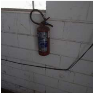
Foto 4 - Extintor de incêndio disponível no local
