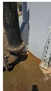
Foto 2 - Vazamentos na base do reservatório
