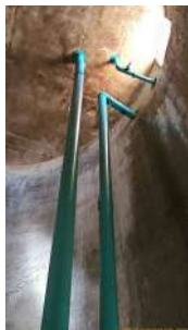
Foto 3 - Vazamento na tubulação dentro da estrutura do reservatório
