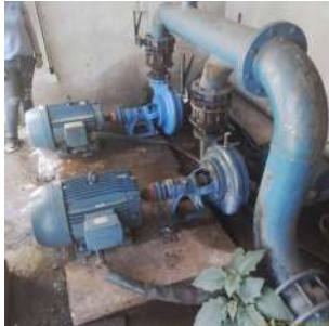
Foto 3 - Conjunto de bombeamento
