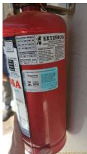
Foto 1 - Extintor de incêndio (validade nov/25)
