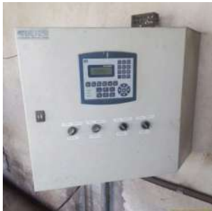
Foto 7 - Painel de comando
