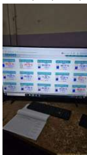
Foto 14 - Painel de controle de nível da ETA e dos reservatórios
