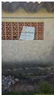
Foto 1 - Placa de identificação degradada
