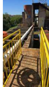
Foto 2 - Ausência de guarda-corpo nos decantadores
