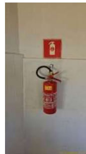
Foto 13 - Extintor de incêndio disponível
