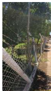
Foto 2 - Alambrado danificado no cercamento do reservatório
