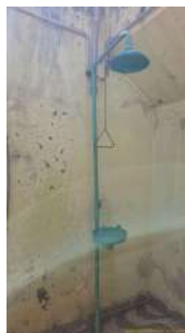
Foto 2 - Chuveiro de emergência
