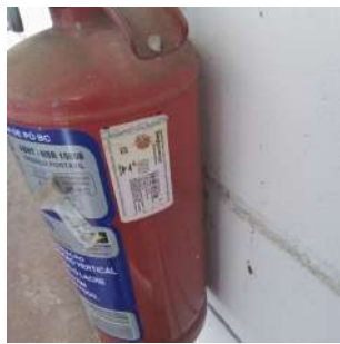
Foto 5 - Detalhe das informações do extintor
