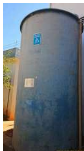
Foto 9 - Tanque de Policloreto de Alumínio
