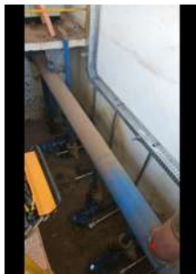
Foto 25 - Bombas de água bruta
