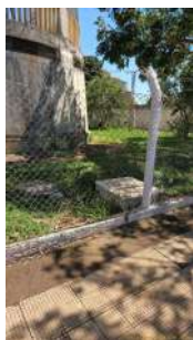
Foto 1 - Alambrado danificado no cercamento do reservatório
