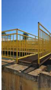
Foto 1 - Ausência de guarda-corpo nos decantadores
