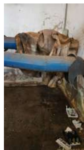
Foto 2 - Vazamento antigo na casa de bombas
