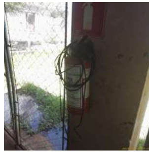
Foto 2 - Extintor disponível na unidade
