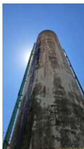
Foto 1 - Vazamento na lateral do reservatório
