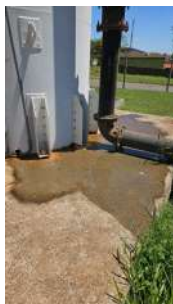
Foto 1 - Vazamentos na base do reservatório
