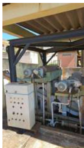
Foto 23 - Bombas de secagem do lodo
