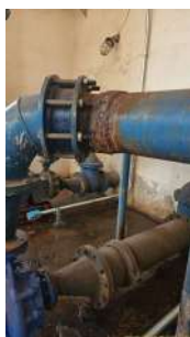
Foto 3 - vazamento na tubulação na casa de bombas (bomba 4)
