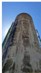
Foto 2 - Vazamento na lateral do reservatório
