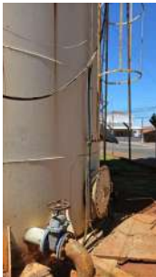
Foto 2 - Destaque para a tubulação
