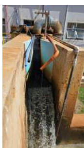
Foto 17 - Entrada da água e aplicação de coagulante (PAC)
