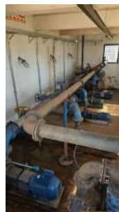
Foto 24 - Casa de bombas
