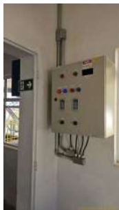
Foto 12 - Destaque para painel elétrico
