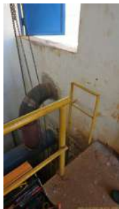
Foto 3 - Ausência de guarda-corpo na casa de bombas de água bruta
