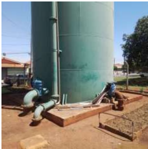
Foto 2 - Base do reservatório
