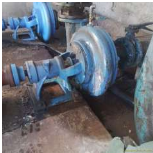
Foto 1 - Vazamento na bomba da elevatória
