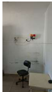
Foto 26 - Alarme para indicar acidentes com Cloro Gás
