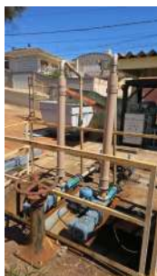
Foto 1 - No dia da fiscalização, sistema do lodo estava inoperante devido à manutenção
