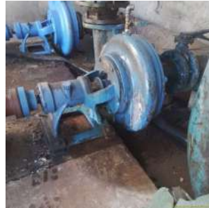
Foto 4 - Conjunto de bombeamento
