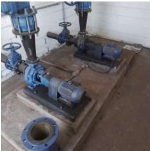
Foto 1 - Conjunto de bombas da elevatória
