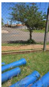
Foto 1 - Alambrado danificado no cercamento
