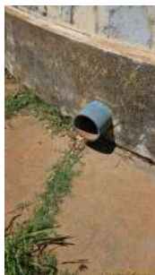
Foto 1 - Ausência de tela de proteção
