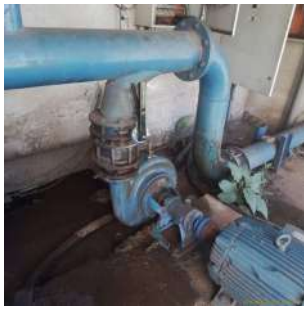
Foto 1 - Destaque para a bomba da elevatória
