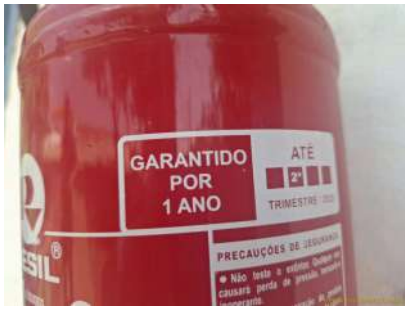
Foto 6 - Validade do extintor de incendio
