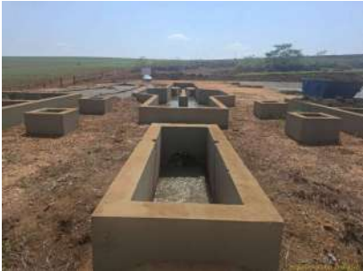
Foto 2 - Vista do tratamento preliminar
