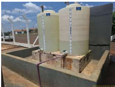
Foto 9 - Armazenamento de hipoclorito de sódio
