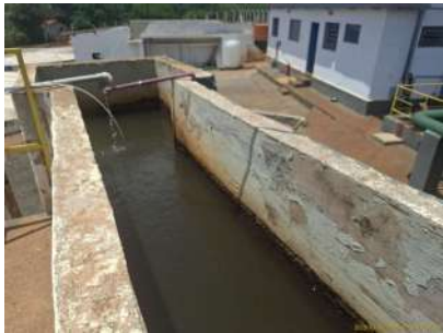
Foto 2 - Chegada da água bruta e dosagem de produto químico
