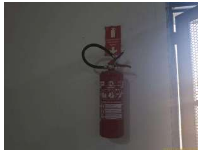
Foto 6 - Extintor de incêndio
