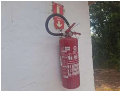
Foto 5 - Extintor de incêndio
