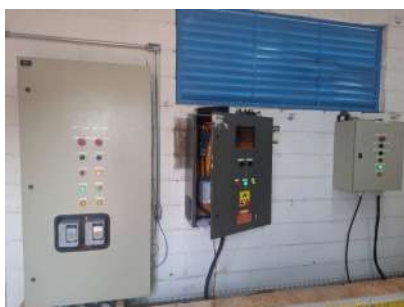
Foto 3 - Paineis de comando e controle
