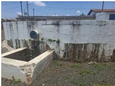
Foto 1 - Marcas de infiltrações na parede do reservatório
