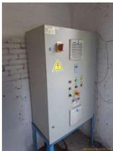
Foto 4 - Painel de comando e controle
