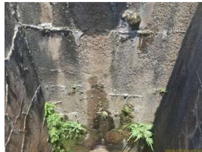
Foto 2 - Marcas de infiltrações na parede do reservatório
