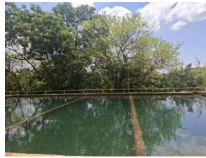
Foto 6 - Vista lateral dos decantadores
