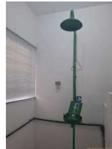
Foto 12 - Chuveiro de emergência
