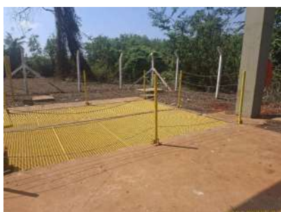
Foto 5 - Poço de sucção
