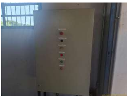
Foto 5 - Painel de comando e controle
