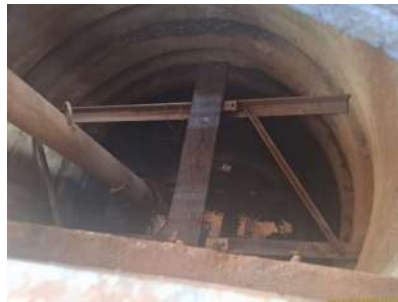
Foto 4 - Poço de sucção
