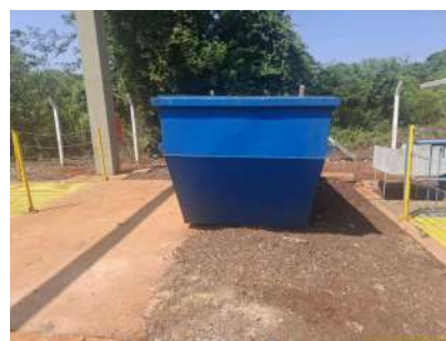
Foto 4 - Caçamba para armazenamento de resíduos do gradeamento
