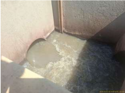
Foto 1 - Chegada de esgoto bruto
