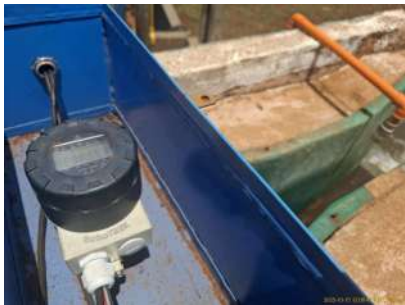
Foto 3 - Medidor de vazão de entrada
