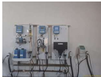
Foto 4 - Medidores online da água tratada
