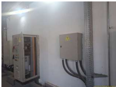
Foto 5 - Paineis de comando e controle
