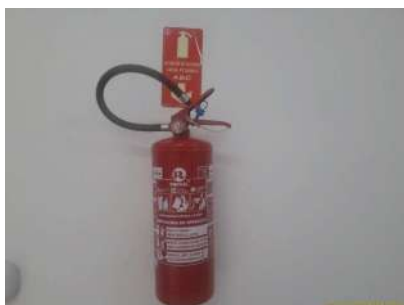
Foto 15 - Extintor de incêndio
