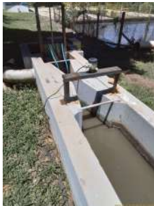
Foto 3 - Calha Parshall e sensor para medição do volume de entrada de esgoto bruto.
