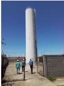
Foto 1 - Vista da área em que o reservatório está instalado.
