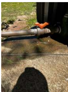
Foto 1 - Vazamento observado na tubulação próxima à motobomba.
