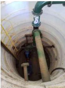
Foto 3 - Bomba de captação.
