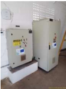
Foto 1 - Painel de controle do ponto de captação
