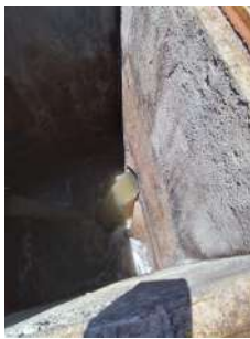
Foto 11 - Saída de esgoto tratado.
