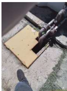
Foto 1 - Entrada de esgoto bruto.
