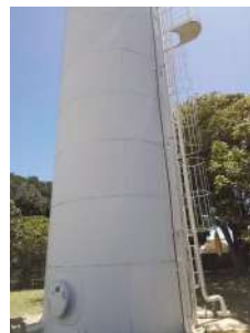
Foto 7 - Escada de acesso ao topo do reservatório e fiação do para-raios.
