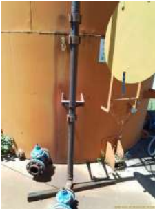
Foto 1 - Tubo de entrada de água com avançado estado de oxidação.
