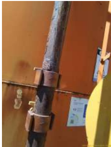
Foto 2 - Tubo de entrada de água, com destaque para a região das braçadeiras de fixação.
