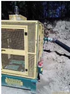
Foto 9 - Gerador de energia para captação alternativa.
