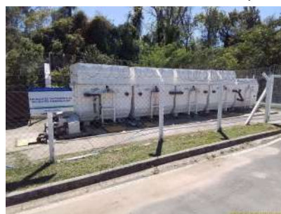
Foto 7 - Vista geral da ETE compacta.
