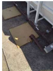
Foto 4 - Passagem do lodo.
