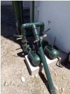
Foto 1 - Conjunto de moto bomba.
