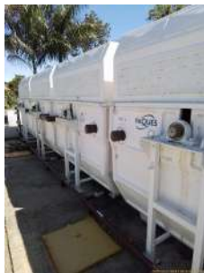
Foto 3 - Tanques de rotação (para aeração) e decantação.
