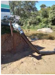
Foto 5 - Tubulação de captação alternativo.
