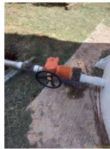
Foto 4 - Tubulação de entrada/saída de água.
