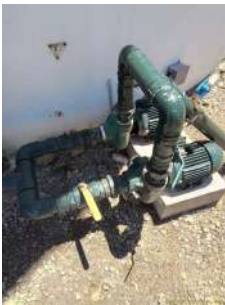
Foto 3 - Vista das linhas de tubulação direcionadas para as motobombas.
