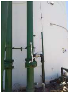
Foto 4 - Tubulações de saída do reservatório conectadas às bombas para manutenção da pressão na rede.
