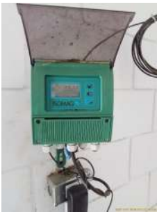
Foto 2 - Medidor de vazão da captação.
