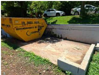
Foto 1 - Vista geral da estrutura com sinais de deterioração.
