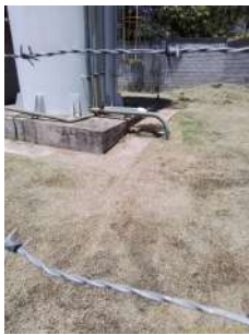
Foto 4 - Tubo extravasor com a extremidade final direcionada para um ralo, para a liberação do excesso de água.
