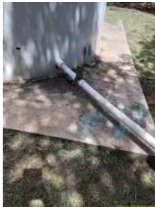
Foto 5 - Tubo de saída para condução da água até a rede de distribuição.
