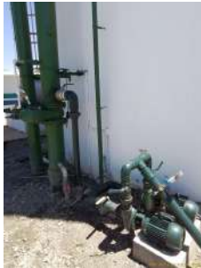
Foto 2 - Vista geral das tubulações.
