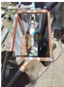
Foto 1 - Motobomba em operação.
