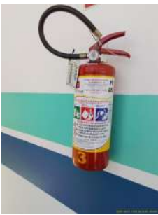
Foto 6 - Extintor de incêndio.
