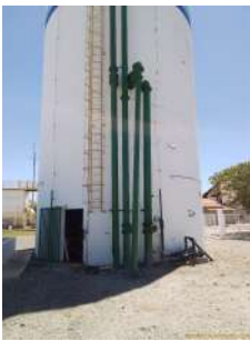
Foto 5 - Vista Geral do Booster.
