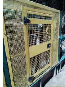
Foto 8 - Gerador de energia para captação alternativa.
