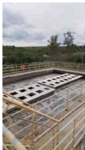
Foto 22 - Visão dos reatores
