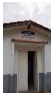
Foto 2 - Entrada da casa de bombas e identificação
