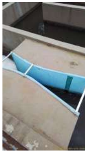
Foto 1 - Calha parshall na saída
