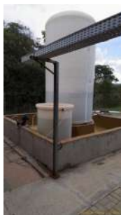
Foto 1 - Dique de contenção no armazenamento de hipoclorito de sódio
