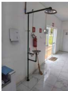
Foto 30 - Chuveiro de emergência
