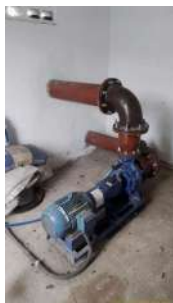
Foto 32 - Bomba de recirculação da lagoa
