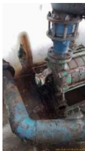
Foto 1 - É necessário realizar ajustes nos equipamentos para conter o vazamento.
