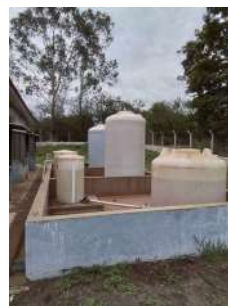
Foto 12 - Diques de contenção dos produtos químicos
