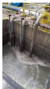
Foto 4 - Sucção das bombas no tratamento preliminar
