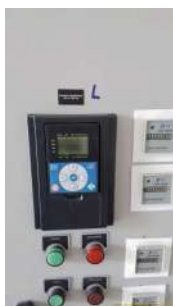
Foto 14 - Identificação da bomba no painel
