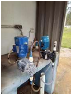
Foto 19 - Bombas para dosagem de produtos químicos
