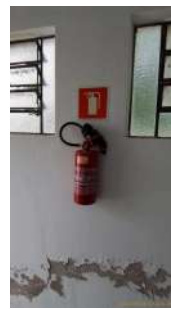
Foto 4 - Extintor de incêndio
