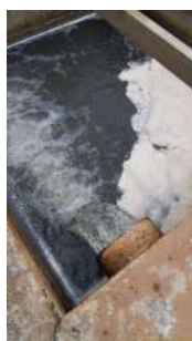
Foto 1 - Entrada de água bruta
