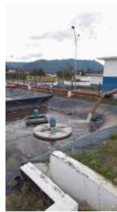
Foto 16 - Tubulação de recirculação
