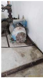
Foto 1 - Canaletas para drenar água de lubrificação das gaxetas
