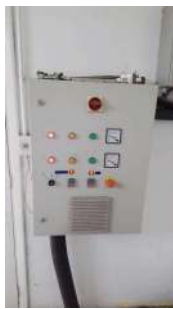
Foto 3 - Painel de comando das bombas
