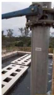
Foto 20 - Identificação de tubulação do difusores
