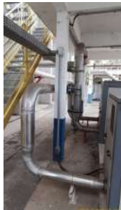
Foto 28 - Tubulações dos sopradores
