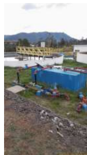
Foto 20 - Bombas de recirculação
