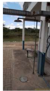
Foto 2 - Chuveiro próximo ao hipoclorito de sódio.
