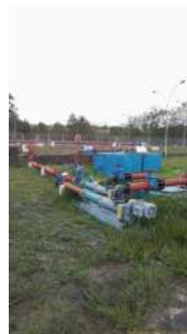
Foto 31 - Bombas para recirculação
