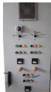
Foto 15 - Painel de comando
