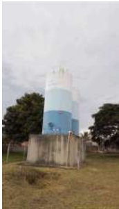
Foto 3 - Reservatórios apoiados sobre base elevada.
