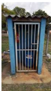
Foto 7 - Abrigo para o flúor.
