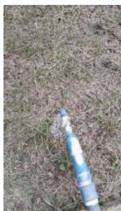
Foto 9 - Torneira para coleta de água bruta.
