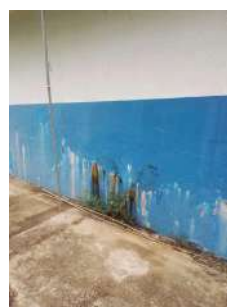
Foto 2 - Vazamentos provenientes de infiltrações.
