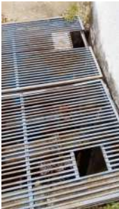
Foto 4 - Tubulação de saída. A água acumulada era proveniente de tubulação de drenagem de casa de bombas.
