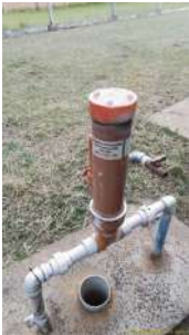
Foto 2 - Clorador por pastilhas.
