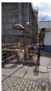
Foto 1 - Elevatória para bombeamento do efluente aos reatores, após tratamento preliminar
