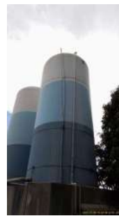
Foto 6 - Alimentação e extravasor.
