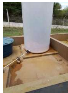
Foto 18 - Armazenamento de PAC
