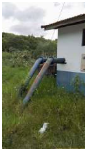
Foto 9 - Tubulação de recalque
