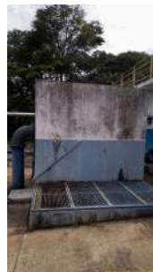
Foto 10 - Tanque onde há aplicação de flúor e cloro
