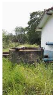
Foto 10 - Poço de sucção
