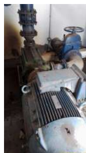
Foto 4 - Conjunto motobomba da elevatória
