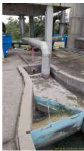
Foto 8 - Entrada do efluente na caixa de areia, após passar pelo peneiramento.
