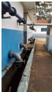
Foto 9 - Tubulações para limpeza dos filtros
