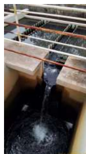
Foto 4 - Saída dos decantadores
