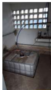
Foto 28 - Dosagem de produtos químicos
