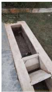
Foto 5 - Entrada do efluente
