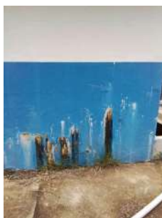
Foto 3 - Vazamentos provenientes de infiltrações.
