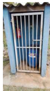
Foto 8 - Abrigo para o flúor.
