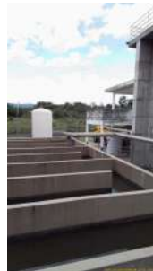
Foto 32 - Entrada do efluente no tanque de contato, após saída dos reatores.
