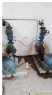
Foto 4 - Bombas da captação
