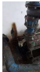
Foto 2 - Local do vazamento
