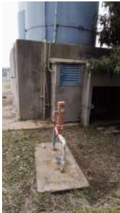
Foto 1 - Clorador por pastilhas.
