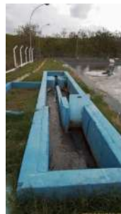
Foto 8 - Caixa de areia e calha parshall.
