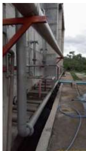
Foto 30 - Tubulações de saída dos reatores e para controle do lodo.
