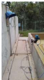
Foto 2 - Dosagem de hipoclorito de sódio no tanque de contato
