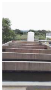
Foto 31 - Tanque de contato para desinfecção
