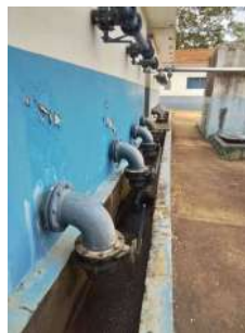
Foto 33 - Tubulações para limpeza dos filtros
