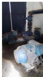
Foto 2 - Bombas da elevatória
