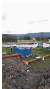
Foto 18 - Visão geral dos decantadores
