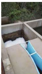
Foto 33 - Calha parshall na saída do tanque de contato
