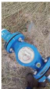
Foto 3 - Medidor de vazão.
