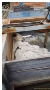
Foto 8 - Entrada de água bruta
