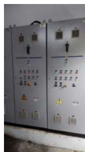
Foto 5 - Paine de comando das bombas
