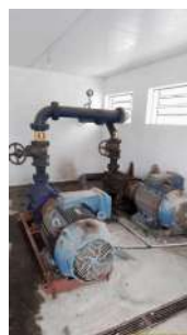
Foto 2 - Bombas da elevatória
