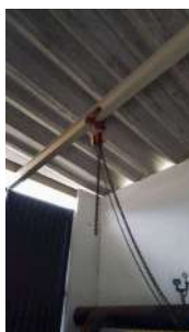
Foto 3 - Ponte rolante para içamento de equipamentos
