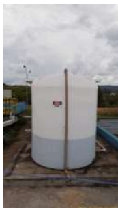
Foto 29 - Armazenamento de PAC no decantador químicos
