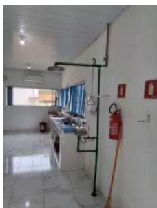
Foto 24 - Laboratório e chuveiro de emergência
