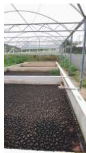
Foto 2 - Estufas para secagem de lodo químico.
