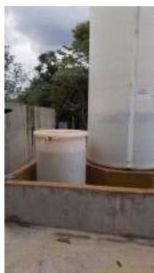
Foto 3 - Armazenamento de hipoclorito de sódio
