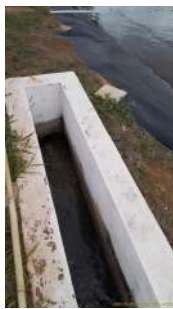
Foto 15 - Entrada de efluente na lagoa
