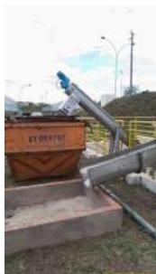
Foto 13 - Caçamba para remoção de detritos da peneira
