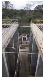
Foto 23 - Visão da calha parshall na saída a partir dos reatores
