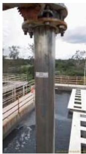
Foto 26 - Identificação em tubulação
