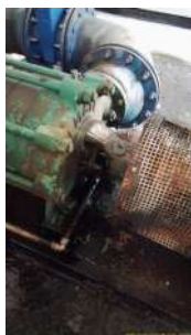
Foto 1 - Realizar ajustes para conter o vazamento
