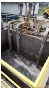
Foto 11 - Sucção das bombas para encaminhar o efluente para os reatores
