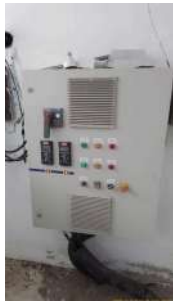
Foto 5 - Pannel de comando das bombas
