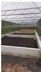
Foto 1 - Estufas para secagem de lodo químico, proveniente do decantador químico.
