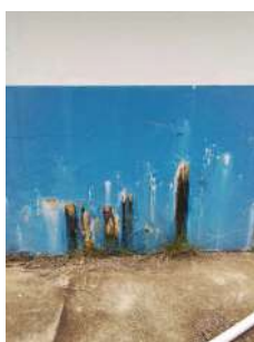
Foto 1 - Vazamentos provenientes de infiltrações.
