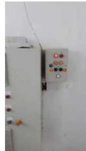
Foto 6 - Pannel das bombas
