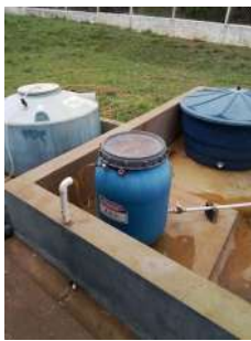
Foto 17 - Armazenamento e dosagem de PAC
