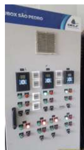
Foto 13 - Painéis de comando das bombas.
