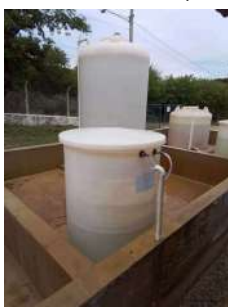
Foto 15 - Armazenamento de hipoclorito de sódio
