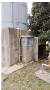
Foto 5 - Alimentação do reservatório a partir do poço.
