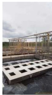
Foto 27 - Visão geral dos reatores
