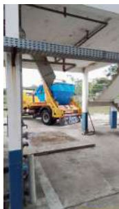
Foto 3 - Saída do lodo após passar pela centrífuga.
