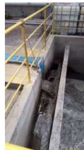
Foto 10 - Saída da caixa de areia, após passagem pela calha parshall
