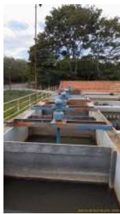
Foto 7 - Misturadores mecânicos dos floculadores
