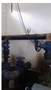
Foto 6 - Tubulação de recalque das bombas
