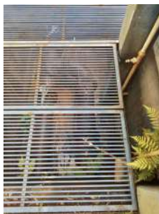
Foto 32 - Tubulação na qual ocorre pré cloração
