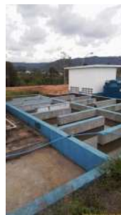
Foto 30 - Tanque de contato
