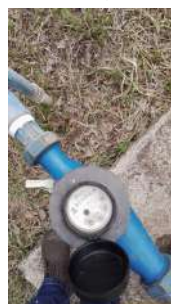
Foto 8 - Medidor de vazão.
