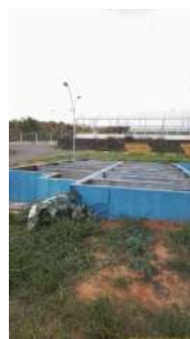
Foto 24 - Tanque de contato
