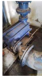
Foto 2 - Tubulação de drenagem
