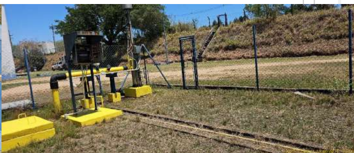
Foto 34 - Queimadores de gás metano produzidos nos reatores UASB
