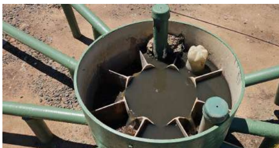
Foto 5 - Tubulação entupida (reator 3)
