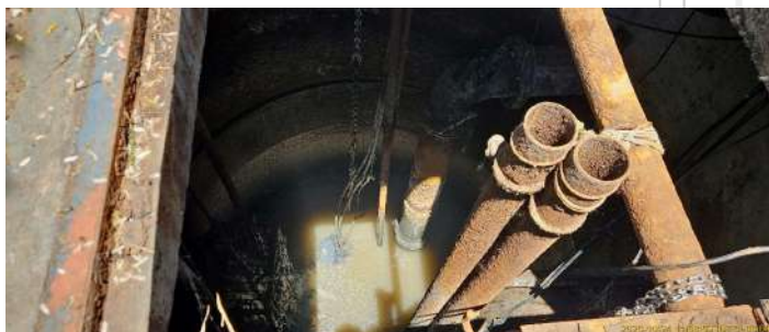
Foto 3 - Chegada do esgoto
