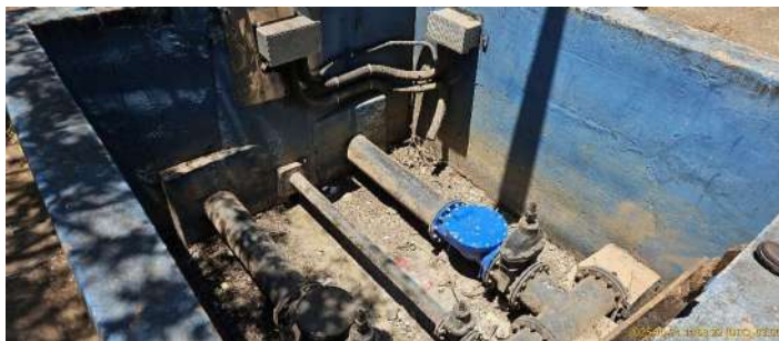
Foto 2 - Destaque para a tubulação
