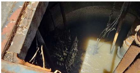
Foto 4 - Chegada do esgoto e gradeamento
