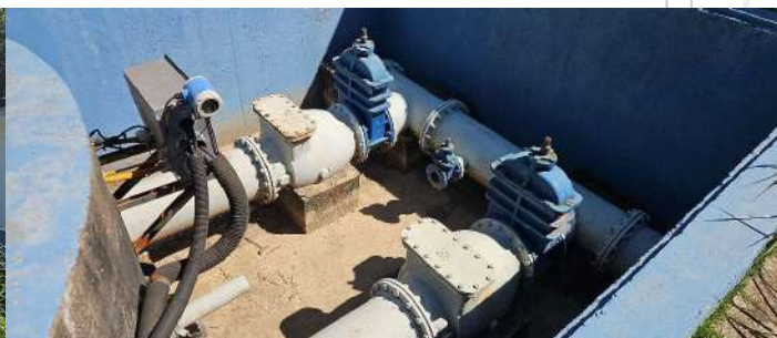
Foto 2 - Tubulação de recalque
