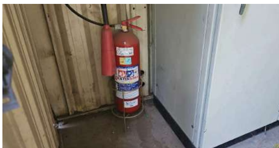
Foto 1 - Extintor de incêndio disponível na elevatória
