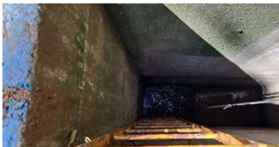
Foto 1 - Patamar de acesso com esgoto
