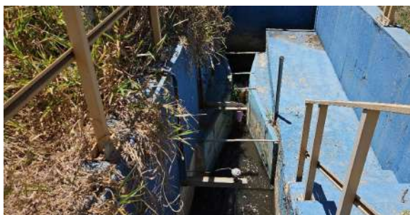
Foto 33 - Calha Parshall de passagem do efluente final
