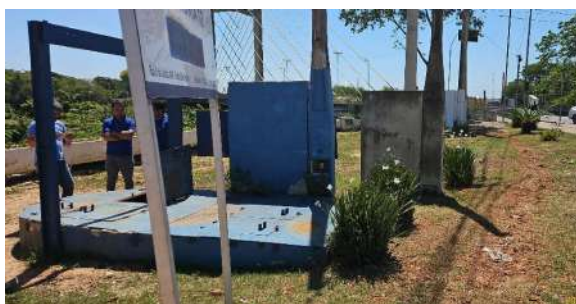
Foto 1 - Área da elevatória não possui cercamento
