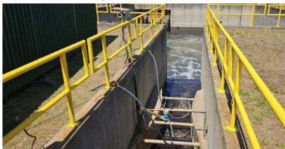
Foto 11 - Macromedidor de entrada
