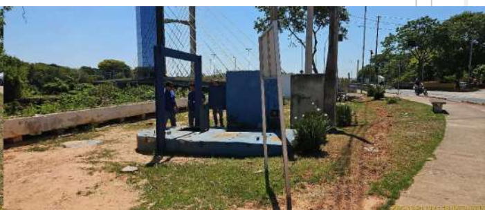
Foto 2 - Área da elevatória não possui cercamento
