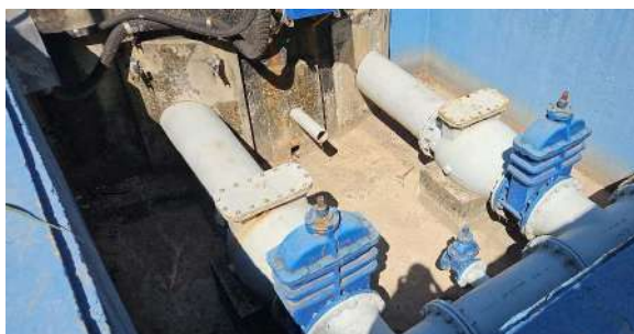
Foto 3 - Tubulação de recalque
