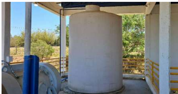
Foto 42 - Tanque de água para preparo de polímero no tratamento do lodo
