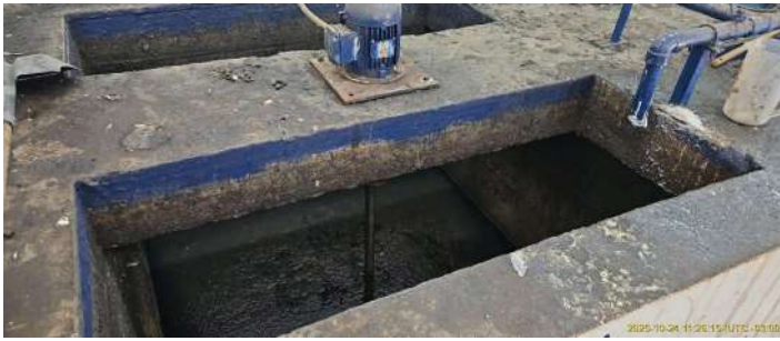
Foto 1 - Retorno de lodo nos tanques dos polímeros
