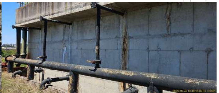
Foto 4 - Vazamento nas paredes do reator 4
