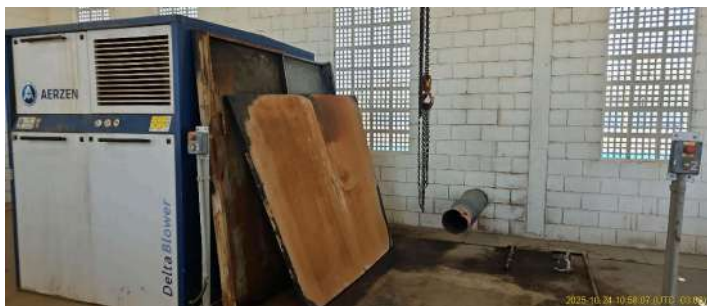
Foto 9 - Ausência de soprador reserva
