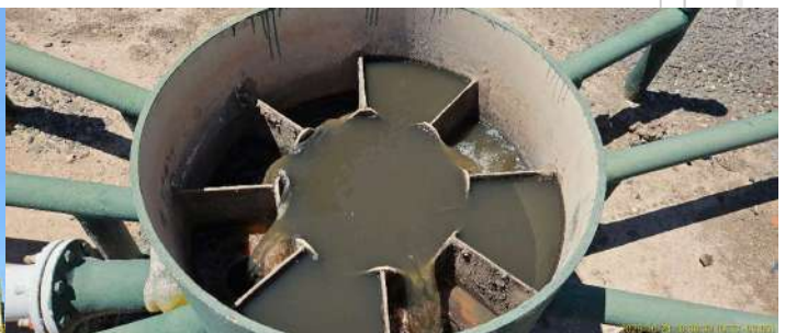
Foto 4 - Tubulação entupida (reator 3)
