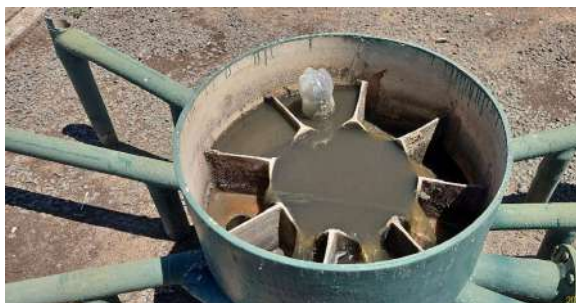
Foto 7 - Tubulação entupida (reator 4)
