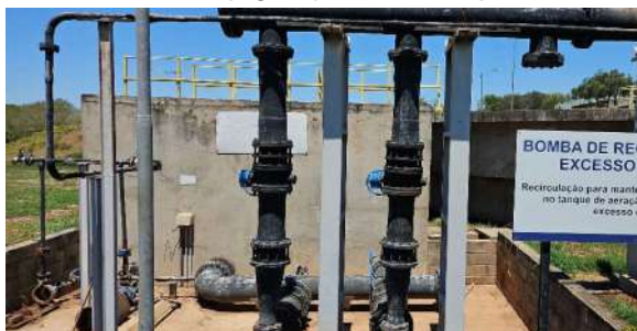
Foto 31 - Bombas de recirculação do lodo
