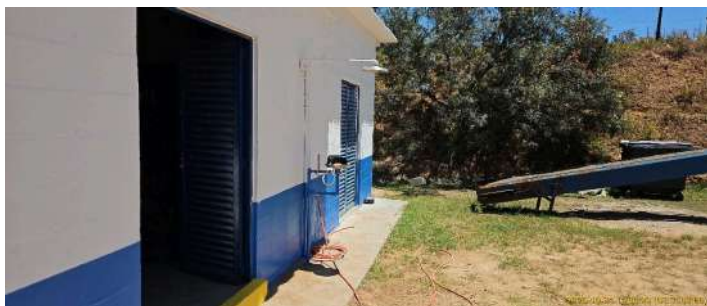
Foto 47 - Chuveiro de emergência próximo ao laboratório
