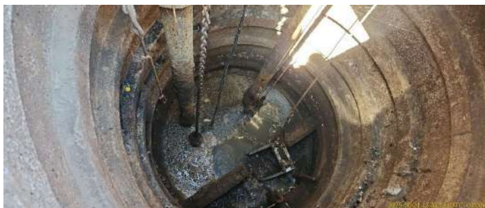
Foto 1 - Gradeamento em más condições de conservação
