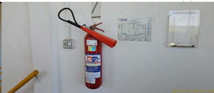
Foto 43 - Extintor de incêndio disponível no prédio de tratamento do lodo
