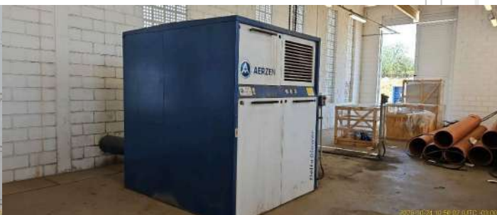
Foto 28 - Soprador do tanque de aeração
