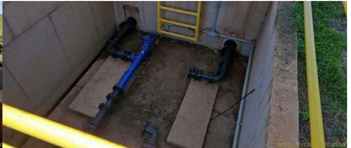
Foto 4 - Ausência de bomba reserva
