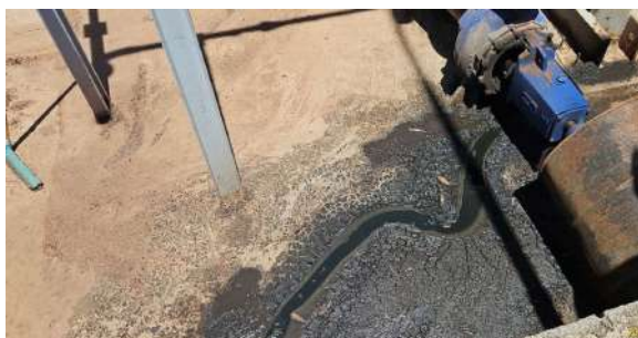
Foto 5 - Vazamento na bomba de recirculação de lodo
