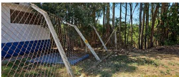
Foto 1 - Alambrado em más condições
