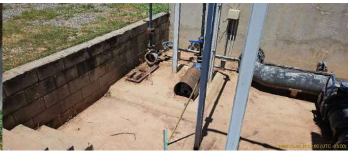
Foto 2 - Ausência de bomba reserva na recirculação do lodo
