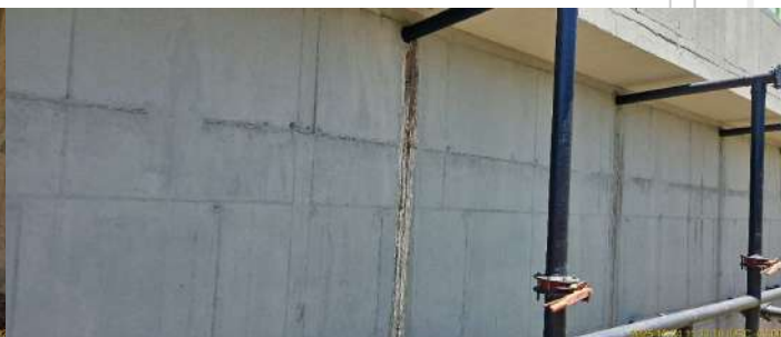
Foto 10 - Vazamento nas paredes do reator 1
