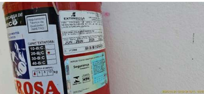
Foto 2 - Destaque para os dados de validade do extintor
