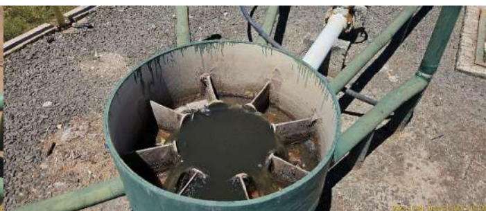
Foto 6 - Tubulação entupida (reator 4)
