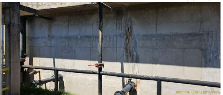
Foto 2 - Vazamento nas paredes do reator 3
