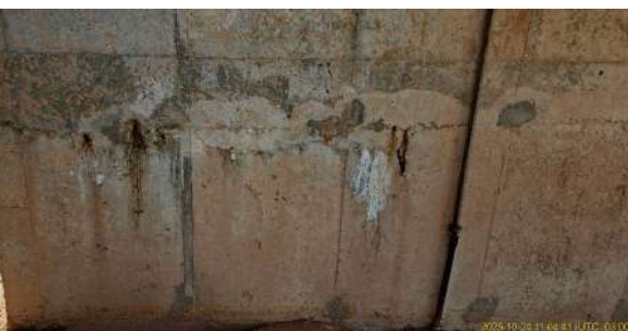
Foto 8 - Vazamento no decantador
