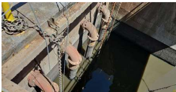
Foto 17 - Destaque para o bombeamento
