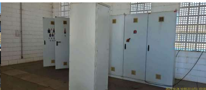
Foto 26 - Painéis elétricos da etapa de aeração
