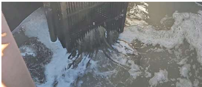
Foto 1 - Gradeamento em más condições de conservação
