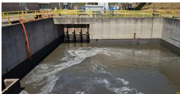
Foto 13 - Tanque de equalização
