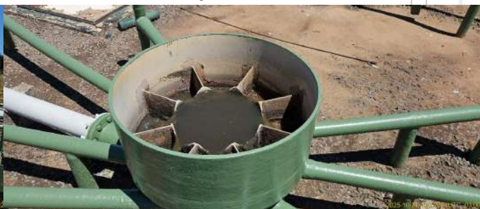
Foto 20 - Destaque para vertedores do reator UASB 3
