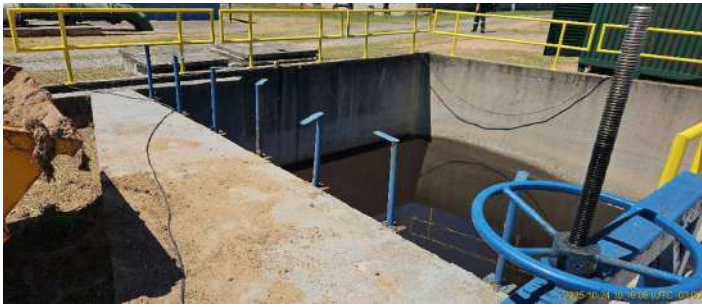
Foto 1 - Ausência de guardacorpo na lateral do desarenador
