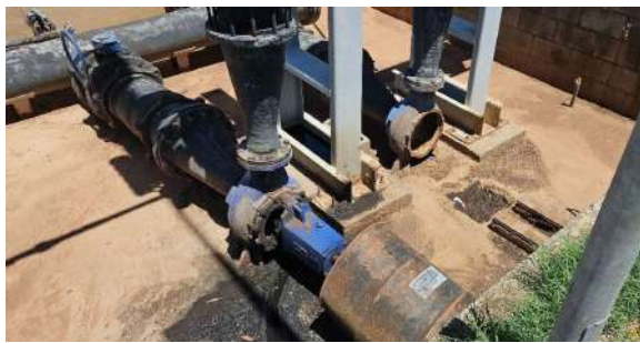
Foto 1 - Ausência de bomba reserva na recirculação do lodo
