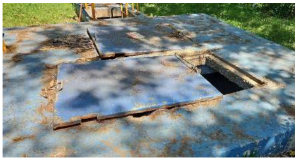
Foto 3 - Tampa de acesso aberta
