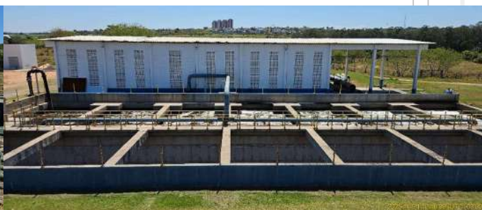
Foto 22 - Tanques de aeração
