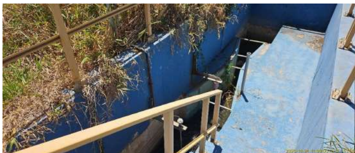
Foto 1 - A macromedição de saída não está sendo feita
