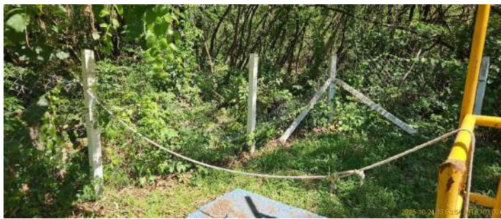
Foto 1 - Trecho sem cercamento nos fundos da EEEB
