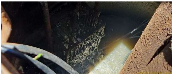
Foto 1 - Gradeamento em más condições de conservação
