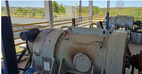
Foto 3 - Bomba centrífuga (uma das bombas não tem o sensor)
