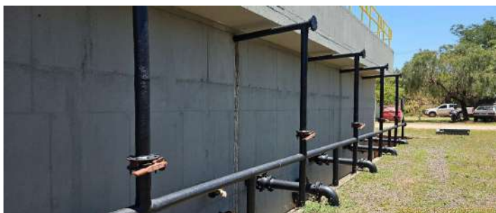
Foto 11 - Vazamento nas paredes do reator 1
