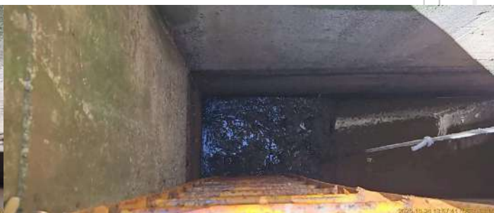
Foto 2 - Patamar de acesso com esgoto
