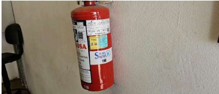
Foto 1 - Extintores de incêndio disponível na elevatória
