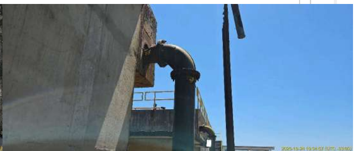
Foto 2 - Tubulação corroída no reator 3 (drenagem/ladrão)
