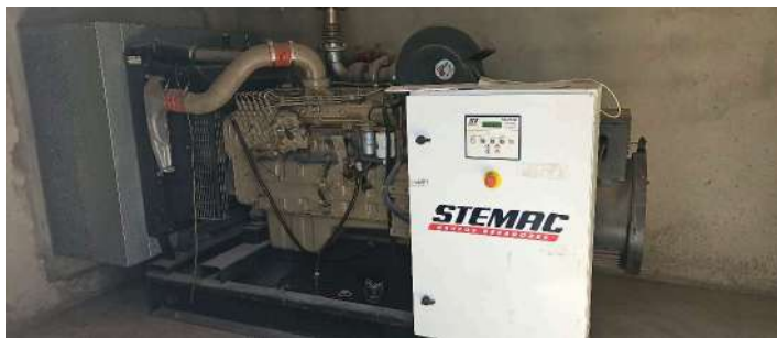
Foto 1 - Gerador inoperante no local.
