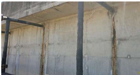
Foto 1 - Vazamento nas paredes do reator 4
