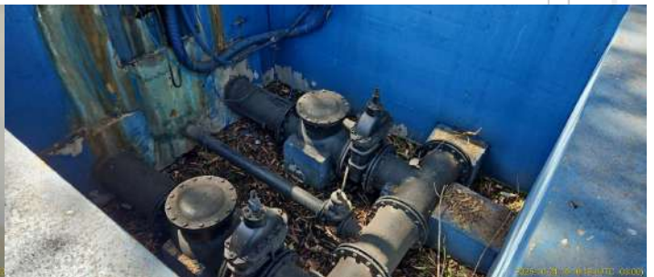
Foto 6 - Destaque para tubulações e conexões
