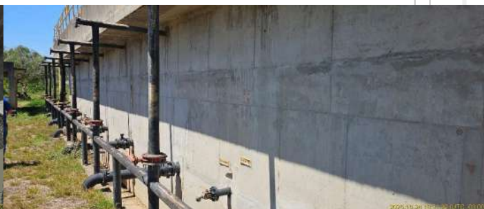
Foto 18 - Lateral do reator UASB 3 e suas tubulações
