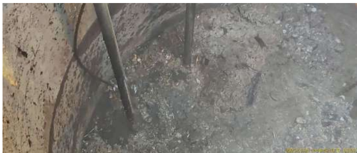
Foto 1 - Gradeamento em más condições de conservação
