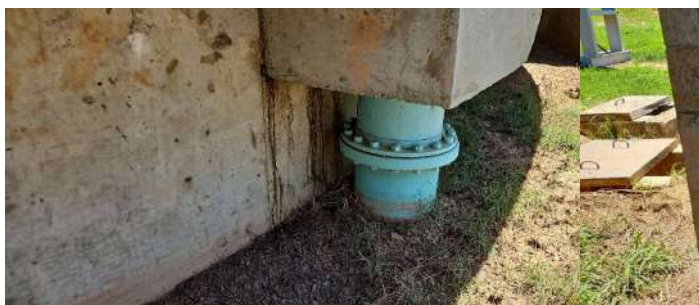
Foto 7 - Vazamento no decantador
