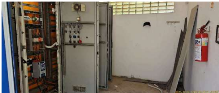
Foto 6 - Painéis elétricos da elevatória
