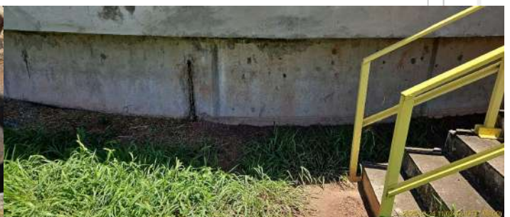
Foto 6 - Vazamento parede do decantador
