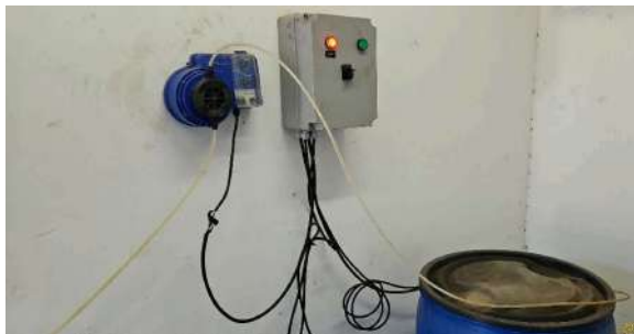
Foto 5 - Dosador de produtos
