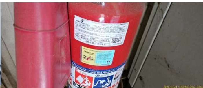
Foto 2 - Destaque para as informações de validade do extintor (junho/2026)
