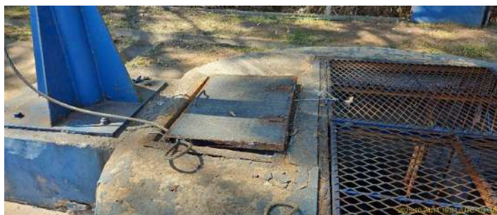
Foto 1 - Tampa solta e desalinhada
