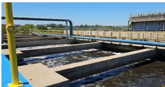
Foto 25 - Tanques de aeração
