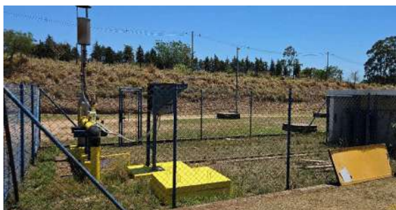
Foto 35 - Queimadores de gás metano produzidos nos reatores UASB
