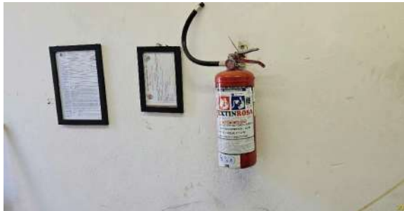
Foto 3 - Extintor de incêndio disponível na elevatória
