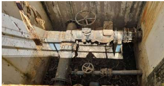
Foto 3 - Barrilete da estação elevatória
