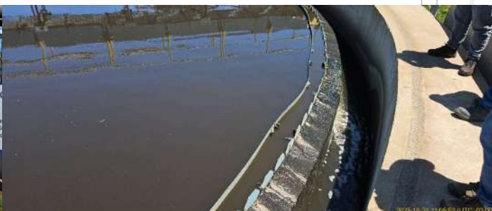
Foto 32 - Vertedores do decantador
