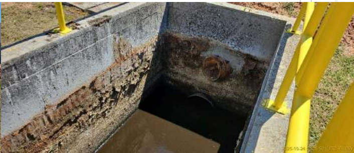
Foto 4 - Entrada do esgoto bruto
