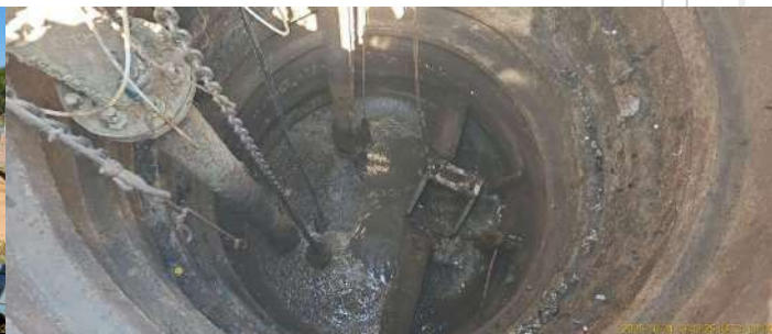
Foto 4 - Poço de passagem do efluente
