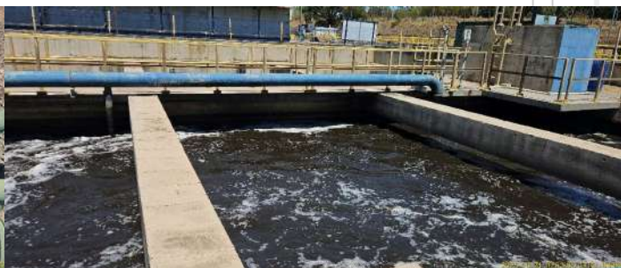
Foto 8 - Distribuição de ar irregular no sistema de aeração
