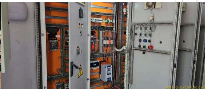
Foto 5 - Painéis elétricos da elevatória
