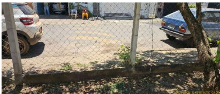
Foto 1 - Alambrado do cercamento danificado
