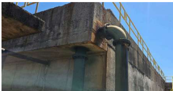
Foto 3 - Corrosão na tubulação do reator 4
