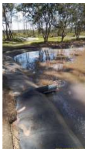
Foto 28 - Tubulação de entrada de efluente na lagoa facultativa.
