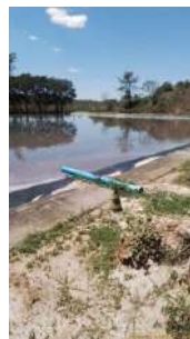
Foto 18 - Tubulação para bypass para lagoa facultativa
