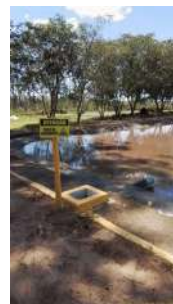
Foto 29 - Tubulação de entrada de efluente na lagoa facultativa.
