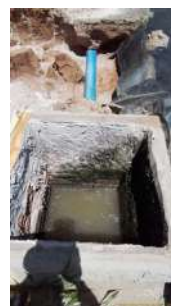
Foto 12 - Caixa na entrada de efluente na lagoa anaeróbia.
