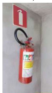
Foto 10 - Extintor junto ao painel elétrico
