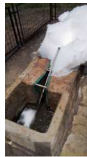
Foto 43 - Calha parshall na saída com espuma acumulada.
