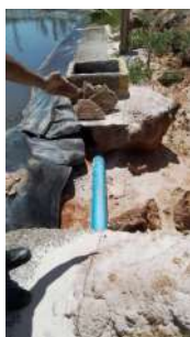
Foto 11 - Tubulação que servirá de bypass entre a caixa de areia, na chegada do esgoto à estação, para a lagoa facultativa. Será utilizado quando houver manutenção na lagoa anaeróbia.
