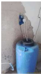
Foto 42 - Armazenamento e dosagem de hipoclorito de sódio.
