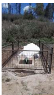
Foto 40 - Calha parshall antes do lançamento. Espuma acumulada.
