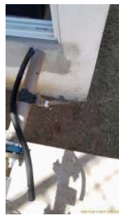
Foto 12 - Torneira para coleta de água bruta.
