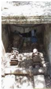
Foto 16 - Barrilete da bomba
