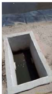
Foto 35 - Caixa de saída da lagoa facultativa
