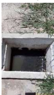
Foto 38 - Caixa de saída da lagoa facultativa.
