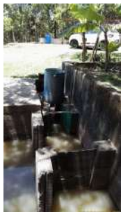
Foto 3 - Etapa preliminar e calha parshall
