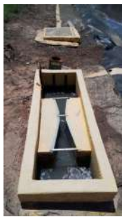
Foto 23 - Calha parshall situada entre a Lagoa anaeróbia e a lagoa facultativa
