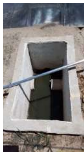
Foto 37 - Caixa saída lagoa facultativa
