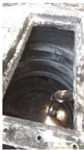
Foto 10 - Saída do extravasor do poço de sucção
