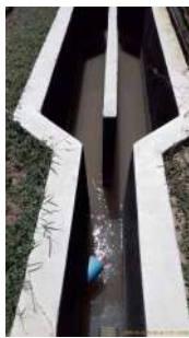
Foto 3 - Caixa de areia da ETE.
