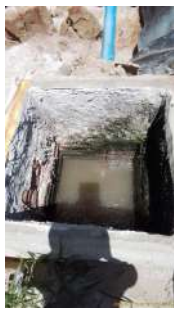
Foto 13 - Caixa na entrada de efluente na lagoa anaeróbia
