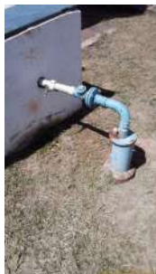
Foto 1 - Poço 4. Laje estava coberta por grama
