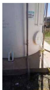
Foto 8 - Tubulação proveniente do poço 4 para complementar o abastecimento do reservatório.
