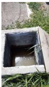
Foto 15 - Caixa de entrada na lagoa anaeróbia.
