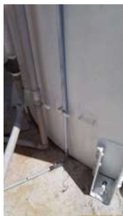
Foto 9 - Descida do SPDA para aterramento
