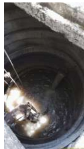
Foto 17 - Poço de sucção
