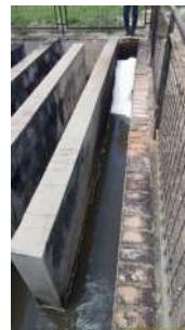
Foto 46 - Entrada do efluente nas chicanas
