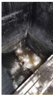
Foto 1 - Entrada do efluente na elevatória.
