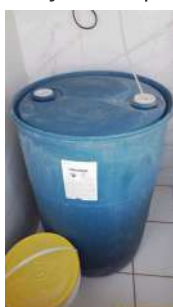
Foto 7 - Armazenamento de hipoclorito de sódio
