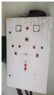
Foto 12 - Painel de comando da bomba
