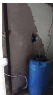
Foto 41 - Bombeamento de hipoclorito de sódio.
