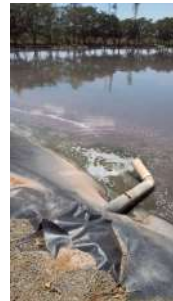
Foto 25 - Entrada de efluente na lagoa facultativa, após passar pela lagoa anaeróbia.
