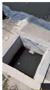
Foto 22 - Saída da lagoa anaeróbia
