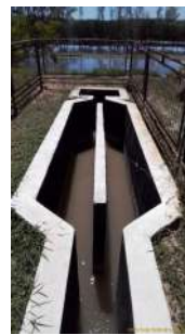
Foto 4 - Chegada do efluente proveniente da elevatória de esgoto.
