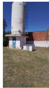
Foto 6 - Poço 4 e reservatório desativado
