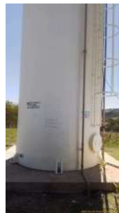
Foto 4 - Alimentação do reservatório a partir do poço 4, que complementar o abastecimento pelo poço 8.
