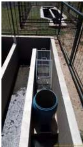
Foto 1 - Gradeamento do tratamento preliminar instalado por loteamento cujo efluente é encaminhado diretamente para a ETE. O efluente das demais partes da cidade é encaminhado primeiramente à elevatória de esgoto.
