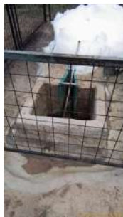
Foto 44 - Detalhe de canaleta para retorno de eventual extravasamento de efluente.
