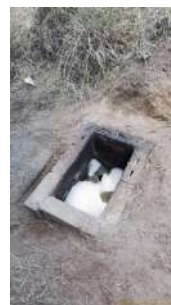
Foto 48 - Saída do tanque de contato
