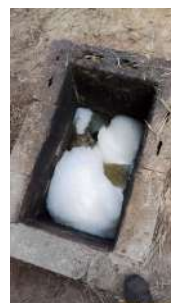
Foto 50 - Espuma acumulada na saída das chicanas, antes do lançamento final.
