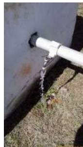
Foto 2 - Torneira para coleta de água bruta
