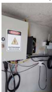
Foto 9 - Painéis elétricos e transmissão de telemetria.
