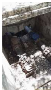
Foto 9 - Barrilete. Apenas uma bomba instalada e em funcionamento.
