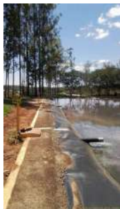
Foto 26 - Entradas de efluente na lagoa facultativa.
