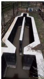
Foto 5 - Caixa de areia na chegada do efluente.
