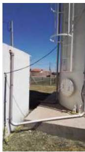
Foto 11 - Alimentação do reservatório pelo poço
