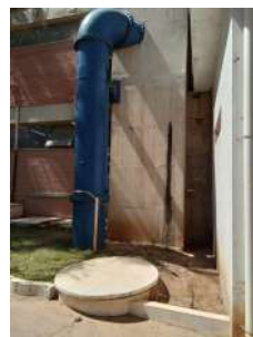
Foto 2 - Entrada da água bruta.
