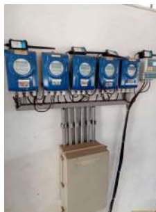
Foto 2 - Medidores de vazão de cada recalque.
