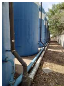
Foto 12 - Reservatórios do FAS (Filtro Aeróbio Submerso)
