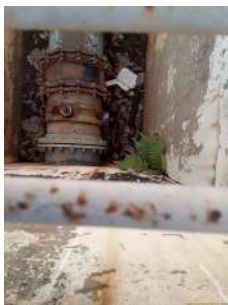
Foto 7 - Tubulação de entrada.
