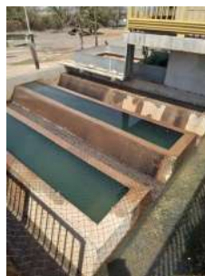
Foto 41 - Decantador de manta de lodo pulsado.
