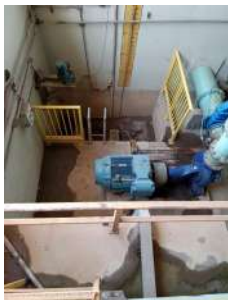
Foto 9 - Um dos conjuntos motobomba.
