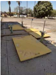
Foto 2 - Caixas de inspeção e válvulas de manobra.
