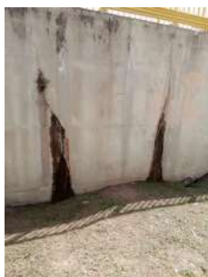
Foto 8 - Dois vazamentos próximos na parede do sistema de tratamento.
