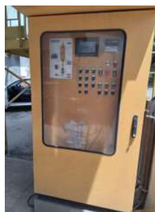
Foto 64 - Pannel de controle do silo de carvão.
