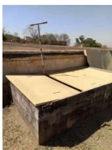
Foto 9 - Caixa com outra válvula de manobra.
