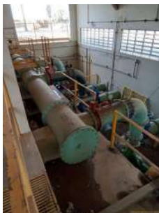
Foto 1 - Vista do sistema de recalque.
