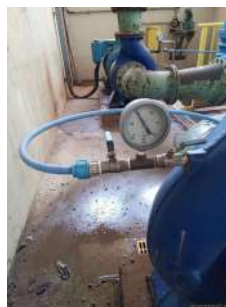
Foto 14 - Manômetro com a pressão de recalque da bomba.
