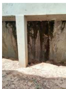
Foto 11 - Vazamento abaixo da canaleta.
