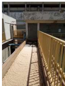
Foto 32 - Calha de entrada de água bruta com floculante.
