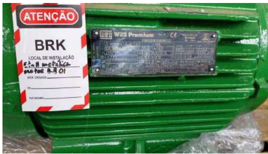
Foto 1 - Motor da bomba reserva.
