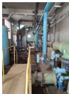
Foto 56 - Válvulas que operam os filtros.
