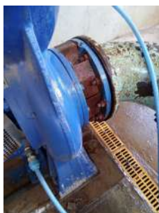
Foto 1 - Vazamento na junção da tubulação de sucção com a bomba.
