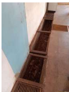
Foto 1 - Canaleta com fiação exposta, sem grade de proteção.
