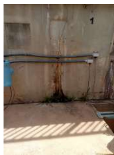
Foto 5 - Vazamento na parede do sistema de tratamento.
