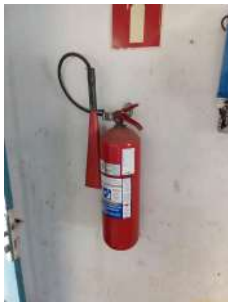
Foto 3 - Extintor de incêndio.
