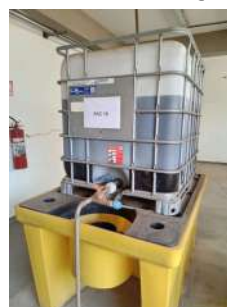
Foto 22 - PAC utilizado em caso de parada do sistema de mistura e dosagem.
