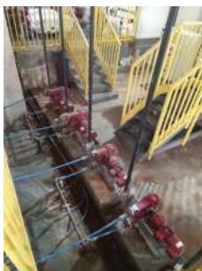
Foto 49 - Bombas de dosagem.
