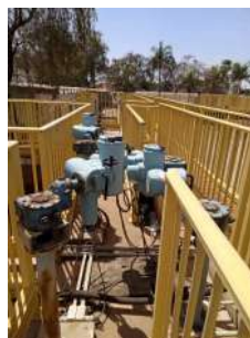
Foto 39 - Válvulas de manobras.
