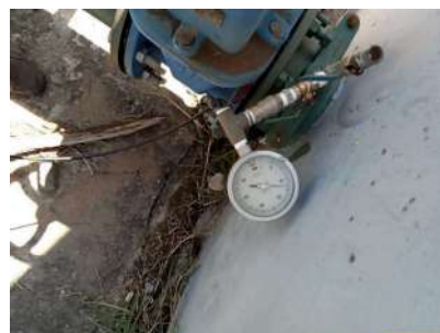
Foto 12 - Manômetro com o nível do reservatório.
