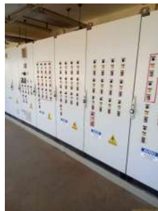
Foto 28 - Painéis de controle do sistema tratamento por manta de lodo pulsado.
