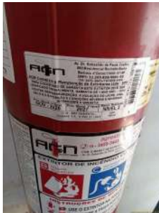
Foto 5 - Validade do extintor.
