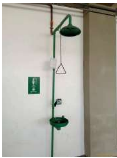
Foto 25 - Chuveiro de emergência instalado na área de entrada de água bruta.
