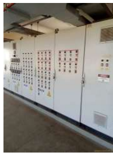
Foto 26 - Painéis de operação do sistema de tratamento convencional da ETA.
