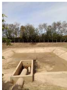
Foto 58 - Reservatório de lodo
