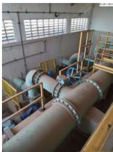
Foto 7 - Tubulações de recalque.
