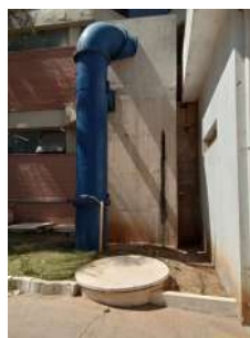
Foto 2 - Vazamento na entrada de água bruta.
