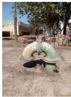
Foto 4 - Tubulação de respiro (ventilação) do reservatório.
