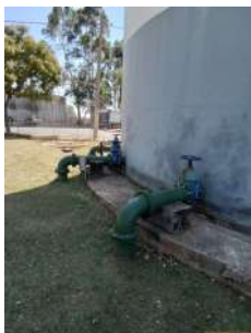
Foto 6 - Tubulações de saída.
