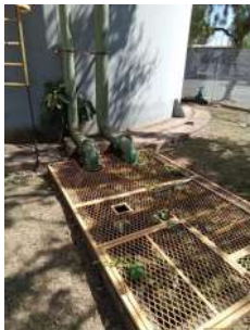
Foto 2 - Tubulações de entrada (recalque da EEAT).
