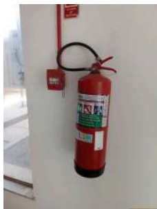
Foto 5 - Extintor de incêndio.
