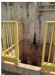
Foto 4 - Vazamento na caixa de descarga.
