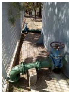
Foto 11 - Outras tubulações de saída do reservatório.
