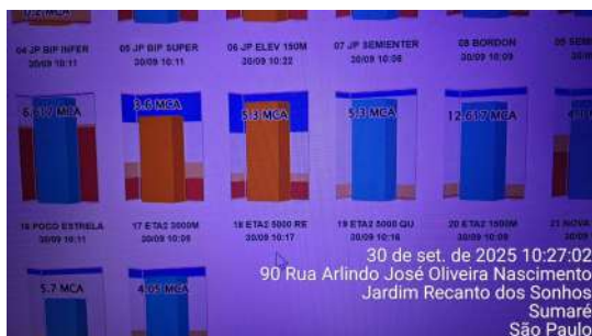
Foto 11 - Tela do CCO com o nível do reservatório.
