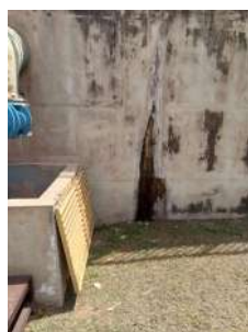
Foto 3 - Vazamento na parede traseira do sistema de tratamento.
