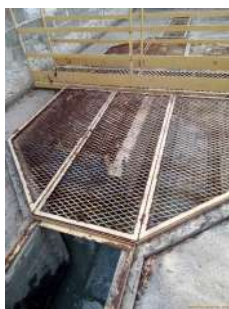
Foto 7 - Calha de remoção de areia.
