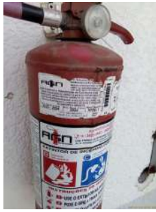
Foto 1 - Validade do extintor de incêndio.
