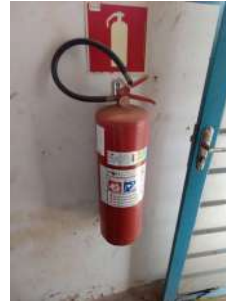
Foto 4 - Extintor de incêndio.
