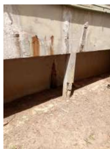
Foto 12 - Outro vazamento abaixo da canaleta do sistema de tratamento convencional.
