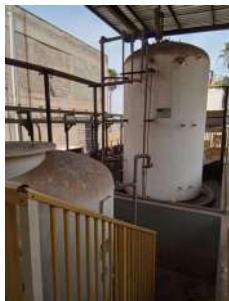
Foto 65 - Tanques do gerador de hipoclorito de sódio.
