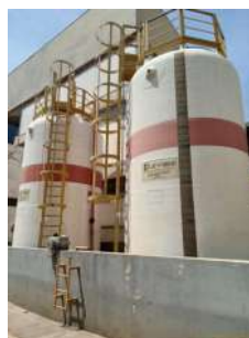
Foto 62 - Armazenamento de PAC.
