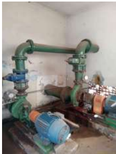
Foto 7 - Vista dos conjuntos motobombas.
