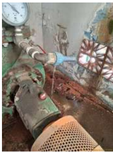
Foto 1 - Vazamento na tubulação de escorva da Bomba 1.
