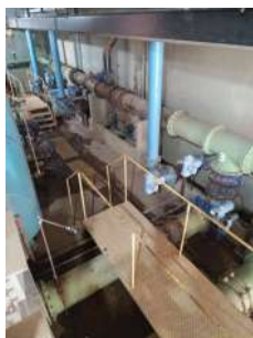
Foto 55 - Sala de operação dos filtros.
