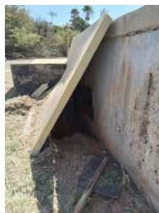
Foto 8 - Abertura na lateral do reservatório, resultante da retirada de tubulação.
