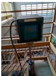
Foto 11 - Medidor de vazão de inserção.
