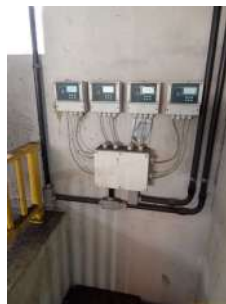
Foto 48 - Medidores de vazão da sala de mistura e dosagem.
