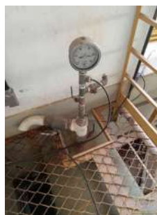
Foto 12 - Manômetro com a pressão do recalque principal.
