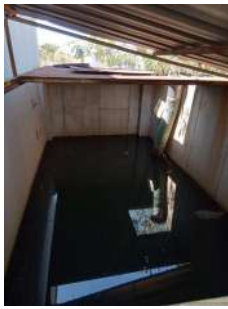
Foto 7 - Segunda caixa de alvenaria cheia de água suja e parada.
