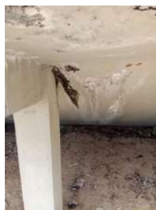
Foto 9 - Vazamento na parede lateral do sistema de tratamento convencional.
