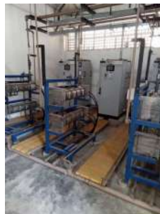
Foto 66 - Gerador de hipoclorito de sódio.
