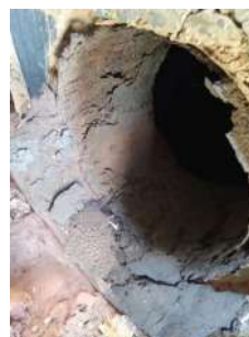
Foto 2 - Detalhe da abertura.
