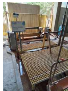
Foto 20 - Entrada da água bruta.
