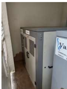
Foto 19 - Par de sopradores.
