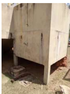
Foto 10 - Vazamento na caixa da canaleta que leva água aos filtros.
