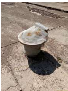
Foto 1 - Tubulação de ventilação com a abertura voltada para cima sem cobertura.
