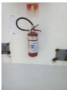
Foto 17 - Extintor de incêndio.
