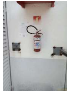
Foto 2 - Extintor de incêndio.
