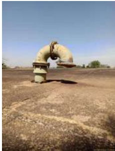
Foto 4 - Tubulação de ventilação.
