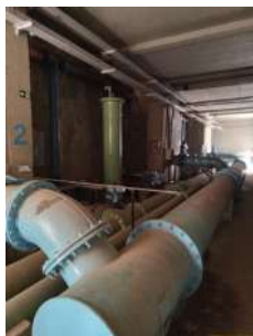
Foto 57 - Tubulações dos filtros.
