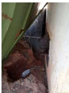
Foto 1 - Abertura no reservatório devido a retirada de tubulação.
