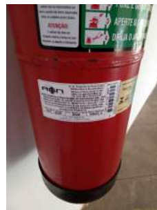
Foto 6 - Validade do extintor.
