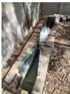
Foto 13 - Calha Parshall de saída.
