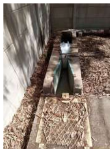
Foto 14 - Saída do efluente tratado.
