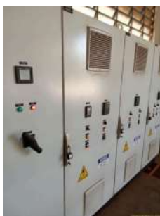
Foto 5 - Painéis de controle.
