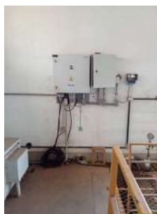
Foto 6 - Painéis de energia.
