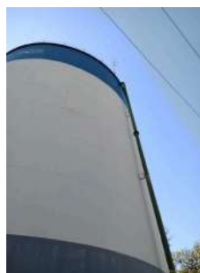
Foto 8 - Detalhe da tubulação do extravasor.
