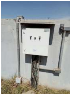
Foto 2 - Pannel da bomba de coleta de água (desativada).
