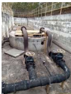
Foto 9 - Estação Elevatória de Esgoto (EEE)
