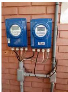
Foto 3 - Macromedidor de entrada.
