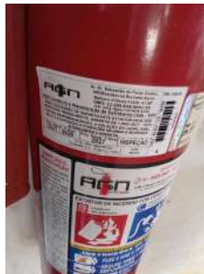
Foto 4 - Validade do extintor de incêndio.
