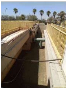
Foto 27 - Tubulação de passagem de água entre os filtros dos dois tipos de tratamento.
