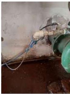
Foto 2 - Vazamento na tubulação de escorva da Bomba 2.
