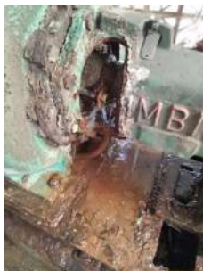
Foto 1 - Drenagem da lubrificação da gaxeta da Bomba 1.
