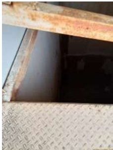
Foto 10 - Detalhe do vazamento na parede do reservatório e da caixa.
