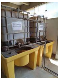
Foto 21 - Hipoclorito de sódio utilizado em caso de parada do sistema de mistura e dosagem.
