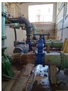
Foto 13 - Tubulações de sucção.
