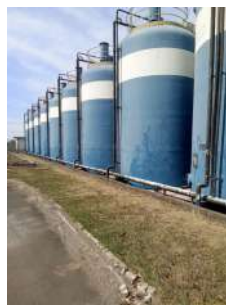
Foto 10 - Reservatórios do UASB.
