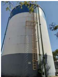
Foto 1 - Escada marinheiro e tubulações do reservatório.
