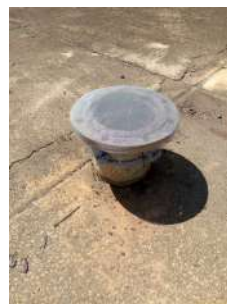
Foto 3 - Tubulação de ventilação sem a cobertura.
