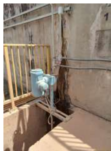
Foto 7 - Vazamento na parede próximo as fiações do atuador.
