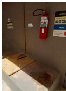
Foto 54 - Saída do tratamento convencional
