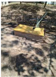
Foto 3 - Caixa de inspeção com tubulação desativada chegando.
