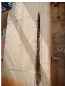
Foto 1 - Detalhe do vazamento na entrada de água bruta.
