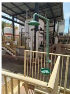
Foto 53 - Chuveiro de emergência externo.
