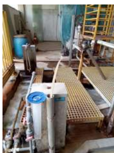
Foto 23 - Calha Parshall e dosagem de produtos químicos.
