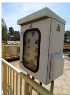
Foto 35 - Paineis de operação das pás de limpeza dos decantadores.
