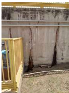
Foto 6 - Três vazamentos próximos.
