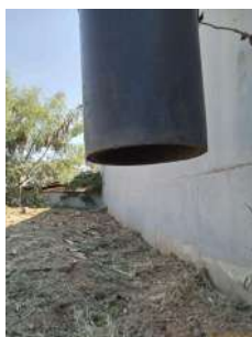
Foto 1 - Ponta do tudo extravasor sem tela de proteção.
