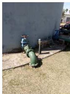
Foto 10 - Tubulação com o sensor de nível.
