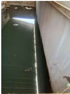
Foto 1 - Caixa de alvenaria na lateral do reservatório cheia de água.
