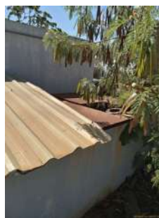
Foto 6 - Caixa de válvulas.
