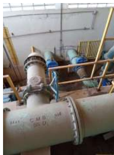
Foto 8 - Tubulação de recalque e, ao fundo, as tubulações de sucção.
