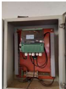
Foto 10 - Medidor de vazão do recalque principal.
