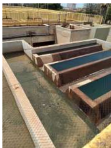
Foto 40 - Sistema de tratamento por decantador de manta de lodo pulsado.
