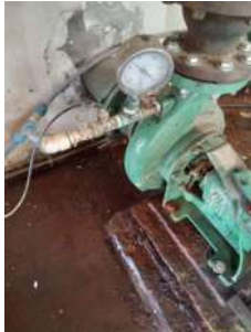
Foto 3 - Manômetro com a pressão de recalque.
