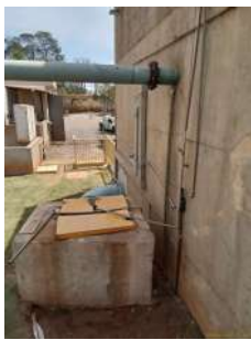
Foto 43 - Tubulação de saída da água tratada.
