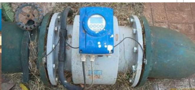
Foto 11 - Macromedidor de saída da EEAB.
