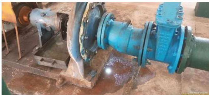
Foto 1 - Vazamento próximo à bomba e ao registro da tubulação de sucção.
