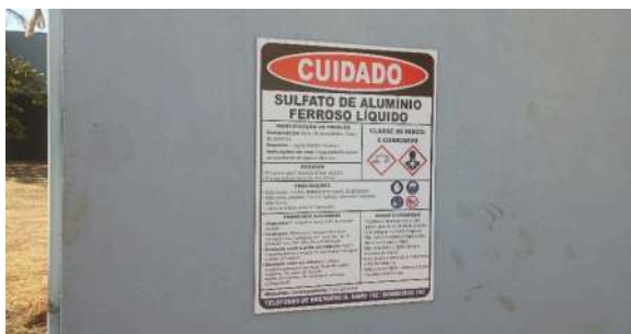
Foto 27 - Placa de identificação e de aviso dos tanques de sulfato de alumínio.
