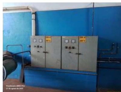
Foto 16 - Painéis elétricos de acionamento.
