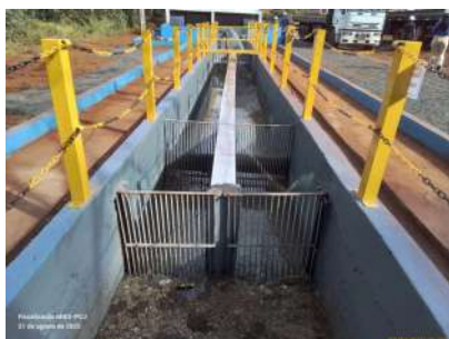
Foto 5 - Sistema de gradeamento grosso e médio.
