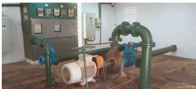
Foto 3 - Vista interna da EEAT.
