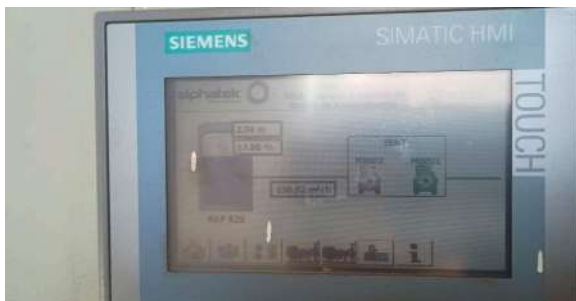
Foto 11 - Medidor de nível do reservatório.
