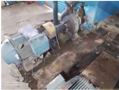
Foto 1 - Situação da água de lubrificação de gaxeta do equipamento próximo à porta.
