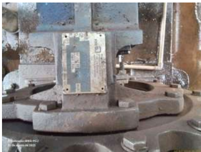
Foto 11 - Especificação da bomba próxima à rampa.
