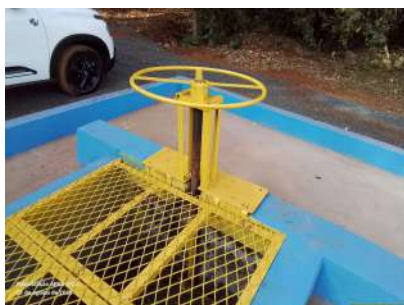
Foto 3 - Comporta para extravasamento da caixa de chegada.
