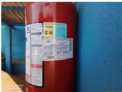
Foto 9 - Extintor da EEAT.
