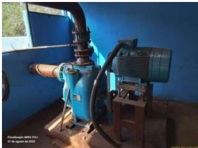
Foto 15 - Vista da bomba do canto.
