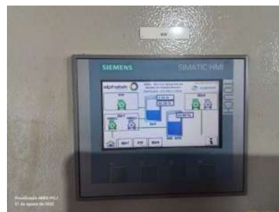
Foto 17 - Tela do sistema de telemetria: a EEAT succiona do RAP, O MBE2 abastece diretamente a rede e o MBE 1 para o reservatório Jota.
