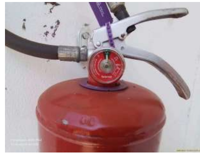
Foto 12 - Extintor do local.
