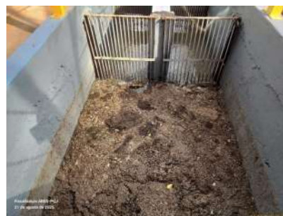
Foto 4 - Gradeamento grosso. Material flutuante acumulado.
