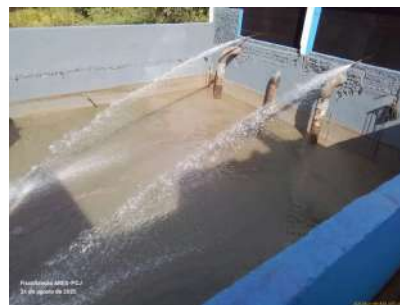
Foto 8 - Poço de sucção e retorno do sistema de escorva das bombas.
