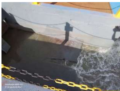
Foto 7 - Calha Parshall afogada.
