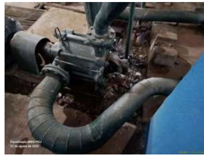
Foto 2 - Vazamento próximo à bomba distante da porta.
