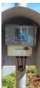
Foto 27 - Vista do visor da macromedicação da saída da ETE.
