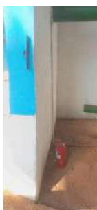
Foto 13 - Extintor de incêndio do local.
