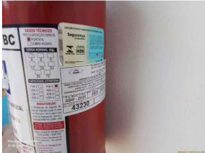
Foto 13 - Extintor do local.
