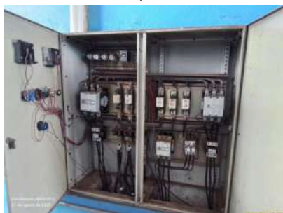
Foto 19 - Interio dos painéis elétricos.
