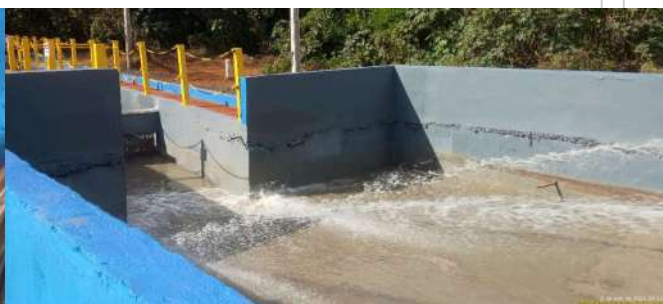
Foto 4 - Primeiro ponto de dosagem dos microorganismos na elevatória de esgoto.
