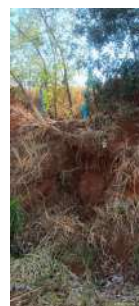
Foto 2 - Situação do barranco na lateral direita da primeira linha de lagoas.
