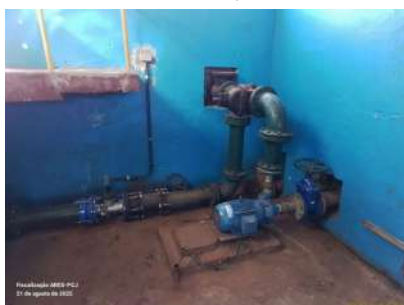
Foto 21 - Booster da área operacional 7. Contribui no recalque por gravidade.
