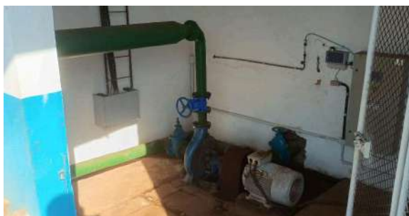
Foto 5 - Vista interna da EEAT.
