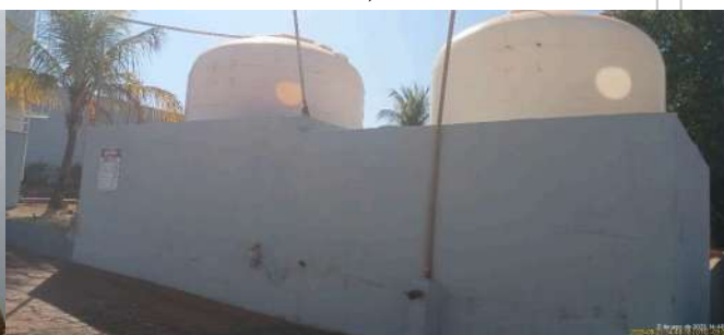
Foto 26 - Tanques de armazenamento de sulfato de alumínio em maior escala.
