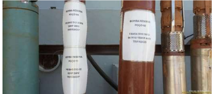
Foto 14 - Bomba reserva do poço em estoque na ETA.
