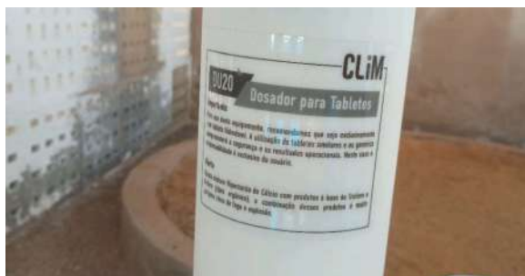
Foto 8 - Sistema de dosagem de produtos químicos na água captada do poço.
