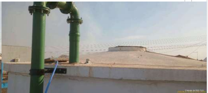
Foto 6 - Tubulação de abastecimento do reservatório.
