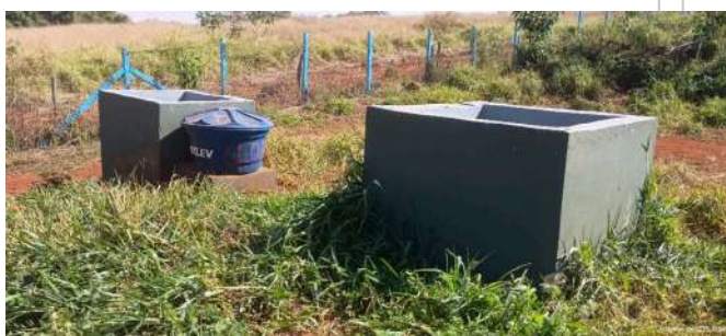
Foto 28 - Caixas de saída dos efluentes e dosagem de hipoclorito.
