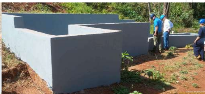
Foto 30 - Caixa de saída do efluente pós tratamento.
