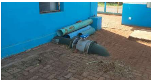
Foto 10 - Tubulação de recalque (saída).
