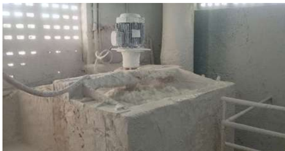
Foto 18 - Tanque de preparo da cal.
