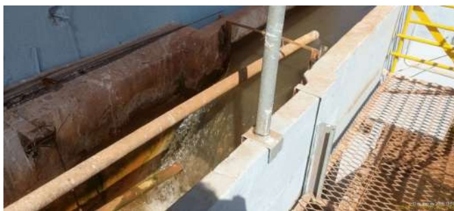
Foto 2 - Chegada da água bruta na ETA.
