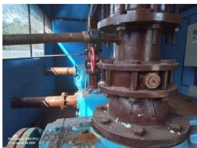
Foto 1 - Vazamento no tubo de escova da bomba da entrada.
