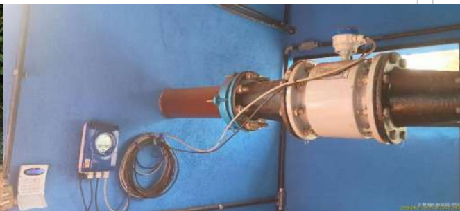
Foto 2 - Macromedidor na tubulação de recalque da elevatória de esgoto.
