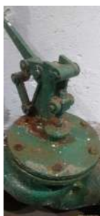
Foto 3 - Tubulação da saída do filtro 2.
