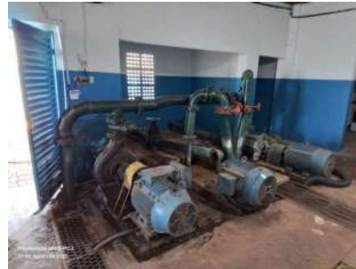
Foto 4 - Conjuntos motobomba da EEAT.
