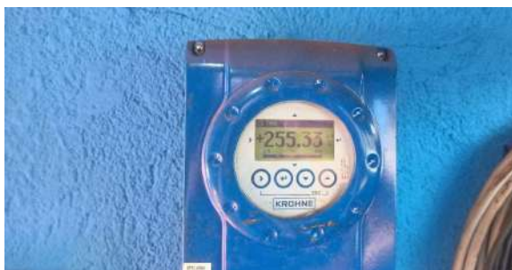
Foto 3 - Macromedidor na tubulação de recalque da elevatória de esgoto.
