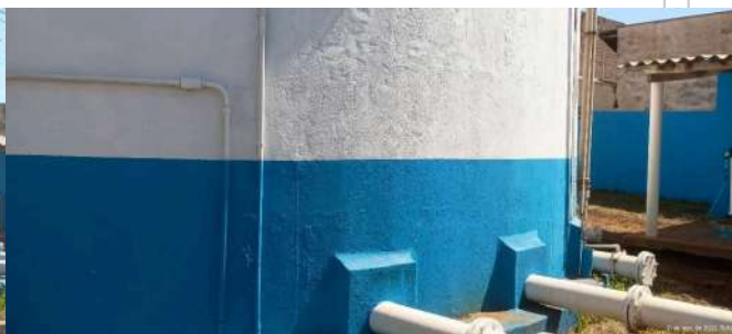
Foto 4 - Tubulação de sucção da EEAT.
