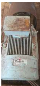
Foto 7 - Motor do conjunto motobomba.
