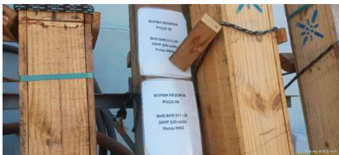
Foto 33 - Bombas reservas dos poços 19 e 8.
