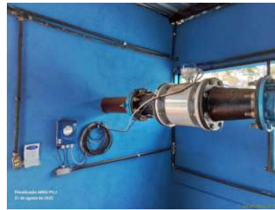
Foto 20 - Macromedidor da linha de recalque.
