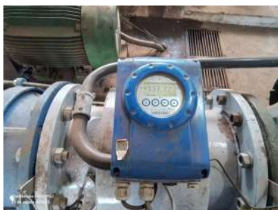
Foto 15 - Macromedidor da linha de recalque.
