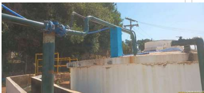
Foto 5 - Tubulação entre o poço e o reservatório.
