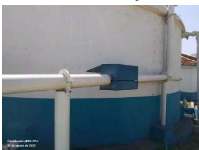
Foto 7 - Caixa de proteção do macromedidor.
