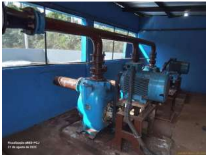
Foto 13 - Vista do sistema de bombeamento.
