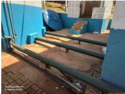
Foto 3 - Tubulações entre o reservatório R23 e a EEAT 1 (sucção).
