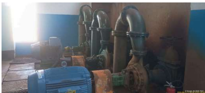
Foto 5 - Conjuntos motobomba da EEAB.
