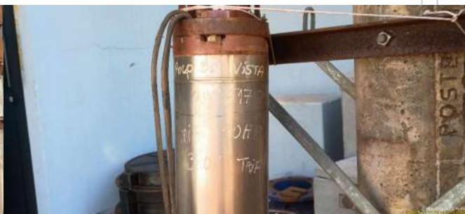
Foto 30 - Bomba reserva do poço Boa Vista.
