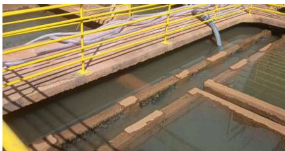
Foto 10 - Decantador e, ao fundo, um dos módulos de filtração.
