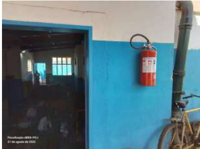
Foto 7 - Extintor da EEAT.
