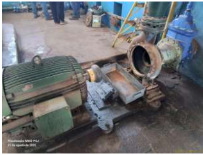
Foto 1 - Ausência de bomba reserva.
