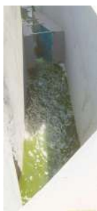
Foto 33 - Situação do efluente na saída do tratamento.
