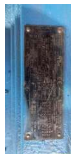
Foto 6 - Placa de especificações técnicas do motor do conjunto motobomba 1
