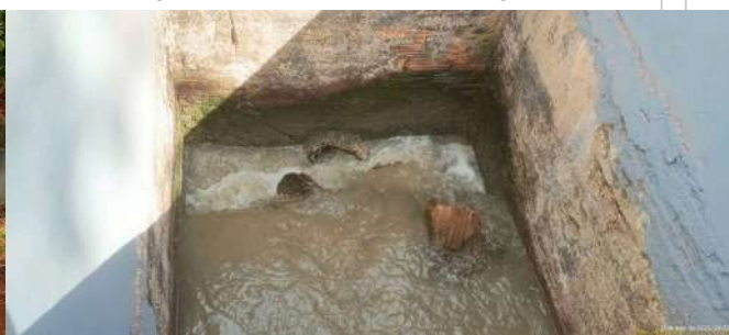
Foto 6 - Vista interna da primeira caixa de chegada dos esgotos.
