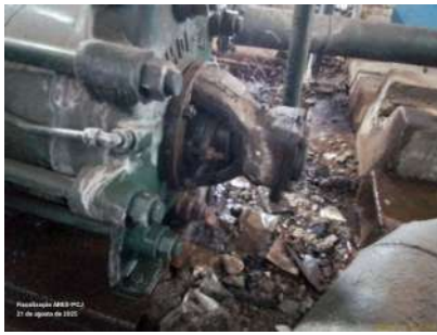
Foto 1 - Vazamento na bomba distante da porta.
