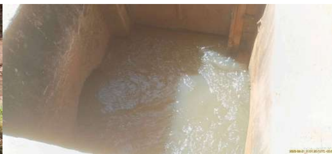
Foto 8 - Entrada da água bruta na tubulação que segue para o local da EEAB.
