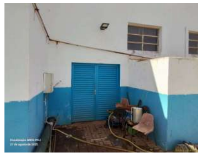
Foto 2 - Portas de acesso para o abrigo dos conjuntos motobomba.
