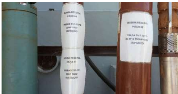
Foto 29 - Bombas reservas dos poços 4, 11 e 2.
