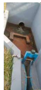
Foto 14 - Segunda chegada de esgoto (não passa pela elevatória) da ETE, com macromedidor.
