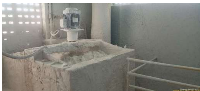
Foto 1 - Tanque de mistura do hidróxido de cálcio, respingando o produto no entorno, inclusive na escada de acesso.
