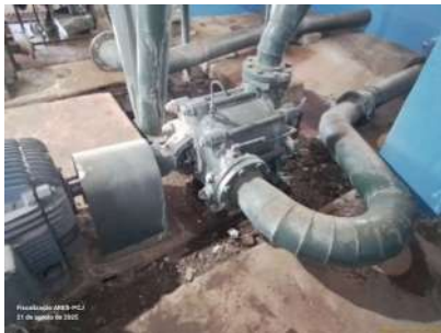
Foto 3 - Situação da água de lubrificação de gaxeta do equipamento distante da porta.
