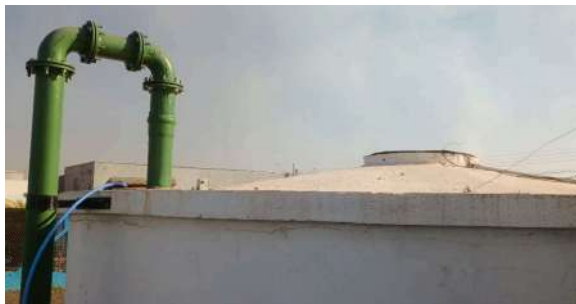
Foto 5 - Tubulação de abastecimento do reservatório.
