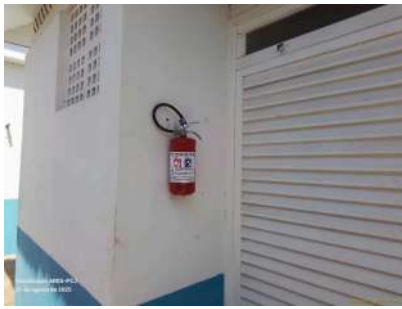
Foto 11 - Extintor do local.
