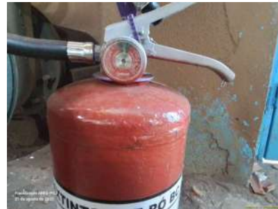
Foto 15 - Indicação de nível do extintor de incêndio.
