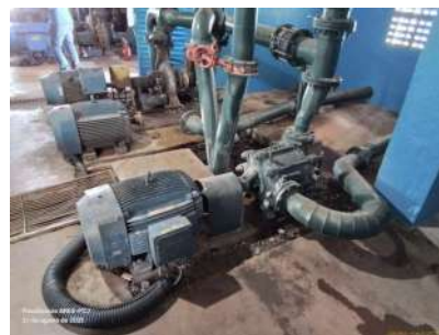
Foto 7 - Conjuntos motobomba da EEAT.
