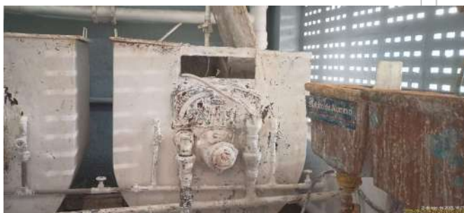
Foto 17 - Tanque de sulfato de alumínio.
