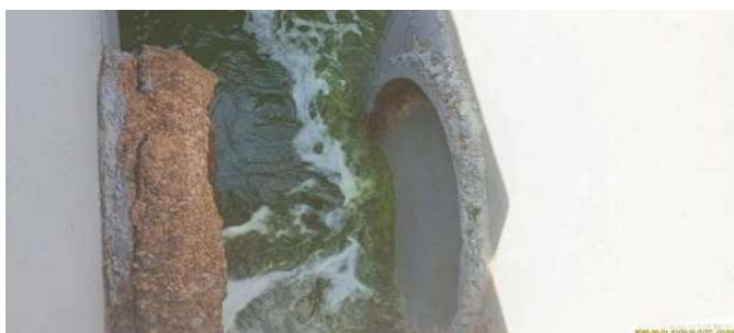
Foto 31 - Situação do efluente na saída do tratamento.
