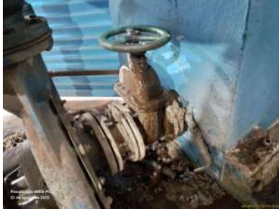
Foto 3 - Vazamento no registro de sucção próximo à porta.
