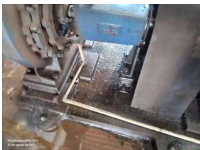
Foto 13 - Drenagem da gaxeta.
