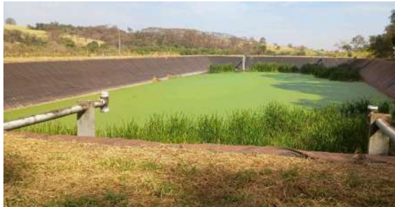
Foto 10 - Primeira lagoa da primeira linha, sem esgoto em razão da previsão de manutenção da manta e remoção de vegetação.
