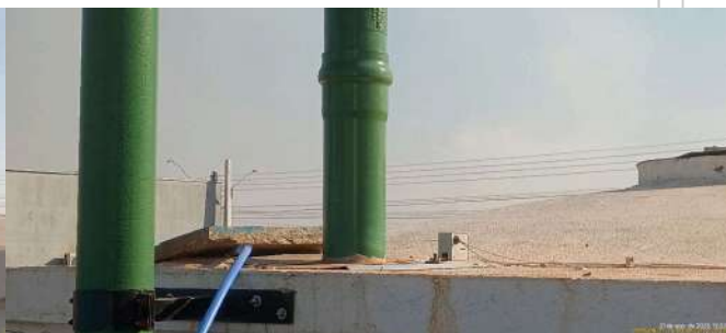
Foto 2 - Tampa de concreto entreaberta.
