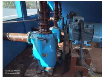
Foto 14 - Vista da bomba da entrada.
