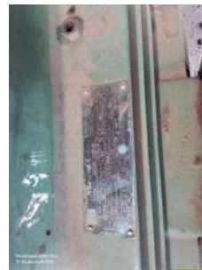
Foto 12 - Especificação do motor próximo à rampa.
