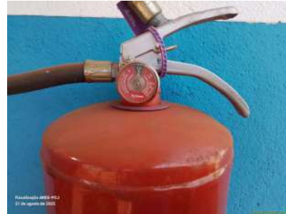
Foto 8 - Extintor da EEAT.
