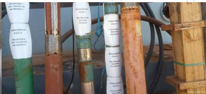
Foto 32 - Bombas reservas dos poços 1, 18, 10 e 7.
