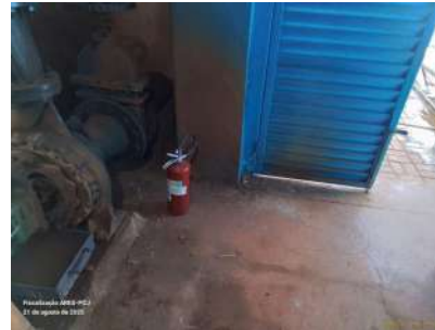
Foto 13 - Extintor de incêndios do local.
