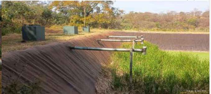
Foto 11 - Tubulações de divisão do esgoto afluente na lagoa anaeróbia da linha 1 (superior).
