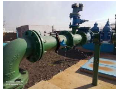
Foto 4 - Tomada de água bruta.
