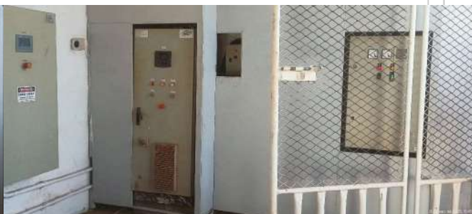
Foto 12 - Vista geral dos painéis elétricos e de comando da EEAT e do Poço P0.
