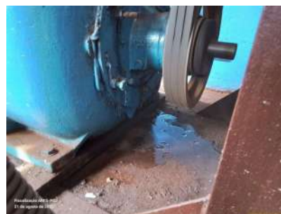
Foto 2 - Vazamento na bomba do canto.
