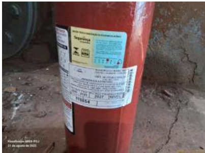
Foto 14 - Validade do extintor de incêndios do local.
