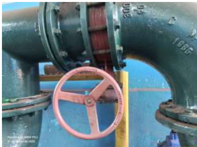
Foto 1 - Vazamento no registro de manobra.
