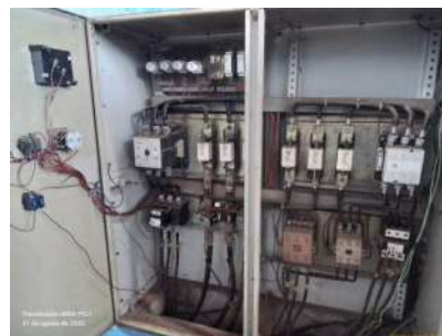
Foto 20 - Interio dos painéis elétricos.
