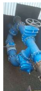
Foto 34 - Macromedidor de saída da ETA.
