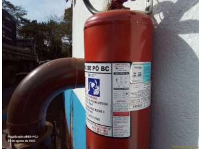
Foto 11 - Validade do extintor do acesso.
