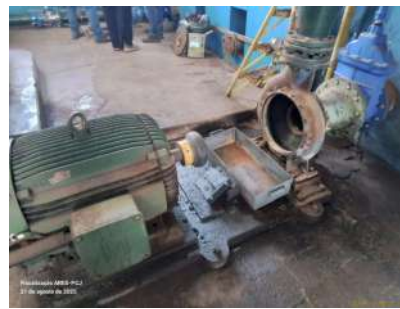
Foto 2 - Recipiente abaixo de onde é o eixo do conjunto 2, ausente por causa de manutenção.
