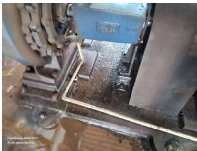
Foto 1 - Tubo condutor da água de lubrificação de gaxetas do conjunto 1 (em operação).
