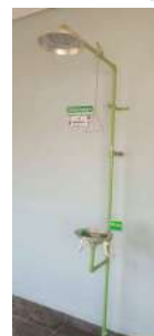
Foto 16 - Chuveiro de emergência da ETA.
