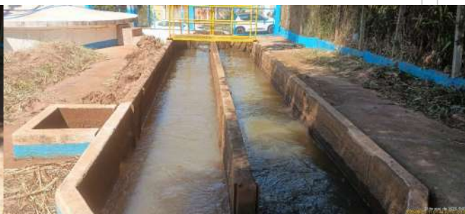
Foto 10 - Canais para remoção de areia antes da EEAB.
