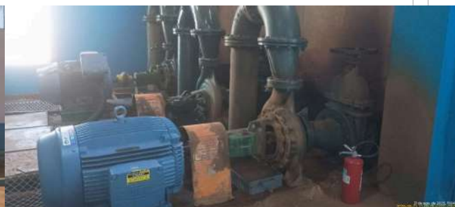
Foto 4 - Conjuntos motobomba da EEAB.
