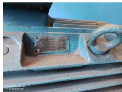
Foto 18 - Especificação do motor da bomba do canto.
