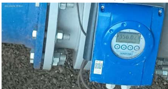
Foto 35 - Macromedidor de saída da ETA.
