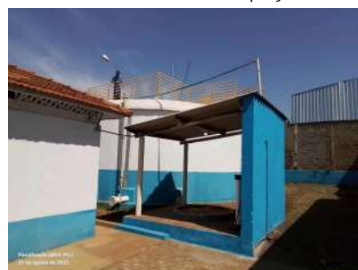
Foto 10 - Abrigo do sistema de dosagem química.
