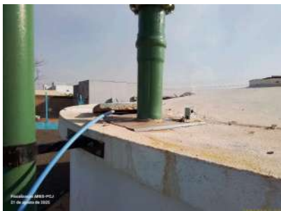
Foto 10 - Entrada do recalque do poço e produtos químicos no reservatório.
