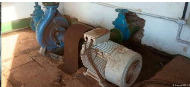
Foto 6 - Conjunto motobomba instalado.
