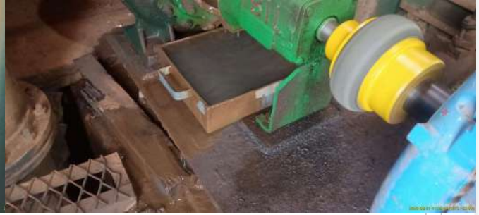
Foto 2 - Recipiente colocado abaixo do eixo do equipamento, sem condução direta da água de lubrificação para fora da região da bomba.
