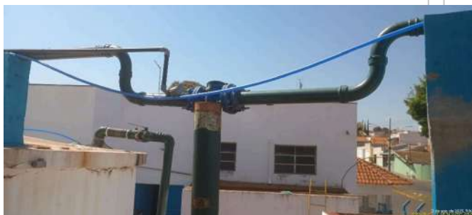
Foto 4 - Macromedidor do poço.
