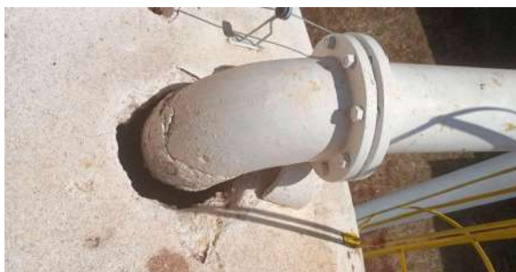
Foto 1 - Abertura excessiva para passagem de tubulação.
