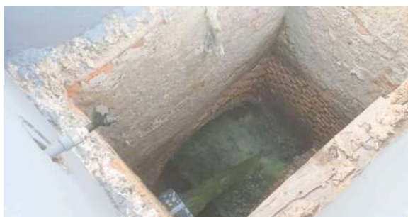
Foto 29 - Dosagem de hipoclorito
