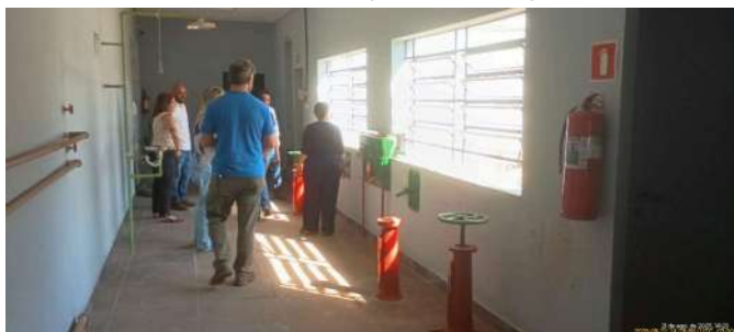
Foto 15 - Chuveiro de emergência e extintor de incêndio.
