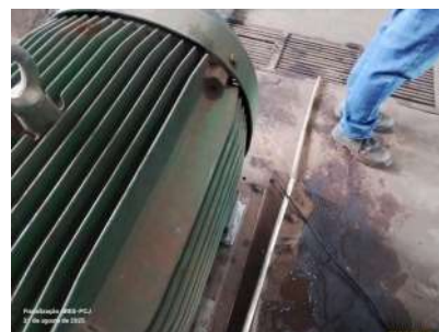
Foto 14 - Drenagem da gaxeta.
