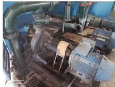
Foto 5 - Conjuntos motobomba da EEAT.
