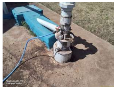
Foto 4 - Laje de proteção e tubo de medição de nível.
