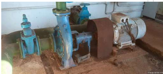
Foto 8 - Conjunto motobomba instalado.
