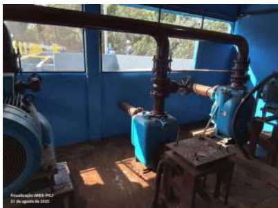
Foto 1 - Ausência do motor da bomba reserva.
