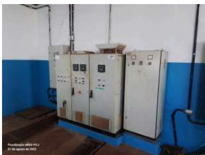
Foto 16 - Painéis elétricos e de comando do local.
