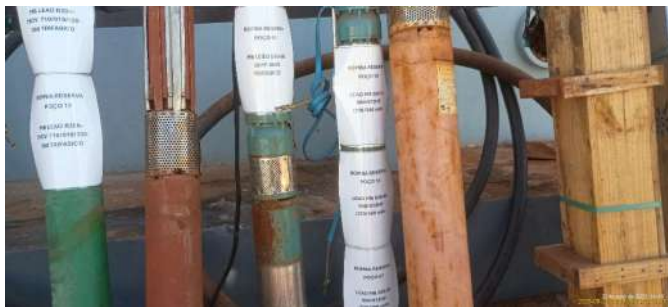
Foto 10 - Conjunto reserva para o Poço P1.
