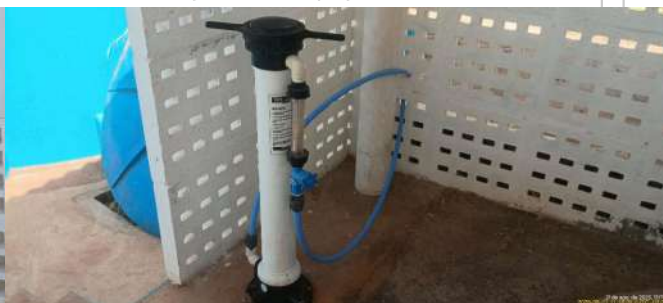
Foto 7 - Sistema de dosagem de produtos químicos na água captada do poço.
