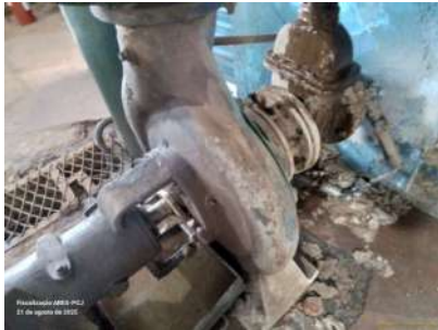
Foto 12 - Bomba do conjunto próximo à porta.
