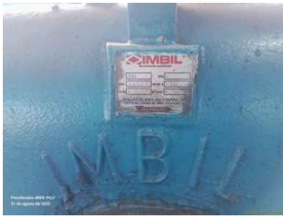
Foto 19 - Especificação da bomba do meio (reserva). Motor em manutenção.
