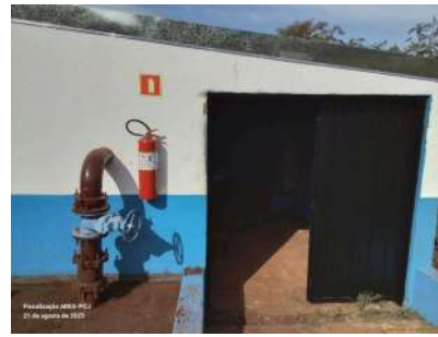
Foto 10 - Acesso ao sistema de bombeamento e extintor do local.
