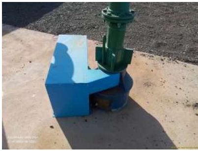
Foto 3 - Laje de proteção e tubo de medição de nível.
