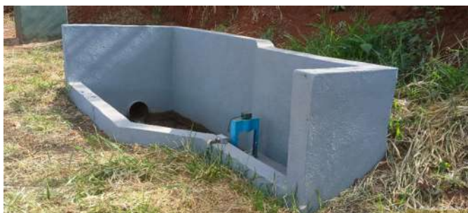
Foto 13 - Segunda chegada de esgoto (não passa pela elevatória) da ETE, com macromedidor.
