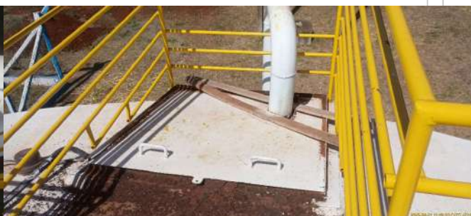
Foto 2 - Situação da tampa de inspeção.
