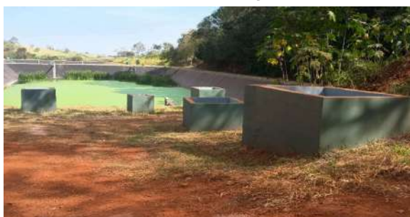
Foto 5 - Caixa de chegada do esgoto na primeira linha de lagoas e divisão das vazões entre as duas linhas.
