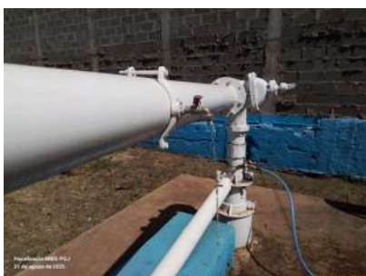
Foto 5 - Tomada de água bruta.
