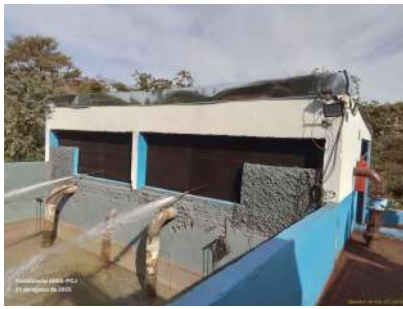
Foto 9 - Vista do abrigo do sistema de bombeamento.
