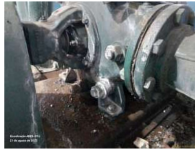
Foto 2 - Situação da água de lubrificação de gaxeta do equipamento distante da porta.
