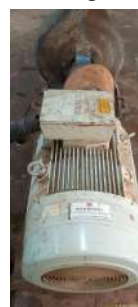
Foto 4 - Conjunto motobomba instalado.
