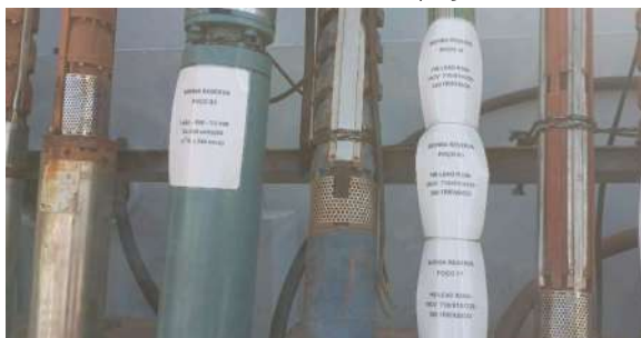
Foto 31 - Bombas reservas dos poços 3, 18, 6, 17 e 1.
