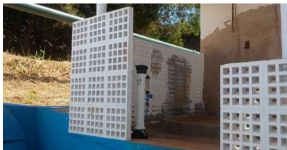
Foto 6 - Sistema de dosagem de produtos químicos na água captada do poço.
