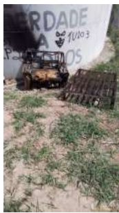
Foto 1 - Acúmulo de sujeira e marcas de incêndio na parede do reservatório.
