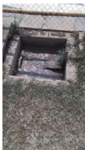
Foto 1 - Abertura com passagem de esgoto sem proteção.
