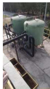
Foto 18 - Filtros de areia. Sem utilização.
