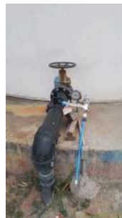
Foto 2 - Medidor de nível.
