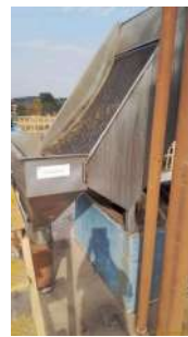
Foto 13 - Peneira para remoção de sólidos.
