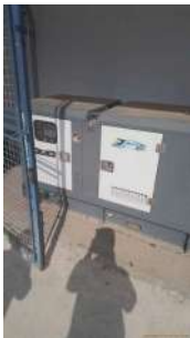
Foto 6 - Gerador de energia.
