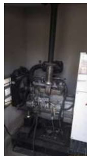
Foto 6 - Gerador de energia.
