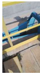
Foto 31 - Calha Parshall para medição do volume de esgoto tratado lançado. Ao esgoto tratado é adicionado hipoclorito de sódio.
