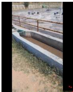
Foto 18 - Estrutura para retorno do lodo formado na decantação para as lagoas de aeração.
