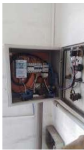
Foto 3 - Interior do painel de controle da EEA.
