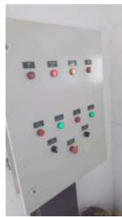
Foto 9 - Painele de controle da EEE.
