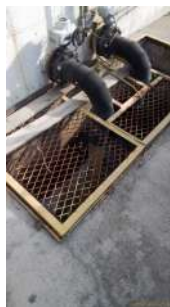
Foto 2 - Grades de proteção em estado de oxidação.
