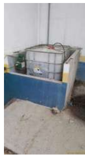
Foto 4 - Tanque de PAC.
