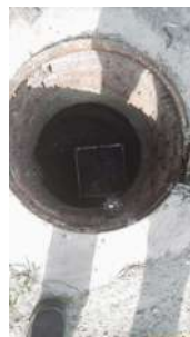
Foto 9 - Peneira para retenção de sólidos grosseiros. Localizada na parte externa da EEE.
