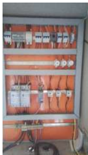
Foto 3 - Interior do painel de controle.
