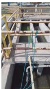
Foto 30 - Detalhe do tanque de contato.
