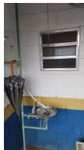
Foto 11 - Chuveiro de emergência.
