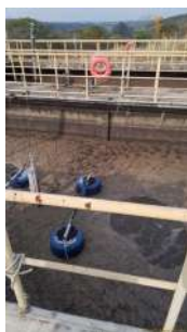
Foto 15 - Sistema com dois tanques de aeração operando em paralelo, realizando dois ciclos diários compostos por etapas anóxica, aeração, decantação e descarga.
