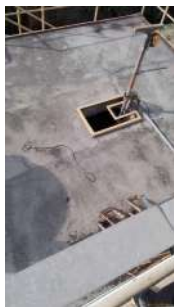
Foto 1 - Grades de proteção em estado de oxidação.
