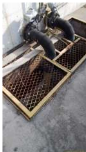
Foto 22 - Local de adição de hipoclorito de sódio.
