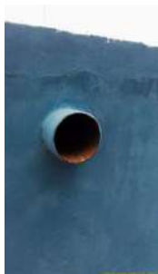
Foto 1 - Tubulação de ventilação sem tela de proteção.
