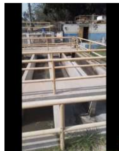
Foto 28 - Tanque de contato.
