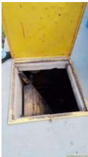
Foto 1 - Tampa de proteção para o acesso às motobombas.
