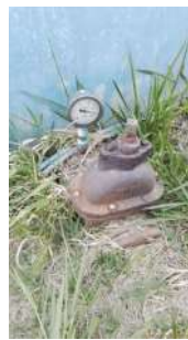
Foto 4 - Medidor de nível. Neste reservatório não foi implementado a telemetria.
