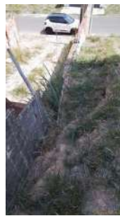
Foto 2 - Área sem proteção. Risco de acidente.
