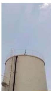
Foto 7 - Para-raios localizado no topo do reservatório.
