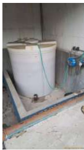
Foto 3 - Tanque de hipoclorito de sódio
