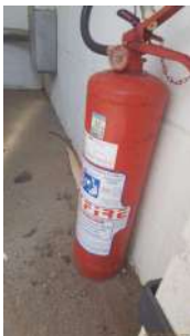
Foto 7 - Extintor de incêndio.
