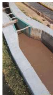
Foto 17 - Calha Parshall utilizada para medição do volume de esgoto.
