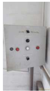
Foto 4 - Painel de controle da EEA.
