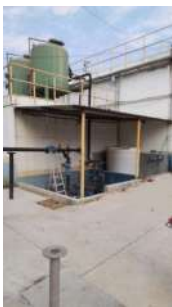
Foto 1 - Conjunto de bombas de recalque de água clarificada.
