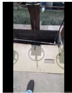
Foto 22 - Tubulação para dosagem do PAC.
