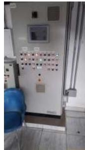
Foto 6 - Painele de controle da ETE.
