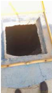
Foto 3 - Entrada de esgoto bruto.
