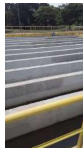
Foto 29 - Tanque de contato.
