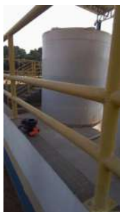
Foto 35 - Tanque de hipoclorito de sódio.
