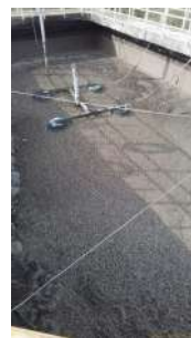
Foto 16 - Sistema com dois tanques de aeração operando em paralelo, realizando dois ciclos diários compostos por etapas anóxica, aeração, decantação e descarga.
