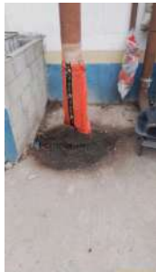
Foto 5 - Remoção de sólidos do excesso de esgoto que não passa na peneira. O filtrado é encaminhado para tratamento.
