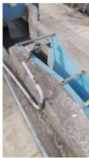
Foto 12 - Calha Parshall e sensor para medida de nível.
