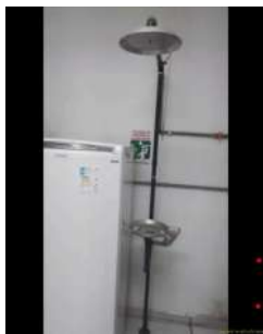
Foto 1 - O chuveiro está presente, mas o registro, devido a vazamentos, encontra-se desligado.
