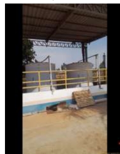
Foto 33 - Tanques de hipoclorito de sódio.
