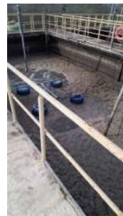
Foto 14 - Sistema com dois tanques de aeração operando em paralelo, realizando dois ciclos diários compostos por etapas anóxica, aeração, decantação e descarga.
