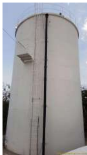
Foto 1 - Vista detalhada do reservatório.
