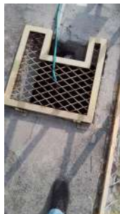
Foto 23 - Local de adição de antiespumante.
