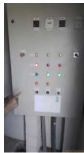
Foto 2 - Painel de controle da EEE.
