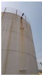
Foto 3 - Tubo extravasor. Em elevado estado de oxidação.
