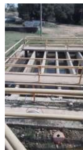
Foto 36 - Vista geral do tanque de contato.
