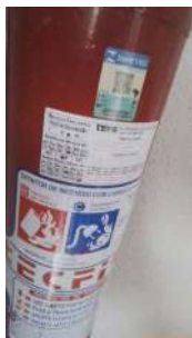
Foto 5 - Detalhe do prazo de validade do extintor, que encontra-se dentro do período vigente, conforme especificado na etiqueta.
