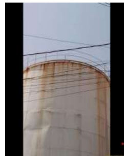
Foto 7 - Para-raios se encontra devidamente instalado.
