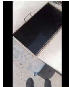
Foto 24 - Ponto de visitação da entrada do esgoto bruto.
