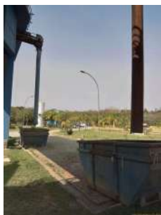
Foto 7 - Caçamba para retirada do material do gradeamento
