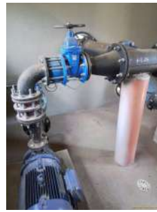
Foto 2 - Bomba do booster
