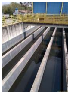
Foto 22 - Tanque de contato
