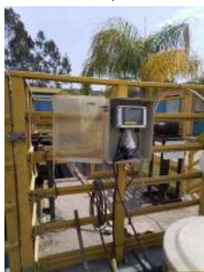
Foto 23 - Medidor de vazão de saída
