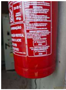
Foto 1 - Extintor de incêndio vencido em 2024
