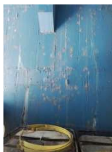
Foto 2 - Vazamentos aparentes em toda a estrutura do reator 1
