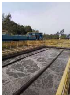
Foto 11 - Tanques de aerção
