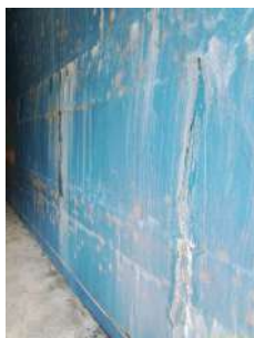
Foto 9 - Vazamento no reator 4
