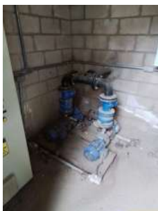
Foto 3 - Bomba em funcionamento
