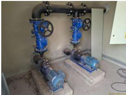
Foto 2 - Bombas da estação elevatória
