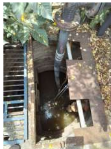
Foto 3 - Destaque para as tubulações
