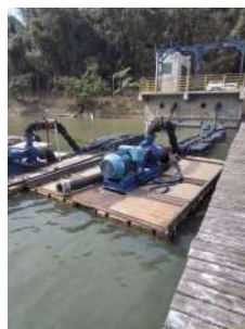
Foto 8 - Sistema de captação de água bruta
