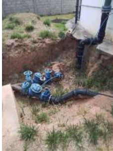
Foto 3 - Bombas do reservatório
