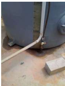
Foto 1 - Vazamento aparente no tanque
