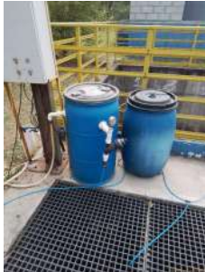
Foto 3 - Dosagem de produtos químicos
