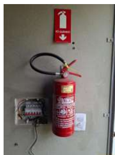
Foto 10 - Extintor instalado no subsistema
