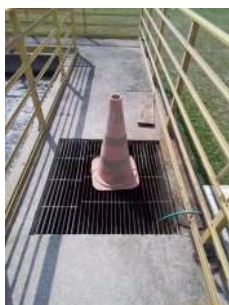
Foto 3 - Grade em más condições (aeradores)
