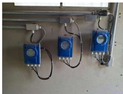
Foto 6 - Medidores de vazão
