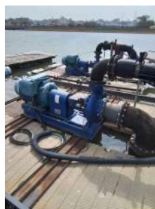
Foto 6 - Bombas do sistema de captação
