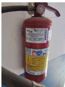
Foto 1 - Extintor da sala dos sopradores vencido
