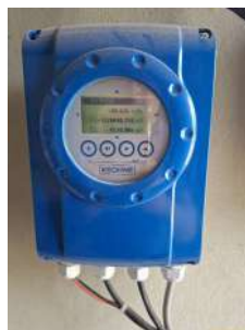
Foto 8 - Medidor de vazão
