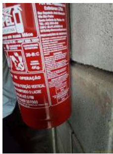
Foto 1 - Extintor de incêndio vencido em 2024
