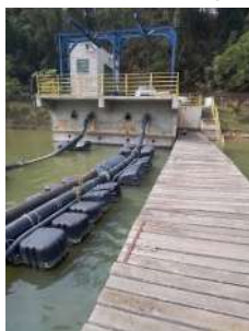
Foto 7 - Tubulação de entrada da água bruta
