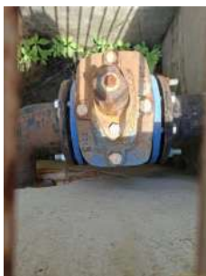
Foto 1 - Vazamento aparente em válvula
