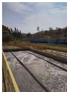
Foto 12 - Tanques de aerção
