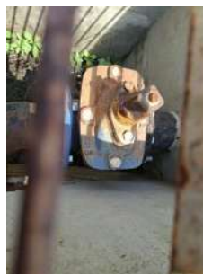
Foto 2 - Vazamento aparente em válvula
