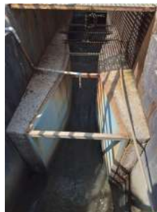
Foto 2 - Calha de entrada do efluente
