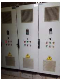
Foto 3 - Painéis elétricos do sistema de captação
