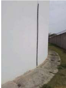
Foto 5 - Para-raios do reservatório
