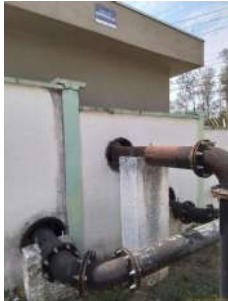
Foto 3 - Placa de identificação e tubulações
