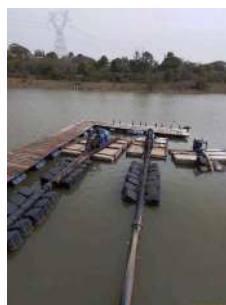
Foto 2 - Plataforma de captação de água
