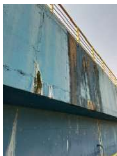
Foto 3 - Vazamentos aparentes em toda a estrutura do reator 1
