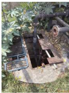
Foto 1 - Ausência de grade de proteção
