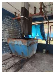
Foto 26 - Caçamba utilizada na secagem de lodo
