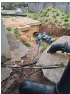
Foto 1 - Abertura na área das bombas, sem cercamento ou proteção
