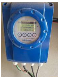
Foto 7 - Medidor de vazão
