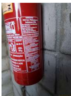
Foto 1 - Extintor de incêndio vencido em 2024
