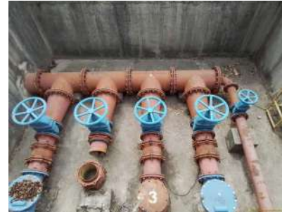
Foto 4 - Destaque para tubulações e conexões
