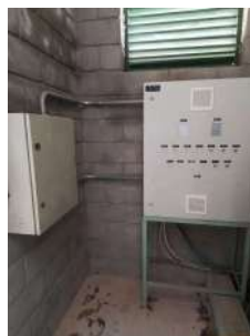
Foto 4 - Painéis elétricos do sistema de captação
