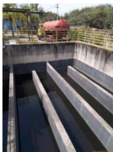
Foto 21 - Tanque de contato
