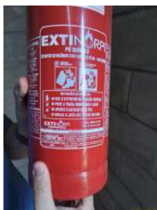
Foto 1 - Extintor de incêndio vencido em 2023
