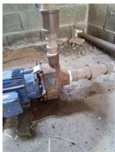
Foto 1 - Vazamento nas conexões
