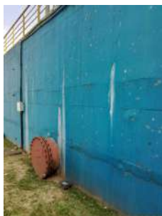
Foto 5 - Vazamentos aparentes em toda a estrutura do reator 1
