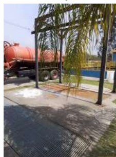
Foto 24 - Estação elevatória de esgoto tratado
