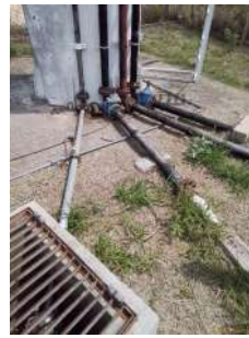
Foto 4 - Destaque para as tubulações
