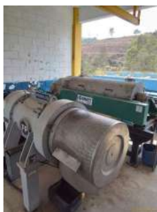
Foto 28 - Duas bombas operantes na secagem do lodo
