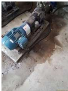
Foto 1 - Vazamento aparente na bomba
