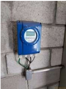
Foto 2 - Medidor de vazão
