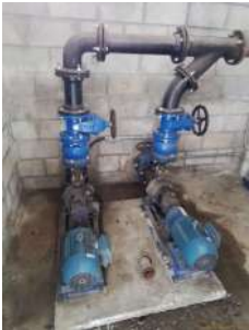
Foto 3 - Bombas do booster
