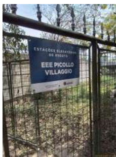
Foto 1 - Placa de identificação da elevatória de esgoto
