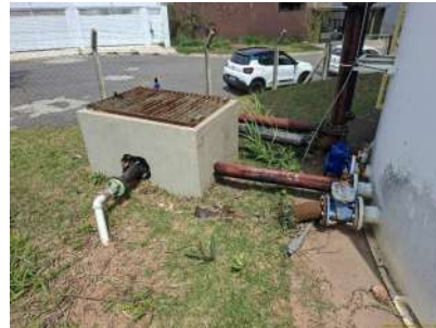
Foto 4 - Destaque para as tubulações do reservatório
