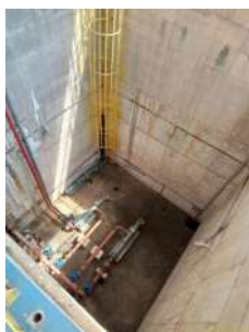
Foto 31 - Bombas de chegada do lodo
