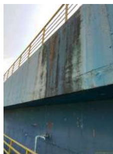
Foto 8 - Vazamentos aparentes em toda a estrutura do reator 3 (fluido extravasa pela estrutura)
