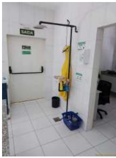
Foto 37 - Chuveiro de emergência
