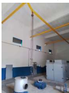
Foto 15 - Sala dos sopradores
