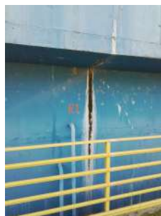
Foto 4 - Vazamentos aparentes em toda a estrutura do reator 1
