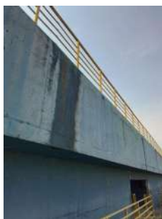
Foto 7 - Vazamentos aparentes em toda a estrutura do reator 2
