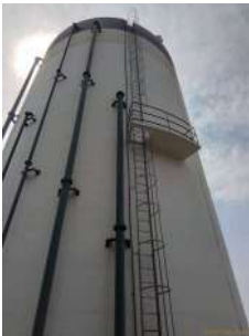
Foto 3 - Destaque para tubulações e escada de acesso
