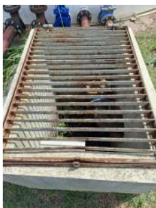
Foto 5 - Grades de proteção da tubulação e registros
