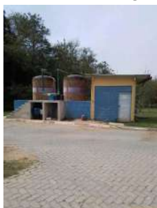
Foto 33 - Tanques de soda
