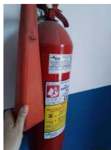
Foto 2 - Extintor da sala com painéis elétricos vencido
