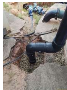
Foto 2 - Abertura na área das bombas, sem cercamento ou proteção
