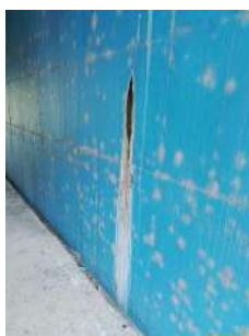
Foto 1 - Vazamentos aparentes em toda a estrutura do reator 1
