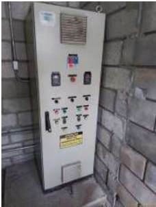
Foto 4 - Pannel elétrico do booster
