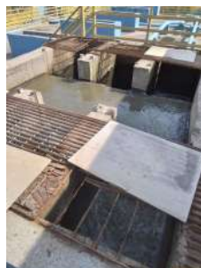
Foto 2 - Grade faltante nos reatores (1 e 2)
