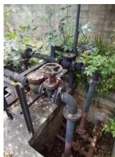
Foto 2 - Tubulações e registros
