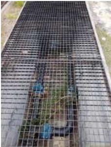
Foto 3 - Destaque para as tubulações
