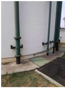
Foto 5 - Destaque para as tubulações do reservatório
