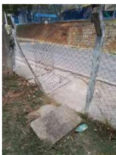
Foto 1 - Cercamento da área danificado
