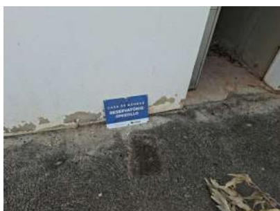
Foto 1 - Placa de identificação não está instalada
