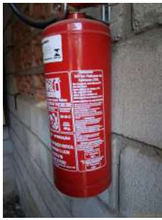
Foto 1 - Extintor de incêndio vencido em 2024
