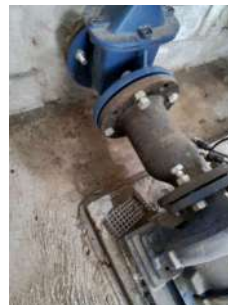
Foto 2 - Vazamento aparente na bomba
