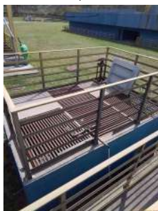
Foto 13 - Grades de proteção
