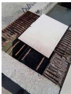
Foto 1 - Grade faltante nos reatores (1 e 2)
