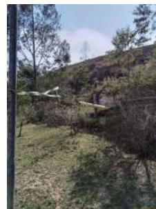
Foto 2 - Tela do alambrado atrás dos reatores está avariada
