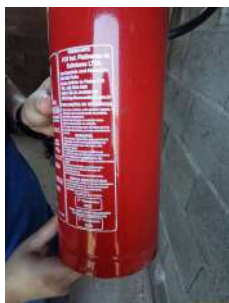
Foto 1 - Extintor vencido em 2024
