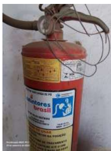
Foto 1 - Único extintor de incêndio evidenciado na unidade fiscalizada. Apresenta prazo de validade vencido.
