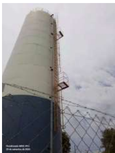
Foto 3 - Guarda corpo nas escadas do reservatório.
