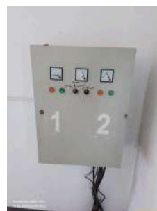
Foto 4 - Quadro de comando da EEA.
