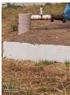
Foto 1 - Vazamento no registro próximo a base do reservatório.
