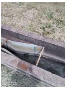
Foto 1 - Detalhe mostrando calha Parshall na entrada da primeira lagoa com régua para medição de vazão ilegível.
