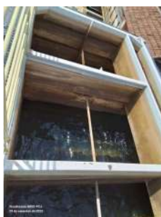
Foto 10 - Vista da filtração da unidade compacta.
