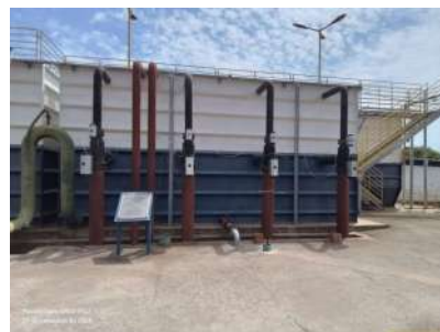
Foto 3 - Vista geral da unidade compacta modular
