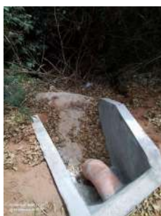
Foto 16 - Tubulação de saída da ETE, após o tanque de contato.
