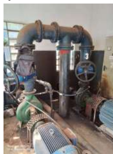
Foto 7 - Conjuntos moto bomba da captação
