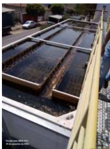
Foto 14 - Vista geral decantadores lamelares da unidade compacta.
