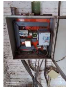
Foto 4 - Vista interna do quadro de comando da EEA.
