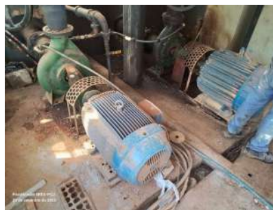
Foto 6 - Conjuntos moto-bomba da captação.
