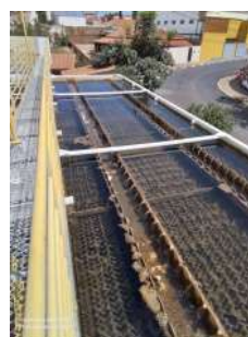
Foto 2 - Decantador da unidade compacta. De acordo com o prestador, há necessidade de manutenção no mecanismo usado para lavagem do decantador.
