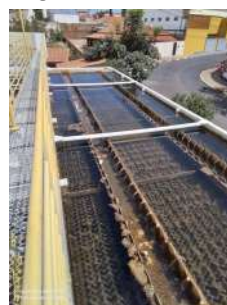
Foto 9 - Decantador lamelar da unidade compacta.
