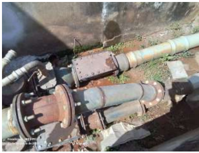
Foto 1 - Presença de vazamentos na tubulação que sai da casa de bombas.
