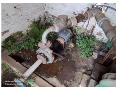
Foto 1 - Vegetação crescendo dentro do abrigo da EEA.
