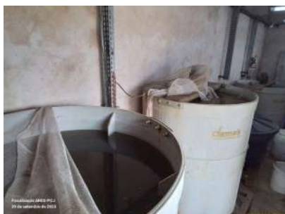
Foto 1 - Reservatório contendo PAC aberto, exposto a contaminação externa.
