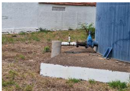
Foto 2 - Vazamento no registro próximo a base do reservatório.
