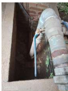
Foto 5 - Tubulação onde a água chega na EEA.
