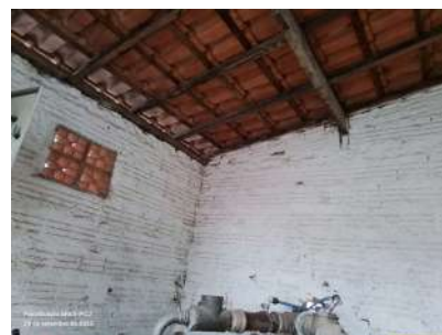
Foto 6 - Vista geral interior do abrigo onde está a EEA.
