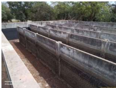
Foto 3 - Caixa de contato vazia para manutenção.
