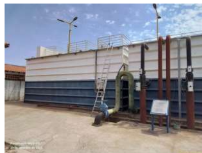
Foto 2 - Vista geral da unidade compacta modular.
