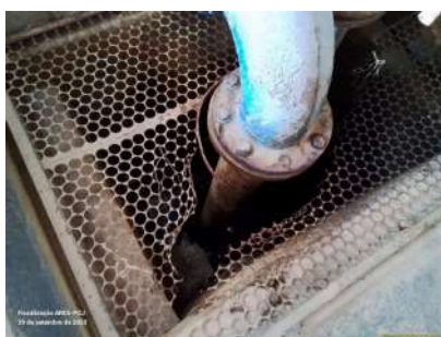
Foto 1 - Foi possível verificar que a caixa onde ocorre a mistura da água tratada para adição de desinfetante e flúor apresenta formação de lodo em suas paredes internas. Verifica-se também tubulação com corrosão em contato com a água tratada.
