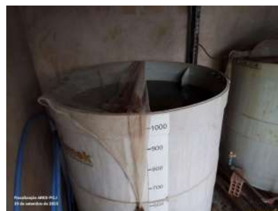
Foto 2 - Reservatório contendo PAC aberto, exposto a contaminação externa.
