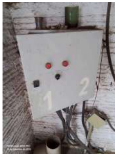
Foto 3 - Quadro de comando da EEA.
