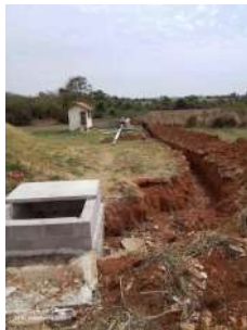
Foto 1 - Efluente da segunda lagoa de estabilização desviado da caixa de contato (desinfecção).
