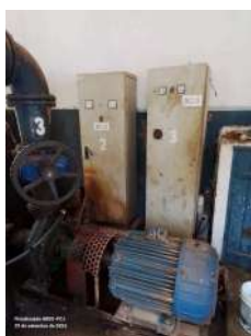
Foto 8 - Conjunto moto bomba com quadros de comando ao fundo.
