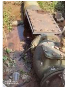
Foto 2 - Presença de vazamentos na tubulação que sai da casa de bombas.
