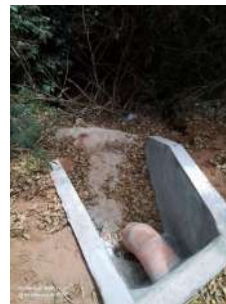
Foto 4 - Saída da caixa de contato.
