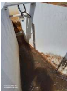
Foto 12 - Calha Parshall para medição de vazão na entrada da unidade compacta.
