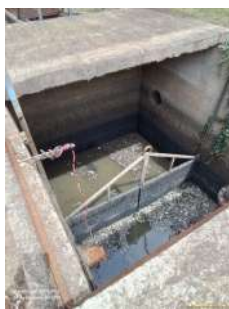
Foto 18 - Gradeamento na elevatória na entrada da ETE.
