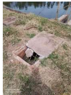
Foto 4 - Tampa quebrada em uma caixa de inspeção próximo às lagoas.
