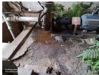
Foto 2 - Acúmulo de água de lubrificação de gaxeta sobre o piso.
