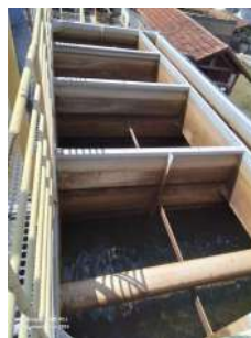
Foto 15 - Vista da filtração na unidade compacta.
