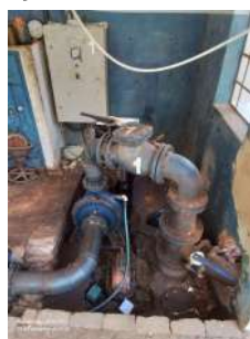
Foto 9 - Conjunto moto bomba da captação com quadro de comando ao fundo.
