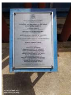
Foto 4 - Placa com identificação da unidade compacta modular.
