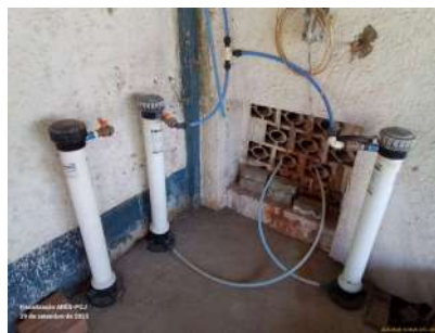
Foto 20 - Dosadores de produto químico para desinfecção da água na saída da ETA.
