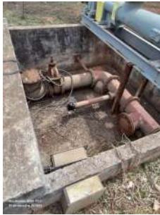
Foto 1 - Há somente um conjunto de bomba submersa na elevatória na entrada da ETE.
