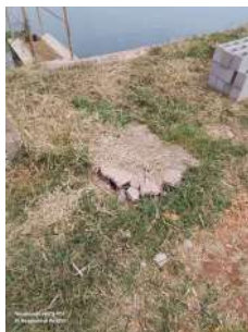
Foto 5 - Tampa quebrada em outra caixa de inspeção próximo às lagoas.
