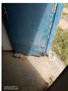
Foto 1 - Danos na porta do local que abriga a EEA.
