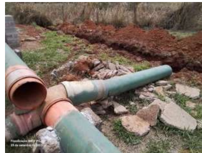
Foto 2 - Efluente da segunda lagoa de estabilização desviado da caixa de contato (desinfecção).
