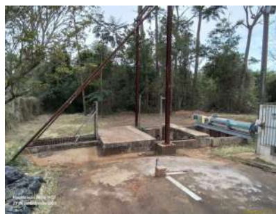
Foto 19 - Vista geral da elevatória na entrada da ETE
