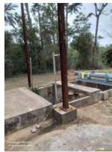
Foto 2 - Estrutura metálica com corrosão na elevatória da entrada da ETE.
