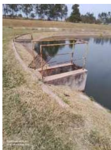
Foto 1 - Guarda corpo com corrosão e quebrado numa das lagoas.
