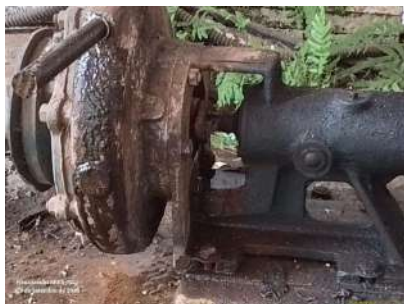
Foto 1 - Água da lubrificação de gaxetas com drenagem inadequada.
