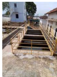
Foto 6 - Vista geral filtração da unidade convencional.
