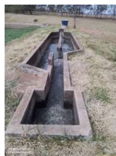
Foto 4 - Caixa de areia na entrada da ETE.
