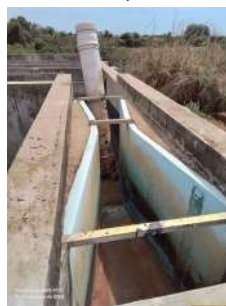
Foto 13 - Calha Parshall para medição na saída do tanque de contato (em manutenção).
