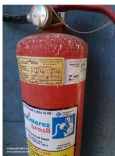
Foto 1 - Extintor de incêndio com validade das manutenções vencidas.
