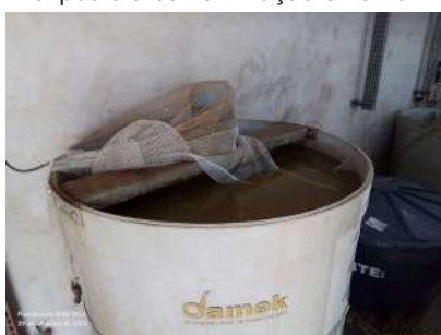
Foto 3 - Reservatório contendo PAC aberto, exposto a contaminação externa.
