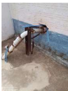
Foto 7 - Tubulação saída de água da EEA.
