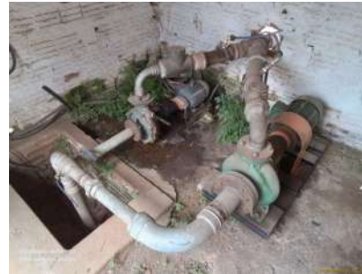
Foto 2 - Conjunto moto bomba principal e reserva.
