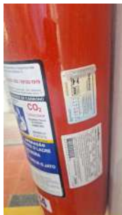
Foto 9 - Extintor de incêndio com validade regular
