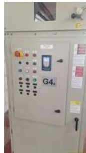
Foto 8 - Painel de controle - casa de bombas 1
