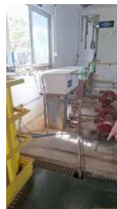
Foto 8 - Dosagem de coagulante PAC
