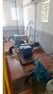
Foto 4 - Três conjuntos motobomba
