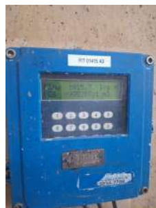
Foto 27 - Macromedidor da água filtrada
