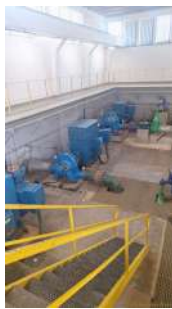
Foto 11 - conjuntos motobomba - casa de bombas 2
