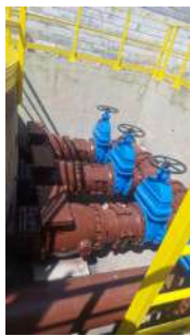
Foto 6 - Linhas de recalque
