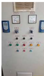
Foto 7 - Painele de acionamento das bombas
