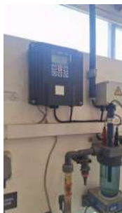
Foto 13 - Controle de dosagem do fluor
