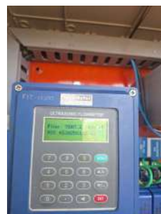
Foto 2 - Macromedidor de entrada
