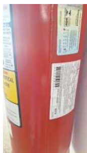
Foto 18 - Extintor de incêndio com validade regular
