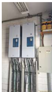
Foto 11 - Inversores de frequência bomba 1 e 2
