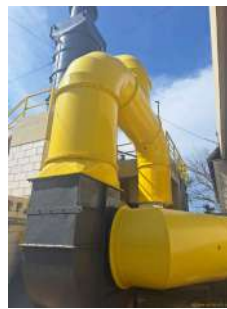
Foto 5 - Lavador de gás cloro
