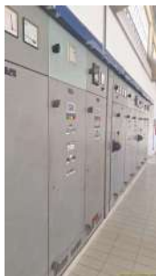
Foto 19 - painéis dos conjuntos motobomba casa 3
