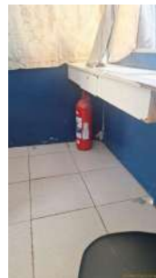
Foto 10 - Extintor na área de guarita
