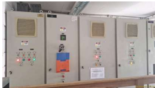
Foto 10 - Painéis das bombas
