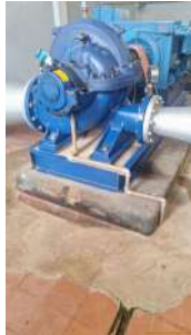
Foto 5 - Drenagem da gaxeta
