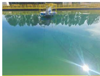
Foto 13 - Decantador com raspador de fundo
