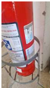
Foto 9 - Extintor de incêndio na área de convivência
