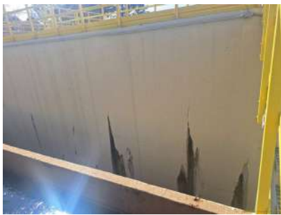
Foto 3 - Pontos de infiltração - Tanque onde há chegada de água bruta
