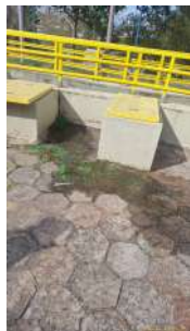
Foto 1 - Vazamento aparente no canal de água bruta
