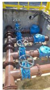
Foto 5 - Linhas de recalque das bombas submersíveis
