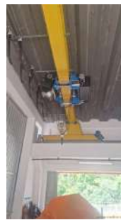
Foto 12 - Talha de içamento - acesso para manutenção
