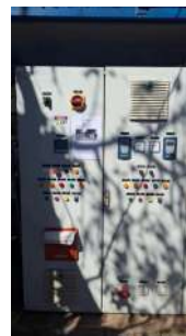
Foto 9 - Pannel dos conjuntos motobomba
