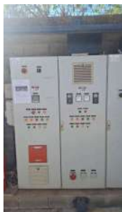
Foto 10 - Painéis das bombas
