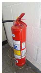
Foto 8 - Extintor de incêndio com validade regular
