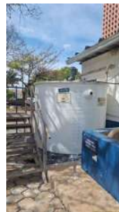
Foto 16 - Tanque de geocálcio
