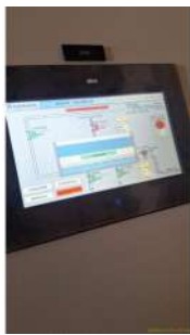
Foto 19 - controle de nível - ETA 1 - filtro 7
