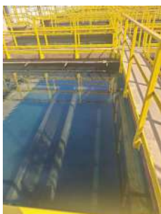
Foto 12 - Filtros da ETA 3
