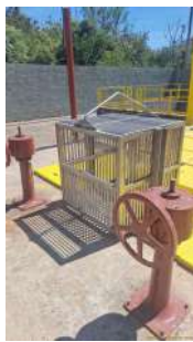
Foto 5 - Cesto de gradeamento
