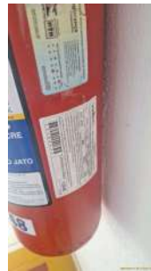
Foto 18 - Extintor de incêndio com validade regular - casa 3
