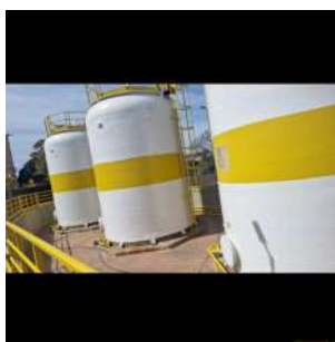
Foto 17 - Hipoclorito de sódio _ armazenamento
