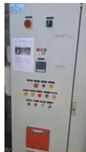
Foto 7 - Pannel de acionamento das bombas
