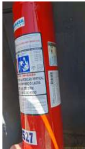
Foto 11 - Extintor com validade regular
