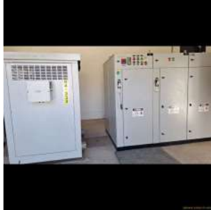
Foto 9 - Estação de energia e trafo
