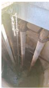
Foto 4 - Poço de sucção e três bombas submersíveis
