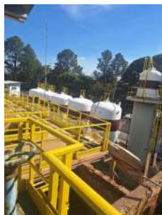
Foto 18 - Tanques de PAC
