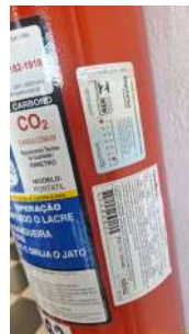
Foto 8 - Extintor de incêndio com validade regular
