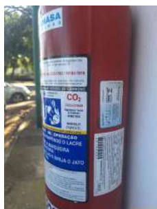
Foto 28 - Extintor de incêndio com validade regular
