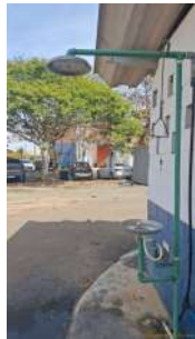
Foto 21 - Chuveiro de emergência
