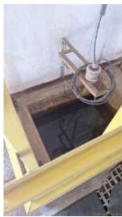
Foto 9 - Macromedidor de entrada
