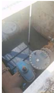
Foto 7 - Caixa de registro da linha de recalque
