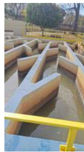
Foto 2 - Canal de dispersão do coagulante
