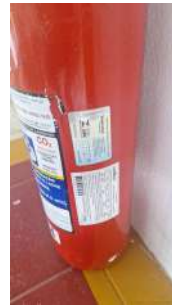
Foto 24 - Extintor de incêndio - casa de bombas 4
