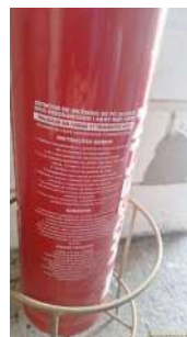
Foto 12 - Extintor com validade regular
