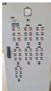
Foto 19 - Ccaixa de lavagem dos filtros
