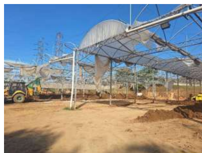
Foto 29 - Estação de tratamento de lodo - Estufas de secagem
