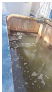
Foto 7 - Entrada da ETA e pré-cloração
