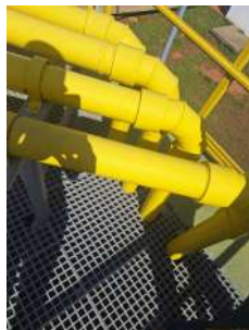
Foto 16 - Dosagem de cloro
