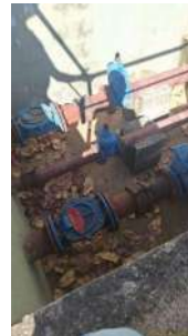
Foto 7 - Linhas de recalque
