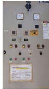
Foto 2 - Painel de acionamento das bombas
