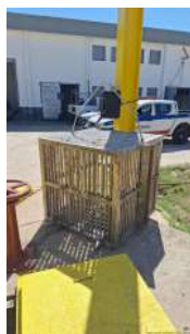
Foto 3 - Cesto de gradeamento
