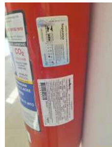
Foto 21 - Extintor de incêndio com validade regular
