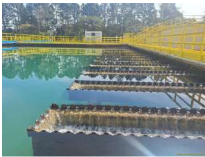
Foto 14 - Vertedores do decantador da ETA 3
