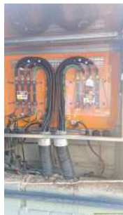
Foto 9 - Painel dos cabos das bombas
