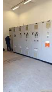
Foto 10 - Painéis de bombas
