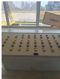
Foto 20 - Painel de controle de lavagem dos filtros
