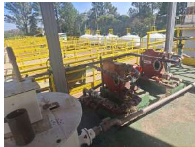
Foto 17 - Bombas de dosagem do PAC
