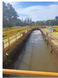
Foto 15 - Entrada de água bruta
