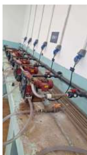
Foto 16 - Bombas de dosagem de hipoclorito de sódio
