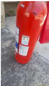
Foto 4 - Extintor de incêndio com validade regular
