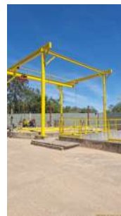
Foto 2 - Pórtico para acesso para manutenção das bombas
