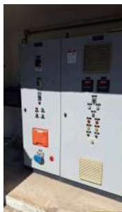
Foto 8 - Painéis de acionamento das bombas
