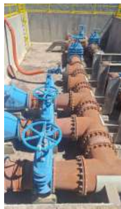
Foto 3 - Linhas de recalque
