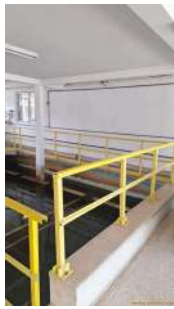
Foto 1 - Guarda-corpos junto ao filtro 1 com deficiência de fixação ou fixação inadequada
