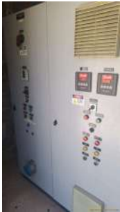
Foto 3 - Painéis de acionamento
