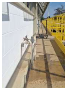
Foto 4 - Ponto de vazamento na região dos filtros
