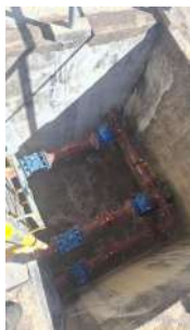
Foto 6 - Linha de recalque
