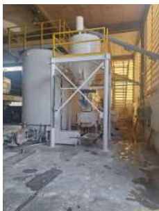
Foto 8 - Tanques de preparo de cal
