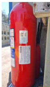
Foto 6 - Extintor de incêndio com validade regular
