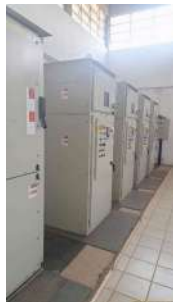
Foto 25 - Painéis inversores - casa de bombas 4
