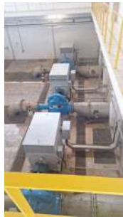
Foto 23 - Conjuntos instalados - casa de bombas 4
