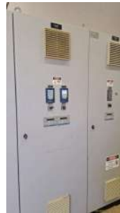
Foto 8 - inversores de frequência
