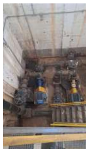
Foto 9 - Conjuntos motobomba 1 e 2
