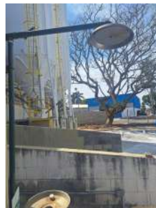
Foto 7 - Chuveiro de emergência
