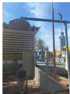
Foto 11 - Chuveiro da área de armazenamento de fluor
