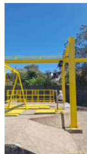
Foto 9 - Pórtico para içamento de bombas para manutenção
