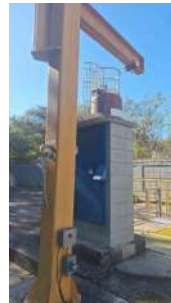
Foto 8 - Pórtico para içamento da bomba submersível - atualmente utiliza caminhão munck
