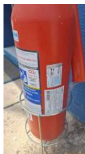
Foto 18 - Extintor com validade regular
