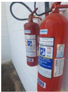
Foto 4 - Extintor de incêndio
