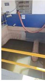
Foto 1 - Poço de Sucção 3 - casa de bombas 1
