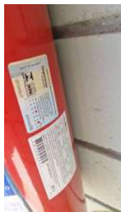
Foto 8 - Extintor com validade regular
