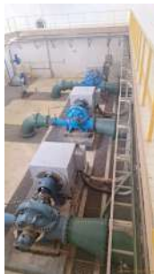
Foto 17 - Três conjuntos motobomba
