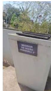
Foto 4 - Ponto de inserção de régua para macromedição
