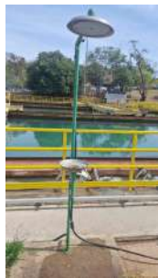
Foto 5 - Chuveiro de emergência
