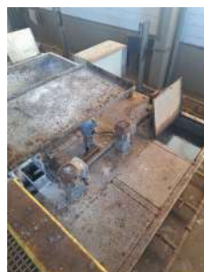
Foto 33 - Tanque de preparo de polímero catiônico
