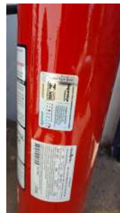
Foto 7 - Extintor de incêndio com validade regular
