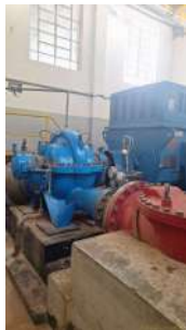
Foto 7 - Conjunto 4 _ 420 l/s - casa de bombas 1
