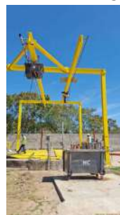
Foto 4 - Talha para retirada do cesto e acesso para manutenção
