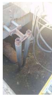
Foto 6 - Poço de sucção
