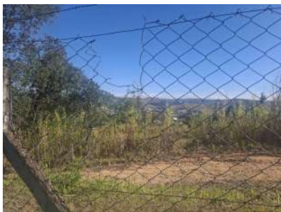
Foto 2 - Aberturas no alambrado
