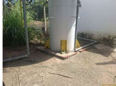
Foto 2 - Base do reservatório
