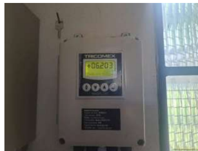
Foto 4 - Display do medidor de vazão
