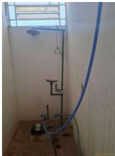
Foto 1 - Chuveiros de emergência
