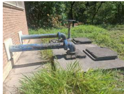
Foto 2 - Tubulação de sucção
