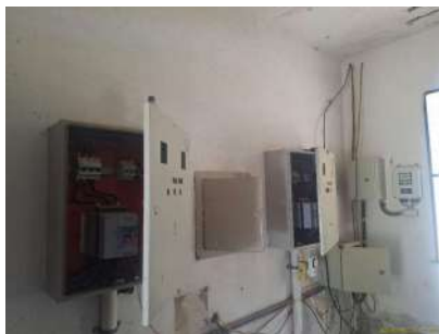
Foto 3 - Painel de comando e controle
