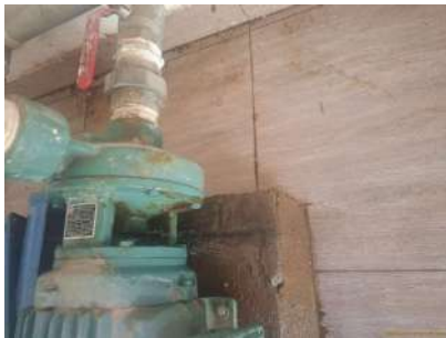
Foto 1 - Vazamento no selo mecânico
