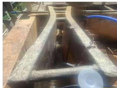
Foto 14 - Chegada da água bruta
