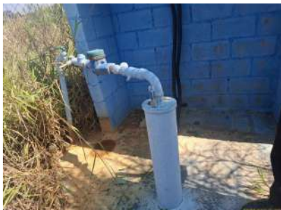
Foto 1 - Cavalete do poço
