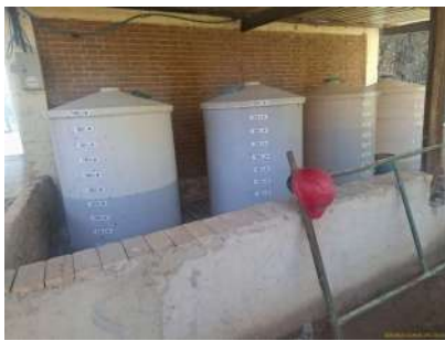
Foto 10 - Armazenamento de PAC e hipoclorito de sódio
