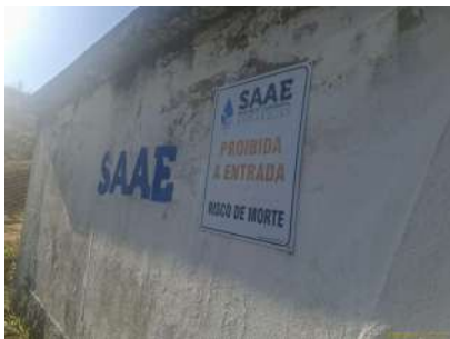
Foto 2 - Reservatório Jardim Itália
