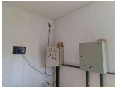
Foto 3 - Pannel de comando e controle
