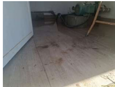
Foto 2 - Interior da EEA alagado
