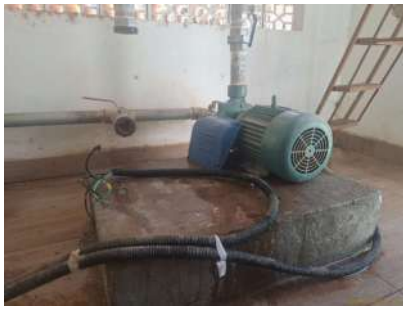
Foto 1 - Ausência de motobomba reserva
