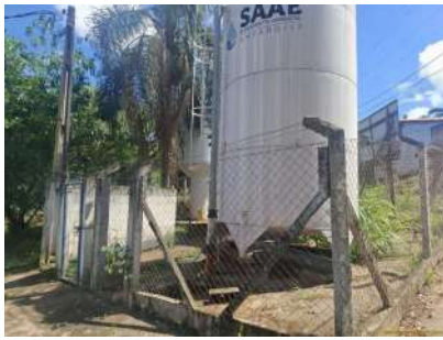
Foto 1 - Reservatório recalque Serra das Estâncias
