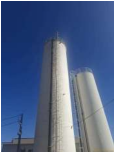
Foto 2 - Vista dos reservatórios Village Di Fiorri e recalque Empire Palm
