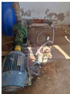
Foto 1 - Ausência de bomba reserva
