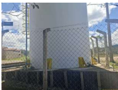
Foto 3 - Base do reservatório
