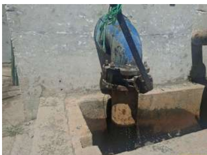
Foto 1 - Registro 2 na saída dos filtros
