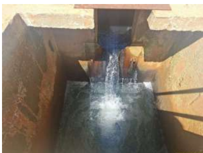
Foto 17 - Saída do filtro
