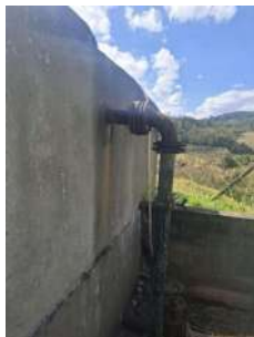
Foto 3 - Medidor de nível
