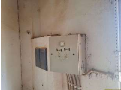
Foto 3 - Painel de comando e controle
