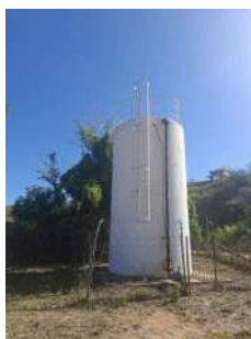
Foto 1 - Reservatório Empire Palm
