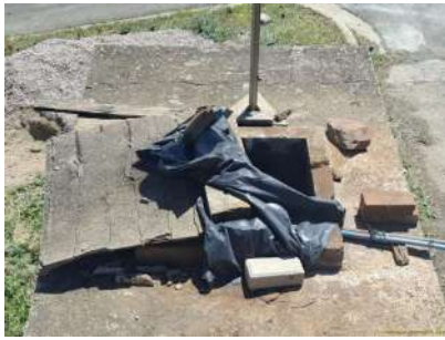
Foto 1 - Ausência de tampa (23/10/2025)
