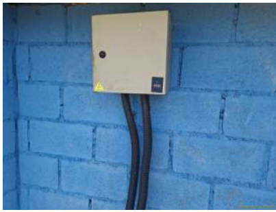
Foto 5 - Painel de comando e controle
