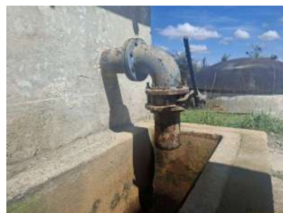
Foto 2 - Registro 1 na saída dos filtros
