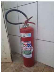
Foto 5 - Extintor de incêndio
