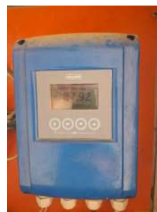
Foto 10 - Display do medidor de vazão de entrada
