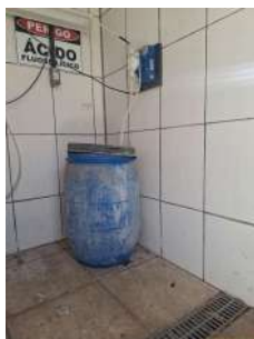
Foto 7 - Armazenamento e dosagem do flúor
