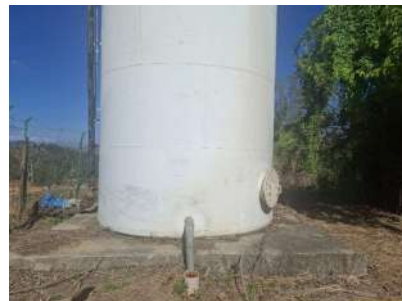
Foto 4 - Base do reservatório
