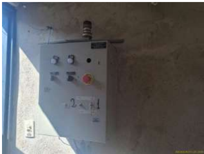
Foto 3 - Painel de comando e controle
