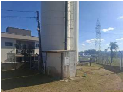
Foto 1 - Vista externa da EEA. Parque do Sol e reservatórios
