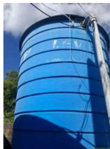
Foto 2 - Reservatório de recalque Bosque dos Eucaliptos
