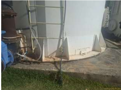
Foto 3 - Base do reservatório
