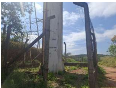
Foto 1 - Ausência de portão de acesso
