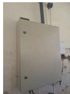
Foto 6 - Painele de comando e controle
