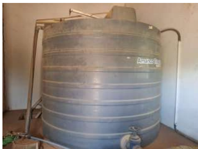
Foto 1 - Reservatório de recalque Vista Alegre
