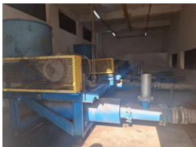
Foto 7 - Casa de sopradores
