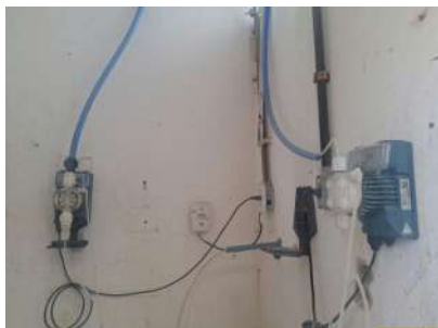
Foto 9 - Bombas dosadoras de cloro e PAC
