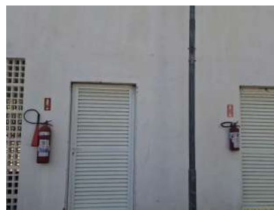
Foto 6 - Extintor de incêndio
