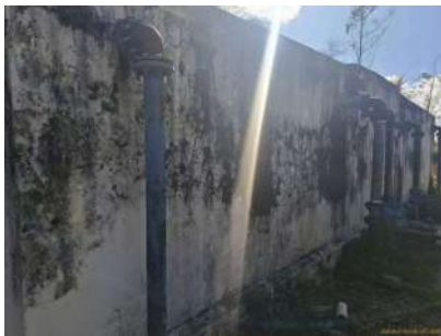
Foto 1 - Reservatório Parque do Sol
