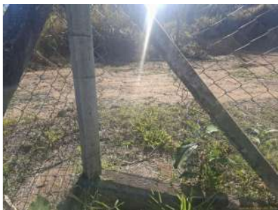
Foto 1 - Aberturas no alambrado
