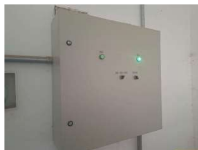
Foto 2 - Pannel de Comando e Controle
