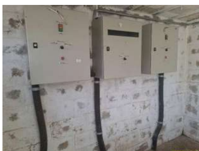
Foto 3 - Painel de comando e controle
