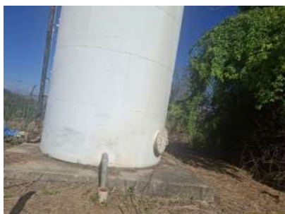
Foto 1 - Ausência de cercamento da área
