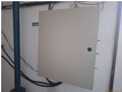
Foto 3 - Painel de comando e controle
