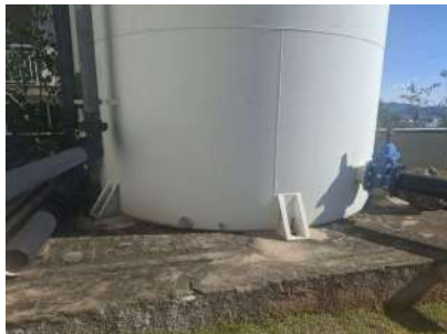
Foto 3 - Base do reservatório
