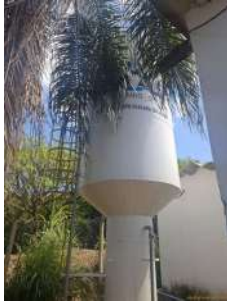
Foto 1 - Reservatório de recalque Chácara das Águas
