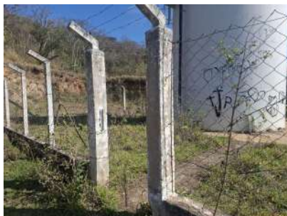
Foto 1 - Ausência de portão de acesso
