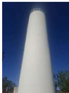
Foto 2 - Reservatório recalque Empire Palm
