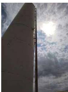
Foto 1 - Detalhe da escada sem guarda-corpos.
