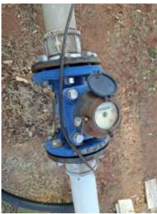
Foto 1 - Detalhe do macromedidor.
