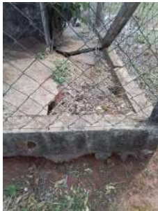
Foto 1 - Detalhe da laje danificada.
