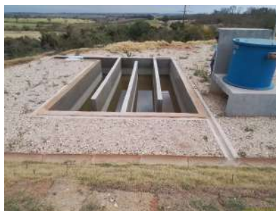
Foto 13 - Local onde será feita a desinfecção do efluente tratado.
