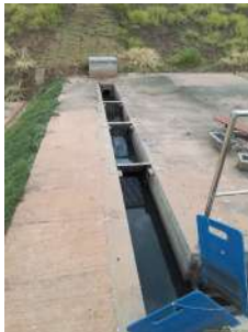
Foto 3 - Chegada do esgoto bruto.
