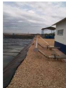
Foto 8 - Tubulação dos sopradores.
