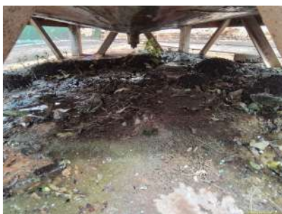
Foto 1 - Vazamento sob o reservatório.
