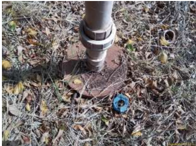
Foto 1 - Não há tubo de medição de nível.
