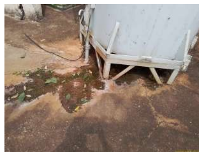
Foto 2 - Acúmulo da água oriunda do vazamento.
