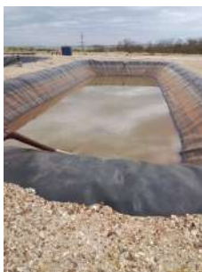
Foto 11 - Lagoa onde ficará o lodo acumulado a ser bombeado para as centrífugas.
