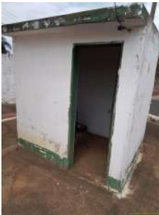
Foto 1 - Vista da elevatória.
