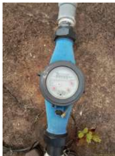
Foto 1 - Detalhe do medidor.
