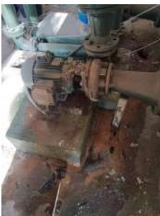
Foto 1 - Vazamento na conexão.
