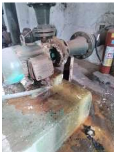
Foto 2 - Detalhe 2 do acúmulo de água.
