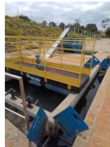
Foto 4 - Caixa de areia.
