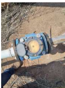
Foto 1 - Detalhe do medidor.
