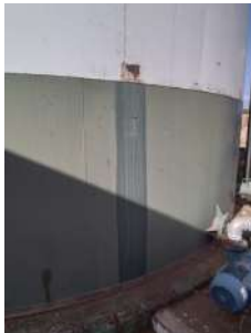
Foto 1 - Vazamento na lateral.
