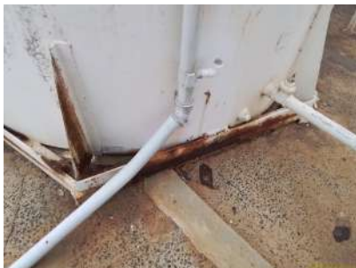
Foto 1 - Detalhe da corrosão na base do reservatório.
