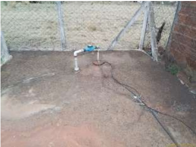
Foto 2 - Cavalete do poço.
