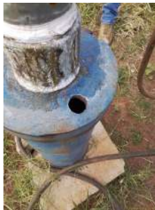
Foto 1 - Detalhe do cavalete e local para instalação do tubo de medição de nível.
