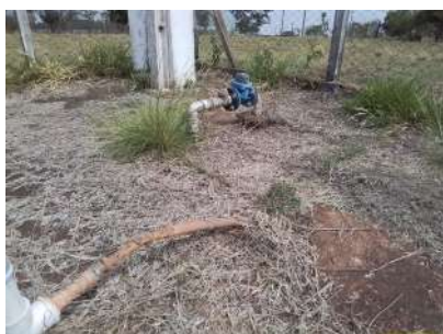
Foto 1 - Acúmulo de vegetação sobre a laje do poço.
