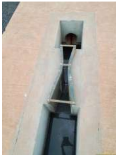
Foto 5 - Calha Parshall após a caixa de areia.
