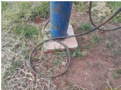
Foto 1 - Ausência de laje de proteção.
