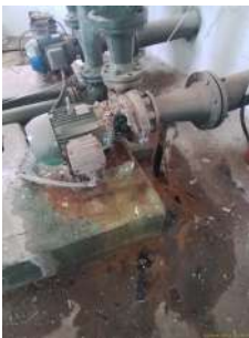
Foto 1 - Detalhe 1 do acúmulo de água.
