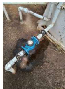
Foto 6 - Macromedidor junto ao reservatório.
