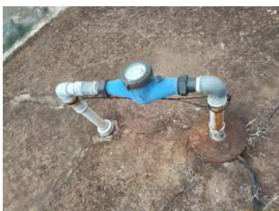
Foto 1 - Detalhe do cavalete sem a tomada de água.
