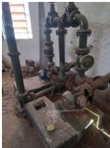
Foto 3 - Conjunto moto-bomba da EEA.
