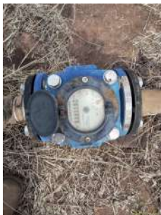
Foto 1 - Detalhe do medidor.
