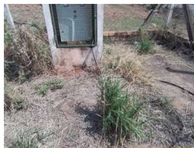
Foto 2 - Acúmulo 2 de vegetação no local.
