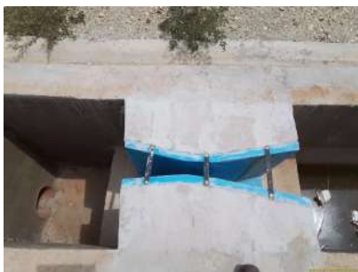
Foto 14 - Calha Parshall na saída da ETE.
