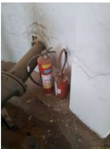
Foto 4 - Extintores junto à EEA.
