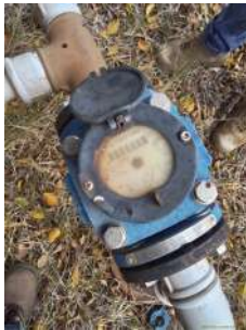
Foto 1 - Há um macromedidor instalado no poço, entretanto, conforme relatado pelo prestador, o medidor não funciona.
