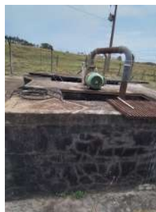
Foto 2 - Detalhe da EEE.
