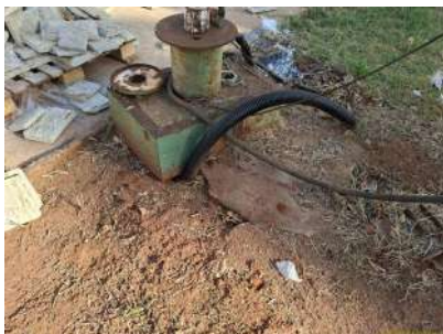
Foto 1 - A laje de proteção encontrava-se danificada na data da fiscalização, sendo necessária a sua adequada manutenção.
