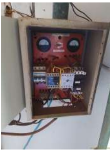
Foto 3 - Painel elétrico da EEA.
