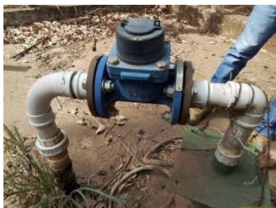
Foto 1 - Não há qualquer tomada de água para coleta de água bruta.
