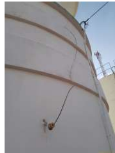
Foto 4 - Condutor de descida.
