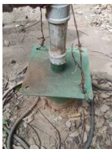
Foto 1 - Não há tubo de medição de nível.
