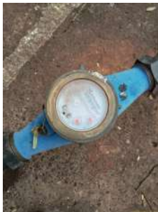
Foto 1 - Detalhe do medidor.
