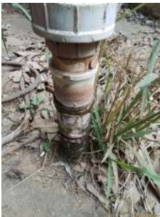
Foto 1 - Vazamento na base do cavalete.
