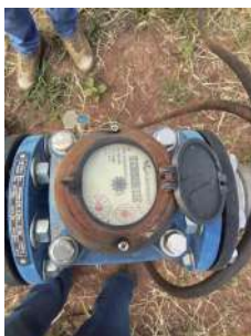
Foto 1 - Detalhe do medidor.
