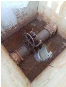
Foto 2 - Vazamento na saída do reservatório.
