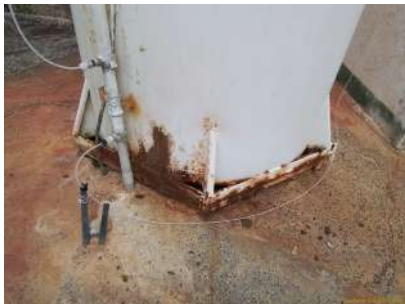
Foto 1 - Detalhe da corrosão na base do reservatório.
