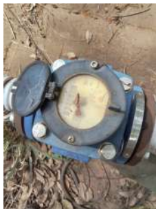
Foto 1 - Detalhe do medidor.
