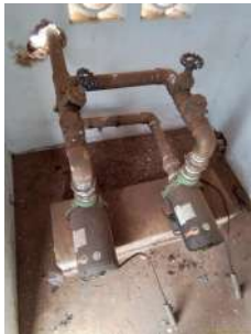
Foto 2 - Detalhe das bombas (1+1R).
