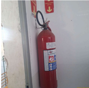
Foto 9 - Extintor de incêndio
