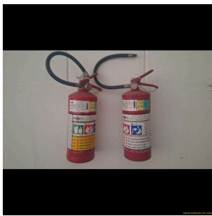
Foto 5 - Extintores de incêndio
