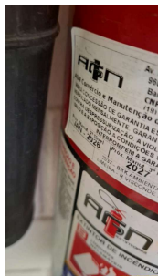
Foto 11 - Extintor dentro da validade
