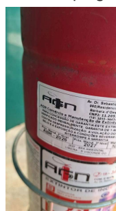
Foto 6 - Extintor de incêndio, dentro da validade
