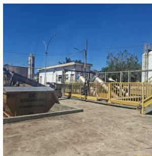
Foto 2 - Vista lateral das peneiras rotativas
