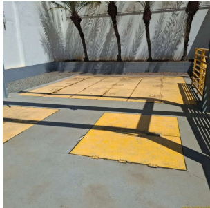
Foto 5 - Poço de sucção
