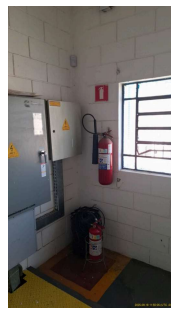
Foto 10 - Extintor de incêndio
