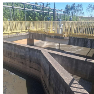
Foto 15 - Vista superior do tratamento físico-químico
