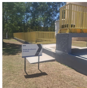
Foto 23 - Vista lateral da saída do esgoto tratado
