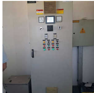
Foto 8 - Pannel de comando e controle
