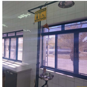
Foto 19 - Chuveiro de emergência
