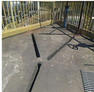
Foto 1 - Ausência de grade de proteção nas aberturas
