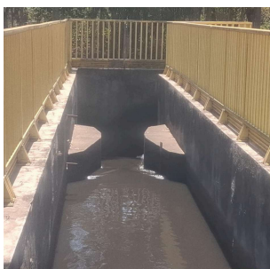
Foto 24 - Vista da saída do esgoto tratado
