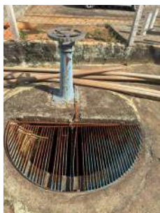
Foto 1 - Grade em mau estado de conservação
