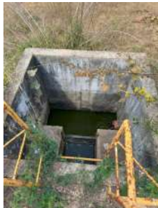
Foto 9 - Caixa de esgoto tatado
