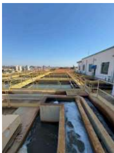
Foto 11 - Vista geral da ETA
