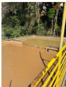
Foto 29 - Armazenamento de lodo
