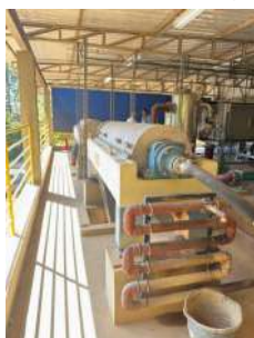
Foto 27 - Tratamento de lodo
