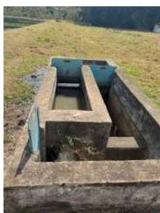
Foto 1 - Vazamento/transbordamento na caixa de entrada
