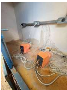
Foto 6 - Dosagem de cloro e fluor
