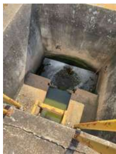
Foto 8 - DEscarte de esgoto tratado
