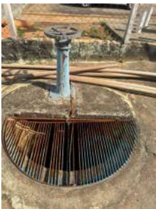
Foto 2 - Vis ta de poço de gradeamento
