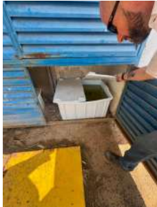
Foto 5 - Dosagem de cloro e fluor
