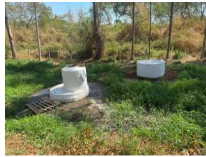
Foto 14 - Vazamento de esgoto
