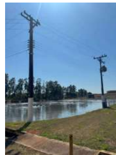
Foto 20 - Vista lagoa aerada
