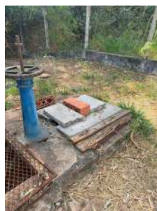
Foto 2 - Ausência de tampa
