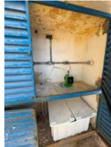
Foto 6 - Dosagem de cloro e fluor
