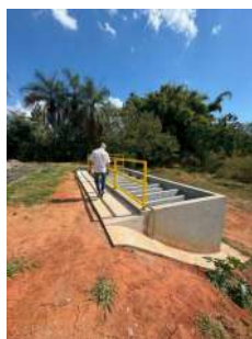
Foto 6 - Tanque de contato (fora de operação)
