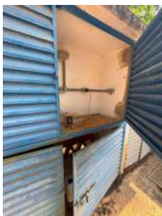
Foto 5 - Dosagem de cloro e fluor
