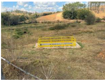
Foto 7 - Tanque de contato
