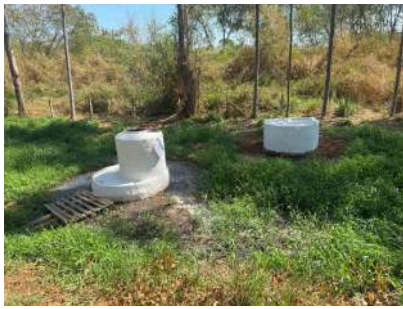
Foto 1 - Detalhe do vazamento do coletor
