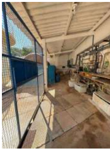
Foto 1 - Sala das bombas dosadoras
