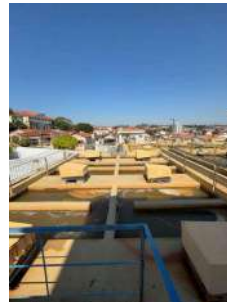
Foto 10 - Entrada de água bruta
