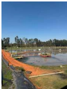
Foto 9 - Captação de lodo flutuante
