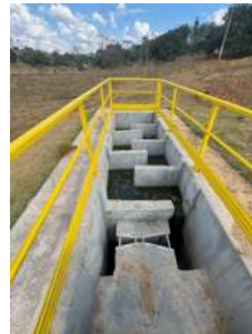
Foto 10 - Tanque de contato
