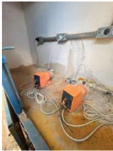
Foto 1 - Abri de dosagem cloro e fluor
