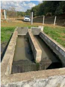
Foto 5 - Caixa de entrada de esgoto
