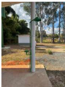
Foto 9 - Chuveiro de emergência
