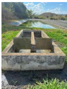
Foto 1 - Vazamento/transbordamento da caixa de entrada
