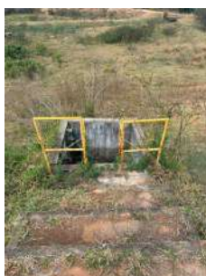
Foto 1 - Ausência de limpeza
