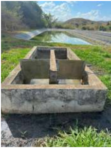
Foto 4 - Caixa de entrada de esgoto
