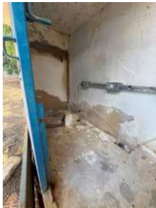
Foto 7 - Dosagem de cloro e fluor
