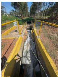
Foto 11 - Saída e fluente - medição de vazão
