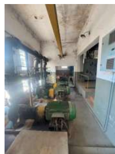
Foto 4 - Vista geral das bombas
