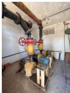
Foto 14 - Conj moto bomba
