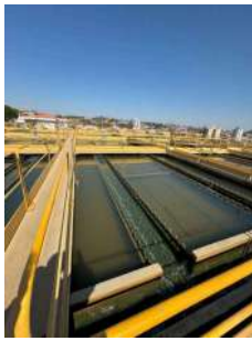
Foto 13 - Vista geral da ETA
