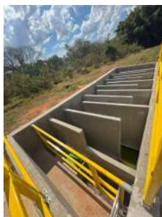
Foto 7 - Tanque de contato (fora de operação)
