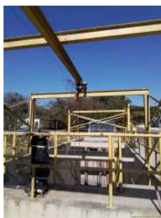
Foto 3 - Sistema de içamento para manutenções
