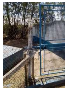
Foto 2 - Vão sem fechamento entre o portão e o mourão do alambrado
