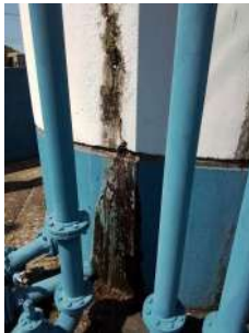
Foto 1 - Destaque para vazamento na lateral do reservatório
