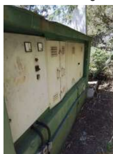
Foto 4 - Painéis elétricos do poço P-04
