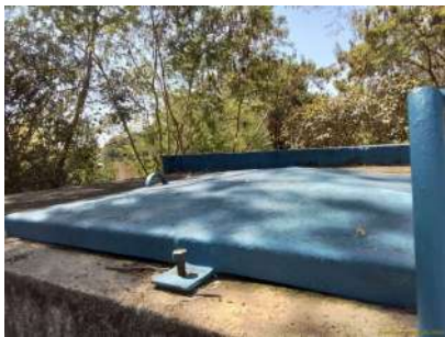
Foto 3 - Tampa do reservatório Vila João
