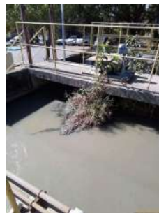
Foto 3 - Presença de plantas e detritos diversos
