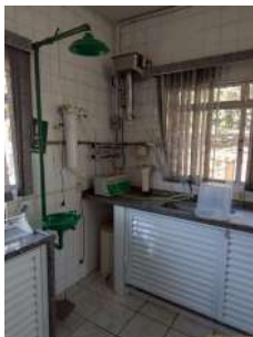
Foto 27 - Chuveiro de emergência
