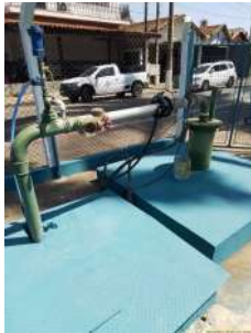
Foto 3 - Laje de proteção e cavalete do poço
