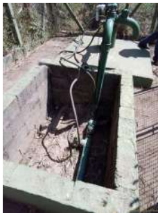
Foto 5 - Destaque para as tubulações
