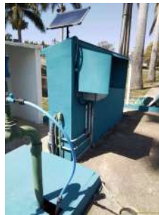
Foto 2 - Quadro elétrico do poço
