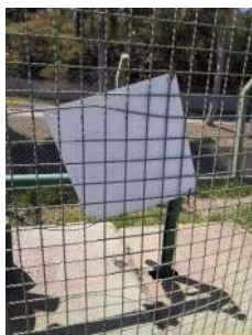
Foto 1 - Placa de identificação do Poço P-06 desgastada
