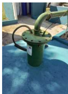
Foto 2 - Destaque para a tubulação
