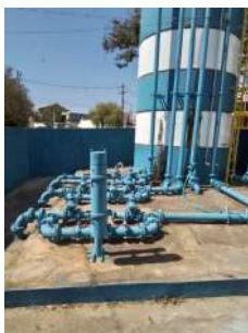
Foto 1 - Destaque das tubulações do reservatório
