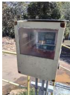
Foto 15 - Painel na passagem do efluente pelo tanque de contato
