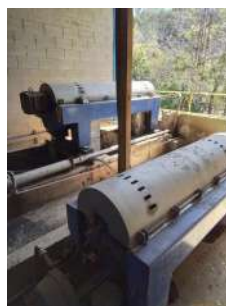
Foto 21 - Centrífuga para desidratação do lodo gerado
