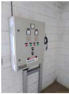
Foto 3 - Painel elétrico da EEEB
