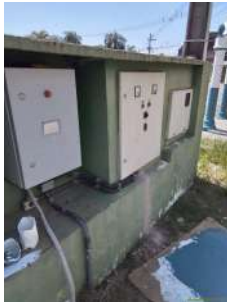
Foto 1 - Painel elétrico do poço.
