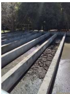
Foto 16 - Tanque de contato
