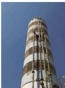
Foto 1 - Ausência de para-raios
