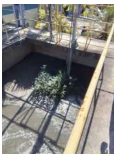
Foto 4 - Presença de plantas e detritos diversos
