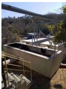
Foto 5 - Saída do efluente após passagem pelas caixas de areia
