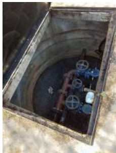
Foto 3 - Tubulação da estação elevatória
