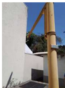
Foto 2 - Sistema de içamento para manutenções
