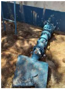
Foto 4 - Destaque para tubulações
