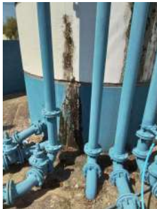
Foto 2 - Destaque para vazamento na lateral do reservatório
