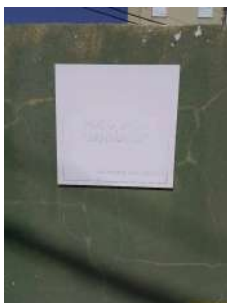
Foto 1 - Placa de identificação apagada.
