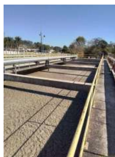
Foto 11 - Tanques de aeração
