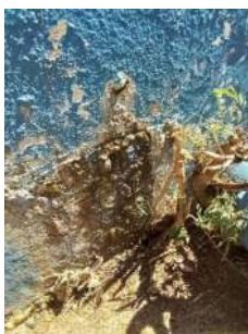
Foto 1 - Pontos de vazamento no reservatório
