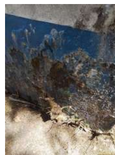
Foto 2 - Pontos de vazamento no reservatório
