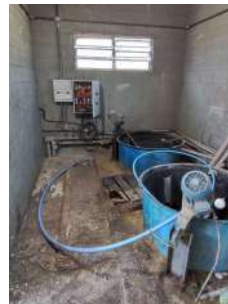
Foto 2 - Más condições de limpeza e conservação
