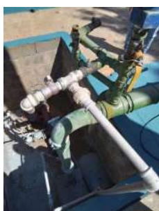
Foto 1 - Ausência de ponto de coleta da água bruta para análise
