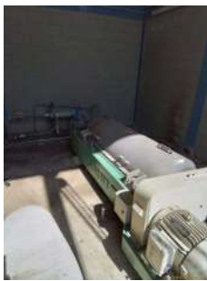
Foto 22 - Centrífuga para desidratação do lodo gerado
