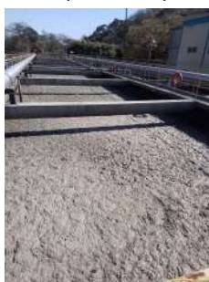
Foto 10 - Tanques de aeração
