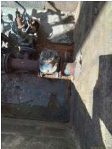
Foto 1 - Vazamento na tubulação do poço P-11
