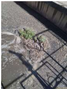
Foto 1 - Presença de plantas e detritos diversos após a etapa de gradeamento
