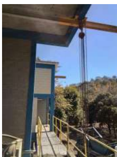
Foto 20 - Sistema de içamento para manutenções
