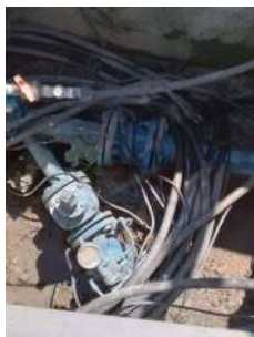
Foto 1 - Vazamento nas tubulações
