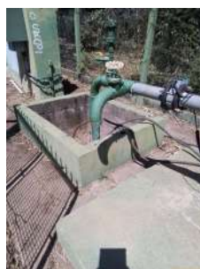
Foto 2 - Cavalete de água do poço
