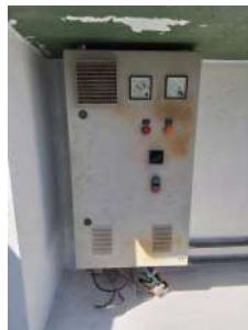
Foto 4 - Quadro elétrico do poço
