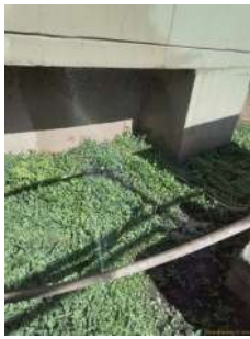
Foto 3 - Vazamento de água ao lado do decantador II
