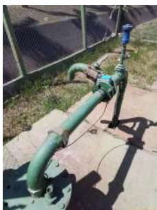
Foto 3 - Laje de proteção e cavalete do poço
