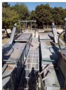
Foto 6 - Caixas de areia
