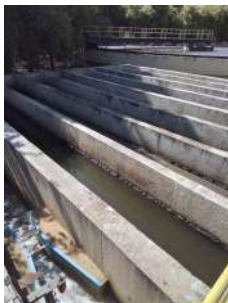
Foto 14 - Tanque de contato
