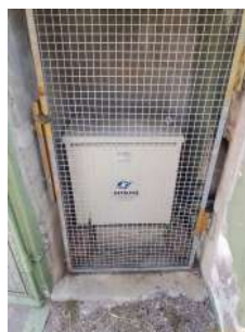
Foto 2 - Destaque para elétrica do poço
