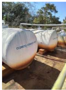
Foto 23 - Tanques de cloreto férrico
