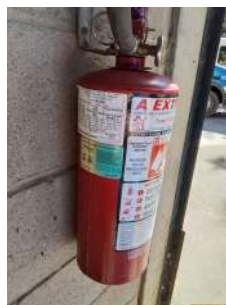
Foto 19 - Extintores de incêndio da estação
