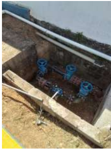
Foto 1 - Destaque para as tubulações do reservatório
