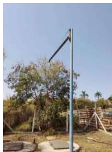
Foto 2 - Sistema de içamento para manutenções
