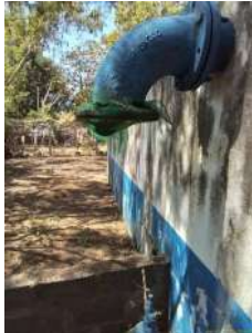
Foto 6 - Tela de proteção na tubulação
