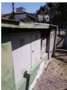
Foto 1 - Quadros elétricos do poço P-06
