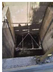
Foto 5 - Elevatória de entrada do esgoto na estação em más condições
