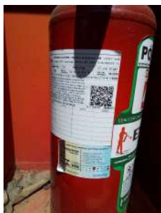
Foto 1 - Extintor vencido em 04/2025
