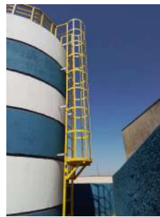
Foto 2 - Escada de acesso e guarda corpo do reservatório
