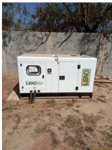
Foto 4 - Gerador de energia
