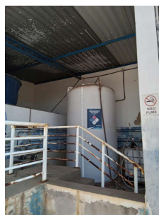
Foto 16 - Tanque de armazenamento de Hipoclorito de Sódio
