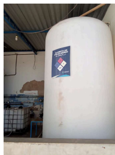
Foto 15 - Tanque de armazenamento de PAC
