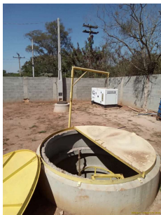
Foto 1 - Acesso ao Poço Seco
