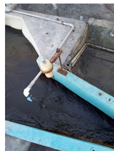
Foto 3 - Dispersão do Coagulante (PAC) sobre medidor Parshall e sensor de nível ultrassônico (macromedidor)
