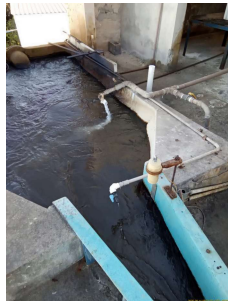
Foto 1 - Chegada da água bruta com dispersão de permanganato de potássio, hidróxido de cálcio e PAC, junto ao ponto de medição de vazão
