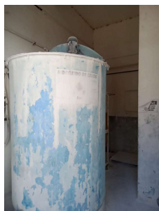
Foto 14 - Tanque de mistura de hidróxido de cálcio
