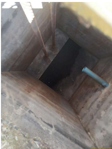
Foto 2 - Poço de chegada de esgoto com gradeamento
