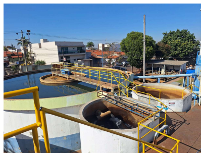
Foto 23 - Visão geral - flocculador, decantador e filtros - ETA II
