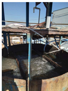
Foto 6 - Caixa de distribuição de água às unidades de flocculação e decantação, com dosagem de cloro, como oxidante
