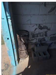
Foto 5 - Cesto utilizado em bomba submersa, não operante no momento
