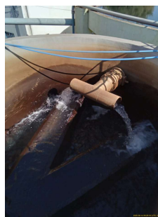
Foto 5 - Entrada de água no filtro
