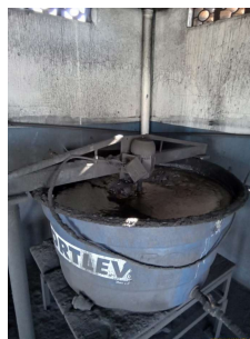
Foto 7 - Tanque de preparo de carvão ativado em pó
