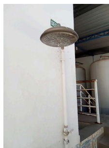
Foto 13 - Chuveiro de emergência
