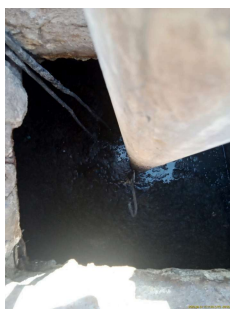
Foto 3 - Poço de sucção de esgoto e cabeamento de controle de nível
