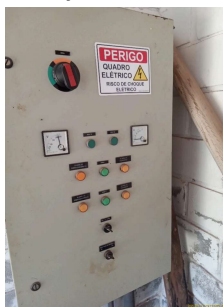
Foto 6 - Painel de acionamento do conjunto motobomba
