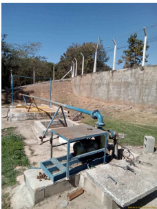
Foto 1 - Conjunto motobomba instalado
