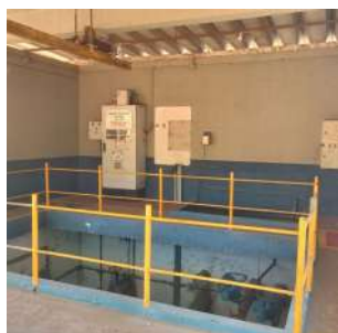
Foto 7 - Vista geral do abrigo dos conjuntos motobomba de lodo decantado e de recirculação
