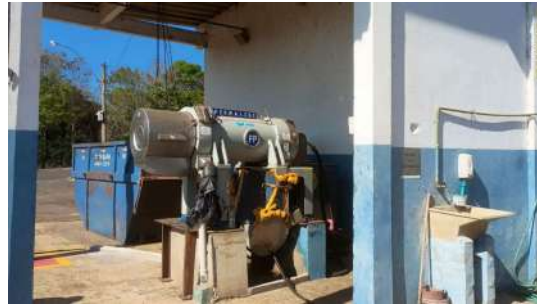
Foto 27 - Centrífuga e caçamba de descarte do lodo.
