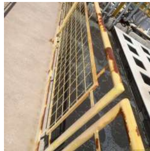
Foto 4 - Presença de oxidação, em diferentes estágios, nos guarda-corpos.
