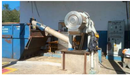
Foto 25 - Centrífuga e caçamba de descarte do lodo.
