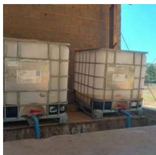
Foto 1 - Tanques de polímero catiônico (utilizado no adensamento de lodo).
