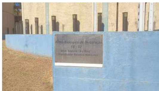
Foto 53 - Placa de identificação dos Filtros biológicos de percolação (desativados).
