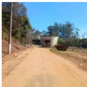
Foto 10 - Biodigestores de lodo.
