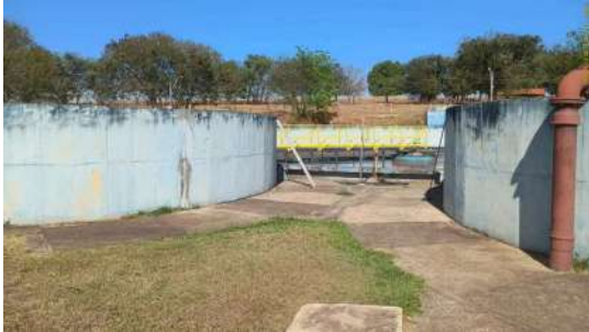
Foto 36 - Vista geral do valor de oxidação e, na área central, decantador secundário.
