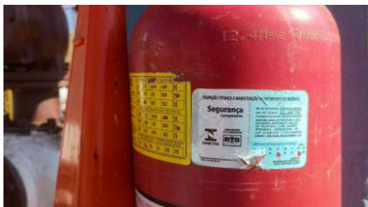
Foto 2 - Extintor com prazo vencido, situado perto dos conjuntos motobomba de recirculação de lodo.
