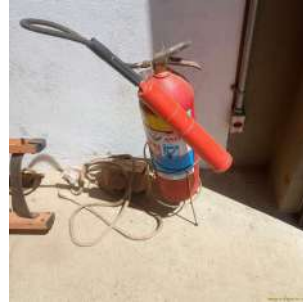
Foto 6 - Extintor de incêndios do local.
