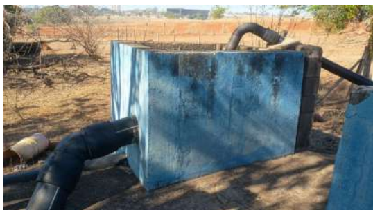
Foto 3 - Tanque de chegada do esgoto bruto.
