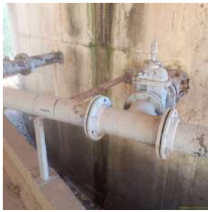
Foto 5 - Escoamento do efluente pela alvenaria devido ao vazamento no biodigestor 1.
