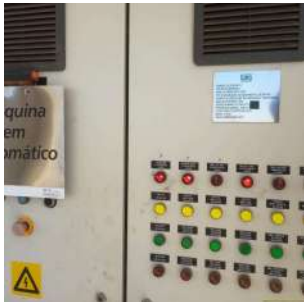
Foto 29 - Painéis elétricos e de comando próximos à centrífuga.
