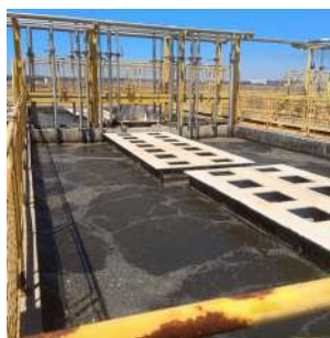
Foto 13 - Vista superior dos tanques de tratamento (lodos ativados).
