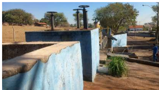
Foto 4 - Canais do tratamento preliminar.
