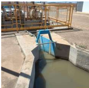
Foto 8 - Medidor de vazão de entrada na ETE.
