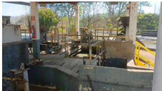
Foto 40 - Estruturas 1 e 2 para remoção de areia, porém não estão operando .
