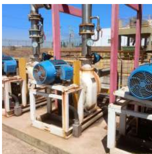
Foto 12 - Conjuntos motobomba da elevatória de esgoto pós tratamento preliminar.
