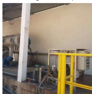
Foto 14 - Centrífuga de lodo pós biodigestor.
