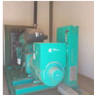
Foto 40 - Grupo gerador da ETE.
