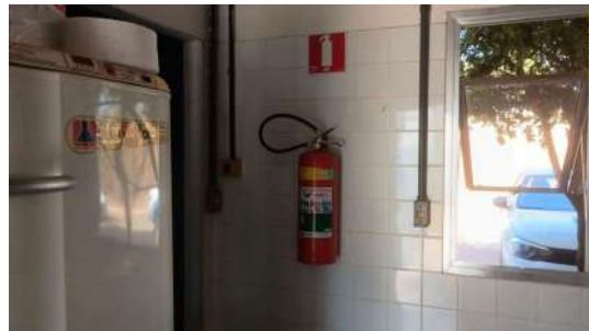
Foto 40 - Extintor de incêndio no interior do laboratório.
