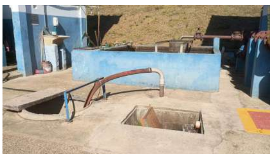
Foto 21 - Tanques de acúmulo do sobrenadante do decantador e do percolado da centrífuga de lodo.
