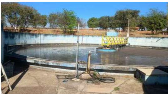
Foto 13 - Decantador secundário (central) da ETE.
