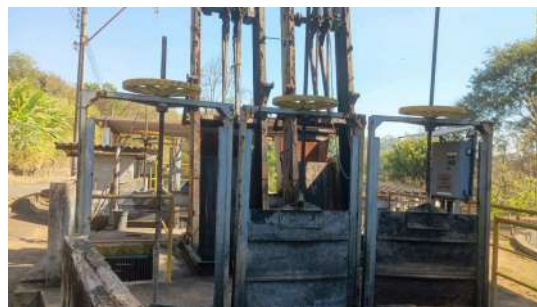
Foto 2 - Situação das estruturas do equipamento de gradeamento fino.
