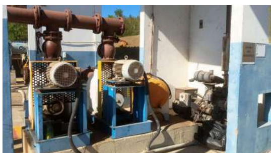
Foto 19 - Conjuntos motobomba de recirculação de lodo.
