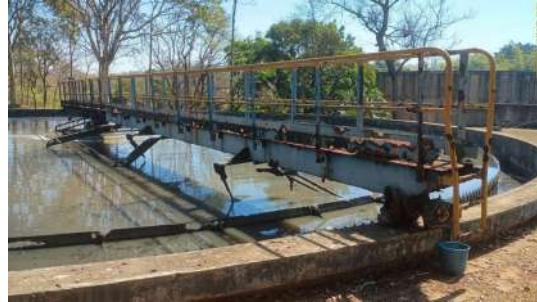
Foto 6 - Situação do decantador primário 1.
