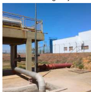
Foto 3 - Chegada do esgoto da elevatória final.
