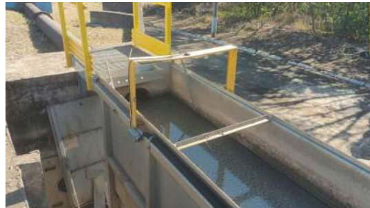
Foto 10 - Macromedidor de entrada.
