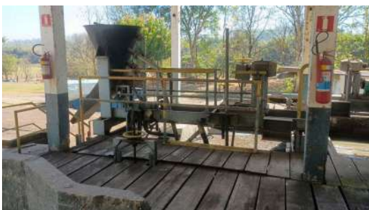
Foto 41 - Estruturas 1 e 2 para remoção de areia, porém não estão operando .
