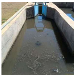
Foto 22 - Situação do efluente final e, ao fundo, Calha Parshall e medidor de vazão de saída,
