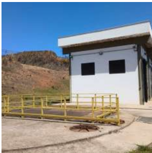
Foto 2 - Vista geral do abrigo dos painéis elétricos e de comando.
