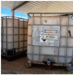
Foto 25 - Armazenamento de produtos químicos (hipoclorito).
