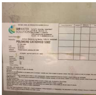
Foto 3 - Placa de identificação com prazo de validade vencido.
