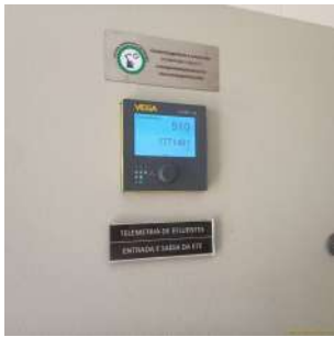
Foto 35 - Tela do sistema de telemetria (entrada do efluente).
