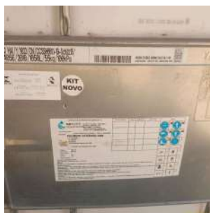
Foto 2 - Placa de identificação com prazo de validade vencido.
