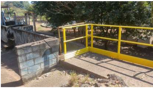
Foto 35 - Canal entre chegada do esgoto e tratamento preliminar.
