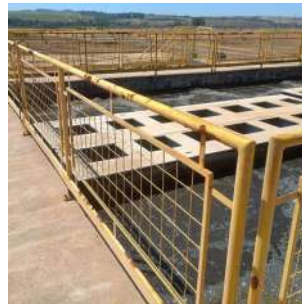
Foto 2 - Presença de oxidação, em diferentes estágios, nos guarda-corpos.
