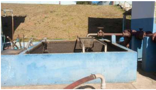
Foto 24 - Tanque que recebe o excesso de lodo para ser adensado na centrífuga.
