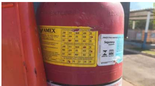
Foto 1 - Extintor com prazo vencido, situado perto dos conjuntos motobomba de recirculação de lodo.
