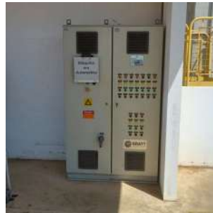
Foto 30 - Painéis elétricos e de comando próximos à centrífuga.
