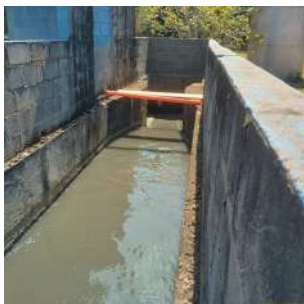
Foto 20 - Macromedidor de saída do efluente final.
