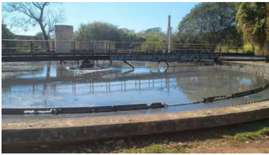
Foto 3 - Situação do decantador primário 1.
