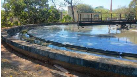
Foto 5 - Situação do decantador primário 1.
