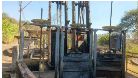
Foto 37 - Estruturas de gradeamento fino.
