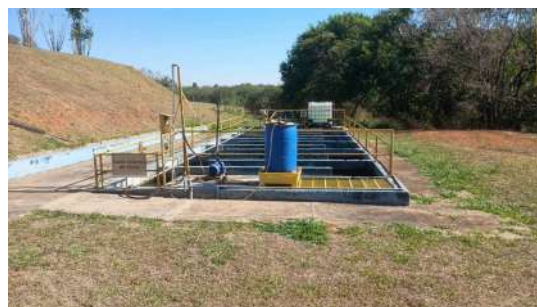
Foto 31 - Chicanas de desinfecção, com dosagem de hipoclorito de sódio.
