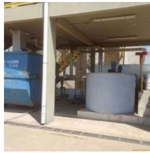
Foto 26 - Tanques de preparo de polímero para uso no adensamento do lodo.
