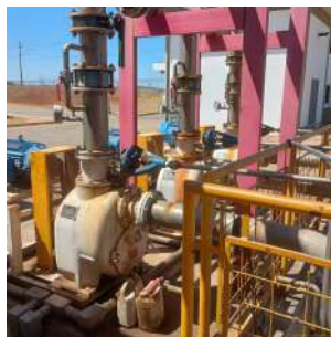
Foto 11 - Conjuntos motobomba da elevatória de esgoto pós tratamento preliminar.
