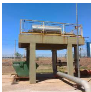
Foto 4 - Chegada do esgoto da elevatória final e gradeamento (caçamba abaixo para coleta do material retido no gradeamento).
