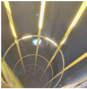
Foto 3 - Vista interna do poço seco onde ficam os conjuntos motobomba da EEE.
