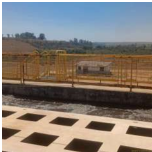
Foto 3 - Presença de oxidação, em diferentes estágios, nos guarda-corpos.
