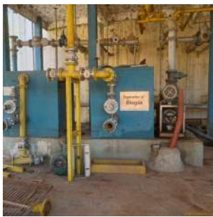
Foto 17 - Equipamento soprador ao lado dos biodigestores (não está funcionando).
