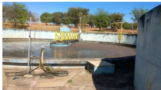
Foto 14 - Decantador secundário (central) da ETE.
