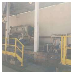
Foto 13 - Centrífuga de lodo pós biodigestor.
