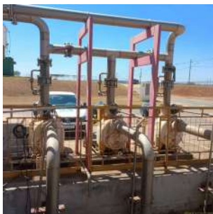
Foto 10 - Conjuntos motobomba da elevatória de esgoto pós tratamento preliminar.
