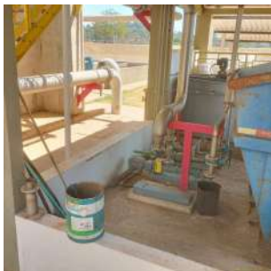
Foto 31 - Abrigo do adesamento de lodo.
