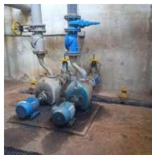
Foto 9 - Motobombas da espuma dos 4 decantadores, que retorna para o início do tratamento.
