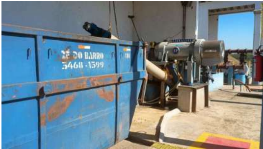
Foto 26 - Centrífuga e caçamba de descarte do lodo.
