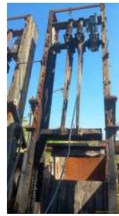
Foto 4 - Situação das estruturas do equipamento de gradeamento fino.
