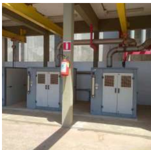
Foto 33 - Sopradores do sistema de tratamento.
