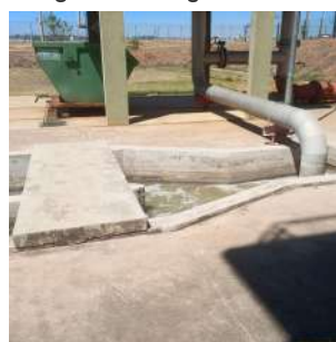
Foto 5 - Divisão do volume nos canais de remoção de areia.
