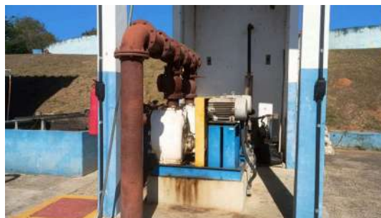
Foto 18 - Conjuntos motobomba de recirculação de lodo (o lodo é succionado direto do decantador, não tendo tanque adicional de equalização).
