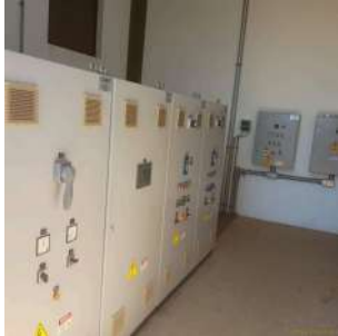
Foto 5 - Vista interna dos painéis elétricos e de comando.
