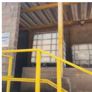
Foto 12 - Abrigo de tanques de polímero para adensamento do lodo.
