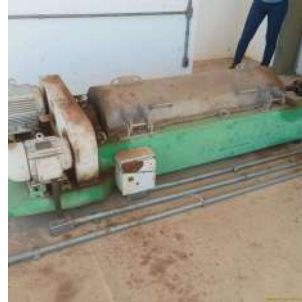
Foto 28 - Bomba centrífuga do adensamento de lodo.
