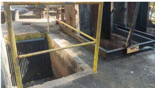
Foto 38 - Grade intermediária da parte do esgoto que vai para o desarenador 3.
