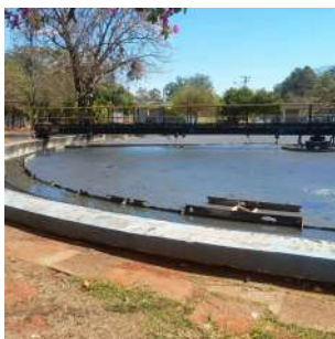
Foto 1 - Situação do decantador secundário 1, com corrosão nos estruturas internas do decantador.
