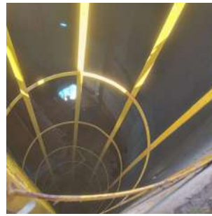
Foto 4 - Vista interna do poço seco onde ficam os conjuntos motobomba da EEE.
