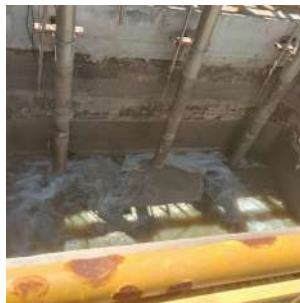
Foto 9 - Tanque de sucção da elevatória de esgoto entre o tratamento preliminar e demais etapas do processo.
