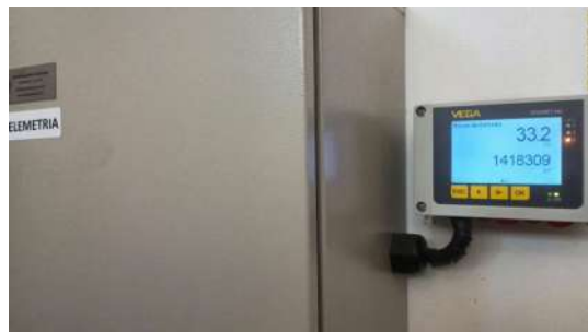
Foto 42 - Tela do sistema de medição de vazão (vazão instantânea de entrada).
