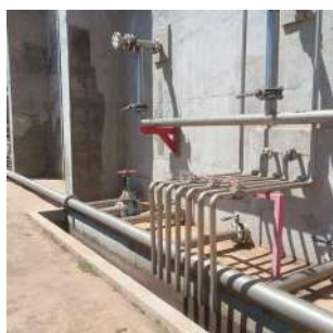
Foto 23 - Tubulações de lodo da ETE.
