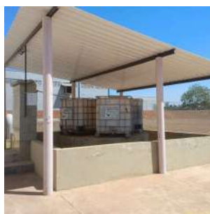
Foto 24 - Armazenamento de produtos químicos (hipoclorito).
