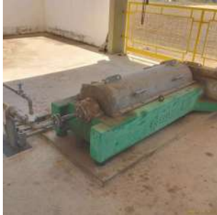
Foto 27 - Bomba centrífuga do adensamento de lodo.
