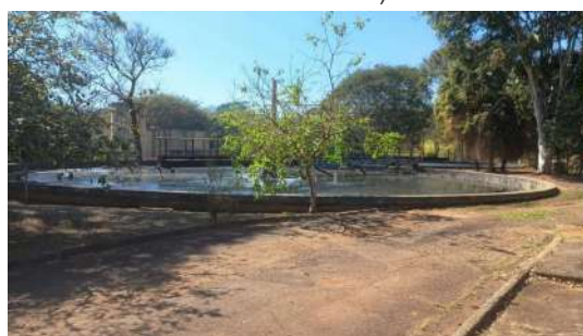
Foto 47 - Decantador primário 1 (à frente) e 2 (ao fundo).
