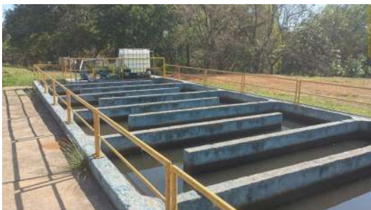
Foto 32 - Chicanas de desinfecção, com dosagem de hipoclorito de sódio.
