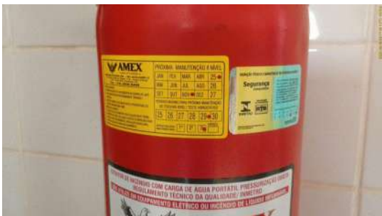
Foto 41 - Validade do extintor de incêndio.
