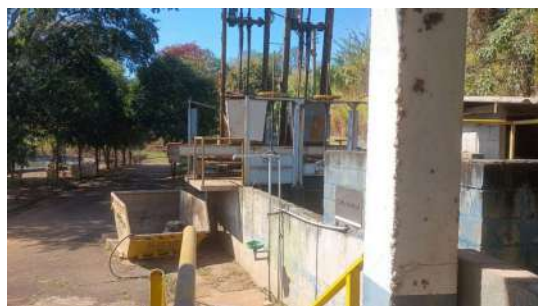
Foto 42 - Caçamba para descarte do material retido no gradeamento.
