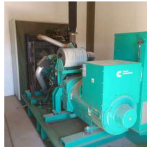
Foto 7 - Grupo gerador do local.
