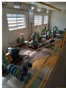
Foto 2 - Visão de cima - conjuntos motobomba da Elevatória Unileste - CLQ
