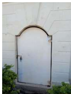
Foto 1 - Porta do reservatório com fendas.
