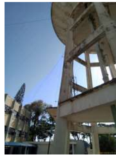
Foto 2 - Descida de para-raios - Reservatório Elevado XV de Novembro
