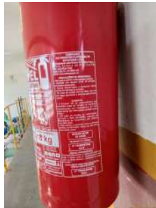
Foto 3 - Extintor de incêndio
