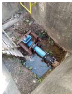
Foto 1 - Ponto de acúmulo de água no registro na base do reservatório
