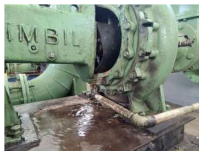
Foto 2 - Vazamento na drenagem da gaxeta
