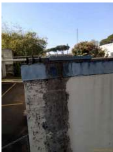
Foto 2 - Tampa de inspeção - Reservatório semienterrado novo
