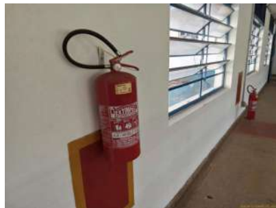
Foto 6 - Extintor de incêndio
