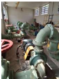
Foto 1 - Conjuntos motobomba - Elevatória Unileste - CLQ
