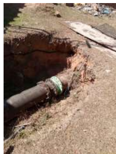
Foto 2 - Pontos de erosão no terreno (2)
