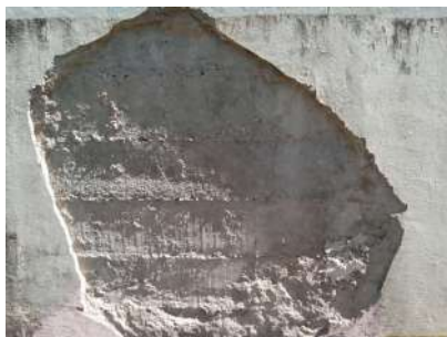
Foto 3 - Parede do reservatório exposta, sem camada de reboco/proteção
