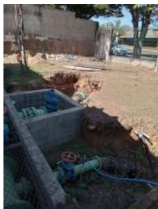
Foto 1 - Pontos de erosão no terreno
