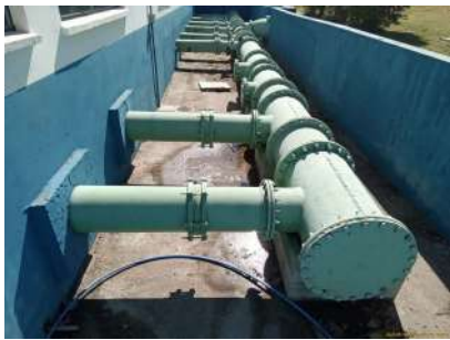
Foto 1 - Ponto de umidade, evidenciando vazamento
