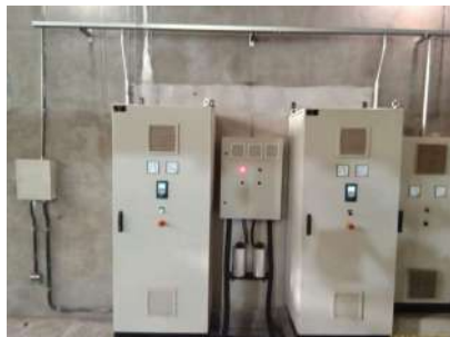
Foto 5 - Painéis de acionamento dos conjuntos
