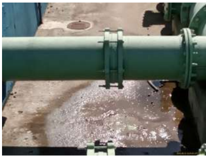
Foto 2 - Vazamento na tubulação de saída da Estação Elevatória
