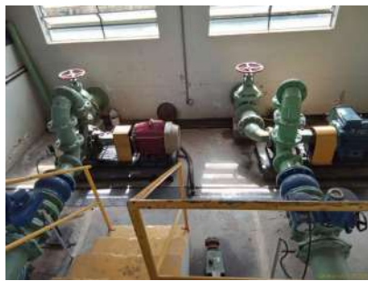
Foto 1 - Dois conjuntos para recalque ao setor Dois Córregos
