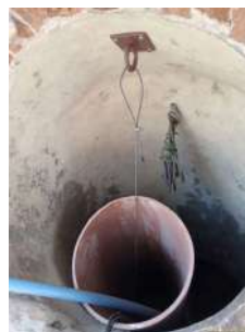
Foto 2 - Abertura do reservatório sem tela de proteção
