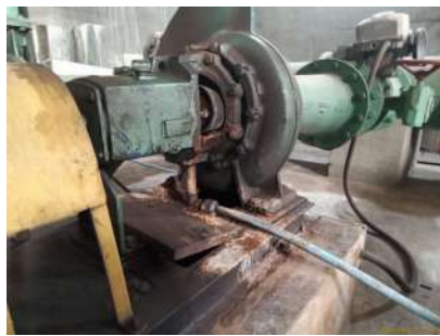
Foto 3 - Drenagem da gaxeta
