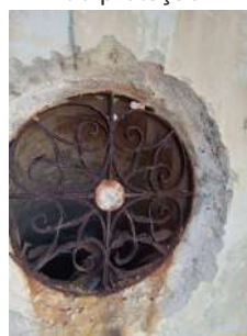
Foto 4 - Ponto de ventilação sem tela de proteção (3)
