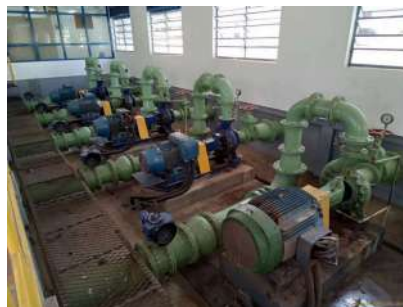
Foto 4 - Conjuntos motobomba 1 a 5 - recalque para a XV de novembro
