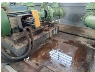
Foto 1 - Chão molhado - Vazamento na drenagem da gaxeta
