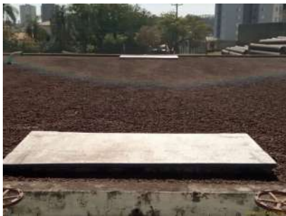
Foto 2 - Tampa de Inspeção - - Reserv. Semienterrado 2 - Uniliete
