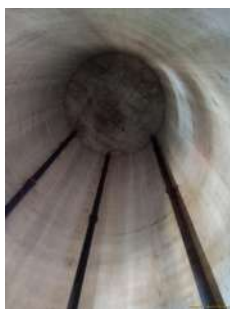
Foto 4 - Visão interior - Reservatório Agronomia
