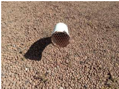
Foto 4 - Ventilação com tela de proteção - Reserv. unileste Semienterrado 1
