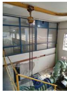
Foto 2 - Içamento monovia - acesso para manutenção
