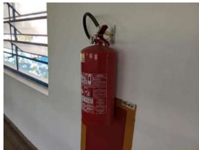
Foto 2 - Extintor de incêndio
