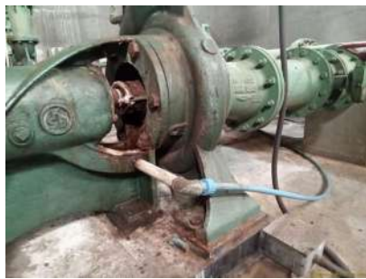
Foto 3 - Drenagem da gaxeta
