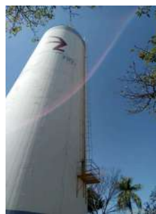
Foto 5 - Guarda-corpos e para-raios - Reservatório Agronomia
