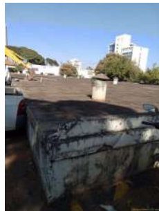
Foto 3 - Ventilação - Reservatório Semienterrado Velho XV de Novembro
