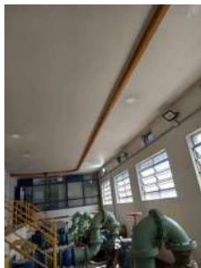
Foto 3 - Içamento monovia - acesso para manutenção
