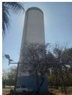
Foto 1 - Visão geral - Reservatório Agronomia - Guarda corpos e descida de para-raios
