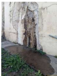
Foto 1 - Ponto de vazamento na parede do reservatório
