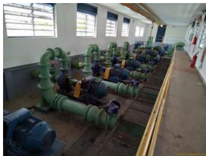
Foto 3 - Conjuntos motobomba (oito no total - cinco recalcam para XV)
