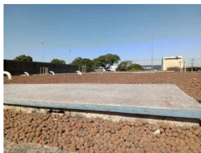
Foto 8 - Tampa de inspeção - Reserv. Semienterrado 2 - Uniliete
