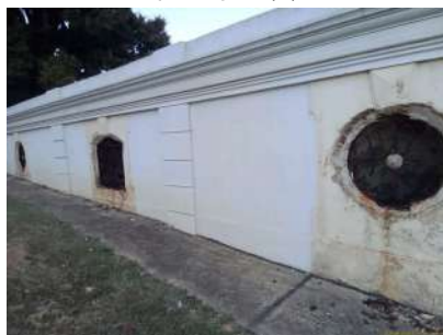
Foto 5 - Diversos pontos de ventilação sem tela de proteção
