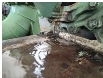
Foto 3 - Bomba 5 -Vazamento na drenagem da gaxeta
