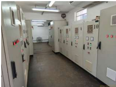
Foto 2 - Painéis de acionamento
