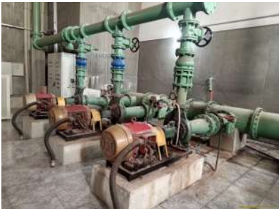
Foto 2 - Três conjuntos motobomba
