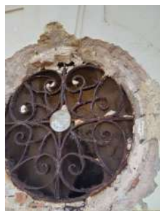
Foto 1 - Ponto de ventilação sem tela de proteção
