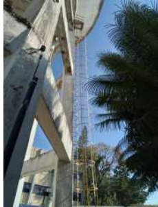
Foto 3 - Descida de para-raios e escada com guarda-corpos - Reservatório Elevado XV de Novembro
