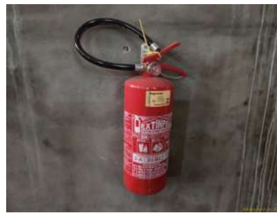
Foto 4 - Extintor de incêndio
