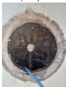
Foto 3 - Ponto de ventilação sem tela de proteção (2)
