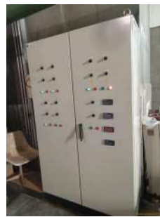
Foto 4 - Painel de acionamento dos conjuntos motobomba
