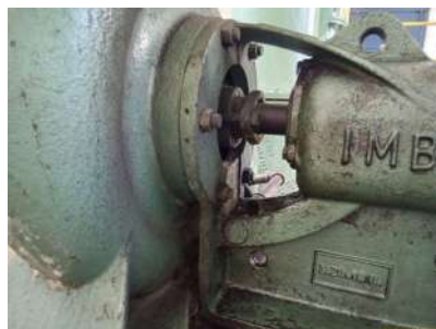
Foto 5 - Gaxeta com dreno
