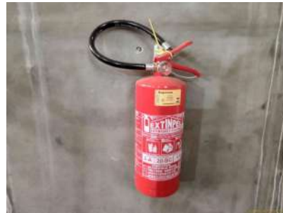
Foto 6 - Extintor de incêndio
