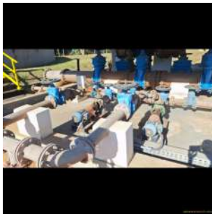
Foto 26 - Recalque do lodo sedimentado do decantador
