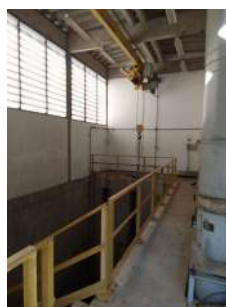
Foto 33 - Acesso para manutenção dos conjuntos motobomba com talha elétrica
