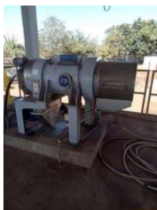
Foto 10 - Centrífuga para desidratação do lodo
