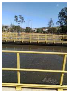
Foto 16 - Guarda-corpo regular dos reatores aeróbios
