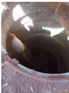
Foto 1 - Chegada de esgoto
