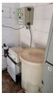
Foto 8 - Neutralizador de odores _ elevatória
