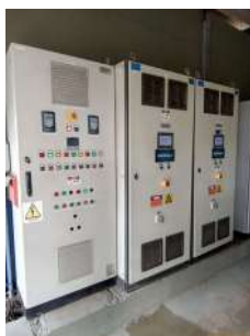
Foto 11 - Painel de controle das centrífugas
