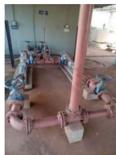
Foto 11 - Registros e bomba de lodo
