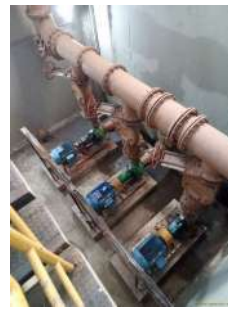
Foto 2 - Conjuntos motobomba da estação elevatória
