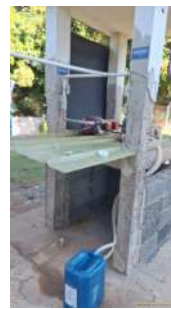
Foto 36 - Dosagem de hipoclorito para reúso
