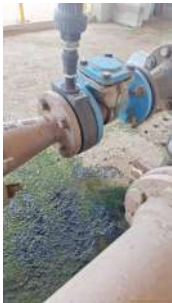
Foto 1 - Pequeno vazamento na tubulação de mistura do polímero
