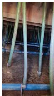
Foto 22 - Fundo do reator no módulo 3
