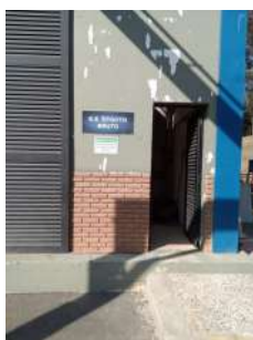
Foto 32 - Estação Elevatória de Esgoto Bruto
