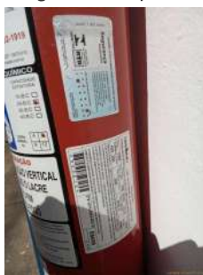
Foto 5 - Extintor de incêndio com validade regular
