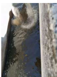
Foto 17 - Calha de direcionamento do efluente tratado
