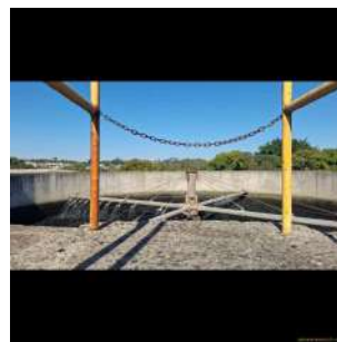
Foto 23 - Filtro biológico percolador
