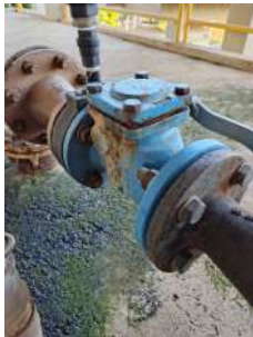
Foto 2 - Evidência de reparo de vazamento
