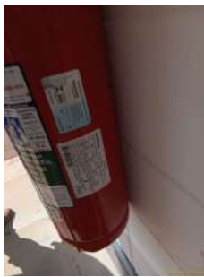
Foto 25 - Extintor de incêndio com validade regular
