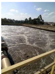
Foto 23 - Reator aeróbio em operação
