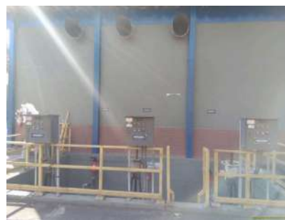
Foto 35 - Linhas de recalque do esgoto para o tratamento preliminar
