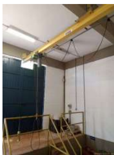
Foto 7 - Içamento monovia para acesso de manutenção
