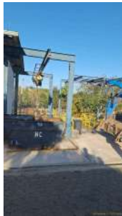
Foto 1 - Elevatória de esgoto - gradeamento por cesto e poço pulmão
