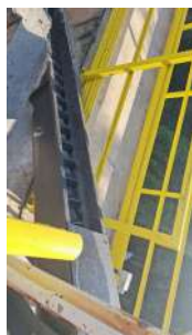
Foto 14 - Transportador helicoidal de remoção de areia do fundo da caixa
