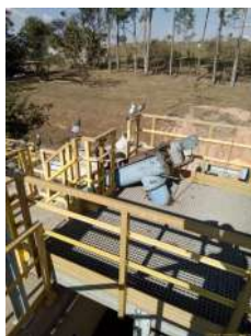
Foto 27 - Transportador helicoidal de material do desarenador e descarte em caçamba
