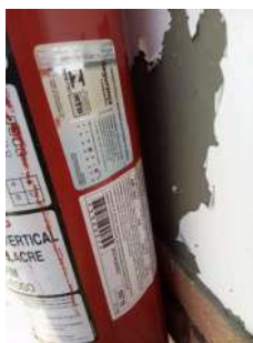
Foto 34 - Extintor de incêndio
