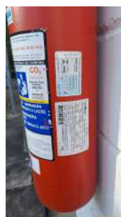
Foto 9 - Extintor próximo a pannel elétrico da estação elevatória
