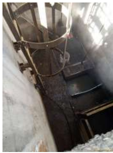
Foto 1 - Gradeamento da estação elevatória
