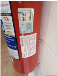
Foto 4 - Extintor com validade regular na estação elevatória
