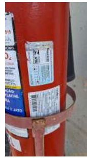
Foto 27 - Extintor _ recirculação do lodo
