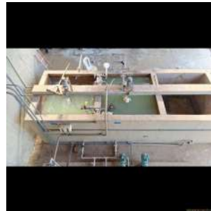
Foto 28 - Tanque de preparo dos polímeros
