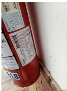
Foto 5 - Extintor de incêndio com validade regular
