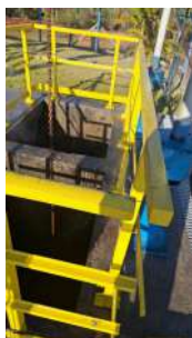
Foto 4 - Neutralizador de odores da estação elevatória
