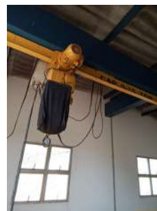
Foto 4 - Içamento monovia para manutenção dos conjuntos motobomba
