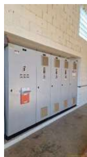
Foto 7 - Pannel de comando dos conjuntos motobomba
