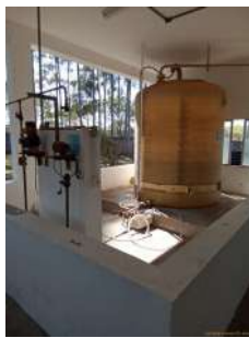
Foto 19 - Tanque de hipoclorito e bombas dosadoras
