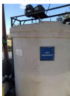
Foto 18 - Tanque de antiespumante
