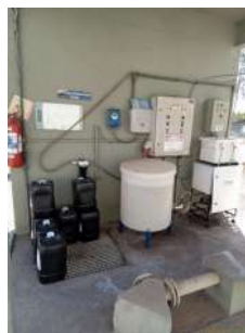
Foto 12 - Sistema para neutralizador de odores
