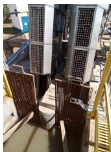
Foto 17 - Gradeamento grosseiro do tratamento preliminar
