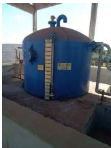
Foto 12 - Tanque de hipoclorito de sódio
