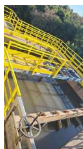
Foto 13 - Desarenador com raspadores de fundo
