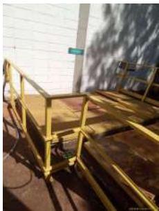
Foto 3 - Poço de sucção com acesso protegido por guarda-corpos
