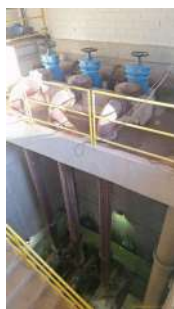
Foto 6 - Conjuntos motobomba da estação elevatória
