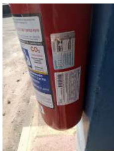
Foto 21 - Extintor de incêndio
