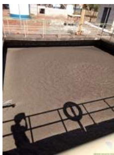
Foto 16 - Reator aeróbio - batelada
