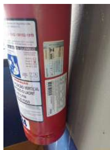
Foto 12 - Extintor de incêndio
