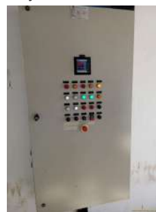
Foto 6 - Paineis de acionamento dos conjuntos motobomba
