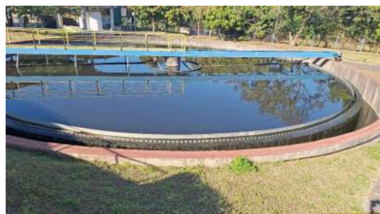
Foto 25 - Decantador efluente do filtro biológico
