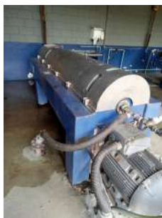
Foto 9 - Centrífuga de desidratação de lodo
