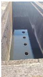
Foto 20 - Entrada de esgoto no reator anaeróbio
