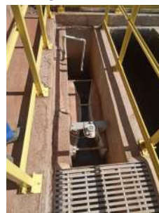
Foto 13 - Macromedidor de saída
