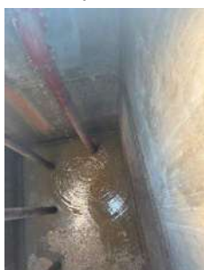
Foto 5 - Poço de sucção
