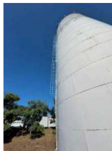
Foto 4 - Detalhe do reservatório
