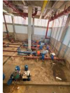
Foto 40 - Bombas de lodo
