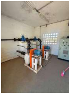
Foto 6 - Conj moto bomba
