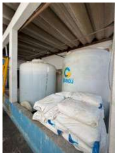
Foto 9 - Armazenamento de produtos químicos
