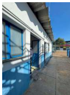
Foto 16 - Vista da sala de bombas e operação
