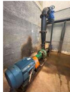
Foto 6 - Conj moto bomba
