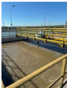
Foto 25 - Tanque de aeração
