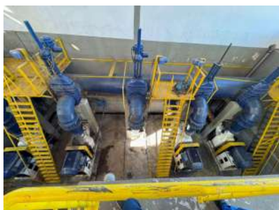
Foto 15 - Elevatória de Esgoto bruto
