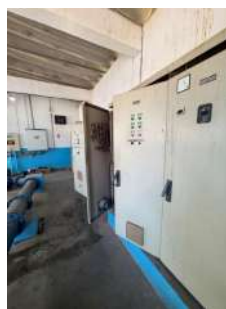
Foto 24 - Sala de bombas
