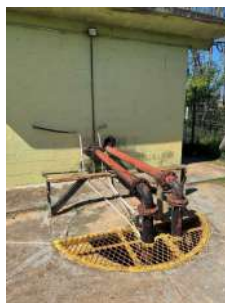
Foto 6 - Poço de sucção
