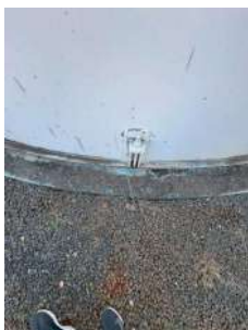
Foto 5 - Detalhe do aterramento
