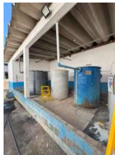
Foto 10 - Armazenamento de produtos químicos
