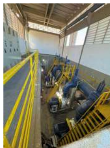
Foto 14 - Elevatória de Esgoto bruto
