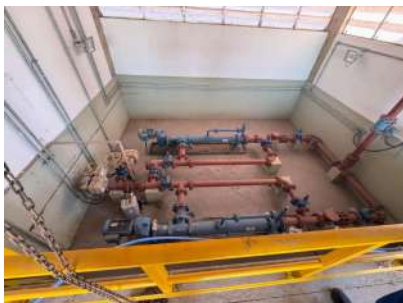
Foto 35 - Bombas de lodo
