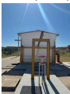
Foto 7 - Casa de bombas
