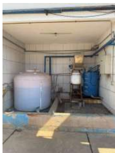
Foto 7 - Armazenamento de produtos químicos
