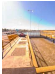
Foto 24 - Tanque de aeração
