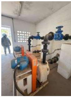
Foto 7 - Conj moto bomba
