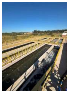
Foto 48 - Tanque de contato
