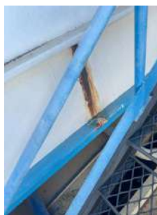
Foto 2 - Vazamento nos módulos
