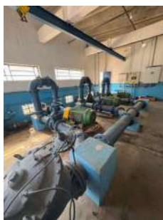
Foto 23 - Sala de bombas da EEAT
