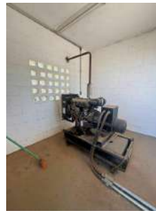
Foto 8 - Conj. moto gerador
