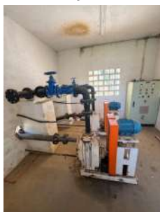
Foto 9 - conj. moto bomba
