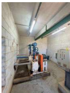
Foto 7 - Vista geral da sala de bombas
