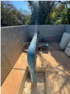
Foto 2 - Barrilete da elevatória
