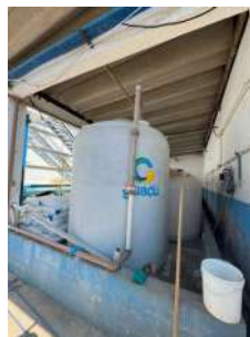
Foto 8 - Armazenamento de produtos químicos
