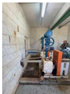
Foto 6 - Conj moto bomba
