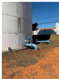
Foto 6 - Detalhe das tubulações
