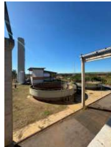
Foto 44 - Adensadores de lodo
