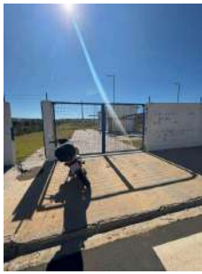
Foto 1 - Ausência de identificação
