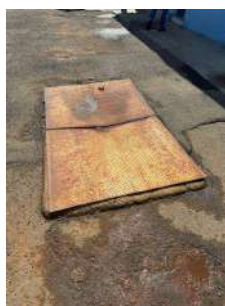
Foto 2 - Tampa em mal estado de conservação
