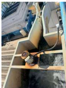
Foto 11 - Canal de entrada e medidor de vazão
