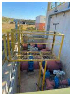
Foto 50 - Elevatório de retorno de lodo
