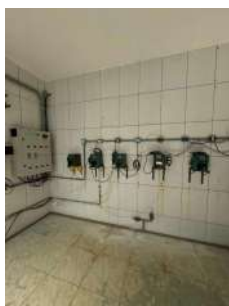
Foto 17 - Sala de bombas desadoras
