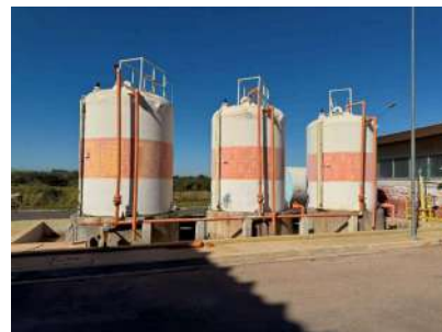
Foto 46 - Tanques de produtos químicos
