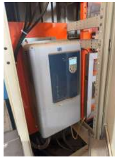
Foto 6 - Inversor de frequência
