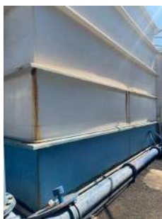
Foto 1 - Vazamento na chapa dos reatores
