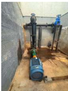
Foto 1 - Sem bomba reserva
