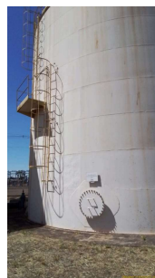
Foto 4 - Guarda-corpo do Reservatório Dona Margarida em Santa Bárbara DOeste
