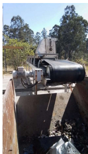
Foto 8 - Gradeamento da Elevatória de esgoto da ETE Toledos II em Santa Bárbara DOeste
