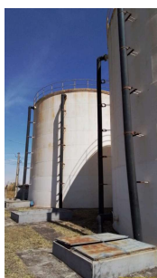
Foto 9 - Tubulações de entrada, saída e extravasor do Reservatório Dona Margarida em Santa Bárbara DOeste
