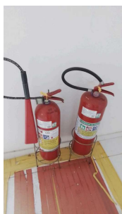
Foto 7 - Extintor de incêndio da ETE Toledos II em Santa Bárbara DOeste
