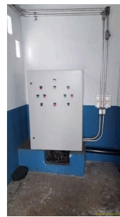
Foto 2 - Painél elétrico da elevatória de água do Reservatório Vila Brasil em Santa Bárbara DOeste
