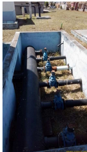
Foto 7 - Tubulações do Reservatório Elevado Vila Brasil em Santa Bárbara DOeste
