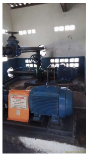
Foto 1 - Bomba da elevatória de água do Reservatório Vila Brasil em Santa Bárbara DOeste
