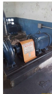
Foto 6 - Bomba da elevatória de água do Reservatório Vila Brasil em Santa Bárbara DOeste
