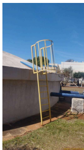
Foto 1 - Escada de acesso ao topo do reservatório com gaiola de proteção, mas não há proteção na borda do reservatório nos pontos onde estão instaladas as tampas de inspeção.
