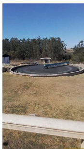
Foto 21 - Decantadores da ETE Toledos II em Santa Bárbara DOeste
