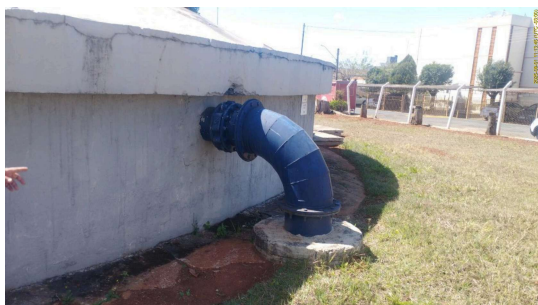
Foto 7 - Tubulação de entrada da água no reservatório - abastecido pela água tratada na ETA 2.
