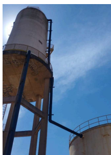
Foto 8 - Tubo extravasor do reservatório elevado, com a saída conectada ao reservatório apoiado.
