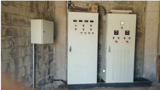
Foto 5 - Painéis elétricos das bombas.
