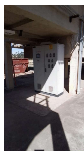
Foto 16 - Painél elétrico da ETE Toledos II em Santa Bárbara DOeste
