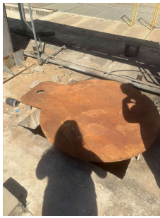
Foto 1 - Risco de queda na Elevatória de esgoto da ETE Toledos II em Santa Bárbara DOeste
