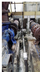
Foto 7 - Bombas da Elevatória de esgoto da ETE Toledos II em Santa Bárbara DOeste
