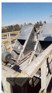
Foto 9 - Gradeamento da ETE Toledos II em Santa Bárbara DOeste
