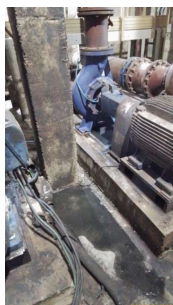
Foto 6 - Bombas da Elevatória de esgoto da ETE Toledos II em Santa Bárbara DOeste
