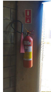
Foto 6 - Extintor de incêndio instalado no interior da edificação.
