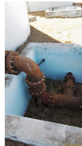
Foto 8 - Tubulação do Reservatório Elevado Vila Brasil em Santa Bárbara DOeste
