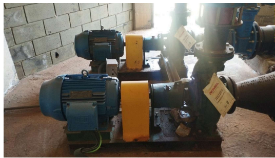
Foto 4 - Há dois conjuntos moto bomba instalados no local.
