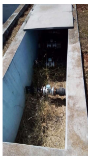
Foto 9 - Medidores de vazão do Reservatório Elevado Vila Brasil em Santa Bárbara DOeste
