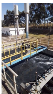
Foto 15 - Desarenador da ETE Toledos II em Santa Bárbara DOeste
