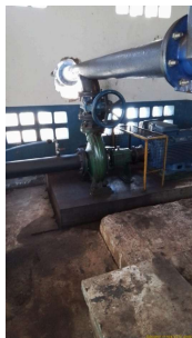
Foto 5 - Bomba da elevatória de água do Reservatório Vila Brasil em Santa Bárbara DOeste
