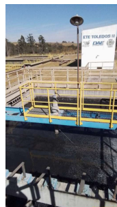
Foto 14 - Desarenador da ETE Toledos II em Santa Bárbara DOeste
