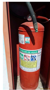
Foto 4 - Extintor de incêndio do Reservatório Elevado Vila Brasil em Santa Bárbara DOeste
