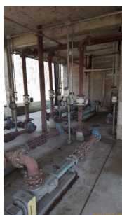
Foto 25 - Centrifugas de lodo da ETE Toledos II em Santa Bárbara DOeste
