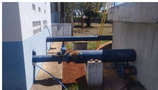
Foto 8 - Tubulação de saída da água para a estação elevatória.
