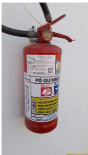
Foto 3 - Extintor de incêndio da Elevatória de esgoto da ETE Toledos II em Santa Bárbara
