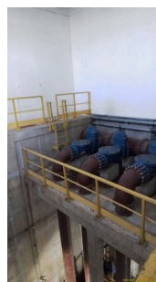
Foto 5 - Tubulações da Elevatória de esgoto da ETE Toledos II em Santa Bárbara DOeste
