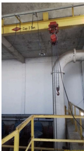
Foto 4 - Talha da Elevatória de esgoto da ETE Toledos II em Santa Bárbara DOeste
