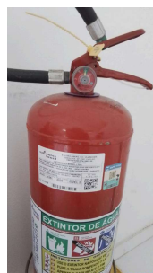
Foto 8 - Extintor de incêndio da ETE Toledos II em Santa Bárbara DOeste
