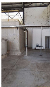
Foto 27 - Chuveiro de emergência da ETE Toledos II em Santa Bárbara DOeste
