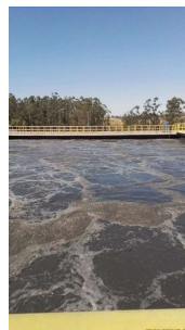
Foto 18 - Aeração da ETE Toledos II em Santa Bárbara DOeste
