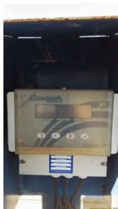
Foto 11 - Medidor de vazão da ETE Toledos II em Santa Bárbara DOeste
