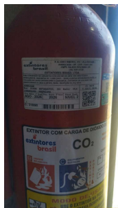
Foto 7 - Detalhe da etiqueta de controle de manutenções do extintor - dentro da validade.
