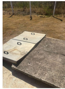
Foto 2 - Risco de queda Elevatória de esgoto da ETE Toledos II em Santa Bárbara DOeste
