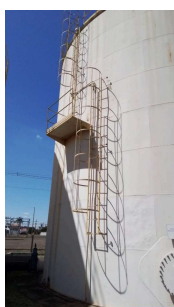
Foto 7 - Guarda-corpo do Reservatório Dona Margarida em Santa Bárbara DOeste
