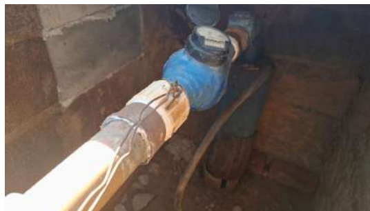
Foto 16 - Cavalete do poço.
