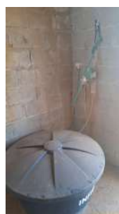
Foto 8 - Armazenamento e bombeamento de hipoclorito de sódio.
