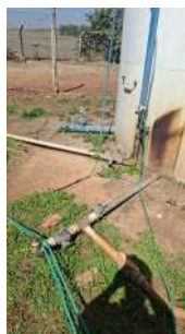
Foto 8 - Tubulações de saída.
