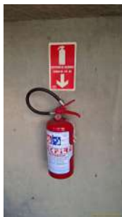
Foto 11 - Extintor de incêndio.
