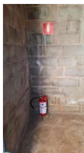
Foto 9 - Extintor de incêndio.
