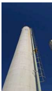
Foto 1 - Detalhe do suporte guia do SPDA sem cabo.
