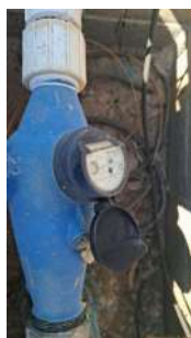
Foto 5 - Medidor de vazão.
