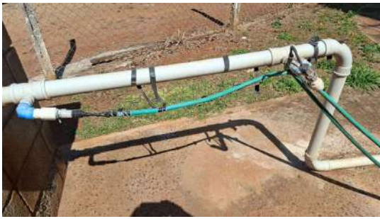
Foto 17 - Tubulação de saída do poço, onde é realizado o tratamento da água.
