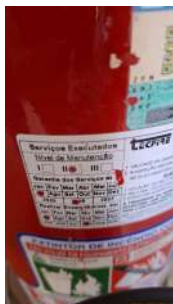
Foto 27 - Validade do extintor maior.
