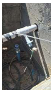
Foto 9 - Torneira de água bruta.
