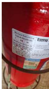
Foto 10 - Validade do extintor de incêndio.
