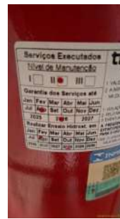
Foto 12 - Validade do extintor de incêndio.
