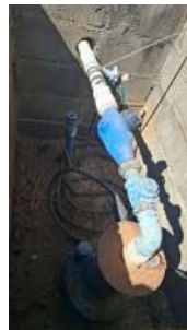
Foto 4 - Cavalete do poço.
