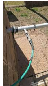
Foto 14 - Detalhe da torneira onde é inserido o hipoclorito de sódio.
