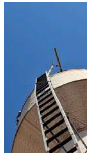
Foto 8 - Detalhe do captor Franklin e do extravasor.
