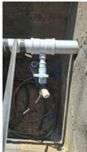
Foto 13 - Detalhe da torneira de água bruta.
