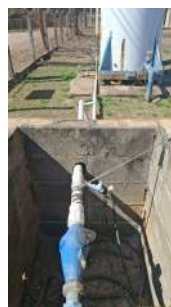
Foto 6 - Medidor de vazão e torneira de água bruta.
