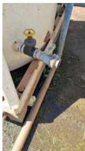
Foto 1 - Vazamento na descarga do reservatório.
