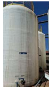
Foto 20 - Filtro Anaeróbio Submerso (FAS).
