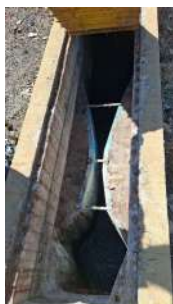
Foto 31 - Calha Parshall de saída.
