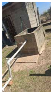
Foto 2 - Abrigo do cavalete.
