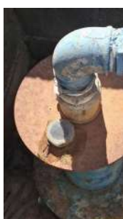
Foto 1 - Local do tubo de medição de nível.
