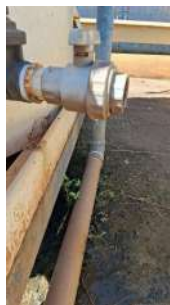
Foto 2 - Detalhe do vazamento.
