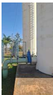
Foto 8 - Tubulação de saída do reservatório.
