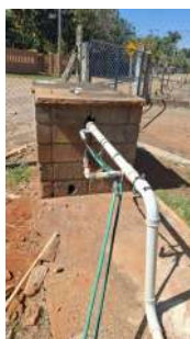
Foto 8 - Vista das torneiras utilizadas para a aplicação dos produtos de tratamento e, ao fundo, o abrigo do poço.
