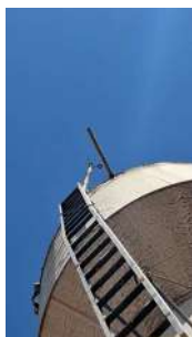
Foto 1 - Extravasador sem tela de proteção.
