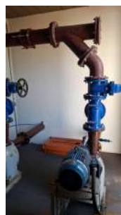
Foto 13 - Bomba principal da elevatória de esgoto bruto.
