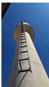
Foto 1 - Escada sem guarda corpo.
