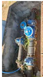
Foto 6 - VRP na tubulação de saída.
