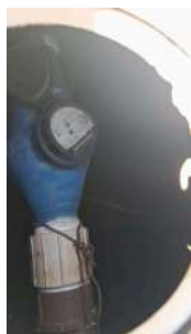
Foto 3 - Medidor de vazão.
