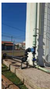
Foto 6 - Tubulação de chegada da água tratada.
