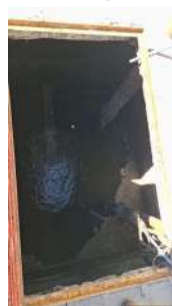
Foto 12 - Poço da elevatória de esgoto bruto.
