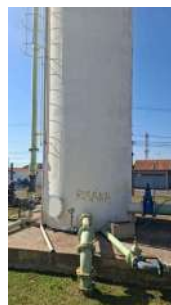
Foto 3 - Tubulações e base do reservatório.
