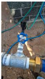
Foto 5 - Torneira de água bruta.
