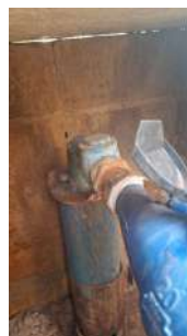
Foto 6 - Tubo camisa do poço.
