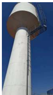
Foto 2 - Detalhe de parte da escada que não possui guarda corpo.
