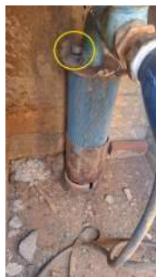
Foto 1 - Poço sem tubo medidor de nível.
