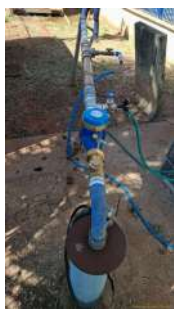
Foto 1 - Cavalete do poço.
