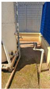
Foto 5 - Base do reservatório e tubulações.
