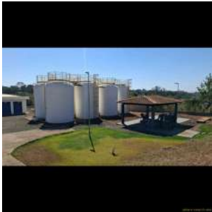
Foto 2 - Tratamento e estação elevatória de esgoto tratado.
