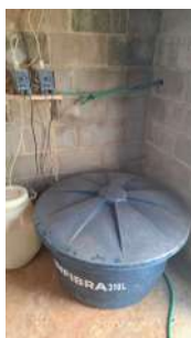
Foto 11 - Armazenamento de hipoclorito de sódio e bombas de dosagem.
