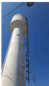
Foto 1 - Escada sem guarda-corpo.
