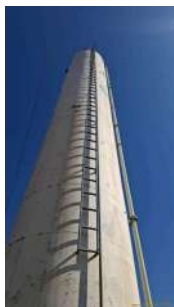
Foto 1 - Escada marinheiro sem guarda-corpo.
