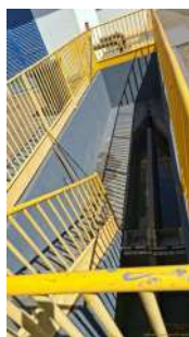
Foto 5 - Gradeamento e canal de areia.
