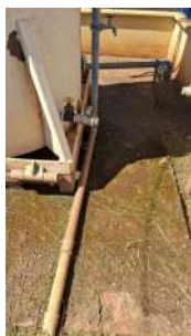
Foto 3 - Local molhado devido ao vazamento.
