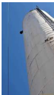
Foto 7 - Captor Franklin no topo da escada e extravasor a esquerda.
