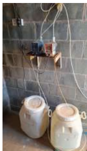
Foto 9 - Dosagem de hipoclorito de sódio e flúor.
