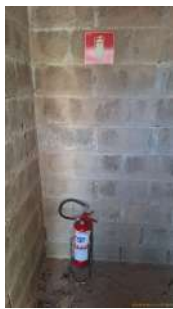
Foto 11 - Extintor de incêndio.
