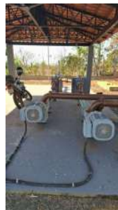
Foto 30 - Elevatória de esgoto tratado na saída, que realiza o recalque diretamente para a rede coletora de esgoto, a qual conduz o efluente a outra ETE.
