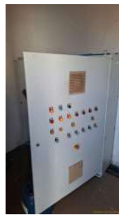
Foto 24 - Paineis de controle.
