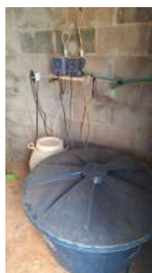
Foto 12 - Produtos químicos e bombas de dosagem.
