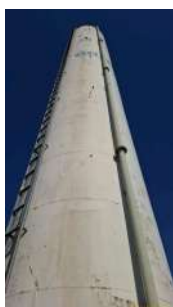
Foto 1 - Detalhe para a ausência de cabo do SPDA.
