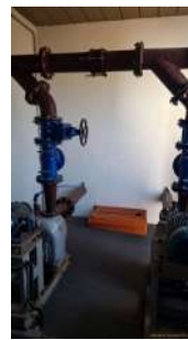
Foto 15 - Conjuntos moto bombas.
