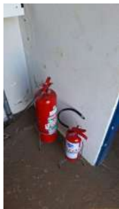
Foto 25 - Extintores de incêndio.
