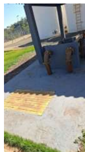
Foto 32 - Poço de efluente tratado da elevatória de saída.
