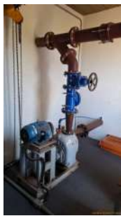
Foto 14 - Bomba secundária da elevatória de esgoto bruto.
