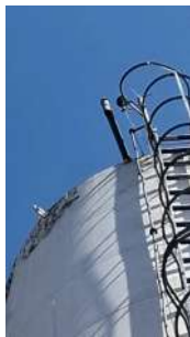
Foto 1 - Extravasador sem tela de proteção.
