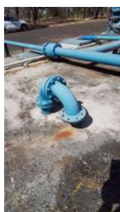
Foto 7 - Tubo para ventilação com tela de proteção.
