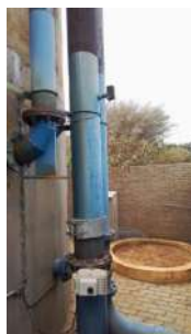
Foto 5 - Entrada do reservatório vindo do poço Planalto.
