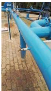
Foto 1 - Torneira para coleta de água bruta.
