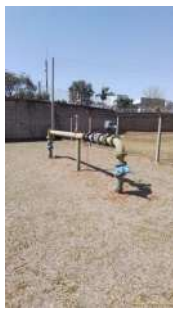
Foto 3 - Cavalete na entrada do reservatório. Medidor de vazão instalado.
