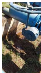
Foto 2 - Vazamento verificado em válvula.
