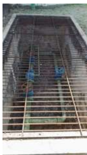
Foto 6 - Tubulação na entrada do reservatório.
