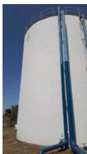
Foto 5 - Abastecimento do reservatório e extravasor.
