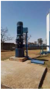
Foto 3 - Poço com bomba centrífuga vertical.
