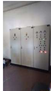
Foto 8 - Painéis de comando do poço.
