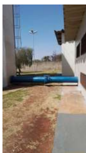
Foto 3 - Saída do reservatório para elevatória.
