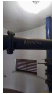
Foto 2 - Tubulação de recalque.
