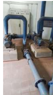
Foto 3 - Recalque das bombas.
