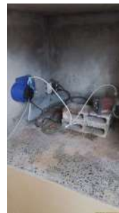
Foto 4 - Bomba dosadora de produto químico.
