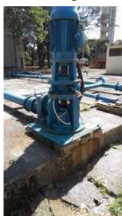
Foto 3 - Vazamento verificado no conjunto motobomba que recalca água do R16 para o R5A.
