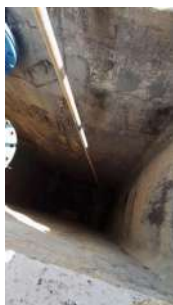
Foto 14 - Saída do reservatório.
