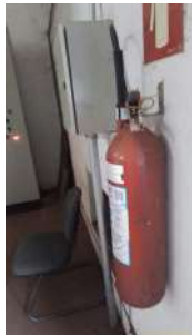
Foto 7 - Extintor junto aos painéis de comando e transformadores.
