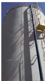
Foto 7 - Escadas e descida do SPDA.
