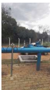
Foto 3 - Medidor de pressão no recalque.
