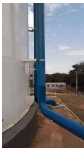
Foto 8 - Alimentação do reservatório a partir do poço.
