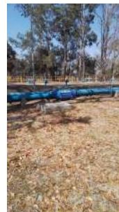
Foto 6 - Abastecimento do R46 a partir dos reservatórios enterrados.
