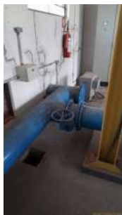
Foto 5 - Tubulação de sucção das bombas, proveniente do R38.
