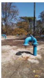
Foto 1 - Tela de proteção caindo.
