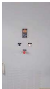
Foto 6 - Painel de comando de bombas da elevatória.
