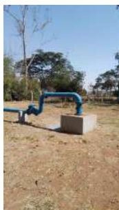
Foto 1 - Poço ETA Paiol.
