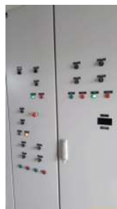
Foto 8 - Painel de comando das bombas.
