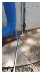
Foto 6 - Tubulação que leva mangueiras para dosagem de produtos químicos no R5A.
