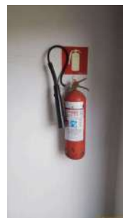
Foto 2 - Extintor na elevatória.
