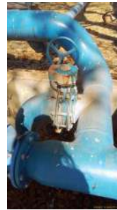
Foto 2 - Vazamento em válvula
