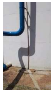
Foto 2 - Tubulação que leva mangueiras para aplicação de cloro e flúor no reservatório R38, abasteciam pelo poço.
