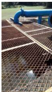
Foto 5 - Poço de sucção.
