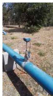
Foto 4 - Medidor de vazão na saída do poço.
