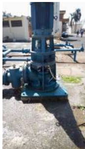
Foto 1 - Vazamento verificado no conjunto motobomba que recalca água do R16 para o R5A.
