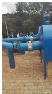
Foto 2 - Recalque das bombas.
