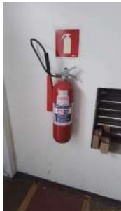
Foto 3 - Extintor na cabine elétrica.
