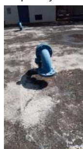
Foto 11 - Tubo para ventilação com tela de proteção.
