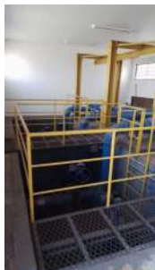
Foto 1 - Interior da elevatória.
