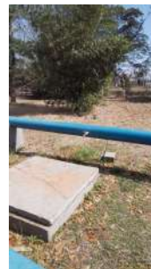
Foto 4 - Tubulação de alimentação do reservatório a partir do poço ETA Paiol
