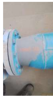
Foto 2 - Identificação da tubulação na qual se verificou vazamento em válvula.
