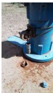
Foto 3 - Tubo para medição do nível do poço.
