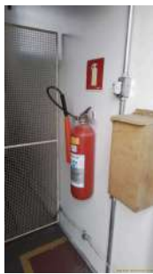
Foto 1 - Extintor na cabine elétrica.
