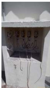
Foto 1 - Bombas dosadoras de cloro e flúor
