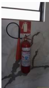
Foto 1 - Extintor na elevatória.
