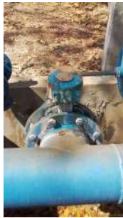
Foto 1 - Vazamento em válvula
