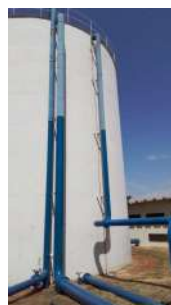
Foto 6 - Tubulações diversas: abastecimentos, saída e extravasor.
