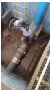
Foto 1 - Vazamento verificado em válvula da tubulação de recalque de uma das bombas da elevatória.
