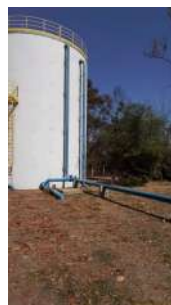
Foto 2 - Tubulação proveniente do poço para abastecer o reservatório pulmão.
