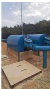
Foto 1 - Bombas da elevatória.
