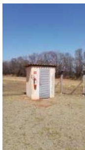
Foto 8 - Abrigo da elétrica da telemetria e extintor.
