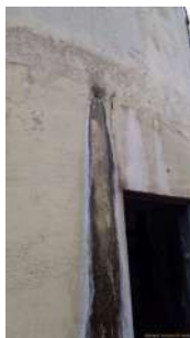
Foto 1 - Vazamento em estágio inicial.
