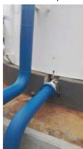
Foto 6 - Saída e alimentação do reservatório.
