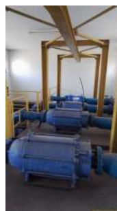
Foto 4 - 4 bombas, sendo dois recalques com 1 bomba em funcionamento e 1 reserva.
