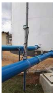
Foto 6 - Medidor de vazão na saída do poço.
