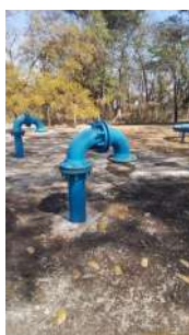
Foto 3 - Tela de proteção caindo.
