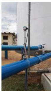
Foto 1 - Macromena saída do poço.
