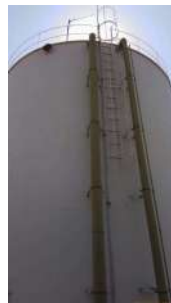
Foto 5 - Escada para manutenção, tubulações de alimentação e extravasor.
