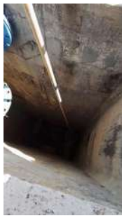
Foto 1 - Pontos com armadura exposta no exterior do reservatório. Recomenda-se avaliar a necessidade de tratar essa patologia para evitar possíveis vazamentos e infiltrações.
