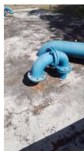
Foto 9 - Tubo para ventilação com tela de proteção.
