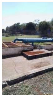
Foto 4 - Poço de sucção e bomba da captação.
