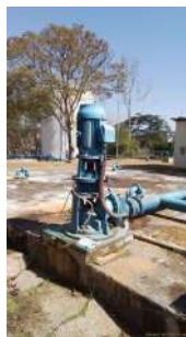
Foto 13 - Conjunto motobomba que complementa o abastecimento do reservatório R5A a partir do R16.
