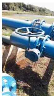
Foto 1 - Vazamento verificado em válvula.
