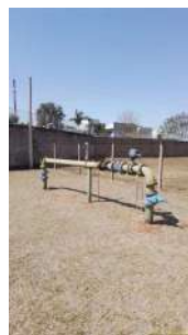
Foto 9 - Cavalete de abastecimento do reservatório. Recebe água do R5A da ETA Paiol.
