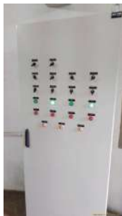
Foto 4 - Painel de comando das bombas.
