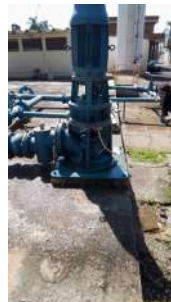
Foto 2 - Vazamento verificado no conjunto motobomba que recalca água do R16 para o R5A.
