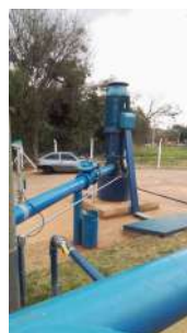
Foto 7 - Poço e recalque.
