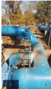
Foto 3 - Vazamento em válvula
