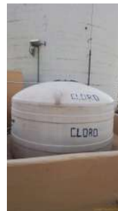
Foto 2 - Armazenamento de cloro.
