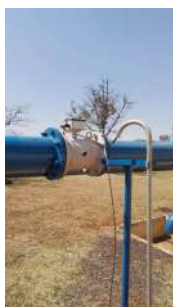
Foto 1 - Macromedidor na tubulação de recalque do poço
