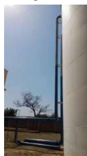
Foto 4 - Abastecimento do reservatório a partir do Poço Planalto e extravasor.
