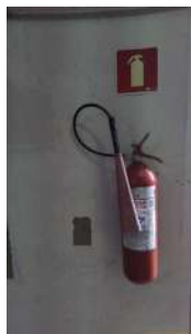
Foto 1 - Extintor na elevatória.
