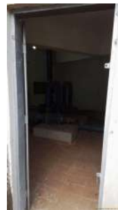
Foto 5 - Entrada da elevatória, na antecâmara do reservatório Planalto Velho.
