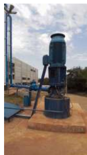
Foto 4 - Poço com bomba centrífuga vertical.
