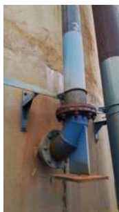
Foto 6 - Abastecimento da câmara superior à partir da câmara inferior, pelas bombas da elevatória.
