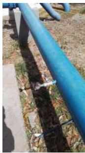
Foto 1 - Tomada para coleta de água bruta.
