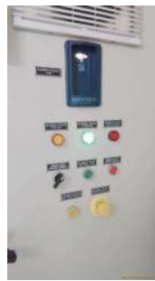
Foto 2 - Painel de comando da bomba do poço.
