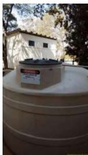
Foto 5 - Identificação do armazenamento de cloro
