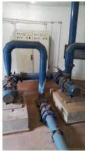
Foto 1 - Bombas da elevatória, que abastece a câmara superior do R20 a partir da câmara inferior.
