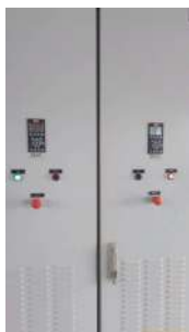
Foto 7 - Painel de comando das bombas.
