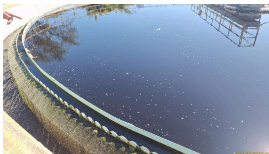
Foto 16 - Decantador - vertedores nivelados
