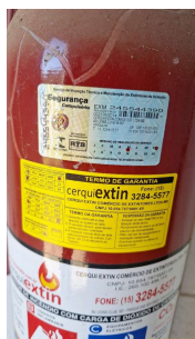
Foto 15 - Extintor - área dos sopradores
