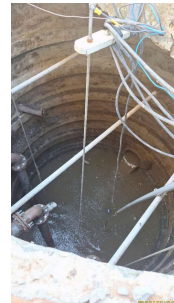
Foto 5 - Tanque pulmão - sucção do esgoto
