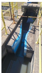
Foto 5 - Medidor Parshall com macromedido
