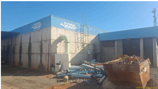
Foto 1 - Materiais de descarte no entorno do Reservatório R1
