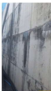
Foto 1 - Marcas de infiltração e umidade - entorno do Reservatório R1
