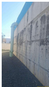
Foto 3 - Marcas de infiltração e umidade - entorno do Reservatório R1 (3)
