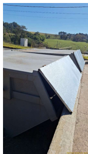
Foto 9 - Caçambas para coleta de material do tratamento preliminar
