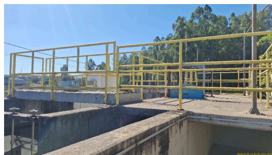
Foto 4 - Guarda corpos no tratamento preliminar
