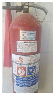
Foto 4 - Extintor de incêndio
