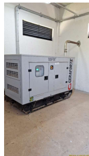
Foto 6 - Gerador de energia
