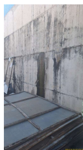
Foto 2 - Marcas de infiltração e umidade - entorno do Reservatório R1 (2)
