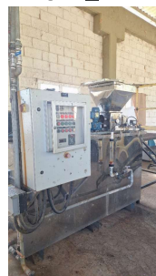
Foto 23 - Tanque de preparo de polímero
