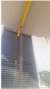
Foto 3 - Içamento monovia - acesso para manutenção
