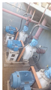
Foto 6 - Três conjuntos motobomba
