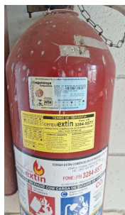
Foto 22 - extintor - área das centrífugas
