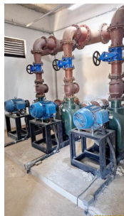
Foto 7 - Três conjuntos motobomba
