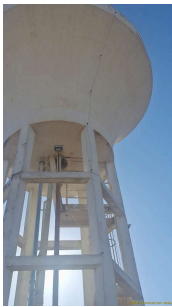
Foto 2 - Cabeamento para raios
