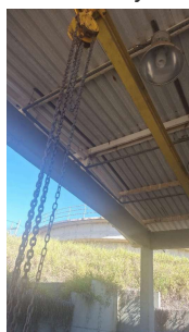
Foto 5 - Guindaste acesso às bombas para manutenção
