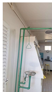
Foto 2 - Chuveiro de emergência - laboratório
