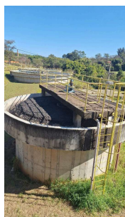
Foto 20 - Adensador do lodo - visto de cima
