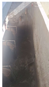
Foto 2 - Tanque pulmão e recirculação da água do adensador
