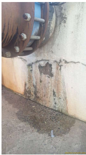
Foto 1 - Vazamento aparente na lateral do reservatório
