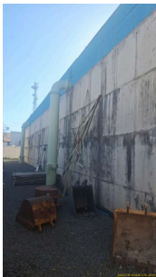
Foto 2 - Materiais de descarte no entorno do Reservatório R1
