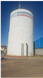
Foto 1 - Visão geral - Reservatório de três câmaras - Sede SAAEC
