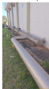
Foto 13 - Duto dos sopradores
