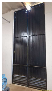
Foto 9 - Acesso aos conjuntos motobomba
