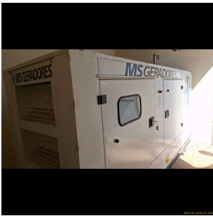
Foto 10 - Gerador de energia
