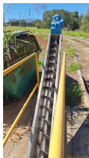
Foto 3 - Rosca helicoidal para transporte de areia do fundo do desarenador
