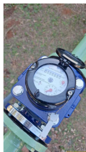
Foto 3 - Macromedidor - Poço Santa Thereza
