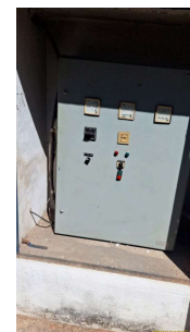
Foto 6 - Painel de comando - Poço Santa Thereza
