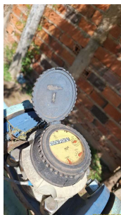
Foto 3 - Macromedidor - Poço Rollin Telles
