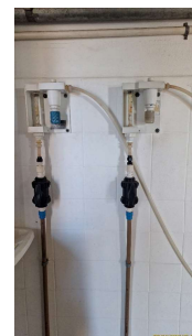
Foto 17 - Controle de pré-cloração (pré-oxidação) e cloração final
