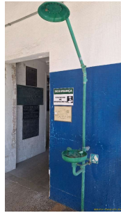
Foto 30 - Chuveiro de emergência
