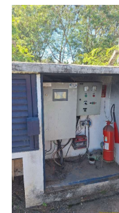
Foto 6 - Abrigo com painel de acionamento e extintor de incêndio
