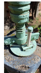
Foto 4 - Tubo medidor de nível - Poço Rollin Telles
