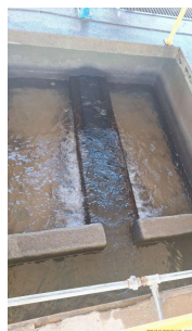
Foto 16 - Filtro em final de operação de lavagem
