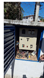
Foto 4 - Painele de acionamento do conjunto motobomba
