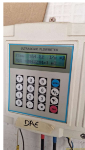
Foto 34 - Leitura de Macromedidor de saída
