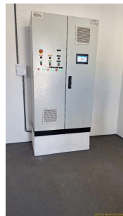
Foto 1 - Painel elétrico sem extintor próximo.
