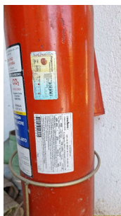
Foto 7 - Extintor de incêndio - Poço Rollin Telles
