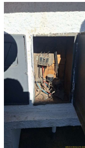
Foto 5 - Disjuntor do painel elétrico - EEE Invernada
