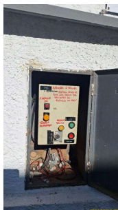
Foto 7 - Paineleletrico EEE Invernada
