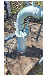
Foto 2 - Tubo medidor de nível e laje de proteção
