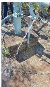
Foto 5 - Ponto de tomada de água
