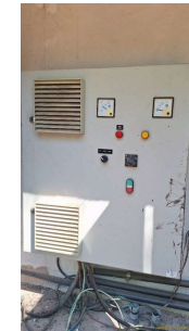
Foto 8 - Painel de comando - Poço Pessagno
