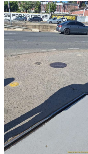
Foto 1 - Localização do Poço de Visita - EEE Invernada
