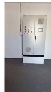
Foto 5 - Painel de comando elétrico
