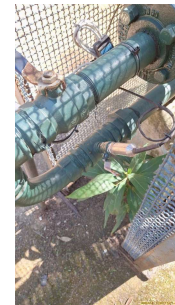
Foto 4 - Medidor de pressão - Poço Pessagno
