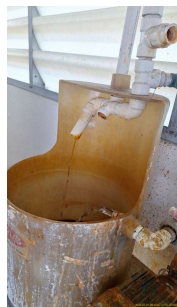
Foto 6 - Dosagem de PAC férrico - tanque de preparo
