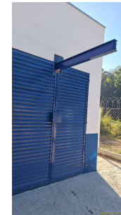
Foto 2 - Acesso para manutenção dos conjuntos motobomba
