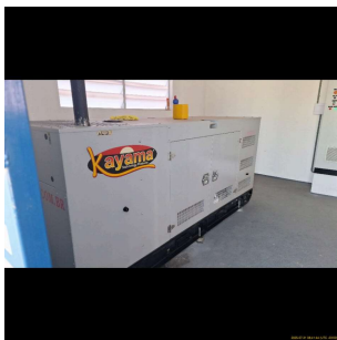
Foto 4 - Gerador da EEE
