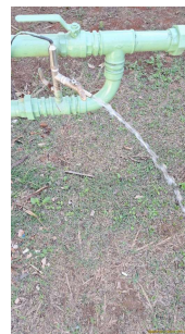
Foto 8 - Ponto de tomada de água - Poço Santa Thereza
