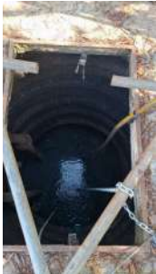
Foto 5 - Poço de sucção com apenas uma bomba instalada.
