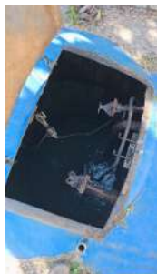
Foto 7 - Poço com apenas um conjunto motobomba instalado.
