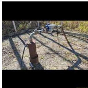
Foto 7 - Vista geral do cavalete.
