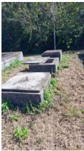
Foto 5 - Caixas de passagem.
