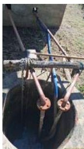
Foto 3 - Poço de sucção com um único conjunto motobomba instalado.
