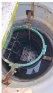
Foto 8 - Poço de sucção.
