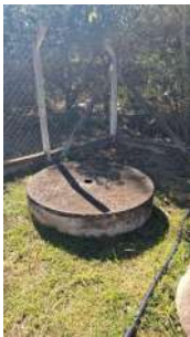
Foto 4 - Poço de chegada do efluente.
