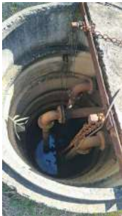
Foto 8 - Elevatória de efluente tratado.
