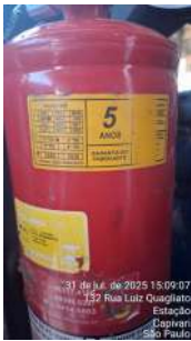
Foto 3 - Validade do extintor do caminhão de apoio.
