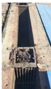
Foto 5 - Detalhe do gradeamento.
