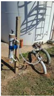
Foto 7 - Sistema de tratamento.
