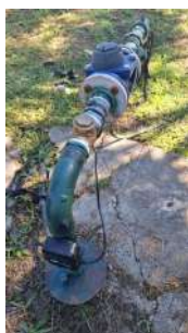
Foto 1 - Laje de proteção do poço deteriorada.
