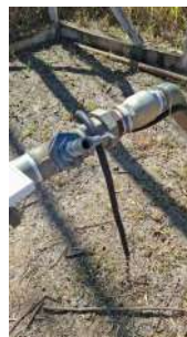
Foto 6 - Torneira para coleta de água bruta.
