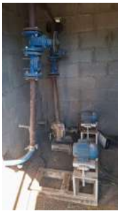
Foto 8 - Conjuntos motobombas inoperantes.
