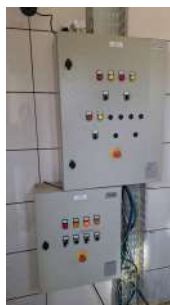
Foto 12 - Painéis de controle.
