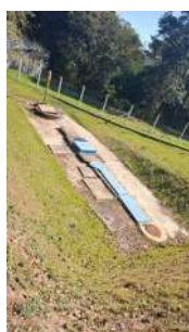
Foto 3 - Entrada do efluente.
