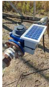
Foto 4 - Medidor de vazão com telemetria.
