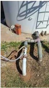
Foto 6 - Tubulação de chegada da água bruta e tubulação de saída da água tratada.
