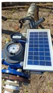
Foto 5 - Medidor de vazão.
