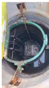
Foto 9 - Poço de sucção com cesto.
