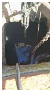
Foto 4 - Poço com um único conjunto motobomba instalado.
