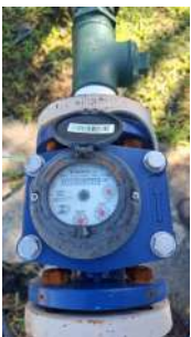
Foto 4 - Medidor de vazão.
