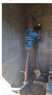
Foto 7 - Tubulações de recalque.
