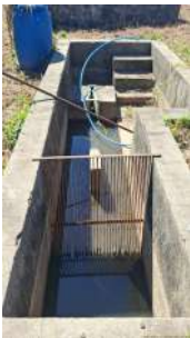
Foto 2 - Entrada do efluente.
