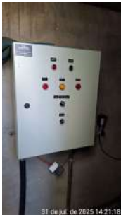
Foto 9 - Painel de controle.
