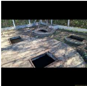
Foto 1 - Poços sem tampa.
