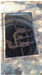
Foto 3 - Caixa de Válvulas
