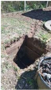
Foto 1 - Caixa de chegada de esgoto sem fechamento.
