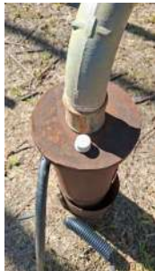
Foto 3 - Tubo de medição de nível.
