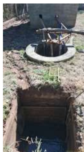
Foto 2 - Poço de entrada do efluente com grelha para retenção de sólidos. Ao fundo o poço de sucção.
