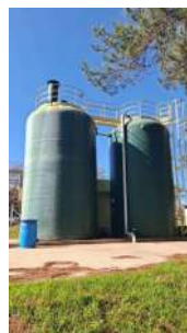
Foto 8 - Sistema de tratamento.
