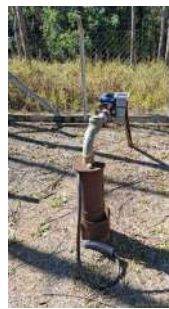
Foto 2 - Cavalete do poço.
