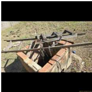
Foto 1 - Ancoragem precária do conjunto motobomba e da chave boia.
