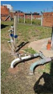
Foto 10 - Sistema de tratamento e tubulações.
