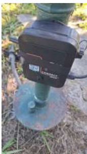
Foto 5 - Sistema de telemetria do medidor de vazão.
