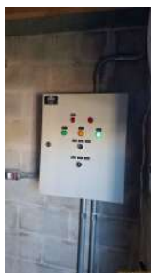
Foto 7 - Painel de controle.
