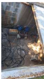
Foto 6 - Caixa de válvulas.
