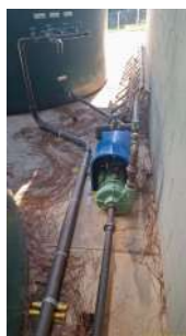
Foto 14 - Bomba para retirada de lodo.
