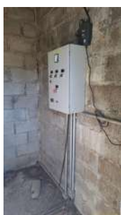
Foto 6 - PAINEL DE CONTROLE.
