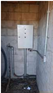
Foto 9 - Painel de controle da bomba da elevatória.
