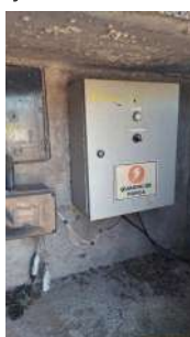
Foto 5 - Quadro de energia e comando.
