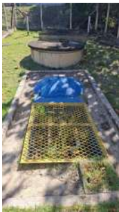
Foto 3 - Poço de sucção e caixa de válvulas.
