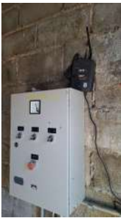
Foto 9 - Detalhe do painel de controle.
