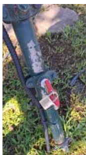
Foto 7 - Torneira de água bruta.
