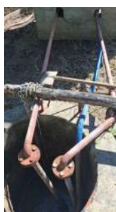
Foto 5 - Tubulações de sucção fora de uso.
