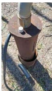
Foto 1 - Poço sem laje de proteção e com tubo camisa apresentando abertura.
