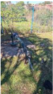
Foto 2 - Cavealete do poço.
