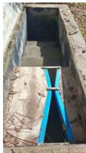
Foto 16 - Calha parshall e saída do efluente tratado.
