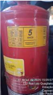
Foto 3 - Validade do extintor do caminhão de apoio.
