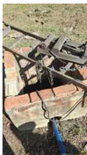
Foto 3 - Chaminé do poço, com a ancoragem do conjunto motobomba.
