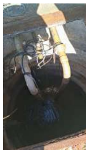
Foto 7 - Poço de sucção.
