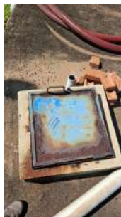
Foto 1 - Tampa de inspeção em más condições no Reservatório Vila Pereira 1 em São José do Rio Pardo
