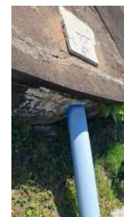
Foto 3 - Entrada da água do Reservatório Vale 1 em São José do Rio Pardo
