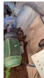
Foto 2 - Vazamento vindo do lado externo na EEA Santo Antônio em São José do Rio Pardo
