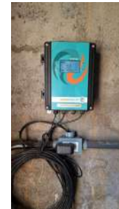
Foto 4 - Medidor de vazão do reservatório Vila Pereira 1 na EEA Vila Pereira em São José do Rio Pardo
