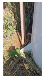
Foto 4 - Tubulações do Reservatório Mantovani em São José do Rio Pardo
