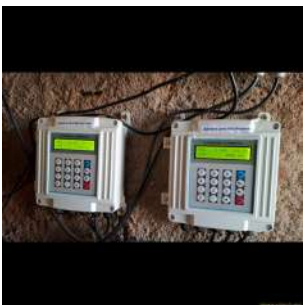
Foto 4 - Medidores de vazão da EEA Vila Formosa em São José do Rio Pardo
