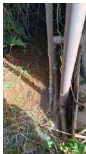
Foto 1 - Extravasor vazando água do Reservatório Mantovani em São José do Rio Pardo
