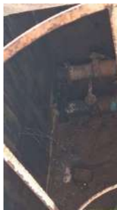
Foto 1 - Vazamento na parede lateral do Reservatório Vale 2 em São José do Rio Pardo
