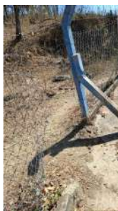
Foto 1 - Alambrado aberto no Reservatório Santo Antônio em São José do Rio Pardo
