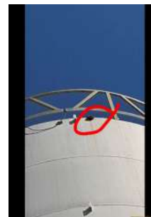
Foto 6 - Extravasador do Reservatório Vila Formosa 2 em São José do Rio Pardo
