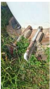
Foto 4 - Tubulação do Reservatório Vila Pereira 2 em São José do Rio Pardo
