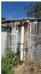
Foto 7 - Tubulações do Reservatório Santo Antônio em São José do Rio Pardo
