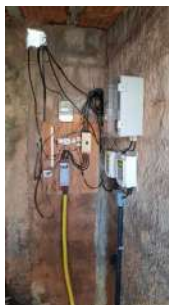
Foto 3 - Painel elétrico da EEA Vila Formosa em São José do Rio Pardo
