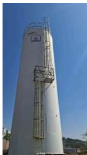
Foto 3 - Guarda-corpo do Reservatório Vila Formosa 2 em São José do Rio Pardo
