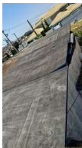
Foto 3 - Reservatório Vila Formoso 1 em São José do Rio Pardo
