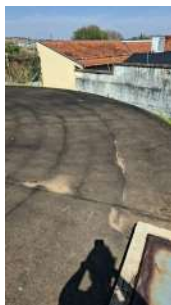
Foto 1 - Rachadura na laje do Reservatório Vila Pereira 1 em São José do Rio Pardo
