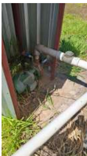
Foto 6 - Tubulação da EEA Altos do São Domingos em São José do Rio Pardo
