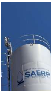
Foto 1 - Ausência de SPDA no Reservatório Mantovani em São José do Rio Pardo
