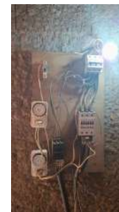
Foto 8 - Painel elétrico da EEA Lupercio Torres em São José do Rio Pardo
