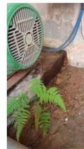
Foto 2 - Drenagem inadequada na EEA Santo Antônio em São José do Rio Pardo
