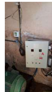
Foto 2 - Painelelétrico na EEA Santo Antônio em São José do Rio Pardo
