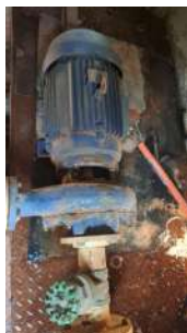
Foto 1 - Vazamento na gaxeta da EEA Santa Tereza em São José do Rio Pardo
