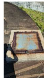
Foto 2 - Tampa de inspeção em más condições no Reservatório Vila Pereira 1 em São José do Rio Pardo
