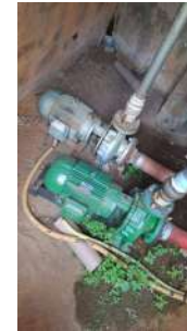
Foto 2 - Bomba da EEA Vila Pereira em São José do Rio Pardo
