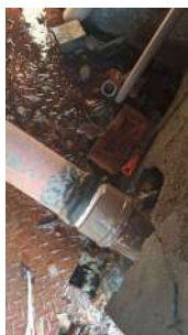
Foto 1 - Vazamento na união da EEA Santa Tereza em São José do Rio Pardo
