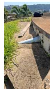
Foto 10 - Entrada da água do Reservatório Vila Formoso 1 em São José do Rio Pardo
