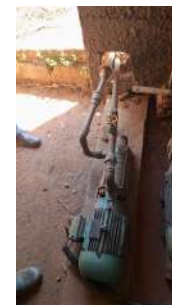
Foto 6 - Bomba do Reservatório Mantovani na EEA Lupercio Torres em São José do Rio Pardo
