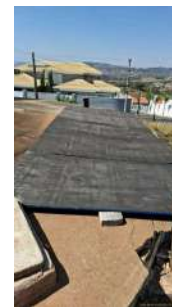
Foto 2 - Cobertura provisória onde a laje cedeu do Reservatório Vila Formoso 1 em São José do Rio Pardo
