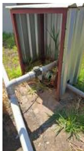
Foto 5 - Bombas do Reservatório Vila Formosa 2 em São José do Rio Pardo
