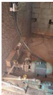
Foto 3 - Bombas da EEA Lupercio Torres em São José do Rio Pardo
