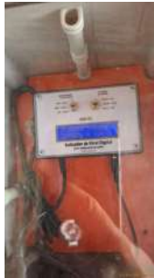
Foto 1 - Medidor de nível do Reservatório Vila Formoso 1 em São José do Rio Pardo
