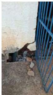
Foto 1 - Ausência de conservação na EEA Vila Formosa em São José do Rio Pardo
