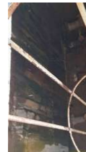
Foto 2 - Vazamento na parede lateral do Reservatório Vale 2 em São José do Rio Pardo
