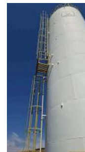
Foto 2 - Guarda-corpo do Reservatório Vila Formosa 2 em São José do Rio Pardo
