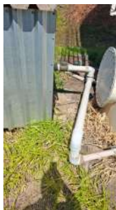
Foto 5 - Tubulação da EEA Altos do São Domingos em São José do Rio Pardo
