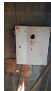
Foto 4 - Painel elétrico da EEA Santa Tereza em São José do Rio Pardo
