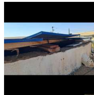
Foto 4 - Reservatório Vila Formoso 1 em São José do Rio Pardo
