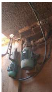
Foto 5 - Bombas da EEA Lupercio Torres em São José do Rio Pardo
