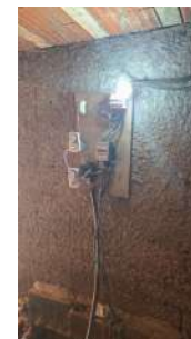
Foto 4 - Painel elétrico da EEA Lupercio Torres em São José do Rio Pardo
