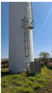
Foto 4 - Vista da EEA Altos do São Domingos em São José do Rio Pardo
