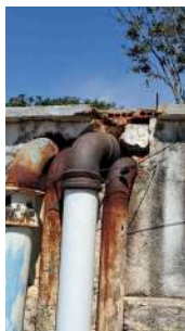
Foto 1 - A entrada/saída das tubulações no reservatório está quebrada no Reservatório Santo Antônio em São José do Rio Pardo
