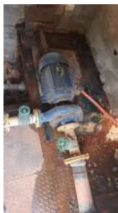
Foto 3 - Bomba da EEA Santa Tereza em São José do Rio Pardo
