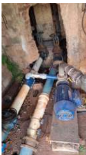
Foto 2 - Tubulações da EEA Vila Formosa em São José do Rio Pardo
