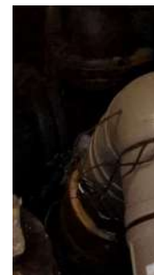
Foto 2 - Vazamento na tubulação de sucção da bomba da EEA Vila Pereira em São José do Rio Pardo
