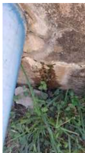
Foto 1 - Vazamento abaixo da tubulação de entrada no Reservatório Vale 1 em São José do Rio Pardo
