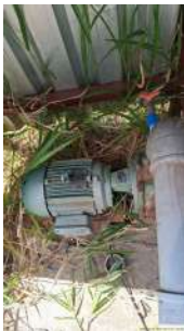
Foto 2 - Bomba da EEA Altos do São Domingos em São José do Rio Pardo
