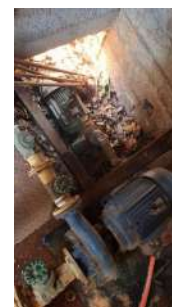
Foto 6 - Bomba da EEA Santa Tereza em São José do Rio Pardo
