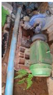
Foto 3 - Drenagem inadequada na EEA Santo Antônio em São José do Rio Pardo
