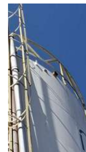
Foto 2 - Tubulação de ventilação do Reservatório Vila Pereira 2 em São José do Rio Pardo
