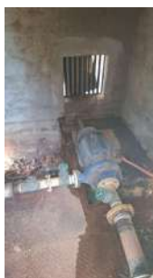
Foto 5 - Bomba da EEA Santa Tereza em São José do Rio Pardo
