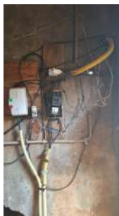
Foto 5 - Pannel elétrico da EEA Vila Pereira em São José do Rio Pardo
