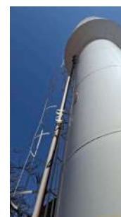
Foto 6 - uarda-corpo do Reservatório Mantovani em São José do Rio Pardo
