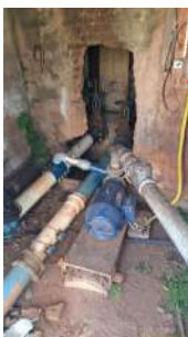
Foto 6 - Tubulações da EEA Vila Formosa em São José do Rio Pardo
