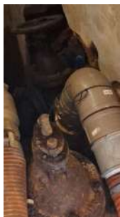
Foto 1 - Vazamento na tubulação de sucção da bomba da EEA Vila Pereira em São José do Rio Pardo
