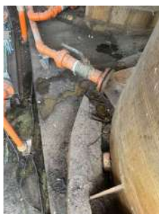
Foto 1 - Vazamento no piso, próximo aos tanques do polímero utilizado no tratamento do lodo.
