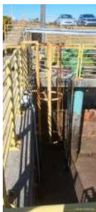
Foto 1 - Gaiola de proteção da escada de acesso ao tanque da estação elevatória de esgoto (pós tratamento preliminar), em estado avançado de oxidação.
