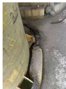
Foto 2 - Vazamento no piso, próximo aos tanques do polímero utilizado no tratamento do lodo.
