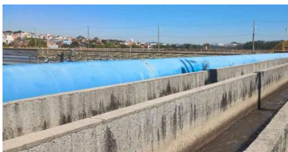
Foto 29 - Canal de distribuição do efluente pós desarenação.
