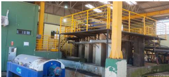
Foto 18 - Adensamento e centrifuga do lodo.
