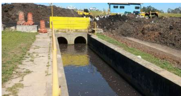
Foto 41 - Saída 3 (lagoa 5 de decantação) do efluente tratado.
