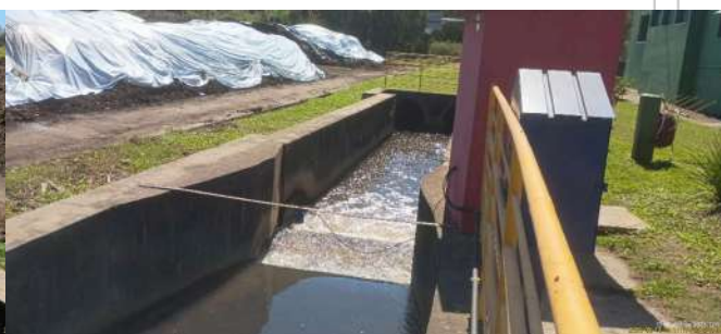
Foto 42 - Saída 3 (lagoa 5 de decantação) do efluente tratado e macromedidor de saída.
