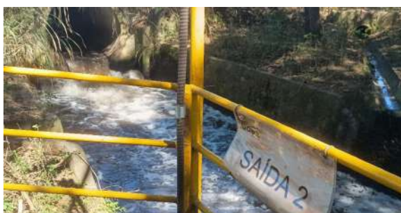
Foto 39 - Saída 2 (Lagoas 3 e 4 de decantação) do efluente tratado.
