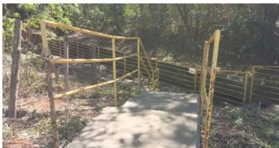
Foto 35 - Saída 1 (Lagoas 1 e 2 de decantação) do efluente tratado.
