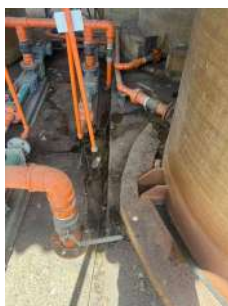
Foto 3 - Vazamento no piso, próximo aos tanques do polímero utilizado no tratamento do lodo.
