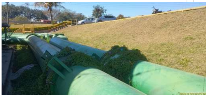
Foto 11 - Linhas de recalque da estação elevatória de esgoto para os desarenadores.
