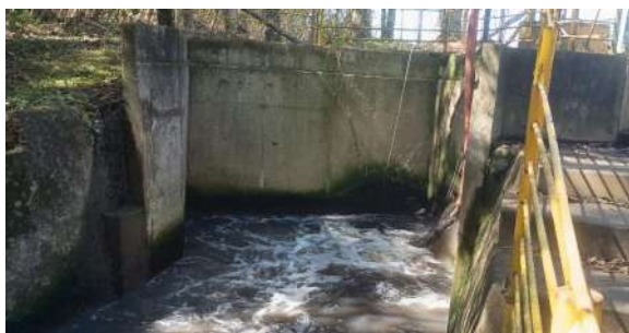
Foto 37 - Saída 1 (Lagoas 1 e 2 de decantação) do efluente tratado.
