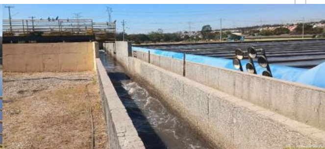
Foto 28 - Canal de distribuição do efluente pós desarenação.
