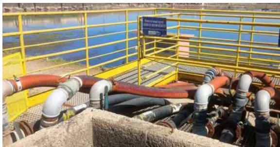
Foto 19 - Chegada do lodo das lagoas de decantação, previamente ao adensamento e centrifugas.
