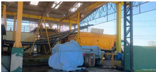
Foto 17 - Adensamento e centrifuga do lodo.
