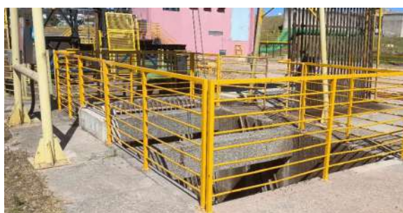
Foto 3 - Tratamento preliminar (gradeamento grosseiro com limpeza manual).
