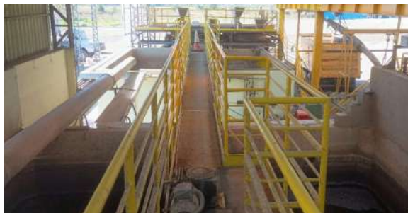
Foto 22 - Adensamento e centrifuga do lodo.
