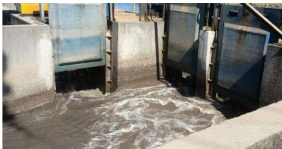
Foto 31 - Ponto de distribuição do efluente entre as lagoas 1, 2 e 3 de aeração.
