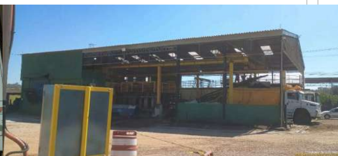
Foto 15 - Galpão das centrífugas de lodo.
