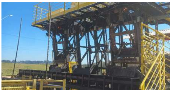
Foto 7 - Tratamento preliminar (gradeamento médio com limpeza automatizada).
