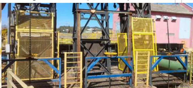
Foto 6 - Tratamento preliminar (gradeamento médio com limpeza automatizada).
