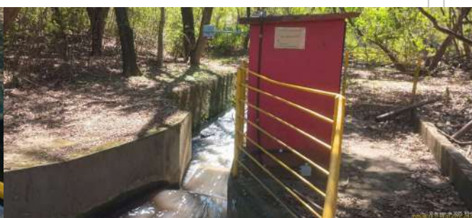
Foto 40 - Saída 2 (Lagoas 3 e 4 de decantação) do efluente tratado e macromedidor de saída.
