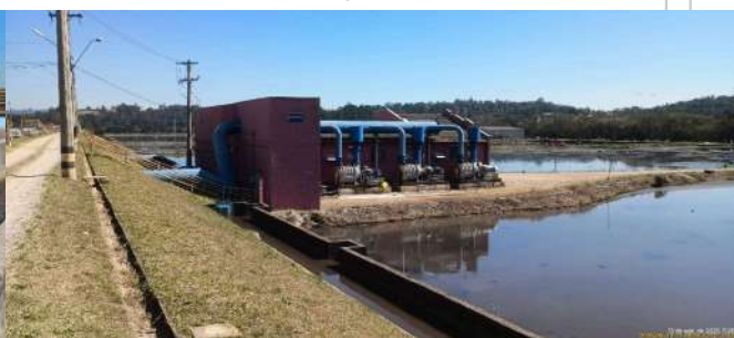
Foto 30 - Casa de máquinas dos sopradores (aeração)
