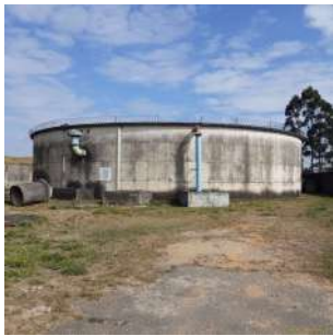
Foto 12 - Vista geral do Reservatório III. Nesta imagem é possível visualizar a tubulação de chegada da água no reservatório.
