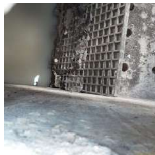
Foto 5 - Gradeamento grosseiro instalado no ponto de chegada do esgoto na ETE.
