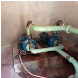
Foto 2 - Vista geral da elevatória.
