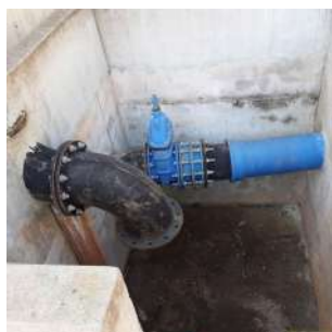
Foto 11 - Tubulação de comunicação entre os Reservatórios II e III (na cor azul).
