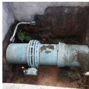
Foto 11 - Tubulação de comunicação entre os Reservatórios II e III.
