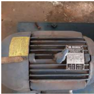
Foto 4 - Detalhe do conjunto moto bomba 1.
