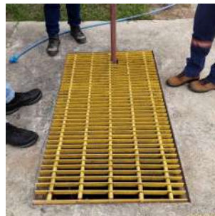
Foto 3 - Ponto de chegada do esgoto na elevatória.
