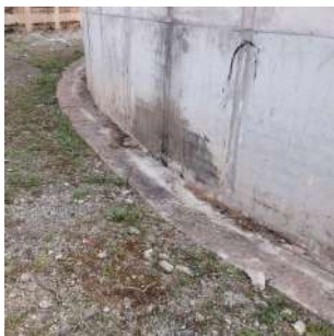
Foto 2 - Vazamento na base do Reservatório I.
