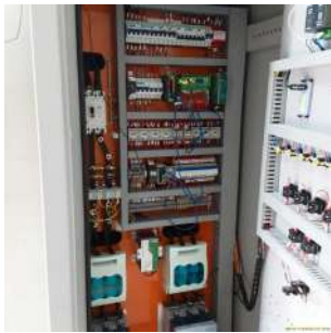
Foto 9 - Detalhe do painel elétrico.
