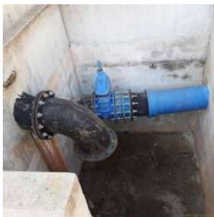
Foto 2 - Tubo extravasor do Reservatório III, sem tela de proteção.
