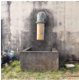
Foto 2 - Tubo extravasor do Reservatório II, sem tela de proteção.
