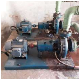
Foto 3 - Vista geral da elevatória.
