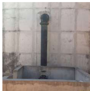
Foto 10 - Tubo extravasor do Reservatório III.
