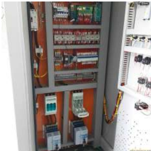
Foto 9 - Detalhe do painel elétrico.
