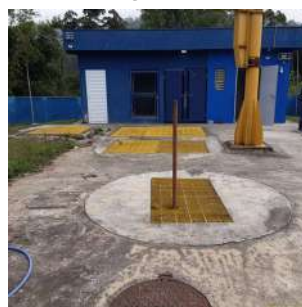
Foto 4 - Ponto de chegada do esgoto na elevatória.
