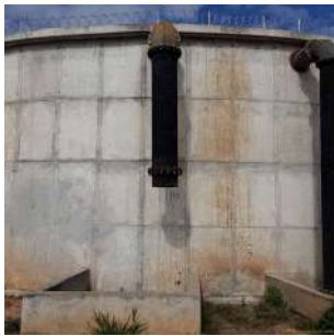
Foto 1 - Tubo extravasor do Reservatório I, sem tela de proteção.
