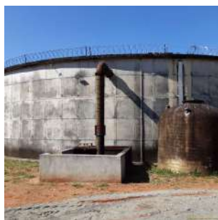
Foto 6 - Tubulação de chegada da água no reservatório II.
