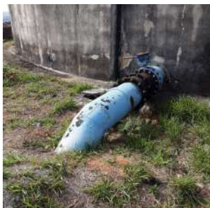
Foto 10 - Tubulação de comunicação entre os Reservatórios II e III.
