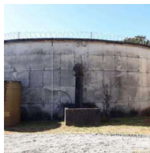
Foto 7 - Tubo extravasor do Reservatório II.
