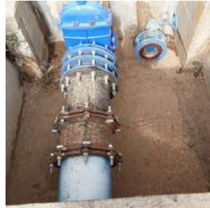
Foto 5 - Tubulação de saída da água do Reservatório I, que se comunica com a tubulação de saída do Reservatório III.
