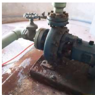
Foto 3 - O sistema está falho nas duas bombas.
