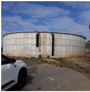
Foto 3 - Vista geral do Reservatório I. Nesta imagem é possível visualizar o tubo extravasor (à esquerda) e a tubulação de chegada da água no reservatório (à direita).
