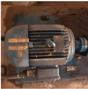
Foto 5 - Detalhe do conjunto moto bomba 2.
