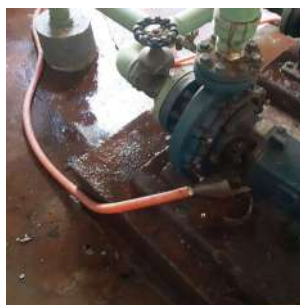
Foto 2 - Detalhe do sistema instalado para captação da água que sai das gaxetas, trata-se de um sistema improvisado com tubos corrugados e garrafas pet.
