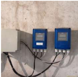
Foto 6 - Medidores de vazão.
