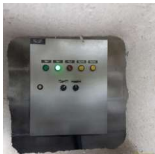
Foto 10 - Painel elétrico no interior da edificação.
