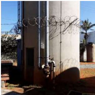
Foto 3 - Tubulações e registros do reservatório.
