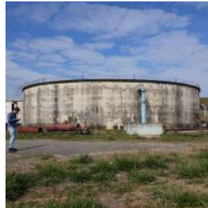
Foto 7 - Vista geral do Reservatório II. Nesta imagem é possível visualizar a tubulação de chegada da água no reservatório.
