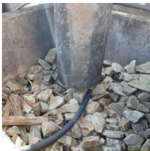
Foto 1 - Tubo extravasor do Reservatório II, sem tela de proteção.
