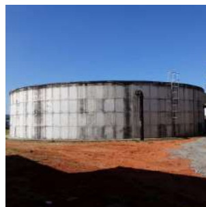
Foto 8 - Vista geral do Reservatório III. Nesta imagem é possível visualizar a tubulação de chegada da água no reservatório.
