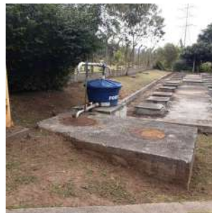
Foto 7 - Ponto de saída do efluente tratado. Segundo informações do prestador, o efluente tratado é lançado na rede coletora de esgotos.
