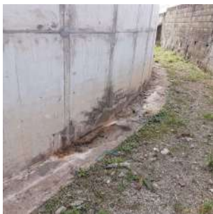
Foto 1 - Vazamento na base do Reservatório I.
