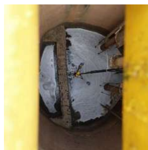
Foto 6 - Vista interna do poço de bombeamento com duas bombas instaladas.
