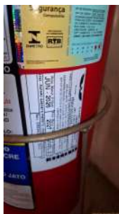
Foto 17 - Validade do extintor da sala dos sopradores.
