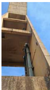
Foto 5 - Tubulações do reservatório.
