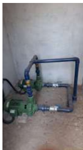
Foto 3 - Sistema de recalque.
