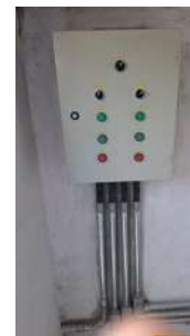
Foto 4 - Painel de controle.
