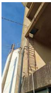
Foto 5 - Fiação elétrica em contato com escada metálica.
