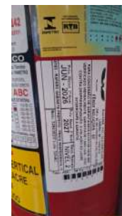
Foto 12 - Validade do extintor na parede.
