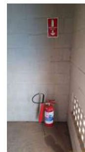
Foto 16 - Extintor de incêndio da sala dos sopradores.
