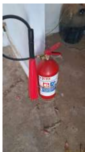
Foto 9 - Extintor de incêndio no suporte de chão.
