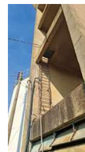
Foto 2 - Escada metálica em contato com fiação elétrica.
