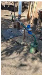
Foto 1 - Poço com laje de proteção danificada.
