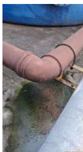
Foto 1 - Vazamento na tubulação dos reatores UASB.
