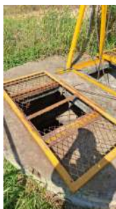
Foto 1 - Grade de proteção do poço.
