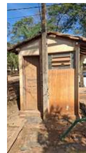
Foto 8 - Abrigo do painel de controle.
