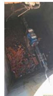
Foto 8 - Saída da água tratada com medidor de vazão.
