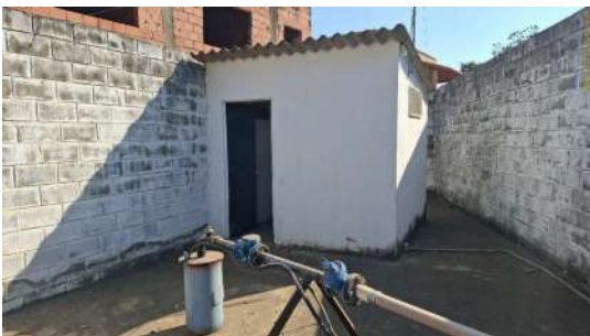
Foto 13 - Vista geral do cavelete e do abrigo.
