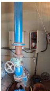
Foto 7 - Tubulação de recalque e painéis.
