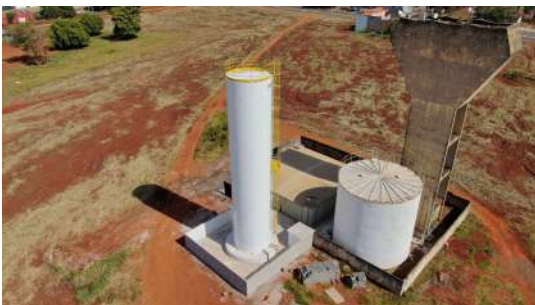
Foto 7 - Vista do sistema de reservação.
