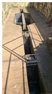
Foto 3 - Gradeamento e canal de remoção de areia.
