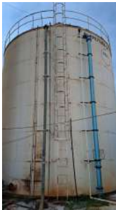
Foto 3 - Tubulações e escada do reservatório.
