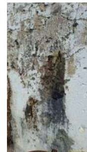
Foto 2 - Outro vazamento na parede frontal.
