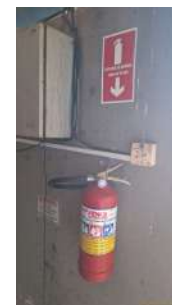
Foto 6 - Extintor de incêndio.
