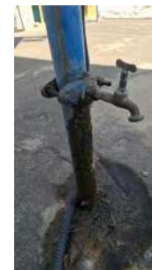
Foto 2 - Detalhe do vazamento.
