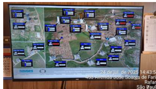
Foto 10 - CCO com os níveis dos reservatórios.
