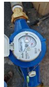
Foto 4 - Medidor de vazão.
