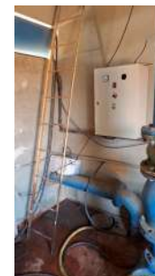
Foto 10 - Painel de Controle.
