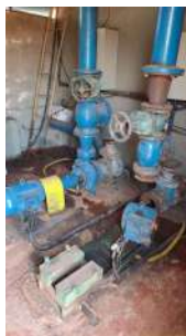
Foto 1 - Sistema de recalque, sem o conjunto motobomba reserva.
