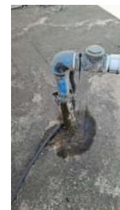
Foto 6 - Torneira para coleta de água bruta.
