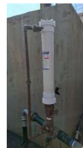
Foto 6 - Dosador de cloro e flúor.
