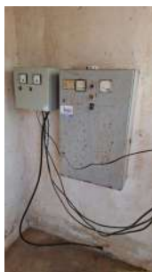
Foto 9 - Painel de controle.
