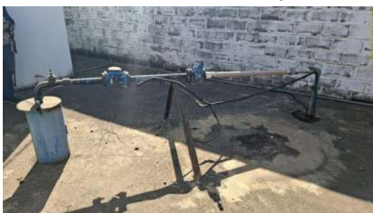
Foto 3 - Cavalete do poço.
