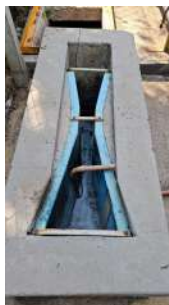
Foto 13 - Saída do efluente tratado.
