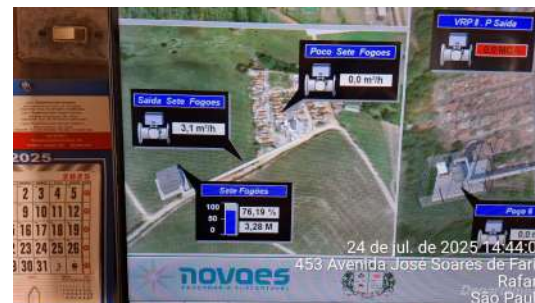
Foto 16 - Detalhe do monitoramento de nível e vazão de saída do Reservatório Sete Fogões.
