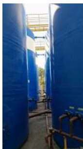
Foto 11 - Tubulação entre os UASB e FAS
