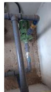
Foto 6 - Segundo conjunto motobomba.
