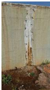
Foto 1 - Primeiro vazamento encontrado.
