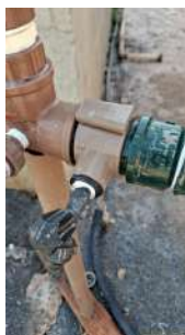
Foto 5 - Torneira para coleta de água bruta.
