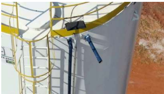
Foto 1 - Extravasor sem tela de proteção.
