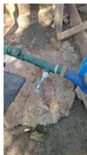
Foto 5 - Torneira para coleta de água bruta.
