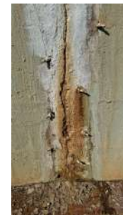
Foto 2 - Detalhe do primeiro vazamento.
