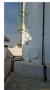
Foto 4 - Tubulações e base do reservatório.
