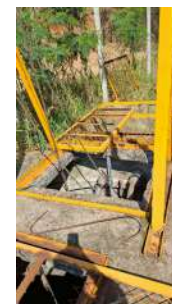
Foto 2 - Poço sem grade de proteção.
