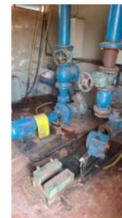
Foto 4 - Sistema de recalque.
