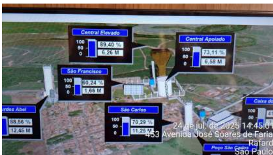
Foto 13 - Detalhe do nível do reservatório no CCO.
