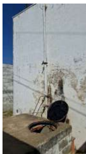
Foto 9 - Detalhe da caixa onde está o medidor de vazão.
