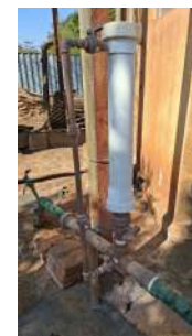
Foto 6 - Dosador de cloro e flúor.
