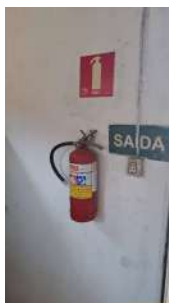
Foto 11 - Extintor de incêndio na parede.
