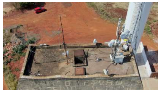
Foto 6 - Cobertura sem guarda-corpo.
