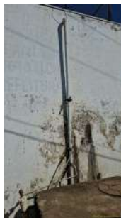
Foto 7 - Tubulação de entrada da água.
