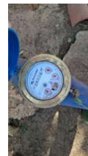
Foto 4 - Medidor de vazão.
