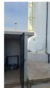
Foto 2 - Abrigo da Estação Elevatória de Água Tratada (EEAT) e, ao fundo, o reservatório elevado Jardim Europa.
