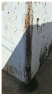
Foto 3 - Vazamento na quina do reservatório.
