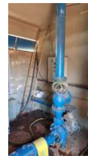
Foto 8 - Conjunto motobomba e tubulação de recalque.
