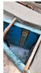
Foto 14 - Régua de medição de vazão na calha parshall.
