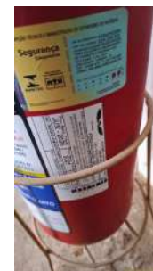
Foto 10 - Validade do extintor de incêndio do suporte.
