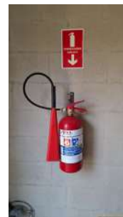
Foto 20 - Extintor de incêndio.
