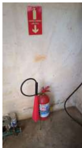
Foto 1 - Extintor de incêndio.
