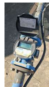
Foto 4 - Medidor de vazão.
