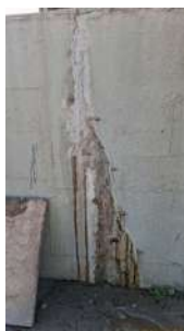
Foto 3 - Outro vazamento na parede do reservatório.
