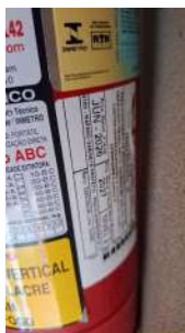
Foto 11 - Validade do extintor de incêndio.
