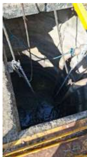
Foto 7 - Poço de sucção.
