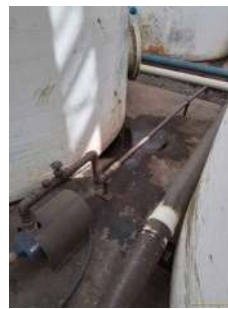
Foto 2 - Vazamento 2, UASB de fibra.
