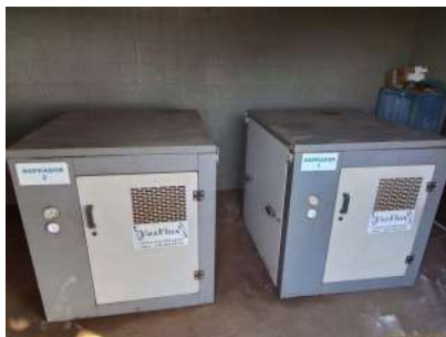
Foto 20 - Sopradores do UASB fibra (operam alternadamente).
