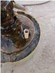
Foto 4 - Tubo de medição de nível.
