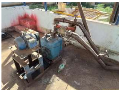
Foto 5 - Bomba utilizada na EEE.
