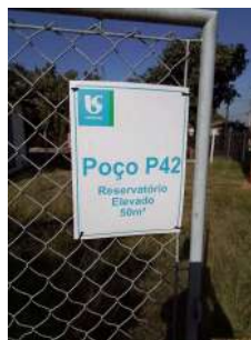
Foto 2 - Identificação do poço e reservatório.
