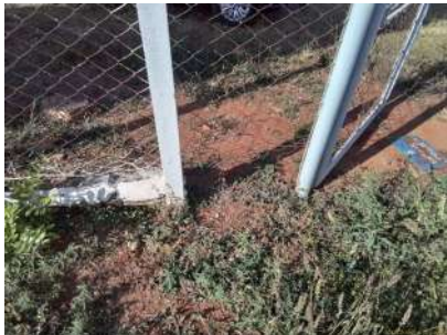
Foto 3 - Local 3 - cercamento danificado.
