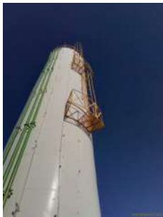
Foto 1 - Ausência de escada para acesso ao topo do reservatório.
