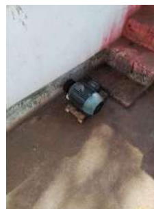
Foto 6 - Bomba reserva, ao lado.
