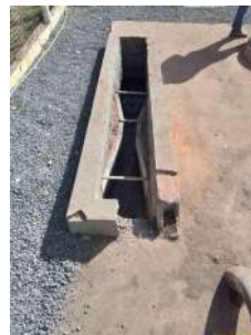
Foto 15 - Saída dos reatores UASB em fibra, com aplicação de desinfetante.
