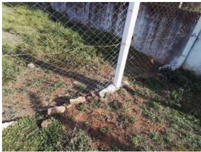
Foto 1 - Local 1 - cercamento danificado.
