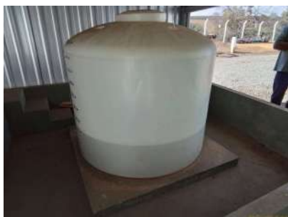
Foto 1 - Tanque de cloro sem identificação.
