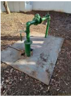
Foto 2 - Vista do Poço P770.
