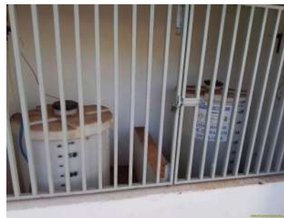
Foto 6 - Armazenamento do cloro e flúor utilizado.
