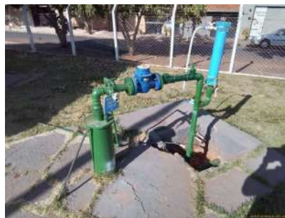
Foto 4 - Vista do poço P-42.
