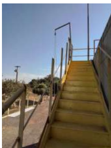
Foto 1 - Escada sem guarda-corpo, junto ao módulo de concreto.
