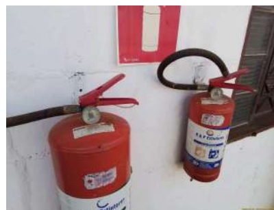
Foto 2 - Extintor próximo ao almoxarifado e com validade expirada.
