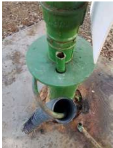
Foto 5 - Tubo de medição de nível.
