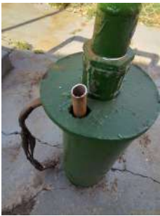
Foto 5 - Tubo de medição de nível.
