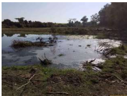
Foto 3 - Vista da lagoa anaeróbia com acúmulo de vegetação em seu interior e em torno.
