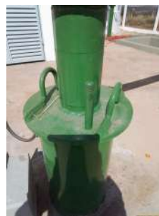
Foto 4 - Tubo de medição de nível do poço.
