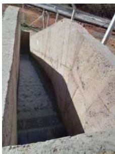
Foto 33 - Saída do efluente tratado.
