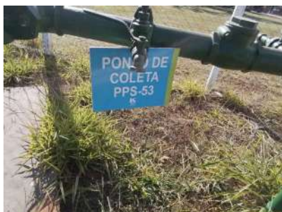
Foto 7 - Torneira para coleta de água bruta.
