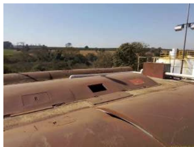
Foto 2 - Topo do módulo de concreto, sem guarda-corpos no seu entorno.
