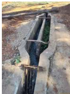
Foto 10 - Acúmulo de detritos na calha Parshall, junto à chegada do esgoto bruto.
