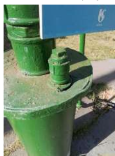
Foto 6 - Tubo de medição de nível.
