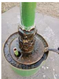
Foto 1 - Vazamento no poço.
