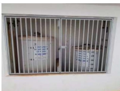
Foto 5 - Tanques de produtos químicos.
