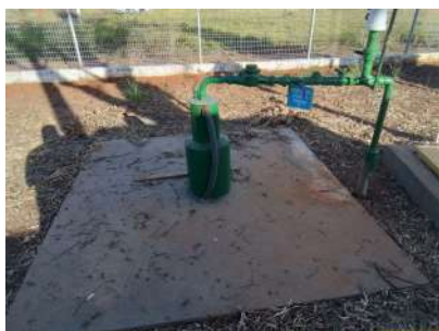
Foto 1 - Vista do poço P-92.
