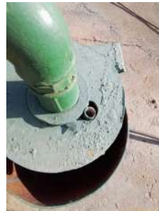
Foto 4 - Tubo de medição de nível.
