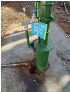
Foto 3 - Torneira para coleta de água bruta.
