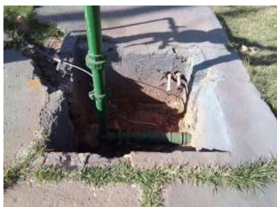
Foto 1 - Abertura junto ao poço representando risco ao operador.
