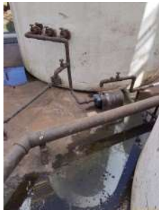
Foto 3 - Vazamento 3, UASB de fibra.
