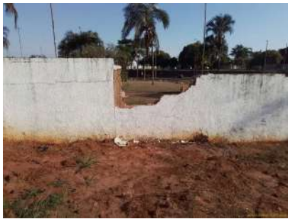
Foto 1 - Detalhe do cercamento danificado.
