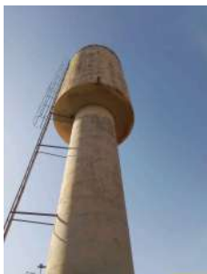
Foto 1 - Indícios de vazamento na lateral do reservatório.
