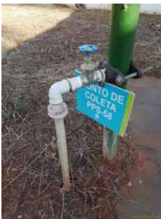
Foto 2 - Torneira para coleta de água bruta.
