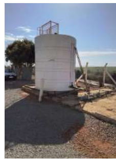
Foto 23 - Tanque de equalização da ETE.
