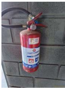
Foto 22 - Extintor junto aos sopradores do UASB fibra.
