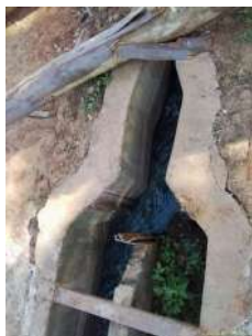
Foto 1 - Chegada do esgoto bruto pela calha Parshall, sem qualquer medidor de vazão na entrada.
