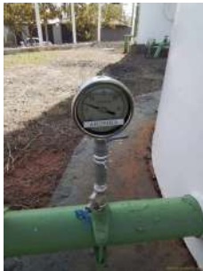
Foto 7 - Manômetro do reservatório inoperante.
