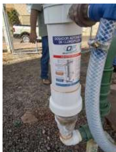
Foto 7 - Aplicação automática de cloro e flúor.
