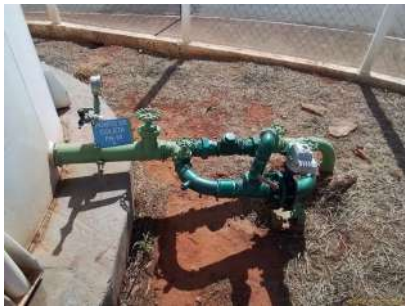
Foto 3 - Saída do reservatório, com manômetro instalado.
