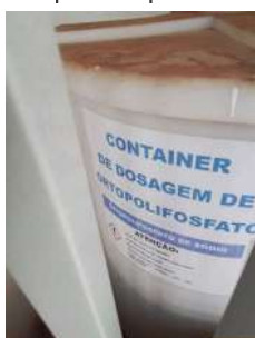
Foto 7 - Container de dosagem de ortopolifosfato.
