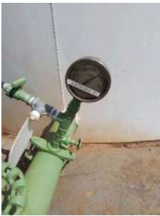
Foto 4 - Manômetro do reservatório operante. O mesmo também está ligado no sistema de telemetria da SABESP.
