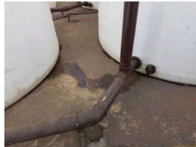
Foto 4 - Vazamento 4, UASB de fibra.
