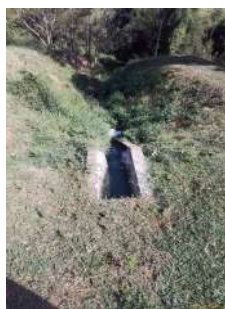
Foto 9 - Saída do efluente tratado.
