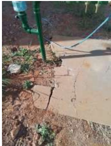
Foto 1 - Detalhe da laje danificada.
