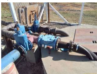
Foto 9 - Detalhe das tubulações da EEE.
