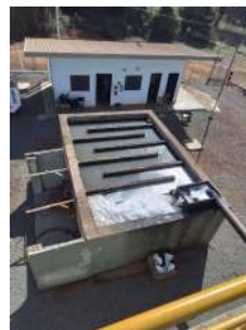
Foto 26 - Tanque de contato junto aos tanques de concreto.
