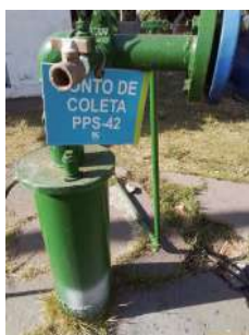
Foto 5 - Torneira para coleta de água bruta.
