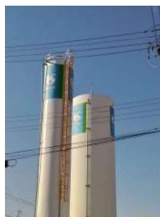
Foto 2 - Detalhe da haste captora.
