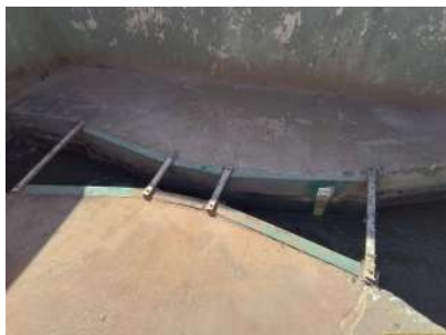
Foto 7 - Calha Parshall ao término do tratamento preliminar e antecedendo a EEE.
