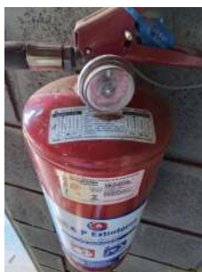
Foto 1 - Extintor próximo aos sopradores do UASB em fibra e com validade expirada.
