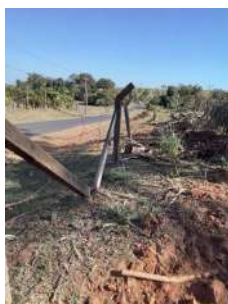
Foto 1 - Detalhe da cerca danificada.
