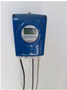
Foto 4 - Macromedidor com medição zerada.
