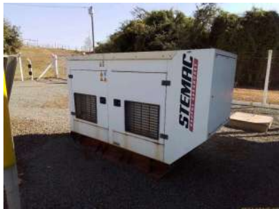
Foto 29 - Gerador a diesel da ETE.
