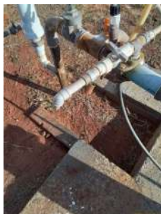
Foto 5 - Torneira para coleta de água bruta.
