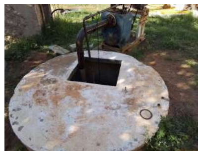
Foto 4 - Poço de sucção (após passar pelo gradeamento).
