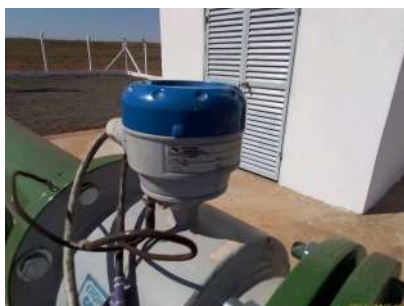
Foto 1 - Detalhe do macromedidor.
