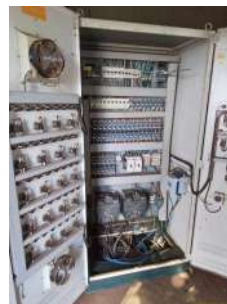
Foto 21 - Painel elétrico junto aos sopradores do UASB fibra.
