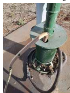
Foto 8 - Tubo de medição de nível.
