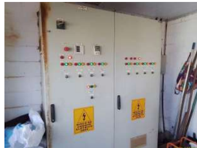
Foto 30 - Painel elétrico no abrigo, próximo ao gerador.
