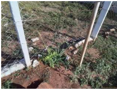
Foto 2 - Local 2 - cercamento danificado.
