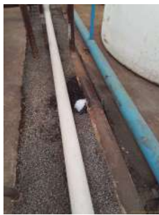
Foto 1 - Vazamento 1, UASB de fibra.
