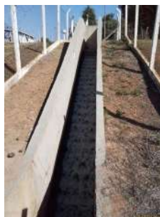
Foto 34 - Saída do efluente tratado.
