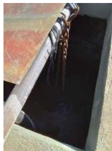
Foto 8 - Poço de sucção da EEE, a partir do qual o esgoto é recalcado aos reatores UASB (fibra).
