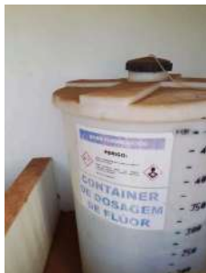
Foto 7 - Tanque de flúor.
