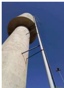
Foto 4 - Parte inferior do reservatório com acúmulo de umidade.
