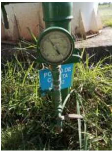
Foto 2 - Manômetro junto do reservatório.
