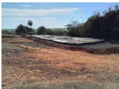
Foto 11 - Bag para acúmulo de lodo.
