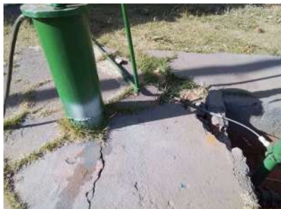
Foto 1 - Detalhe da laje danificada.
