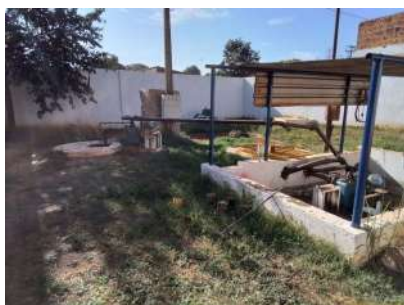
Foto 3 - Vista geral da EEE.
