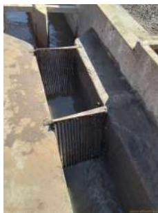
Foto 3 - Chegada do esgoto bruto - gradeamento.
