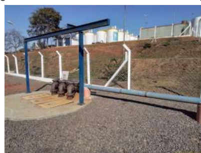
Foto 10 - Poço de sucção da EEE, a partir do qual o esgoto é recalcado aos reatores UASB (concreto).
