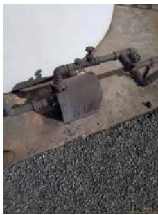
Foto 13 - Bomba de recirculação do UASB em fibra.
