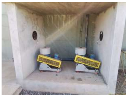
Foto 27 - Sopradores utilizados na ETE de concreto, sendo um reserva.
