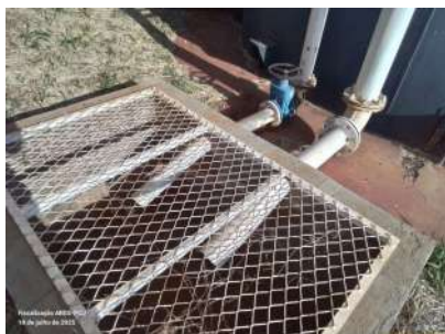
Foto 5 - Saída dos tubos extravasores.
