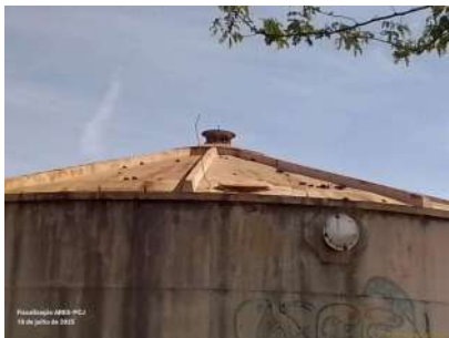
Foto 1 - Ventilação sem tela de proteção.
