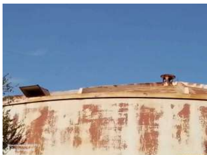
Foto 3 - Tubulação de ventilação do topo e lateral sem tela.
