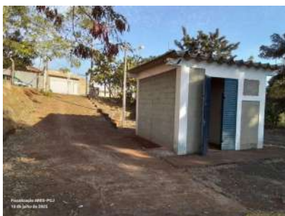
Foto 9 - Vista do abrigo do gerador e painel elétrico.
