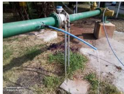
Foto 6 - Tomada de água bruta.
