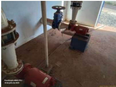
Foto 7 - Canal de drenagem das gaxetas.
