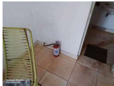
Foto 10 - Extintor do local.
