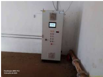
Foto 3 - Painel elétrico da EEA.
