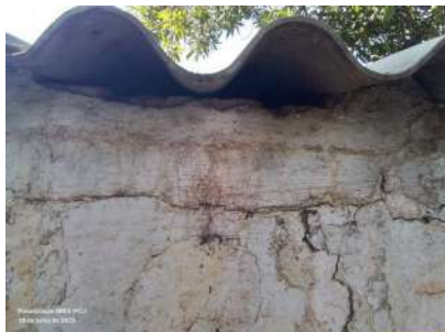
Foto 1 - Abertura sem proteção na junção do telhado com a parede.
