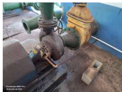
Foto 4 - Drenagem da gaxeta da bomba 2.
