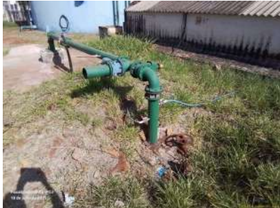
Foto 6 - Linha de recalque com dosagem de cloro e fluor.
