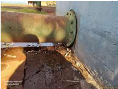
Foto 1 - Vazamento na junção da tubulação com a alvenaria.
