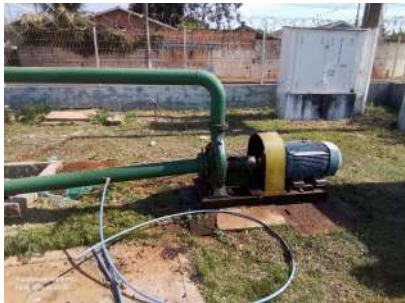
Foto 2 - Vista interna da EEA.
