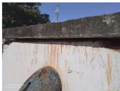
Foto 2 - Abertura entre a laje e as paredes.
