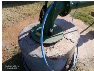
Foto 4 - Tubo de nível e laje de proteção.
