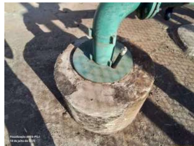
Foto 3 - Tubo de medição de nível e laje de proteção.
