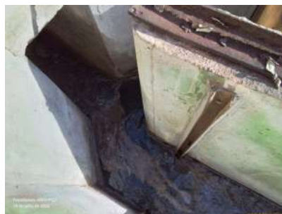
Foto 2 - Material acumulado no início da caixa de areia.
