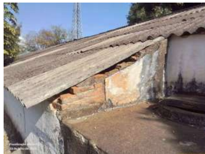
Foto 2 - Abertura sem proteção na junção do telhado com a parede.
