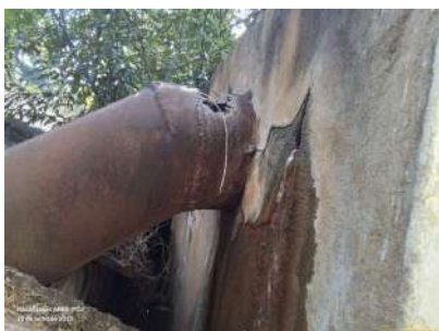
Foto 3 - Tubulação corroída e aberta a contaminantes.
