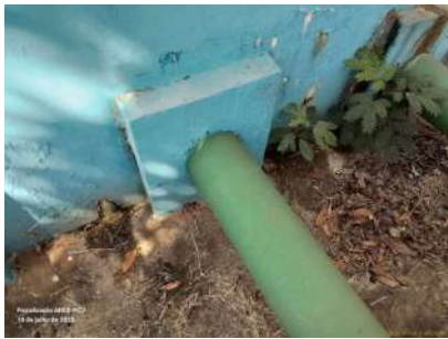
Foto 3 - Vazamento no chão junto às tomadas de água.
