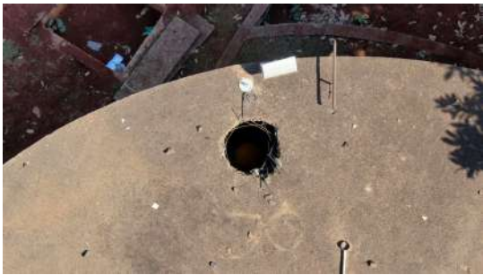
Foto 3 - Abertura na laje sem proteção.
