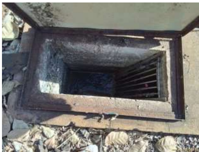
Foto 3 - Chegada e gradeamento.
