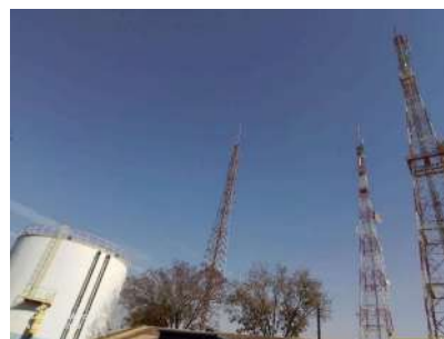
Foto 2 - Antenas nas proximidades com para-raios.
