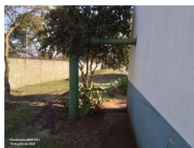
Foto 8 - Tubulação externa de recalque.
