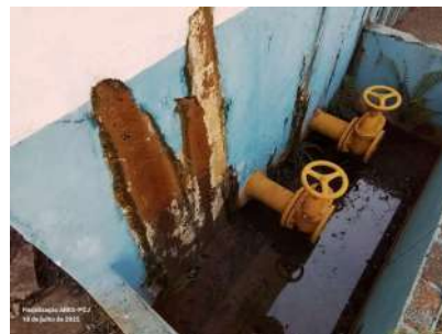
Foto 2 - Vazamento vertendo pela parede.
