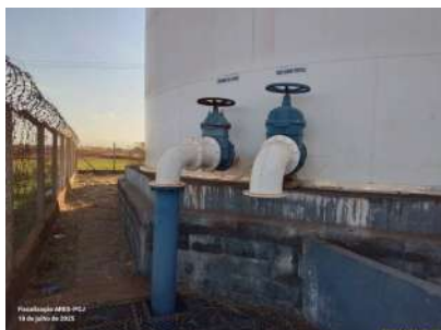
Foto 5 - Saídas para o abastecimento.
