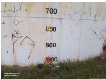
Foto 6 - Medidor de nível inoperante.
