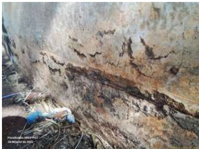
Foto 2 - Desgaste na estrutura com armadura aparente.
