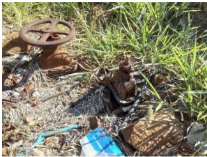
Foto 2 - Vazamento na válvula da linha de recalque.
