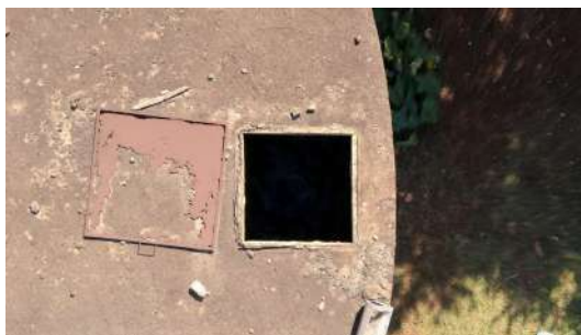
Foto 2 - Ausência de tampa de inspeção.
