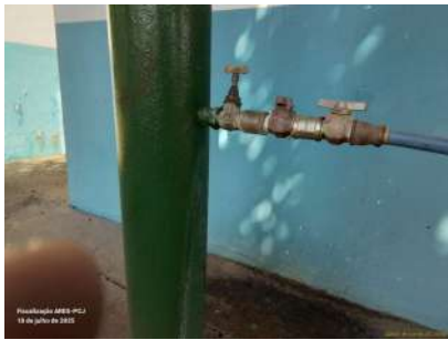
Foto 4 - Vazamento na torneira do recalque da EEA.
