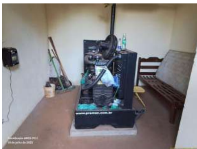
Foto 7 - Gerador de energia inoperante.
