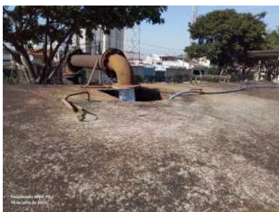
Foto 1 - Entrada de água livre e sem proteção.
