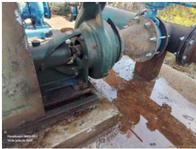
Foto 1 - Local molhado devido o escoamento da água de lubrificação da gaxeta.
