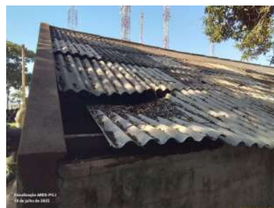
Foto 3 - Telhas soltas e aberturas no telhado.
