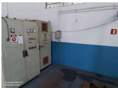
Foto 7 - Painéis de acionamento.
