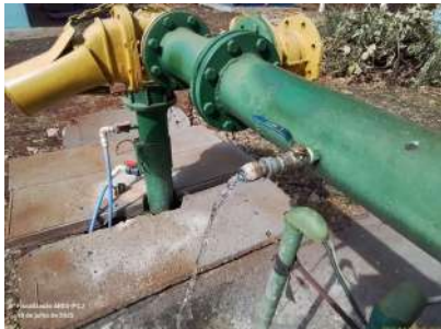
Foto 5 - Tomada de água bruta.
