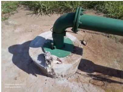
Foto 2 - Tubo de medição de nível e laje de proteção.
