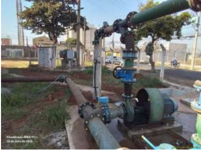
Foto 8 - Vista do booster.
