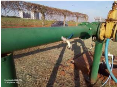
Foto 6 - Tomada de água bruta.
