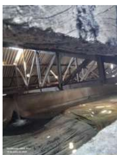
Foto 1 - Interior do reservatório com folhas secas sobre a lona solta, aberturas no telhado demonstrado pelos raios de sol e alimentação ativa com água.
