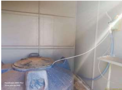
Foto 9 - Dosagem de Hipoclorito de Sódio.
