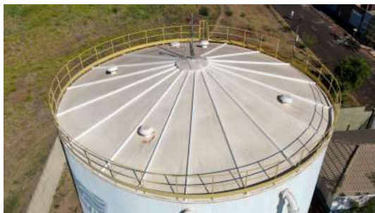
Foto 6 - Tubulações de ventilação.
