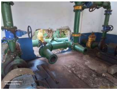
Foto 1 - Buraco na parede de alvenaria.
