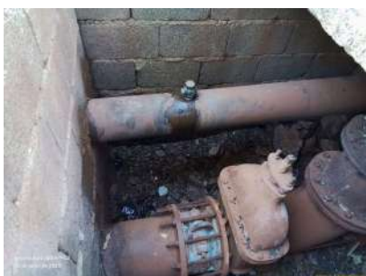
Foto 1 - Vazamento no TAP.
