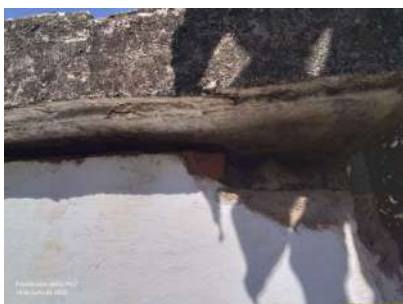
Foto 1 - Abertura entre a laje e as paredes.
