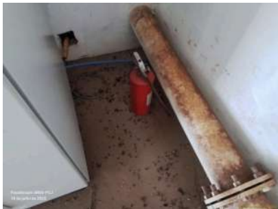
Foto 4 - Extintor da EEA.
