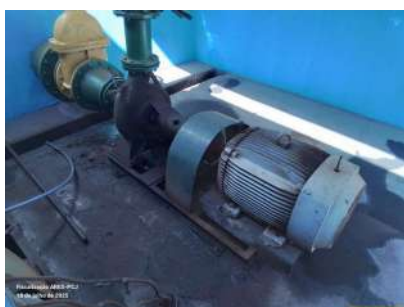
Foto 1 - Vista da bomba sem drenagem adequada.
