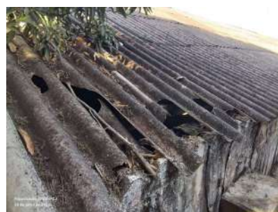
Foto 2 - Buracos por toda a estrutura do telhado.
