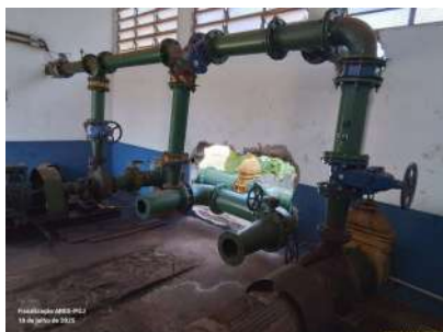
Foto 5 - Vista interna da EEA.
