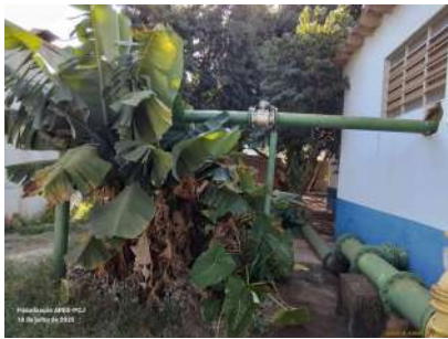
Foto 9 - Tubulação externa de recalque (superior) e sucção (inferior).
