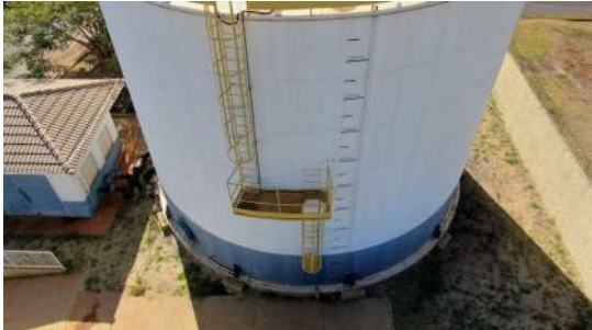
Foto 13 - Medidor de nível e guarda-copro da escada.
