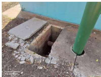
Foto 2 - Tampa de concreto danificada.
