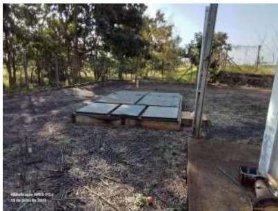
Foto 5 - Vista externa do poço de sucção.
