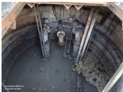
Foto 1 - Poço de sucção com corrente de sacar bomba apenas no lado direito.
