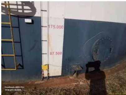
Foto 1 - Medidor de nível com o cabo rompido.
