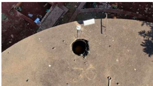
Foto 1 - Abertura na laje sem proteção.
