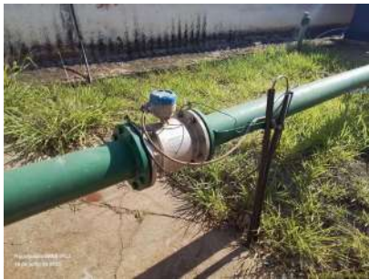
Foto 3 - Macromedidor do poço.
