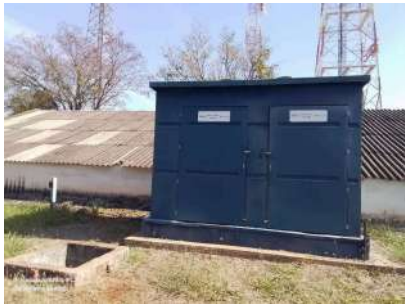
Foto 7 - Abrigo dos produtos químicos.
