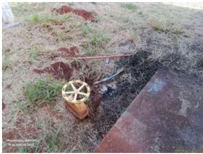
Foto 1 - Mangueira azul com vazamento (possível abastecimento do banheiro).
