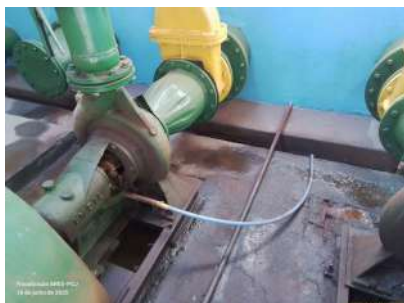
Foto 5 - Drenagem da gaxeta.
