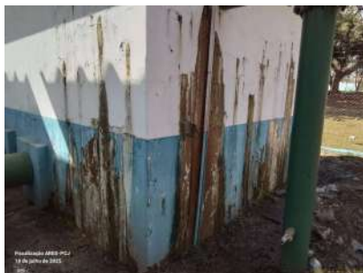
Foto 1 - Vazamentos na estrutura de alvenaria.
