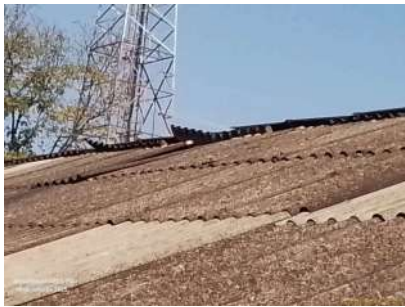
Foto 4 - Cumeeira com telhas soltas.
