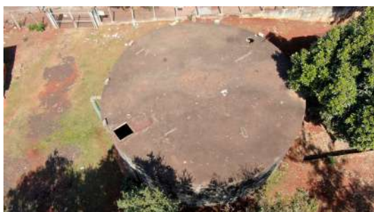
Foto 1 - Ausência de guarda-corpo próximo a tampa de inspeção.
