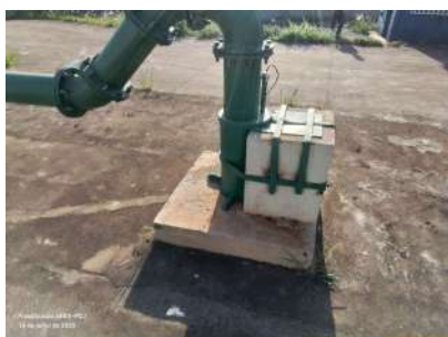
Foto 7 - Tubo de nível e laje de proteção.
