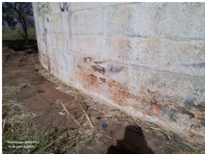
Foto 1 - Desgaste na estrutura com armadura aparente.
