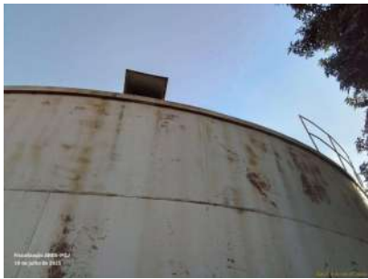
Foto 5 - Tubulação de ventilação da lateral sem tela.
