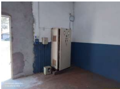
Foto 9 - Painelelétrico do poço.
