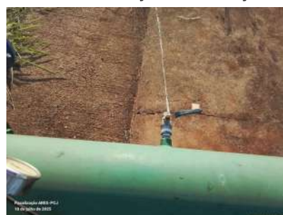
Foto 6 - Tomada de água bruta.
