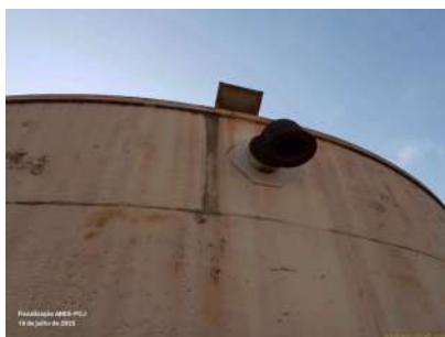
Foto 1 - Extravasor e tubulação de ventilação sem tela.
