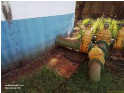
Foto 2 - Vazamento na junção da tubulação com a alvenaria.
