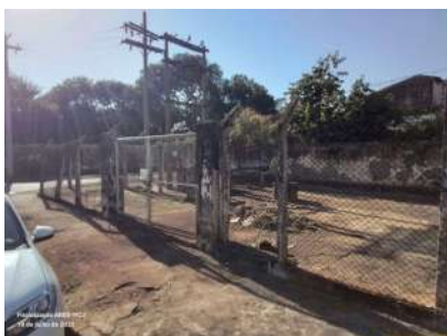
Foto 8 - Vista externa do poço cercado com alambrado.
