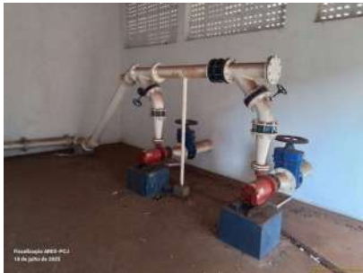
Foto 2 - Vista interna da EEA.
