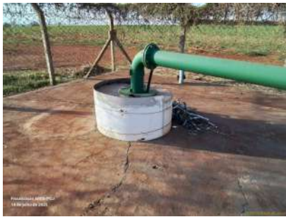
Foto 8 - Tubo de nível e laje de proteção.
