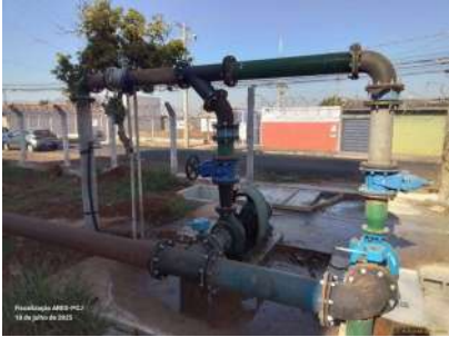
Foto 7 - Vista do booster.
