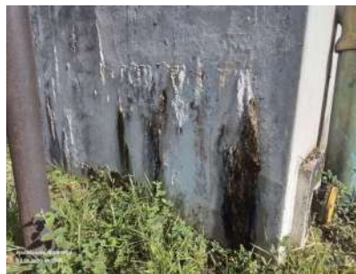
Foto 2 - Vazamentos na lateral 1 da caixa de sucção.
