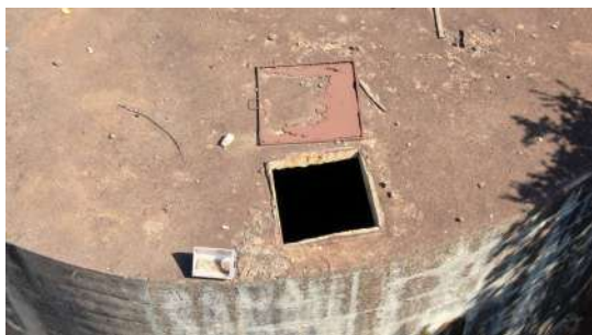
Foto 1 - Ausência de tampa de inspeção.
