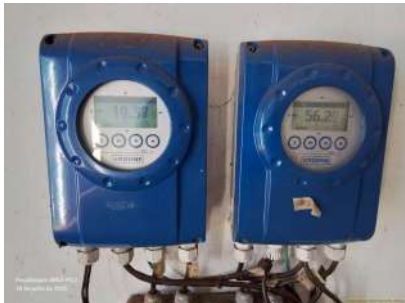
Foto 5 - Painéis de controle de vazão.
