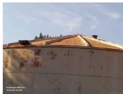
Foto 2 - Tubulação de ventilação do topo e lateral sem tela.
