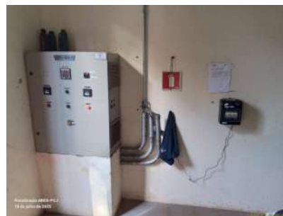
Foto 8 - Pannel elétrico da EEE.
