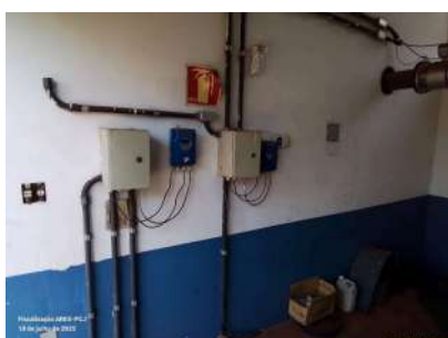
Foto 7 - Visores de controle de vazão.
