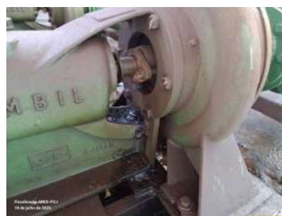
Foto 2 - Ausência de tubulação de drenagem.
