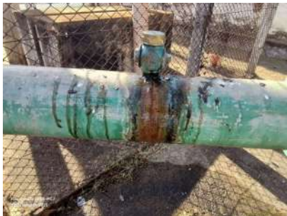
Foto 1 - Vazamento no TAP.
