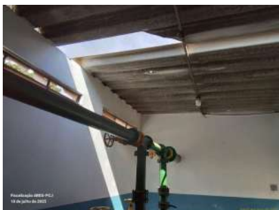
Foto 1 - Ausência de telha.
