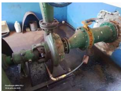
Foto 3 - Drenagem da gaxeta da bomba 1.
