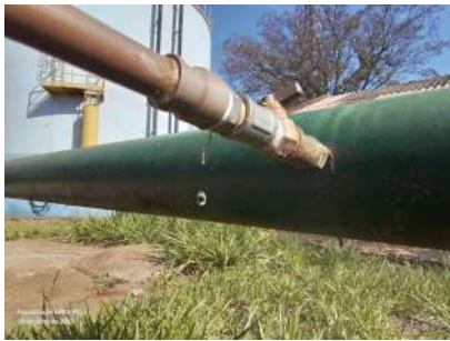
Foto 1 - Vazamento na torneira de amostragem.
