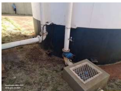
Foto 7 - Tubulação de alimentação e saída.
