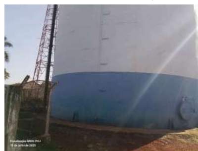
Foto 8 - Medidor de nível.
