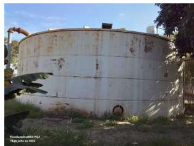
Foto 4 - Tubulação de ventilação da lateral sem tela.
