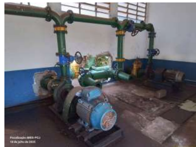
Foto 2 - Vista interna da EEA.
