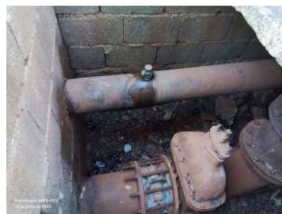
Foto 8 - Válvulas da EEA.
