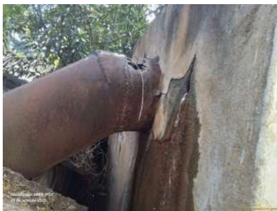
Foto 1 - Vazamento ativo na lateral 3 da caixa de sucção.
