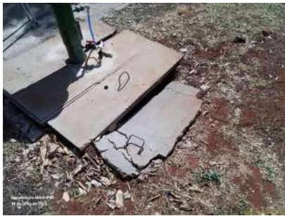
Foto 3 - Tampa de concreto danificada.
