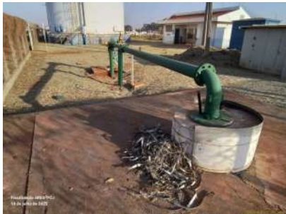
Foto 9 - Tubo de nível e laje de proteção.
