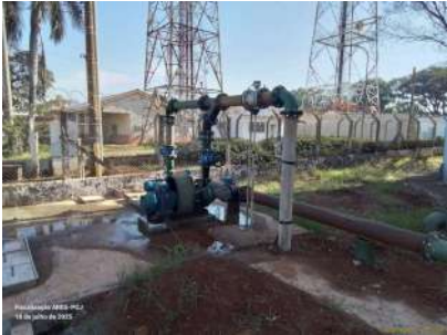
Foto 5 - Vista do booster.
