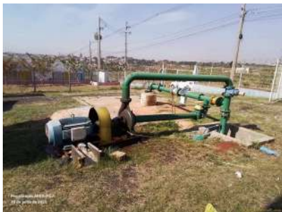
Foto 3 - Vista interna da EEA.
