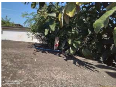
Foto 1 - Tubulação de ventilação sem curvatura de proteção.
