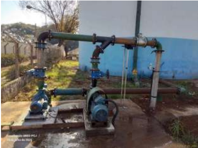
Foto 6 - Vista do booster.
