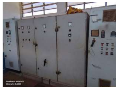
Foto 6 - Painéis elétricos de controle das bombas.
