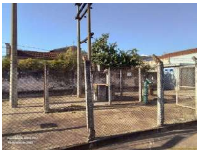
Foto 1 - Vista externa do poço cercado com alambrado.
