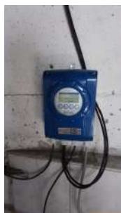
Foto 10 - Detalhe de um dos macromedidores.
