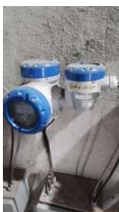
Foto 4 - Saída do reservatório apoiado para condomínio Green Valley.
