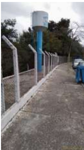
Foto 2 - Cercamento da área. O reservatório taça está desativado.
