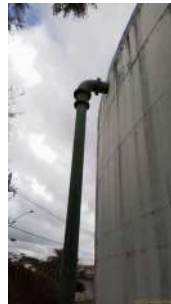
Foto 6 - Abastecimento do reservatório.
