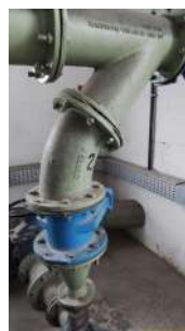
Foto 4 - Tubulação de recalque.
