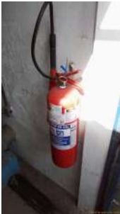
Foto 3 - Extintor na casa de bombas.
