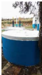
Foto 23 - Tanques para estabilizar o nível de efluente antes do bombeamento
