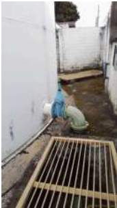
Foto 2 - Saída dos reservatórios.
