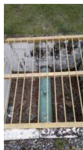
Foto 10 - Saída do reservatório apoiado.
