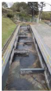
Foto 20 - Tanque de contato antes do lançamento final da ETE desativada.
