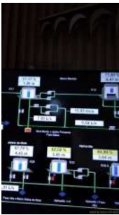
Foto 7 - Visualização do reservatório no CCO. Verifica-se o nível do reservatório por telemetria.
