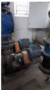
Foto 1 - Bombas da elevatória.
