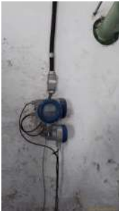
Foto 4 - Macromedidor do recalque do reservatório apoiado para o elevado.
