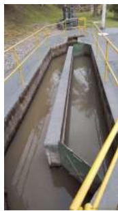
Foto 10 - Caixa de areia.
