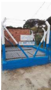
Foto 1 - Placa de identificação da elevatória.
