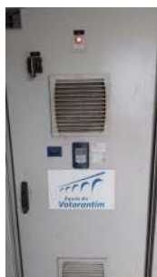
Foto 7 - Painel de comando das bombas.
