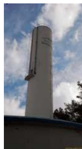
Foto 6 - Escada, extravasor e vazamento.
