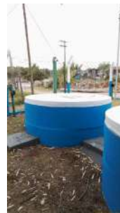
Foto 22 - Tanques para acumulação de efluente à montante das bombas helicoidais, fazendo com que as elas trabalhem sempre afogadas.
