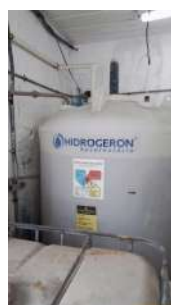
Foto 7 - Armazenamento de hipoclorito de sódio, produzido na própria ETA.
