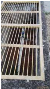
Foto 7 - Saída do reservatório elevado para a rede.
