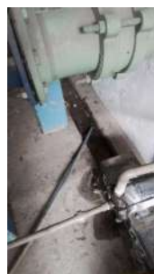
Foto 9 - Canaleta para escoar a água de lubrificação das gaxetas.
