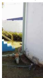
Foto 11 - Alimentação do reservatório elevado.
