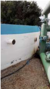
Foto 2 - Extravasor e ventilação com tela de proteção.
