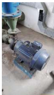
Foto 1 - Bomba da elevatória que recalca para o Reservatório Tatiana.
