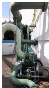
Foto 36 - Saída dos filtros. Mangueira azul realiza pós cloração.
