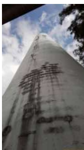
Foto 1 - Vazamento visível no reservatório.
