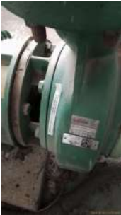
Foto 2 - Identificação da bomba para retrolavagem dos filtros da ETA Novo Mundo.
