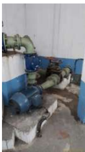
Foto 1 - Bombas da elevatória.
