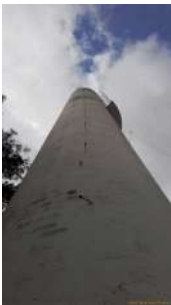
Foto 2 - Ausência de descida do SPDA.
