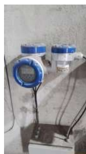
Foto 3 - Saída do reservatório elevado para a rede da parte alta.
