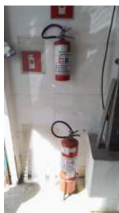
Foto 8 - Extintores na sala de produtos químicos.
