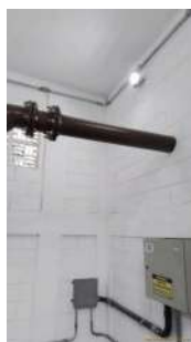
Foto 12 - Recalque das bombas. Efluente é encaminhado à elevatória Cyrella.
