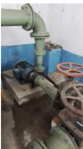
Foto 2 - Bomba da elevatória
