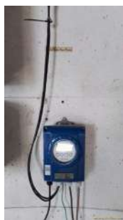
Foto 6 - Macromedidor da saída do elevado para o bairro.
