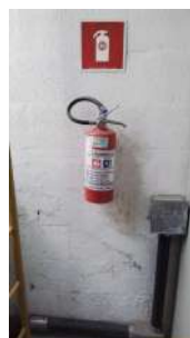
Foto 6 - Extintor da elevatória.
