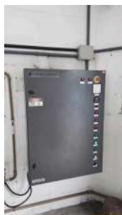
Foto 3 - Painel do sistema gerador de cloro.
