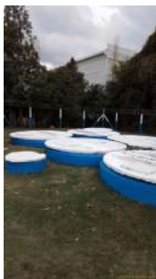
Foto 3 - Sistema de fossas filtro, desativado. Funciona como pulmão da elevatória.
