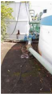
Foto 6 - Tubulação para retrolavagem.
