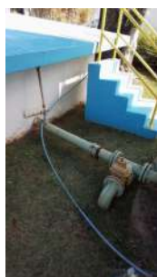
Foto 10 - Abastecimento do reservatório elevado a partir da casa de bombas.
