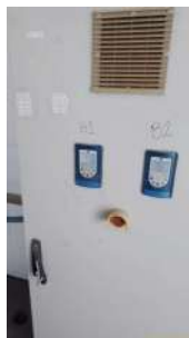
Foto 8 - Painel de comando das bombas.
