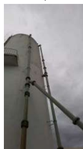
Foto 6 - Tubulações de alimentação e extravasor.
