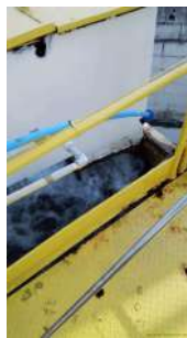
Foto 15 - Entrada de água bruta
