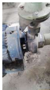
Foto 9 - Bomba com selo mecânico.
