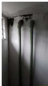
Foto 9 - Tubulações do reservatório.
