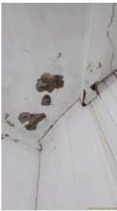
Foto 1 - Foram verificados alguns pontos com armadura exposta e vazamentos. O laudo estrutural a ser apresentado pelo prestador mencionará se há risco e providências a serem tomadas.
