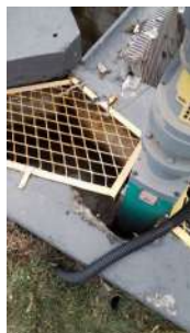
Foto 16 - Equipamento para trituração de sólidos.
