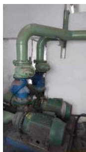
Foto 1 - Bombas da elevatória.
