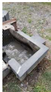
Foto 15 - Esgoto proveniente da elevatória de esgoto Novo Mundo bairro.
