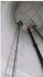
Foto 5 - Escada para manutenção.
