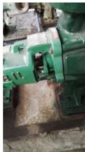
Foto 4 - Detalhe da drenagem da água de lubrificação das gaxetas.
