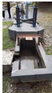
Foto 13 - Gradeamento inicial na chegada do efluente ao tratamento preliminar.
