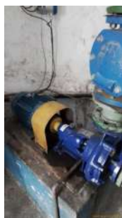
Foto 5 - Bomba de elevatória.
