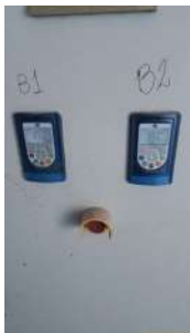
Foto 9 - Painel de comando das bombas.
