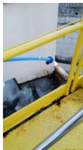
Foto 16 - PAC na entrada da água bruta.
