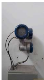
Foto 9 - Macromedidor na saída do reservatório apoiado, por gravidade.
