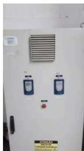
Foto 11 - Paine de comando das bombas.
