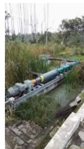
Foto 25 - A área das bombas foi tomada por mato e tem água acumulada. De acordo com funcionários da concessionária, um curso d'água que passa próximo ao local foi desviado por construções irregulares no entorno, fazendo com que a água adentrasse na área.
