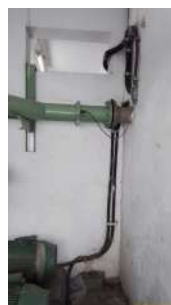
Foto 2 - Tubulação de recalque.
