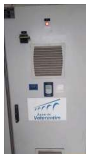
Foto 8 - Painel de comando das bombas.
