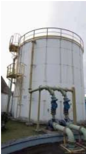
Foto 1 - Reservatório abastecido por recalque a partir do reservatório enterrado. Visualização de escadas e Guarda-corpo.
