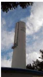
Foto 5 - Escada com proteção para acessar a cobertura. Verifica-se vazamento externo.
