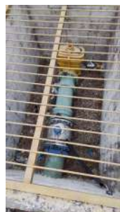
Foto 11 - Macromedidor da saída do reservatório apoiado.
