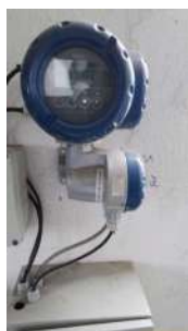
Foto 5 - Macromedidor na saída da elevatória para abastecimento do reservatório Tatiana.
