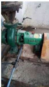
Foto 3 - Detalhe da drenagem da água de lubrificação das gaxetas.
