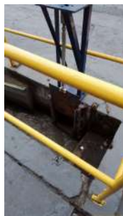
Foto 18 - Comporta que permite extravasão do efluente do tratamento preliminar para os tanques de acumulação, aproveitados da ETE desativada..
