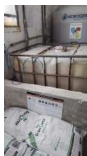
Foto 6 - Armazenamento de flúor.
