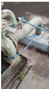
Foto 8 - Drenagem da água de lubrificação das gaxetas.
