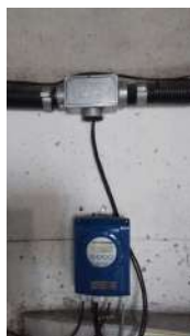
Foto 12 - Macromedidor da saída para abastecimento do Loteamento Sinfonia.
