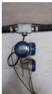
Foto 11 - Macromedidor da saída para abastecimento do reservatório Tatiana.
