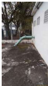
Foto 10 - Recalque para abastecimento da rede.
