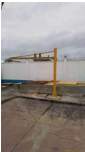
Foto 6 - Talha para manutenção.
