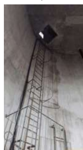
Foto 5 - Escada para manutenção.
