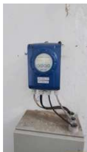
Foto 10 - Macromedidor na saída.
