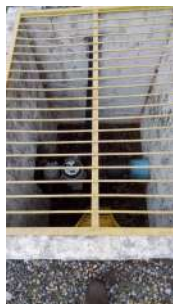
Foto 3 - Abastecimento do reservatório.
