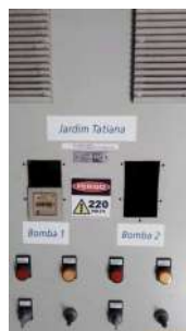
Foto 6 - Painel de comando das bombas.
