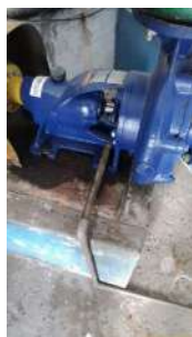
Foto 7 - Tubulação para drenar a água de lubrificação das gaxetas.
