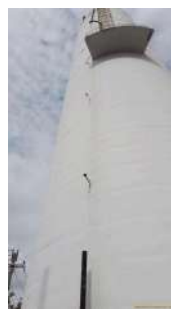
Foto 7 - Ausência de descida de SPDA.
