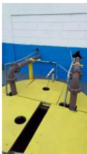
Foto 6 - Sucção das bombas
