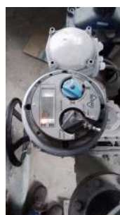
Foto 7 - Controle de abertura de válvula.
