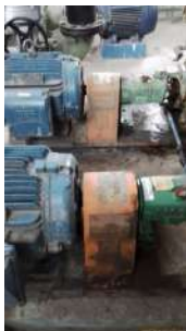
Foto 5 - Bombas da elevatória.
