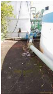
Foto 5 - Tubulação para retrolavagem.
