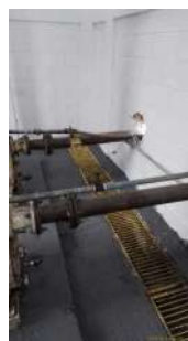
Foto 13 - Tubulações de sucção
