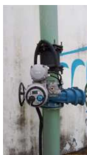
Foto 12 - Controle de válvula na entrada do reservatório.
