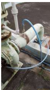
Foto 6 - Tubulação azul drena a água de lubrificação das gaxetas.
