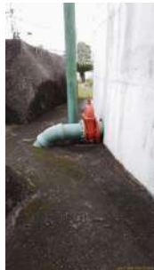
Foto 5 - Saídas do reservatório estão desativadas.
