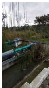
Foto 2 - Mato alto e acúmulo de água no entorno das bombas.
