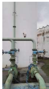
Foto 4 - Bombas do reservatório elevado.
