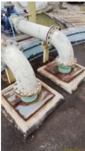
Foto 2 - Sucção no reservatório enterrado.
