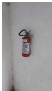
Foto 9 - Extintor da elevatória.
