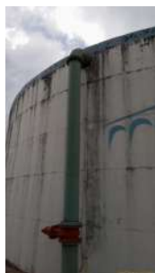
Foto 7 - Abastecimento do reservatório.
