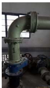
Foto 3 - Tubulação de recalque
