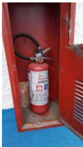
Foto 11 - Extintor da elevatória.
