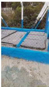
Foto 3 - Poços de entrada do efluente.
