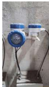
Foto 2 - Macromedidor da saída do reservatório apoiado para parte baixa do bairro.
