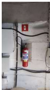
Foto 14 - Extintor próximo a painel de comando de bombas.
