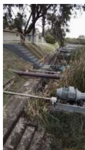
Foto 30 - Tubulação que encaminha para as bombas.
