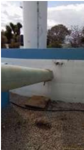
Foto 1 - Entrada de água no reservatório.
