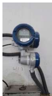
Foto 4 - Macromedidor na saída do reservatório elevado.
