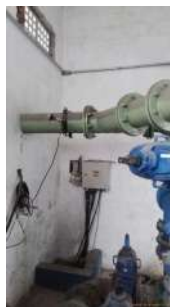
Foto 2 - Recalque para a rede.
