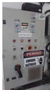
Foto 8 - Painele de comando das bombas.
