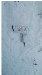
Foto 10 - Alarme na elevatória.
