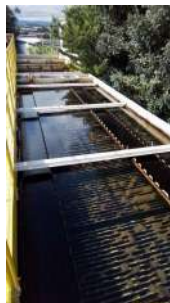
Foto 20 - Decantador da ETA.
