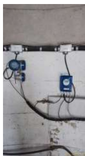
Foto 9 - Macromedidores na saída do tratamento.
