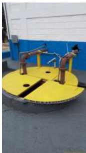
Foto 8 - Poço de sucção da elevatória.
