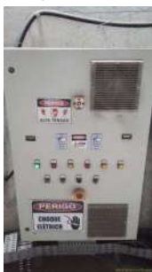
Foto 10 - Paine bombas elevado
