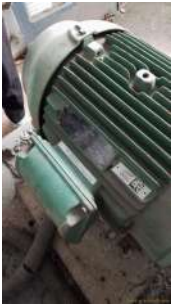
Foto 1 - Identificação da bomba para retrolavagem dos filtros da ETA Novo Mundo.
