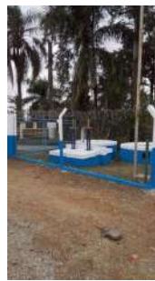
Foto 2 - Tanques que acumulam o efluente e encaminham para o bombeamento, de forma que as bombas trabalhem sempre afogadas.
