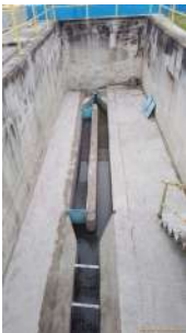
Foto 5 - Gradeamento, caixa de areia e calha parshall.
