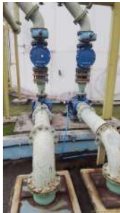
Foto 1 - Bombas que recalcam para reservatório apoiado metálico.
