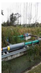
Foto 3 - Mato alto e acúmulo de água no entorno das bombas.
