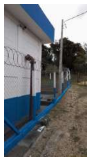
Foto 16 - Cercamento e tubulação de recalque.
