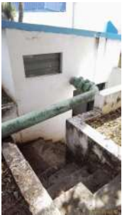
Foto 3 - Tubulação de recalque da retrolavagem.
