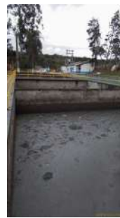
Foto 21 - Tanques de acumulação de efluente.
