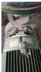
Foto 3 - Identificação de uma das bombas.
