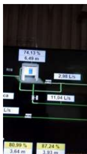
Foto 9 - Visualização do reservatório no CCO.
