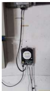
Foto 13 - Macromedidor da saída para abastecimento da rede.
