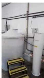
Foto 5 - Tanque para armazenamento de sal utilizado na geração de hipoclorito de sódio.
