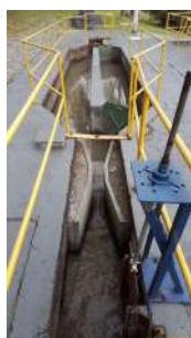
Foto 8 - Tratamento preliminar da antiga ETE que foi mantido em operação.
