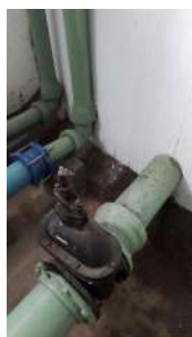
Foto 12 - Tubulação de saída do reservatório (direita) e extravasor (esquerda, parte em azul)
