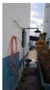
Foto 35 - Chuveiro de emergência.
