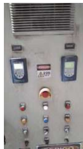
Foto 9 - Paine de comando das bombas de recalque para o reservatório apoiado
