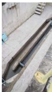
Foto 11 - Caixa de areia.
