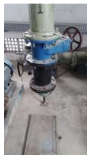
Foto 2 - Apenas uma bomba na elevatória. Também é possível abastecer o reservatório Tatiana por gravidade.
