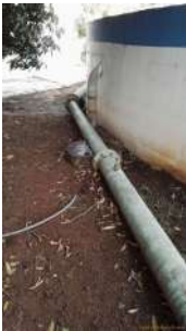
Foto 4 - Tubulação para retrolavagem.
