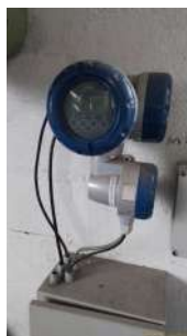
Foto 8 - Macromedidor da saída da elevatória para abastecimento da rede.
