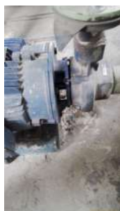
Foto 8 - Bombas com selo mecânico.
