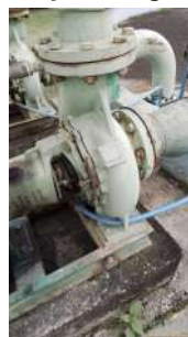
Foto 7 - Drenagem da água de lubrificação das gaxetas.
