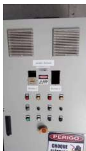
Foto 5 - Painel de comando das bombas.
