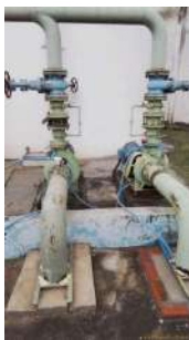
Foto 3 - Bombas que recalcam para o reservatório elevado.
