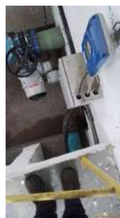
Foto 15 - Extravasor (tubulação azul)
