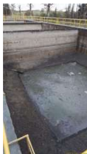
Foto 5 - Atualmente os tanques são utilizados como pulmão para acúmulo de efluente em situações como queda de energia. Nesses casos, a concessionária utiliza bombas sopo para remover o efluente dos tanques e encaminhá-lo para o recalque da elevatória.
