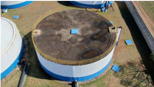
Foto 4 - Vista superior do reservatório Klavin 4
