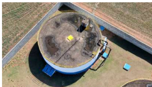
Foto 6 - Vista superior do reservatório Klavin 1
