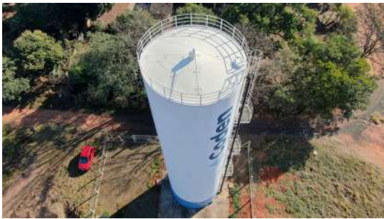
Foto 3 - Reservatório Pós Anhanguera
