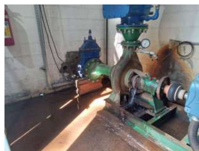
Foto 2 - Ausência de drenagem de água de lubrificação de gaxetas
