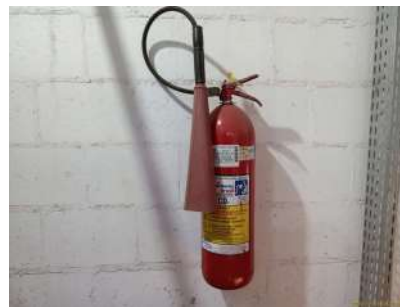
Foto 5 - Extintor de incêndio
