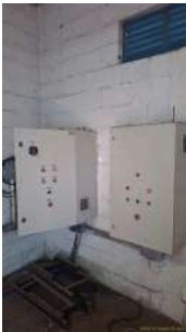
Foto 4 - Painel de comando e controle
