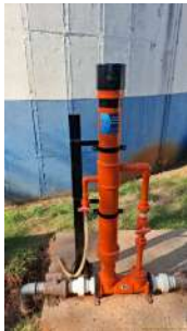
Foto 1 - Dosagem de cloro
