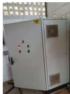
Foto 7 - Pannel de comando e controle
