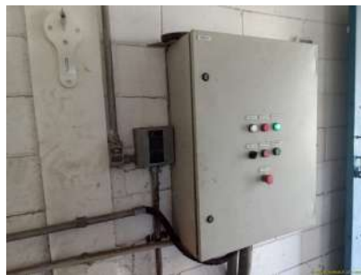
Foto 4 - Painele de comando e controle
