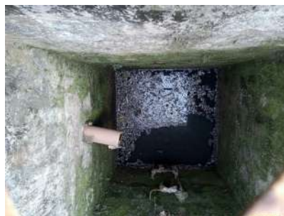
Foto 4 - Chegada de esgoto bruto
