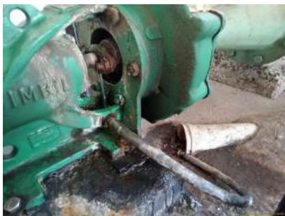
Foto 3 - Drenagem da gaxeta
