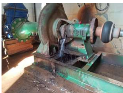
Foto 1 - Ausência de drenagem de água de lubrificação de gaxetas
