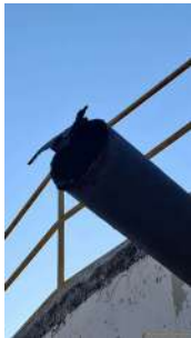
Foto 1 - Ausência de tela de proteção na saída do extravasor
