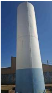
Foto 2 - Reservatório São Francisco elevado
