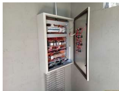
Foto 5 - Painel de comando e controle
