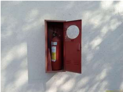
Foto 4 - Extintor de incêndio
