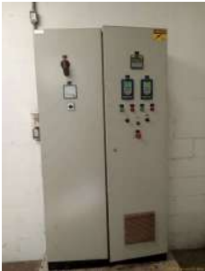
Foto 3 - Painel de comando e controle
