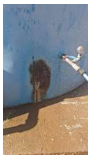
Foto 1 - Vazamento próximo a base do reservatório
