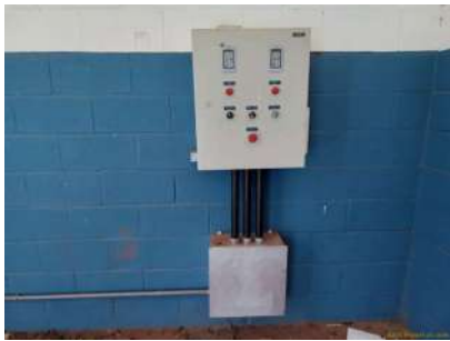
Foto 6 - Painele de comando e controle
