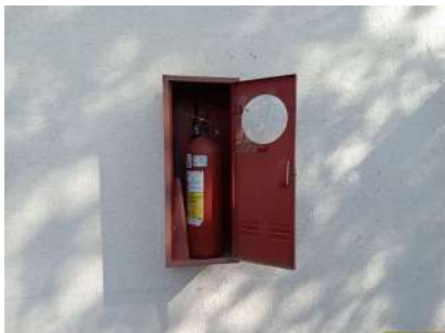
Foto 5 - Extintor de incêndio
