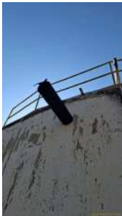
Foto 2 - Ausência de tela de proteção na saída do extravasor
