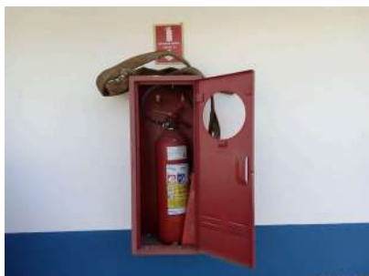
Foto 3 - Extintor de incêndio
