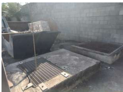
Foto 5 - Cesto para retirada de resíduos, com reserva instalado
