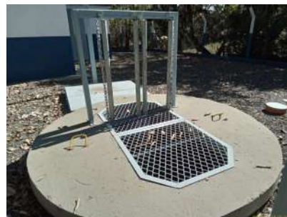
Foto 3 - Poço de sucção
