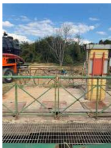
Foto 9 - Vista geral da elevatória
