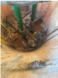
Foto 4 - Poço de sucção
