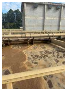
Foto 6 - Detalhe da aeração
