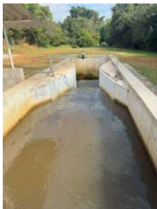
Foto 11 - Canal de saída de efluente tratado
