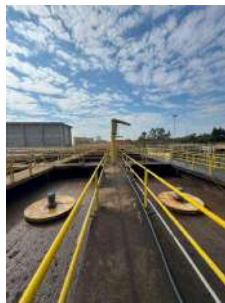
Foto 8 - Misturadores no tanque anóxico
