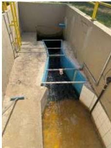
Foto 1 - Saída de esgoto tratado
