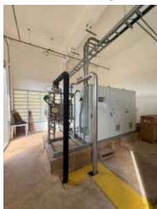
Foto 11 - Sistema de geração Ozônio
