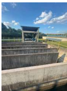
Foto 11 - Tanque de contato
