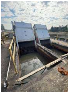
Foto 1 - Pré-tratamento da ETE
