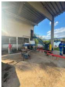
Foto 19 - Centrifuga de lodo
