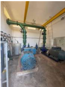
Foto 2 - Detalhe das bombas
