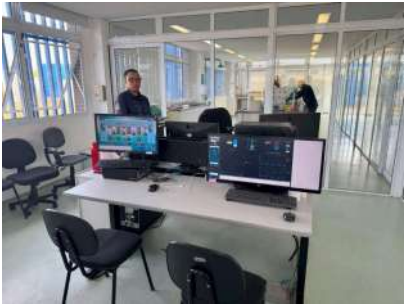
Foto 1 - CCO da ETA
