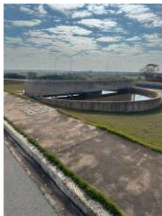
Foto 31 - Decantador de lodo da ETA
