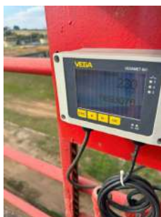
Foto 5 - medição de vazão na entrada
