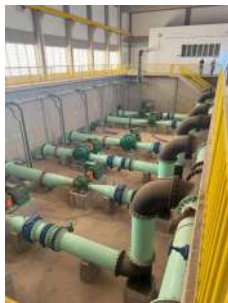
Foto 27 - Elevatória de água tratada
