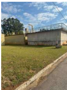
Foto 5 - Tanques de aeração
