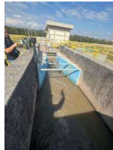
Foto 12 - Medição de vazão na entrada
