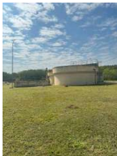
Foto 9 - Adensador de lodo
