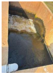
Foto 16 - Entrada de água bruta
