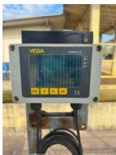
Foto 13 - Medição de vazão na saída
