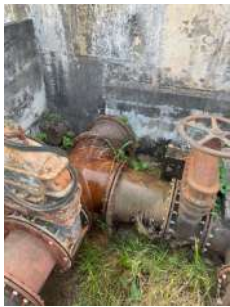
Foto 1 - Vazamento no T
