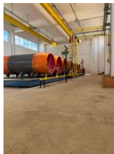
Foto 30 - Cilindros Cloro gás
