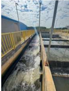
Foto 7 - Canaleta de água bruta
