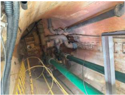
Foto 6 - Conj moto bomba
