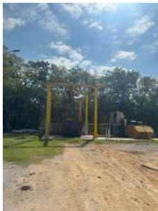
Foto 3 - Elevatória de entrada
