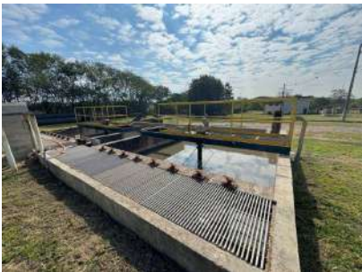
Foto 1 - Pré-tratamento da ETE
