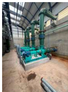
Foto 24 - Bombas de retrolavagem
