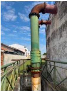
Foto 2 - Vazamento na curva
