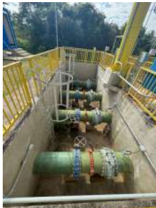
Foto 11 - Barrilete da elevatória
