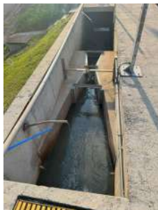
Foto 9 - Macromedidor de saída
