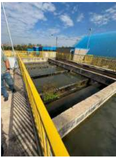
Foto 1 - Presença de vegetação nos tanques
