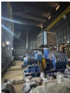
Foto 7 - Sala de sopradores
