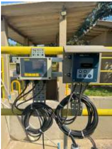
Foto 2 - MEdição de vazão na saída de esgoto
