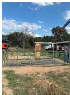
Foto 7 - Vista geral da elevatória
