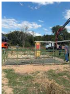
Foto 1 - Vista geral da ETEF
