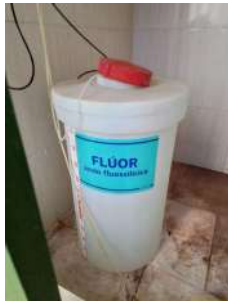
Foto 7 - Tanque de flúor.
