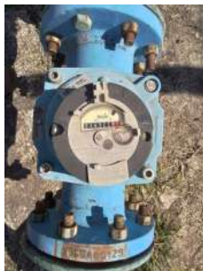
Foto 7 - Macromedidor do poço.
