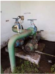
Foto 2 - Bombas do booster (1+1R).
