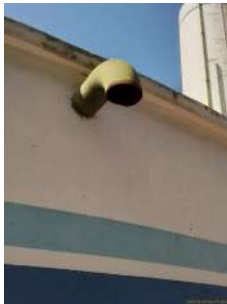
Foto 1 - Ausência de tela de proteção.
