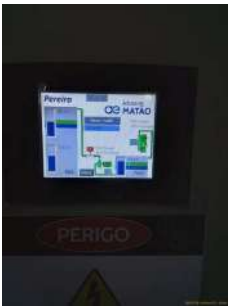
Foto 6 - Conversor do macromedidor localizado dentro do reservatório elevado.
