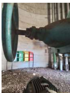
Foto 1 - Detalhe 1 do vazamento.
