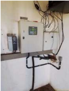
Foto 3 - Painel elétrico do Booster.
