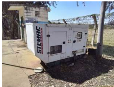
Foto 6 - Gerador da ETE.
