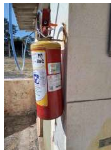
Foto 6 - Extintor no local.
