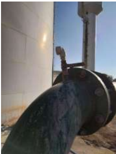
Foto 6 - Torneira para coleta de água bruta.
