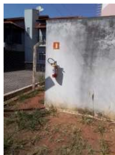
Foto 9 - Extintor no local.
