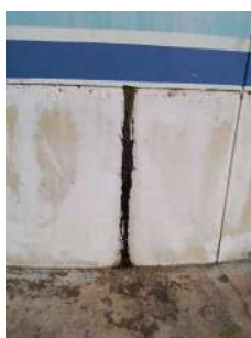
Foto 3 - Vazamento 3 na lateral do reservatório.
