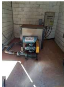
Foto 16 - Um dos sopradores da ETE.
