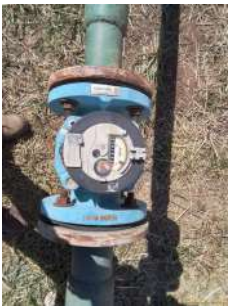
Foto 6 - Macromedidor do poço.
