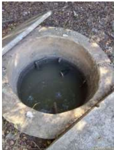
Foto 7 - Chegada do esgoto.
