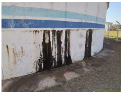
Foto 1 - Vazamento 1 na lateral do reservatório.
