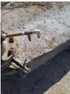
Foto 2 - Torneira para coleta de água bruta.
