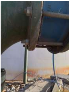
Foto 1 - Vazamento identificado na conexão do cavalete.
