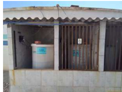
Foto 6 - Estocagem de cloro e flúor.
