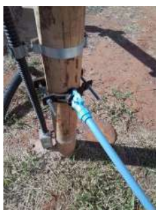
Foto 1 - Detalhe da conexão usada na aplicação de cloro e flúor.
