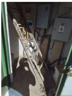
Foto 1 - Escada dentro do abrigo do painel elétrico.
