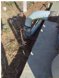
Foto 1 - Vazamento identificado próximo à conexão.
