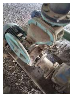
Foto 2 - Detalhe 2 do vazamento.
