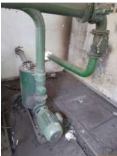
Foto 4 - Bomba reserva, dentro do abrigo.
