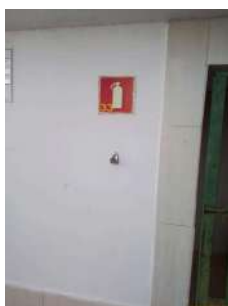
Foto 1 - Não há extintor no local.
