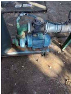
Foto 4 - Detalhe da bomba 1.
