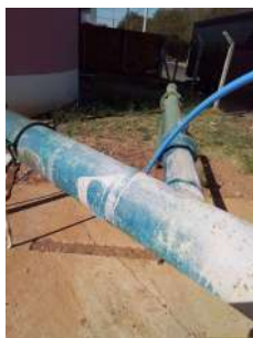
Foto 7 - À esquerda, tubulação que liga o poço diretamente ao reservatório Nova Cidade e à direita a contingência para o Jardim Imperador.
