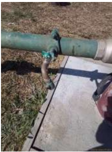
Foto 5 - Torneira para coleta de água bruta.
