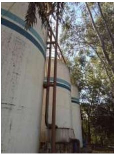
Foto 3 - Vazamento na peneira estática.
