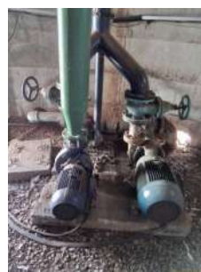
Foto 2 - Detalhe das bombas.
