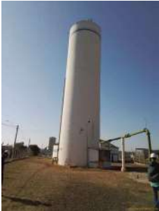
Foto 4 - Reservatório elevado (2 câmaras).
