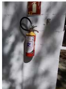
Foto 6 - Extintor próximo ao abrigo.
