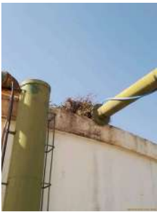
Foto 1 - Crescimento de vegetação na tubulação sobre o reservatório.
