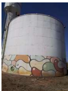
Foto 3 - Reservatório apoiado Bom Jesus.
