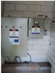
Foto 9 - Pannel elétrico da EEE.
