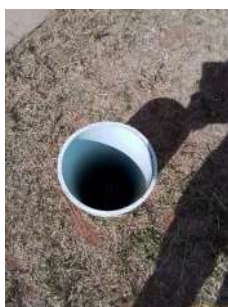
Foto 7 - Vazamento no registro.
