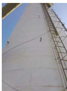
Foto 2 - Detalhe dos suportes para fixação do condutor de descida, sem o condutor.
