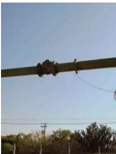
Foto 4 - Macromedidor do poço.
