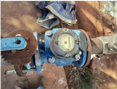
Foto 3 - Macromedidor do poço.
