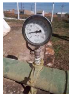
Foto 6 - Manômetro na base do reservatório.
