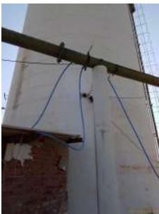
Foto 1 - Detalhe do vazamento.
