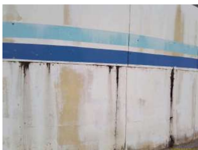
Foto 5 - Vazamento 5 na lateral do reservatório.
