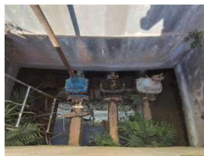
Foto 6 - Vazamento junto aos registros. Detalhe para o acúmulo de água no local.
