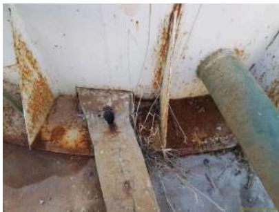
Foto 1 - Vazamento constatado na base do reservatório.
