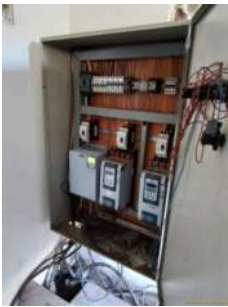
Foto 6 - Painelelétrico da EEE.
