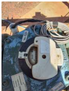
Foto 5 - Macromedidor do poço.
