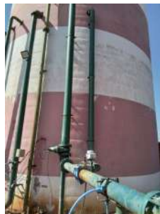
Foto 6 - Ligação do poço ao reservatório e ponto de aplicação de cloro e flúor.
