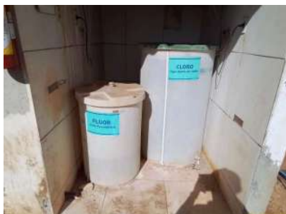
Foto 5 - Cloro e flúor dentro de abrigo próximo ao poço.
