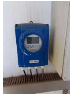
Foto 8 - Conversor 2 do macromedidor.
