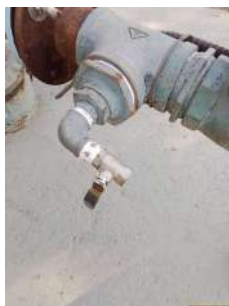
Foto 3 - Torneira para coleta de água bruta.
