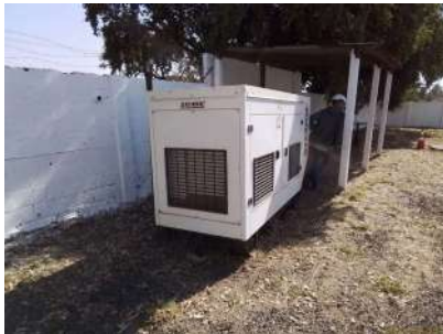
Foto 5 - Gerador no local.
