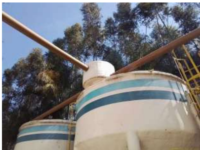
Foto 15 - Caixa de distribuição.
