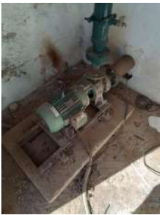
Foto 1 - Bomba da EEA. A reserva está no almoxarifado.
