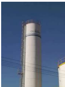
Foto 1 - O reservatório não dispõe de para-raios.
