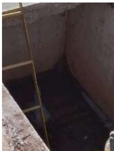
Foto 1 - Detalhe do vazamento, na quina.
