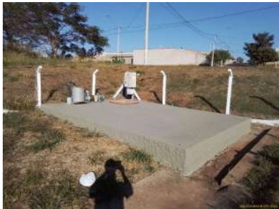
Foto 3 - Vista da EEE.
