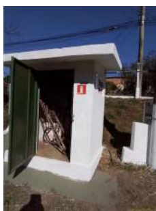
Foto 7 - Abrigo do painel elétrico do poço.
