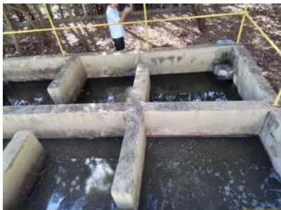
Foto 17 - Saída do efluente tratado.
