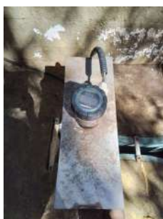
Foto 1 - Detalhe do macromedidor instalado mas não funcionando.
