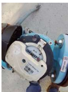
Foto 5 - Macromedidor do poço.
