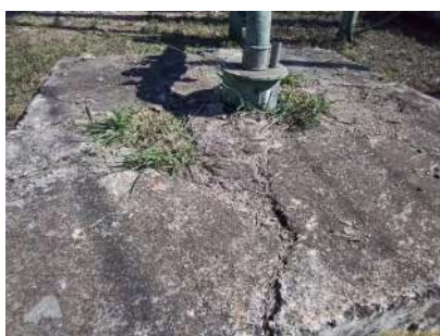
Foto 1 - Detalhe da laje danificada.
