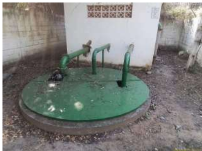
Foto 3 - Poço de sucção.
