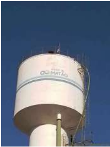
Foto 4 - Haste de para-raio no topo do reservatório elevado.
