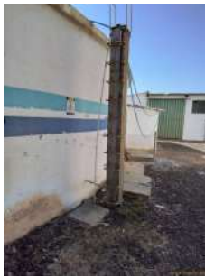
Foto 1 - Escada para acesso ao topo do reservatório sem guarda-corpo.
