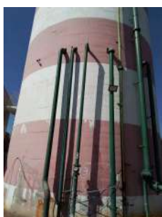
Foto 5 - Tubulações de chegada e extravasor da câmara inferior.
