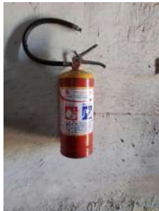
Foto 3 - Extintor no interior do reservatório.
