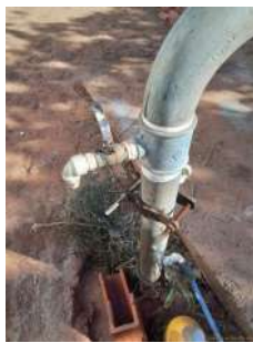
Foto 5 - Torneira para coleta de água bruta.
