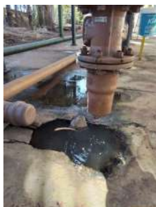
Foto 1 - Vazamento junto ao decantador.
