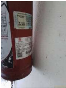
Foto 5 - Validade do extintor de incêndio.
