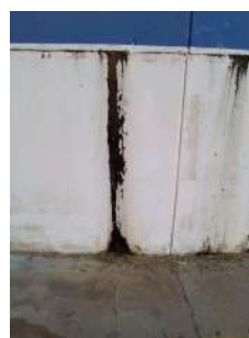
Foto 4 - Vazamento 4 na lateral do reservatório.
