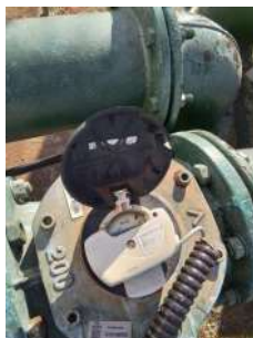
Foto 3 - Macromedidor na saída do reservatório.
