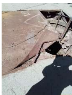
Foto 1 - Detalhe da tampa danificada.
