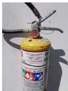
Foto 11 - Pressurização do extintor.
