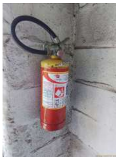
Foto 5 - Extintor junto ao poço.
