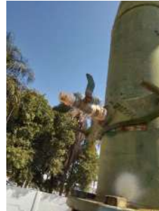
Foto 4 - Torneira para coleta de água bruta.
