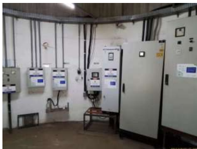
Foto 5 - Painéis elétricos da EAT.
