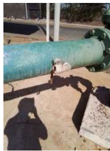
Foto 4 - Torneira para coleta de água bruta.
