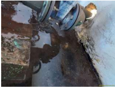
Foto 1 - O vazamento na conexão somado à ausência de drenagem da água das gaxetas contribuem para que o local fique com acúmulo de água.
