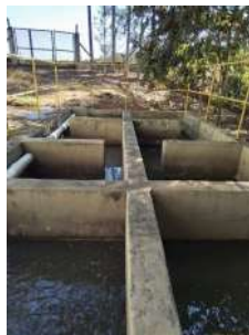
Foto 18 - Saída do efluente tratado.
