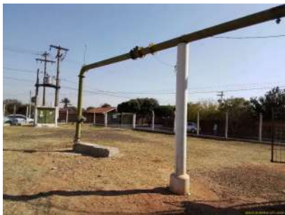
Foto 1 - Vista do poço Vila Pereira.
