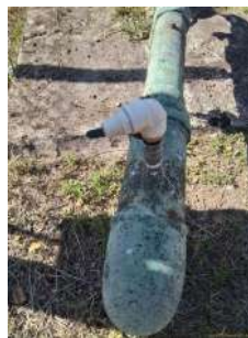
Foto 6 - Torneira para coleta de água bruta.
