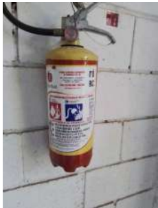
Foto 7 - Extintor da EEE.
