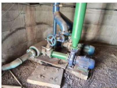
Foto 1 - Elevatória Nova Matão.
