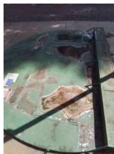
Foto 9 - Poço de sucção das bombas.
