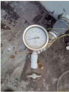
Foto 4 - Manômetro do reservatório.
