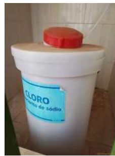
Foto 6 - Tanque de cloro.
