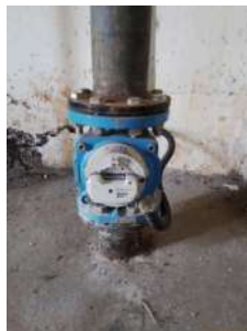
Foto 7 - Manômetro dentro do reservatório (câmara inferior).
