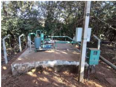
Foto 3 - Vista das bombas (1+1R) da EEE.
