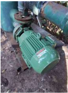
Foto 6 - Detalhe da bomba 2.
