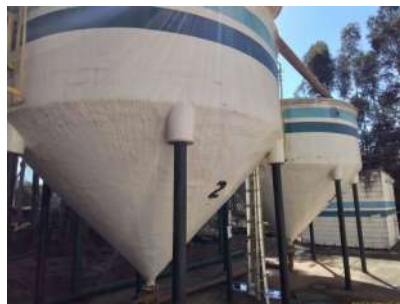
Foto 14 - Decantadores da ETE.
