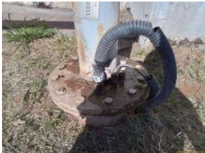
Foto 1 - Vazamento identificado na tubulação do booster.
