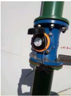
Foto 8 - Macromedidor fixado na tubulação junto ao reservatório apoiado.
