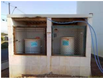
Foto 7 - Cloro e flúor em abrigo ao lado do reservatório.
