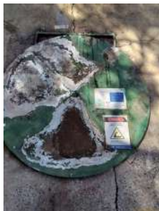
Foto 5 - Chegada do esgoto bruto (tampa fechada).
