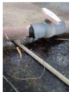
Foto 2 - Vazamento na conexão.
