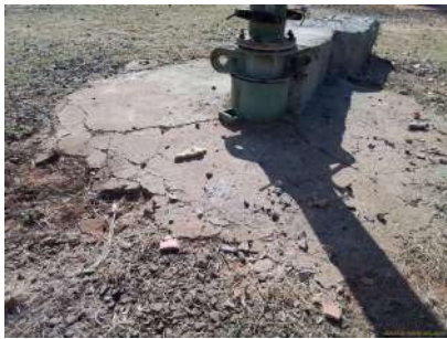
Foto 1 - Detalhe da laje danificada.
