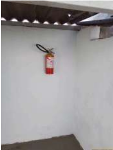
Foto 7 - Extintor dentro do abrigo.
