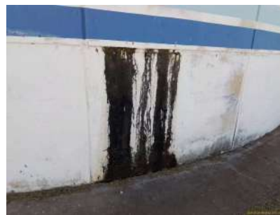
Foto 2 - Vazamento 2 na lateral do reservatório.
