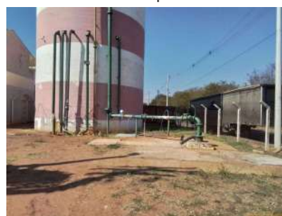
Foto 4 - Poço Nova Cidade e reservatório ao fundo.
