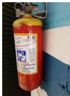
Foto 7 - Extintor de incêndio próximo aos sopradores.
