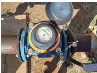
Foto 3 - Macromedidor do poço.
