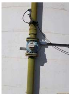
Foto 5 - Macromedidor junto ao reservatório (câmara superior).
