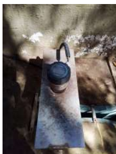
Foto 19 - Macromedidor instalado, mas não funcionando.
