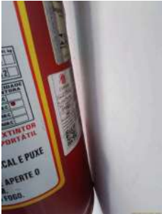
Foto 8 - Validade do extintor.
