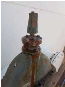
Foto 1 - Detalhe do vazamento.
