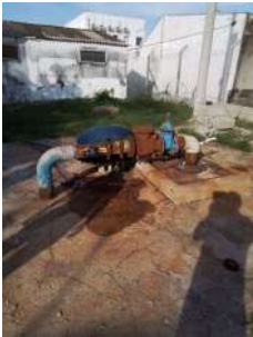
Foto 1 - Vazamento no cavalete.
