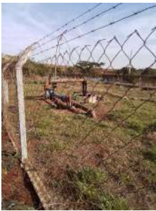
Foto 2 - Visão geral da elevatória. Verifica-se que há apenas uma bomba helicoidal após a tubulação de sucção.
