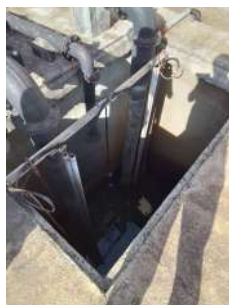
Foto 20 - Bombas para recirculação de lodo.
