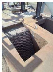
Foto 5 - Gradeamento do tratamento preliminar.
