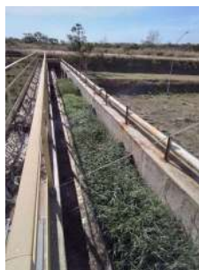
Foto 12 - Um dos reatores UASB da ETE, totalmente inoperantes.
