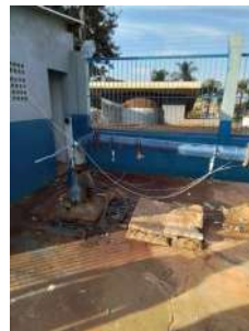
Foto 5 - Cavalete do poço.
