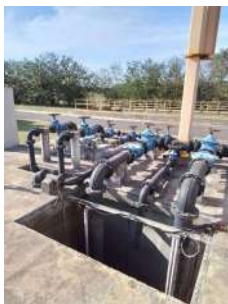
Foto 21 - Bombas para recirculação de lodo.
