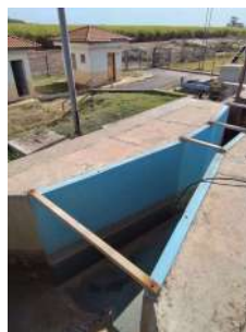
Foto 2 - Calha parshall do tratamento preliminar.
