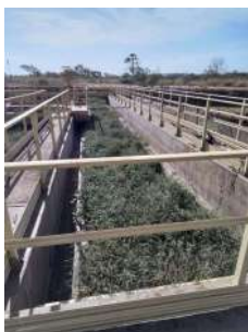
Foto 11 - Um dos reatores UASB da ETE, totalmente inoperantes. e com sinais de deterioração.
