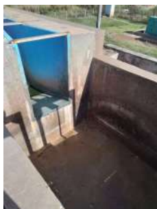
Foto 1 - Calha parshall do tratamento preliminar, completamente seca.
