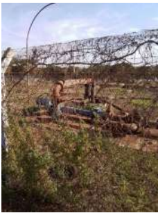
Foto 1 - Bomba helicoidal, apenas uma instalada.
