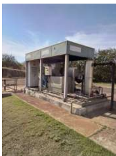
Foto 19 - Skid para tratamento de lodo.
