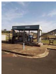
Foto 18 - Skid para tratamento de lodo, inoperante.
