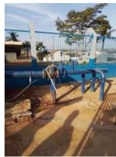
Foto 4 - Cavalete do poço.
