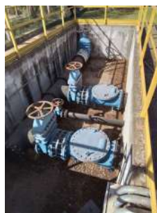
Foto 12 - Barrilete do recalque.
