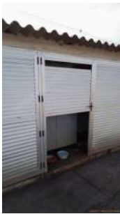
Foto 2 - Ausência de porta na cabine de comando e elétrica.
