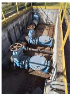
Foto 11 - Barrilete do recalque.
