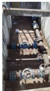
Foto 4 - Barriletes do recalque.
