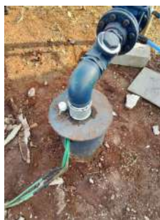
Foto 9 - Tubo para medição do nível do poço.
