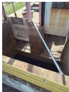
Foto 3 - Sistema de tratamento preliminar
