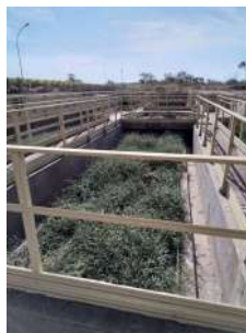
Foto 13 - Um dos reatores UASB da ETE, totalmente inoperantes.
