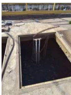
Foto 4 - Efluente acumulado no poço de sucção.
