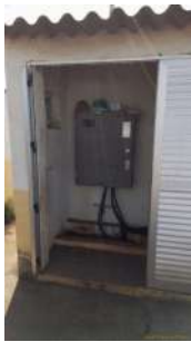
Foto 1 - Ausência de porta na cabine de comando e elétrica.
