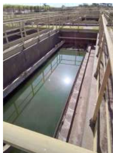
Foto 10 - Reator UASB com efluente acumulado, sem circulação..
