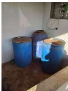
Foto 8 - Bombonas para armazenamento e dosagem de cloro e flúor.
