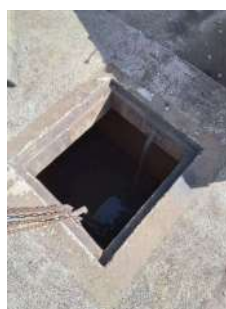
Foto 10 - Poço no qual está instalado cesto peneira.
