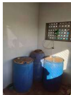
Foto 9 - Bombonas para armazenamento e dosagem de cloro e flúor.
