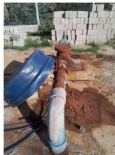
Foto 9 - Cavalete e indícios de vazamento.
