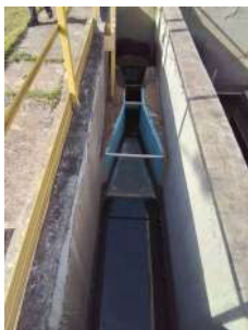
Foto 17 - Calha parshal na saída das chicanas
