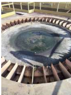
Foto 9 - Distribuidor de um dos reatores da ETE.
