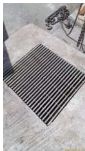
Foto 3 - Poço no qual está instalado o cesto peneira
