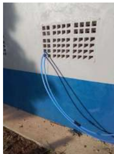
Foto 13 - Mangueiras para aplicação de produtos químicos, cloro e flúor.
