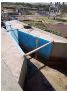
Foto 6 - Calha parshall no tratamento preliminar: não há efluente passando no local.
