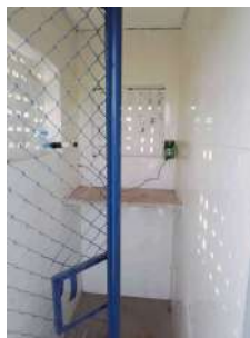
Foto 12 - Bomba dosadora de produto químico.
