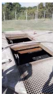
Foto 1 - Poço de sucção da elevatória com nível elevado de efluente acumulado, tendo em vista a paralisação do bombeamento.
