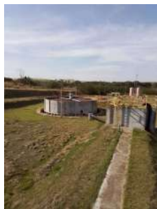
Foto 22 - Visão dos filtros biológicos.
