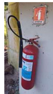
Foto 6 - Extintor de incêndio.
