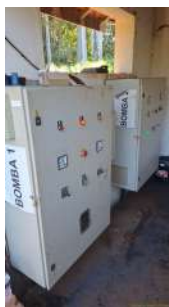
Foto 1 - Painéis das bombas.
