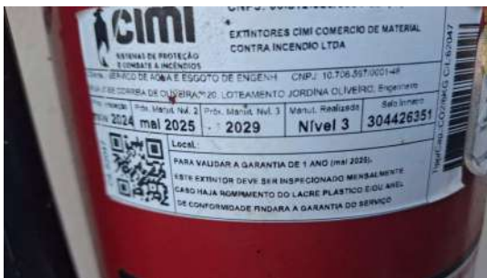
Foto 1 - Validade do extintor de incêndio.
