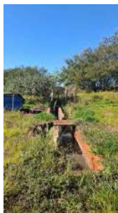
Foto 3 - Entrada do efluente com canal desarenador à frente e Calha Parshall (cercada por alambrado) ao fundo.
