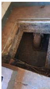
Foto 7 - Cavidade onde está instalada uma das bombas.
