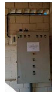
Foto 6 - Painel de controle.
