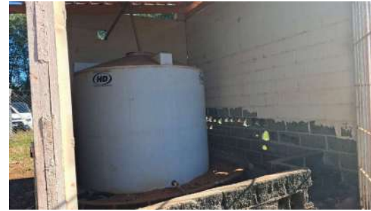
Foto 7 - Tanque de hipoclorito de sódio.
