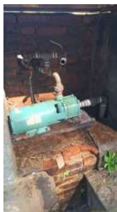
Foto 1 - Vazamento na tubulação da bomba.
