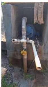
Foto 3 - Vazamento na tubulação de recalque da bomba.
