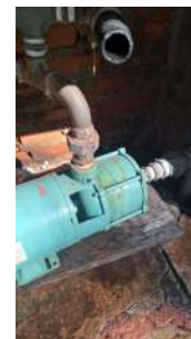
Foto 2 - Detalhe do vazamento.
