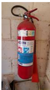
Foto 9 - Extintor de incêndio.
