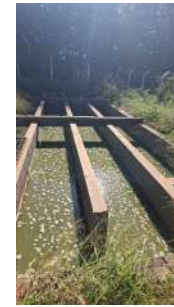
Foto 9 - Tanque de contato.
