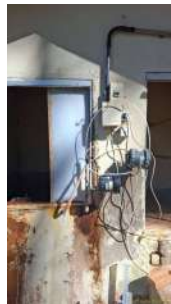
Foto 9 - Dosagem de PAC e Flúor na saída do tratamento.
