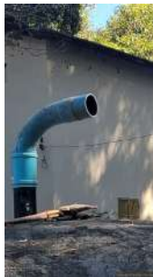
Foto 1 - Tubulação de ventilação sem tela de proteção.
