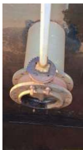
Foto 1 - Registro de descarga do filtro vazando.
