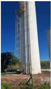
Foto 2 - Tubulações: à direita o extravasor; à esquerda, a tubulação de alimentação.
