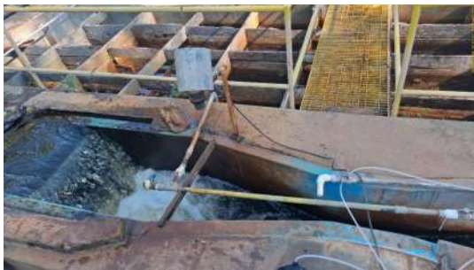
Foto 3 - Calha Parshall equipada com medidor de vazão.
