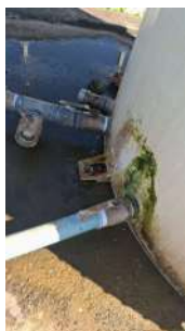
Foto 3 - Vazamento no reservatório.
