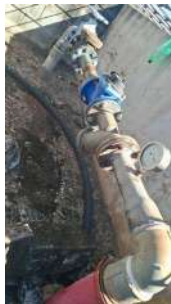
Foto 3 - Cavalete do poço.
