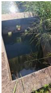
Foto 10 - Saída do efluente tratado.
