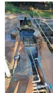
Foto 2 - Entrada da água bruta, que chega por gravidade da represa da Fazenda Pinhalzinho.
