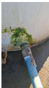
Foto 1 - Vazamento na tubulação de saída do reservatório.
