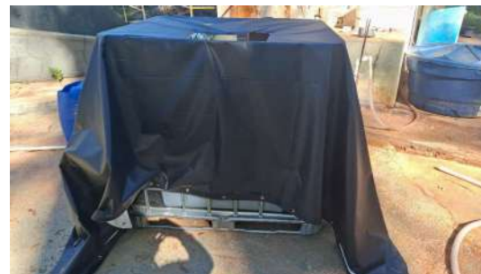
Foto 2 - PAC sem bacia de contenção.
