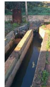
Foto 2 - Entrada do efluente.
