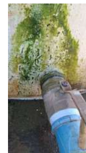
Foto 2 - Detalhe do vazamento.
