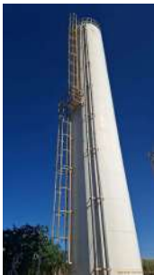
Foto 1 - Escada marinheiro e tubulações do reservatório.
