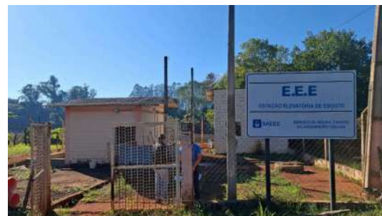
Foto 12 - Vista geral da EEE.
