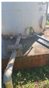
Foto 5 - Tubulações de saída e de descarga.
