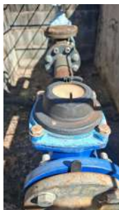
Foto 7 - Medidor de vazão.
