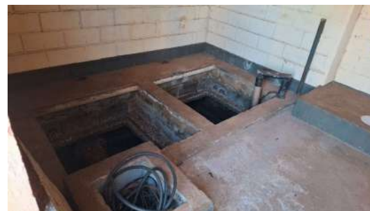
Foto 10 - Poço de sucção.
