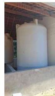
Foto 20 - Reservatório de PAC instalado, mas ainda não está em operação.
