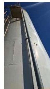
Foto 4 - Tubulação de alimentação do reservatório.
