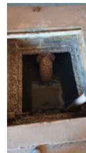
Foto 8 - Cavidade onde está instalada a outra bomba.
