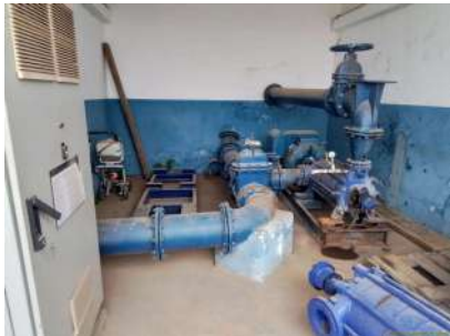
Foto 3 - Vista interna da EEA
