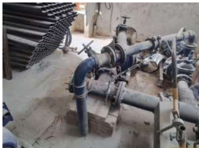
Foto 1 - Área interna da EEA
