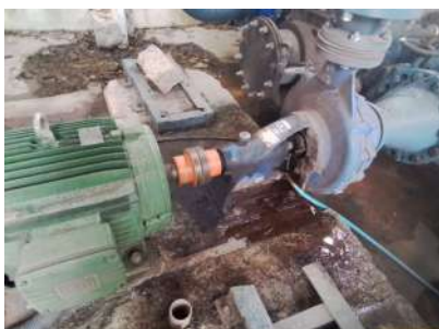
Foto 1 - Drenagem inadequada de água de lubrificação de gaxetas
