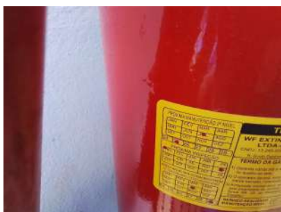
Foto 1 - Validade do extintor de incêndio
