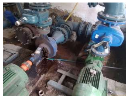
Foto 2 - Piso com empoçamento de água
