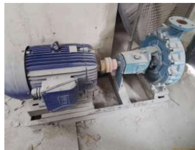
Foto 2 - Moto bomba reserva 1
