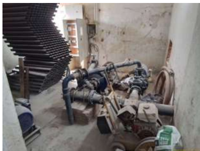
Foto 1 - Vista interna da EEA
