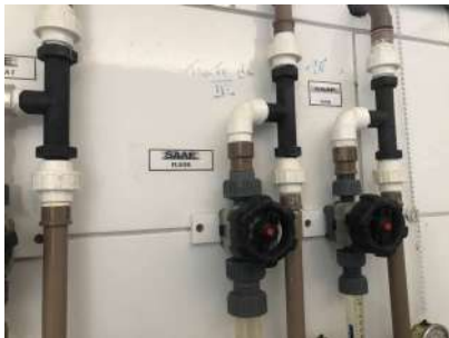
Foto 1 - Dosador de Flúor
