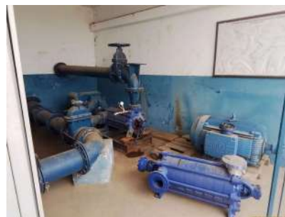
Foto 2 - Área interna da EEA
