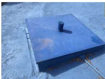
Foto 1 - Tubulação de ventilação com tela de proteção
