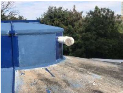
Foto 1 - Tubulação de ventilação/extravaseio
