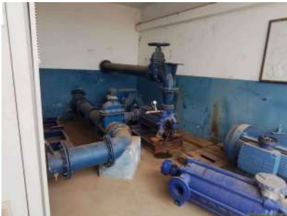
Foto 2 - Vista interna da EEA
