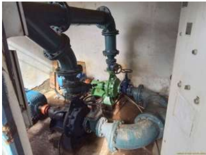
Foto 2 - Vista interna da EEA
