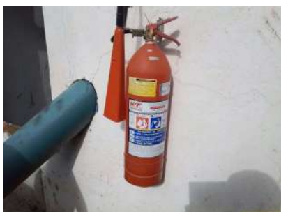
Foto 1 - Extintor de incêndio
