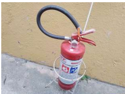
Foto 1 - Extintor de Incêndio
