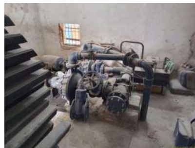
Foto 2 - Vista interna da EEA
