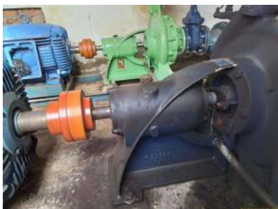
Foto 1 - Drenagem da água de lubrificação de gaxetas
