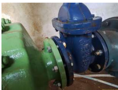
Foto 3 - Vazamento identificado na válvula
