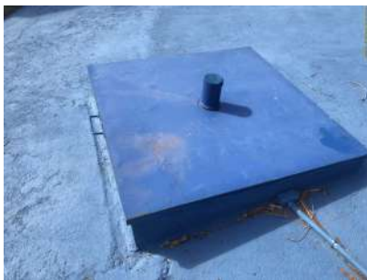
Foto 1 - Tubulação de ventilação com tela de proteção
