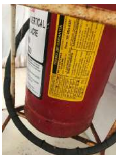
Foto 1 - Validade do extintor de incêndio
