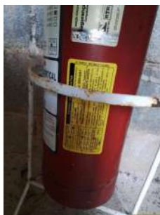
Foto 1 - Validade do extintor de incêndio
