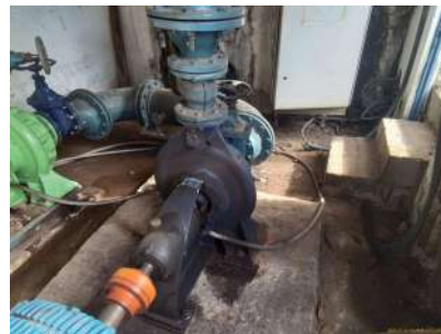
Foto 4 - Vista interna da EEA
