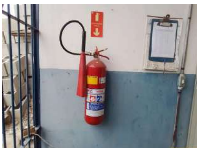
Foto 1 - Extintor de incêndio
