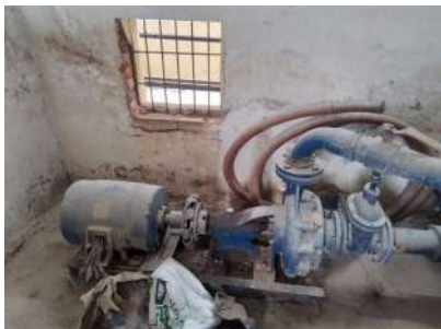
Foto 3 - Motobomba reserva 2 (instalada)
