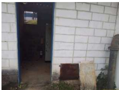
Foto 4 - Vista externa da EEA (local onde estão as motobombas)
