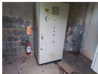
Foto 3 - Painel elétrico da EEA
