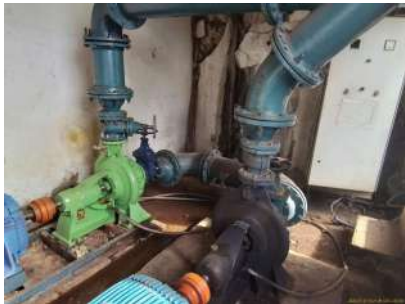
Foto 3 - Vista interna da EEA
