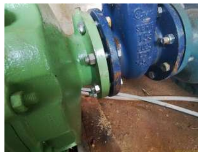
Foto 2 - Vazamento identificado na válvula
