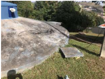
Foto 1 - Fiação elétrica solta e disposta de forma inadequado sobre o reservatório
