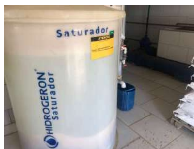
Foto 2 - Estocagem de produtos químicos
