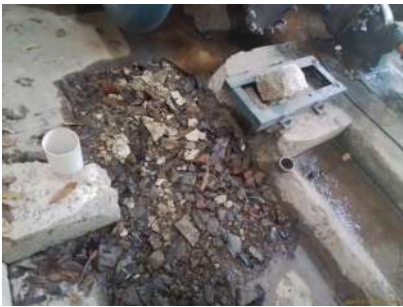
Foto 2 - Entulho no piso da EEA
