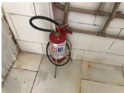
Foto 1 - Extintor de incêndio
