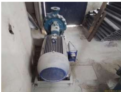
Foto 1 - Moto bomba reserva 1
