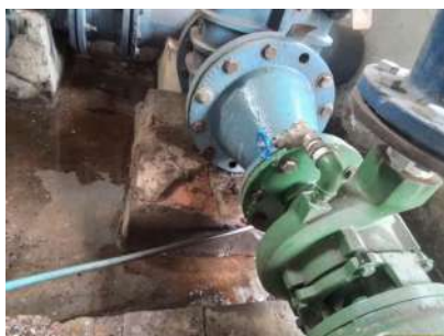
Foto 1 - Vazamento aparente na válvula
