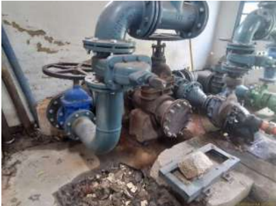
Foto 3 - Vista interna da EEA
