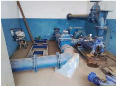
Foto 1 - Área interna da EEA
