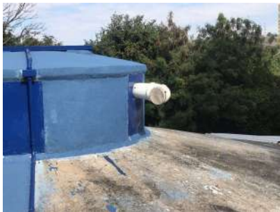
Foto 1 - Tubulação de ventilação/extravassão
