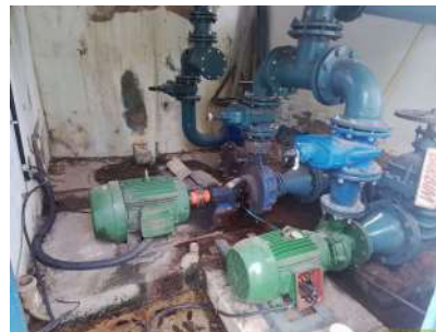
Foto 2 - Vista interna da EEA
