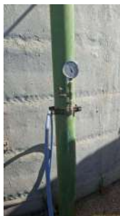
Foto 5 - Manômetro na tubulação de entrada da célula inferior.
