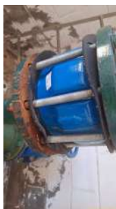
Foto 1 - Vazamento na válvula de retenção.
