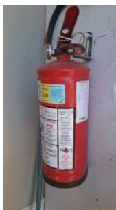
Foto 21 - Extintor de incêndio.
