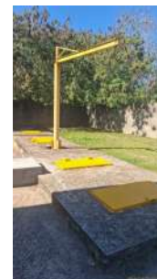
Foto 2 - Poços e guincho.
