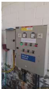
Foto 3 - Pannel de controle.
