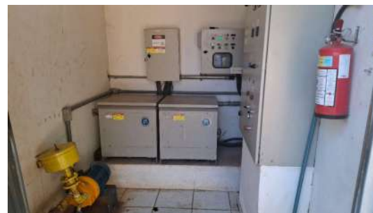
Foto 18 - Sala de controle e do soprador.
