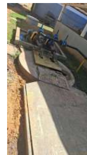
Foto 14 - Estação elevatória de esgoto tratado.
