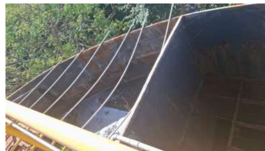
Foto 12 - Tratamento, são 4 módulos.
