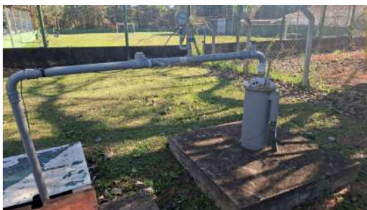
Foto 3 - Cavalete do poço.
