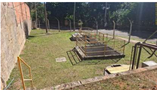
Foto 3 - Entrada do efluente.
