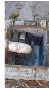
Foto 14 - Saída do efluente tratado.
