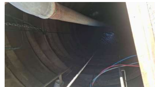
Foto 6 - Poço de sucção com uma única bomba instalada.
