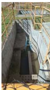
Foto 5 - Desarenador e calha Parshall.
