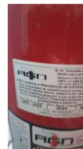
Foto 2 - Validade do extintor da sala do painel de controle.
