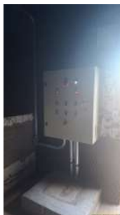
Foto 1 - Painel de controle da EEE.
