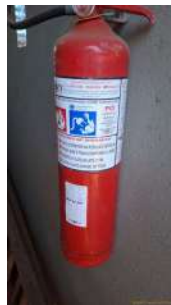
Foto 15 - Extintor de incêndio.
