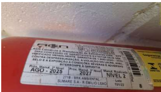
Foto 5 - Validade do extintor.
