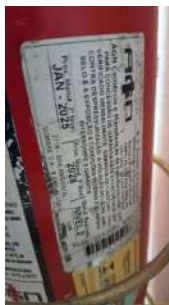
Foto 1 - Validade do extintor de incêndio.
