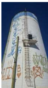
Foto 9 - Escada tipo marinheiro e passarelas de descanso com guarda-corpo.
