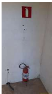
Foto 9 - Extintor de incêndio.
