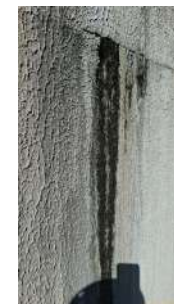
Foto 2 - Detalhe do vazamento.
