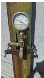
Foto 11 - Manômetro na tubulação de saída
