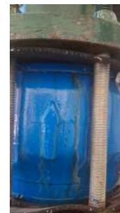
Foto 4 - Válvula de retenção.
