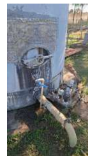
Foto 5 - Tubulação de saída.
