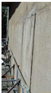
Foto 1 - Vazamentos na parede do tanque de tratamento.
