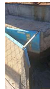
Foto 4 - Medição de vazão por meio de Calha Parshall.
