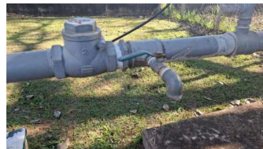
Foto 6 - Torneira para coleta de água bruta.
