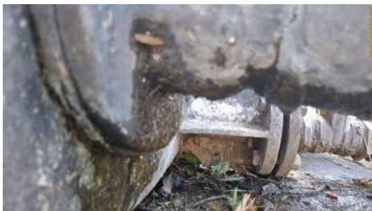
Foto 3 - Detalhe do vazamento.
