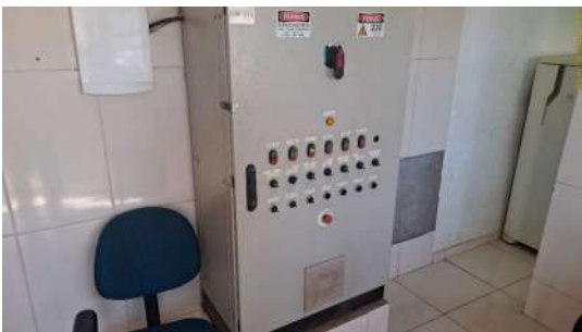
Foto 13 - PAINEL DE CONTROLE.
