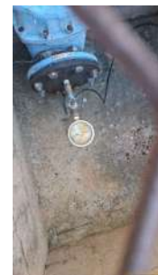
Foto 2 - Manômetro com o nível do reservatório.
