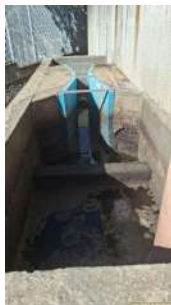
Foto 11 - Saída do efluente tratado.
