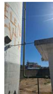
Foto 6 - Tubulação de recalque saindo da EEAT.
