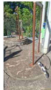
Foto 12 - Poço de armazenamento de lodo localizado à frente e Estação Elevatória posicionada ao fundo.
