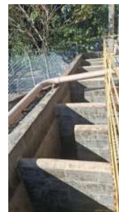
Foto 10 - Tanque de contato.
