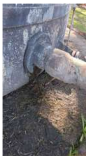
Foto 1 - Vazamento na junção entre o reservatório e a tubulação de saída.
