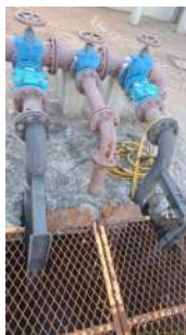
Foto 7 - Tubulação de saída do poço de sucção.
