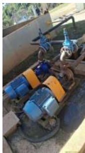
Foto 15 - Bombas da elevatória de esgoto tratado.
