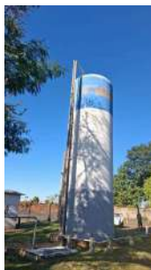
Foto 3 - Vista traseira do reservatório, mostrando as tubulações de recalque: uma do poço e outra de backup, que pode ser abastecida por caminhão-pipa.
