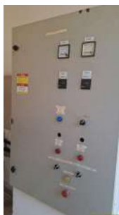
Foto 23 - Painele de controle.
