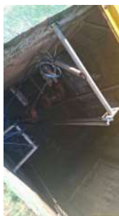
Foto 5 - Poço de sucção.
