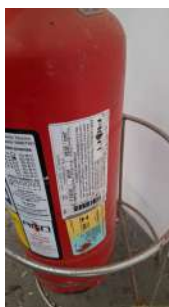
Foto 1 - Validade do extintor.
