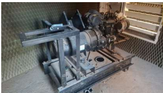
Foto 9 - Gerador da EEE.
