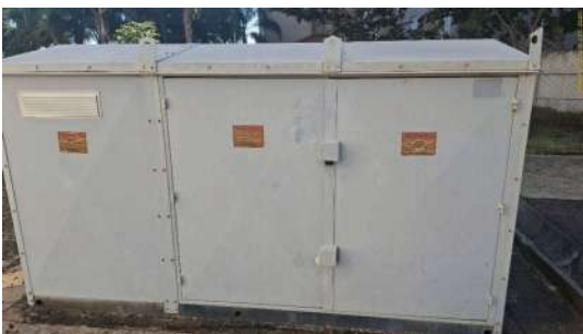
Foto 13 - Sistema compacto de pressurização de rede (booster), não está em operação.
