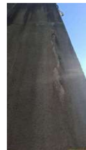
Foto 4 - Vazamento na parede do tanque de tratamento.
