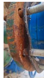
Foto 2 - Detalhe do vazamento.
