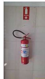
Foto 14 - Extintor de incêndio.
