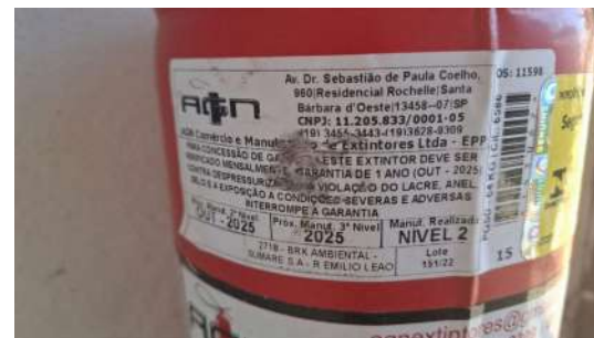
Foto 22 - Validade do extintor.
