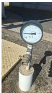
Foto 5 - Manômetro na tubulação de abastecimento do reservatório.
