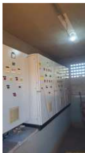
Foto 17 - Painéis de controle.
