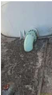
Foto 3 - Tubulação de saída.
