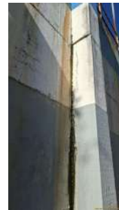
Foto 2 - Detalhe do vazamento.
