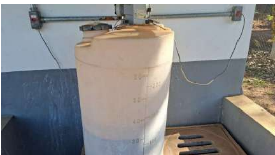
Foto 11 - Dosagem de flúor.
