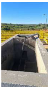
Foto 9 - Entrada do efluente nos reatores UASB.
