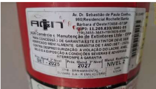
Foto 15 - Validade do extintor de incêndio.
