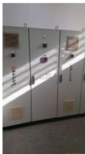
Foto 3 - Painel de controle.
