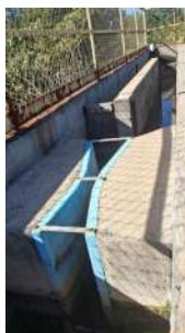
Foto 3 - Entrada do efluente.
