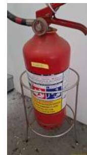
Foto 4 - Extintor da sala do painel de controle.
