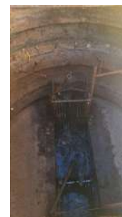
Foto 4 - Detalhe do gradeamento.
