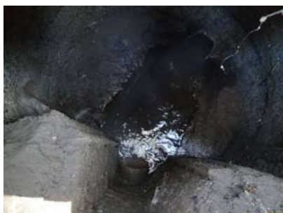
Foto 1 - Chegada de esgoto bruto
