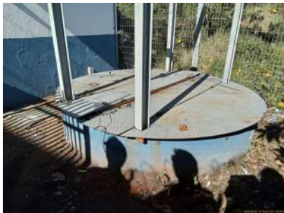
Foto 2 - Poço de sucção
