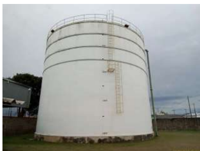
Foto 1 - Reservatório Parque Industrial apoiado
