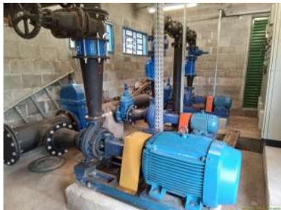
Foto 3 - Vista do interior da EEAT Parque Industrial Nova Instância
