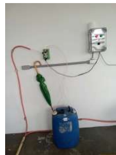
Foto 6 - Armazenamento e dosagem de flúor
