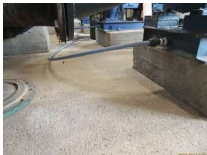
Foto 6 - Drenagem de água de lubrificação de gaxetas
