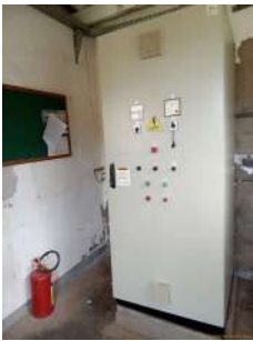
Foto 6 - Painel de comando e controle
