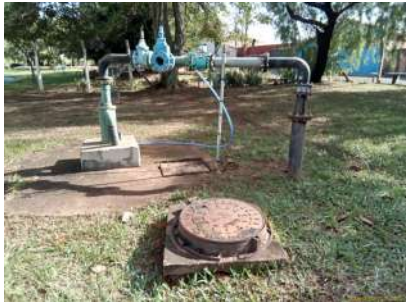
Foto 1 - Cavalete do poço Santa Eudóxia
