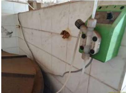
Foto 6 - Bomba dosadora de flúor
