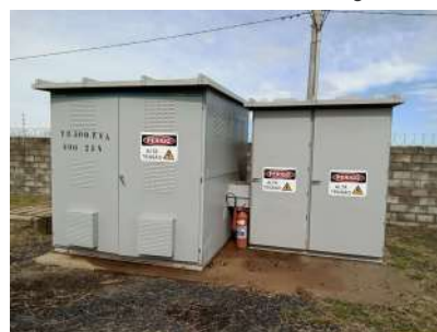
Foto 8 - Cabine de energia
