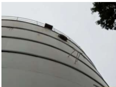
Foto 3 - Tela de proteção no extravasor
