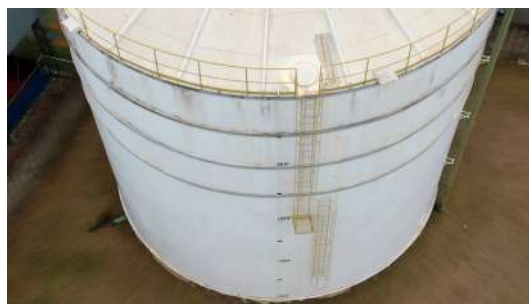
Foto 6 - Tampa de proteção
