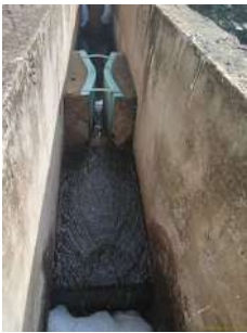
Foto 8 - Medidor de vazão tipo Parshall (saída)
