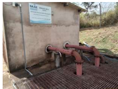
Foto 6 - Poço de sucção
