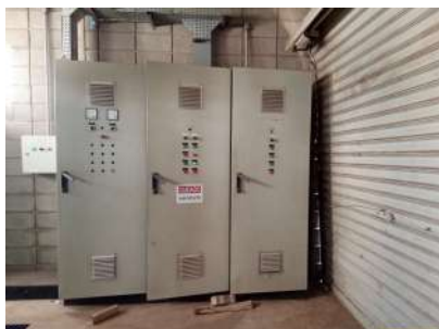
Foto 5 - Painel de comando e controle
