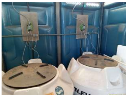
Foto 5 - Armazenamento e dosagem de cloro e flúor
