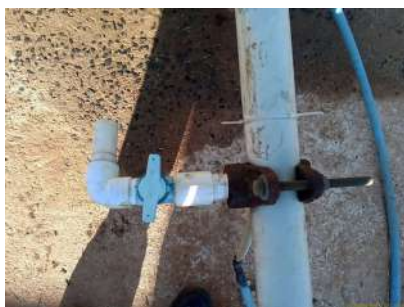
Foto 5 - Tomada para coleta de água
