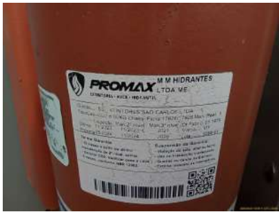
Foto 9 - Validade do extintor de incêndio
