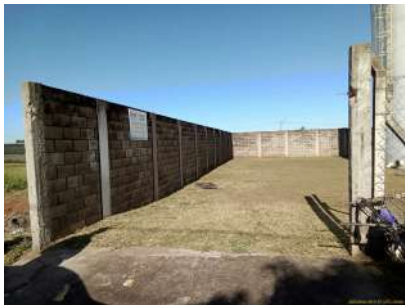
Foto 1 - Ausência de portão (roubado)
