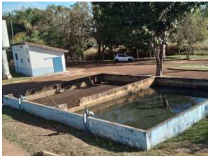
Foto 9 - Leito de secagem de lodo
