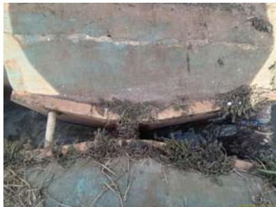
Foto 3 - Medidor de vazão tipo Parshall (entrada)
