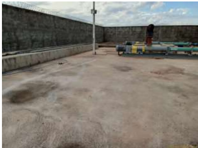
Foto 6 - Vista do interior da EEE. Arcoville
