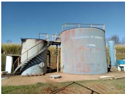
Foto 6 - Vista lateral (UASB e biofiltro)
