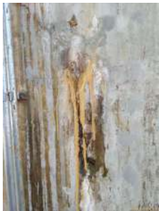
Foto 1 - Vazamentos na parede externa do reservatório
