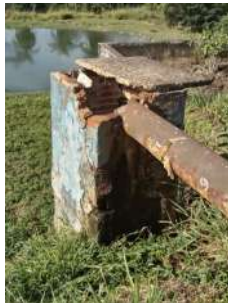
Foto 4 - Caixa de distribuição de vazão localizada perto do leito de secagem
