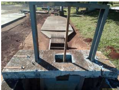
Foto 1 - Tratamento preliminar em operação
