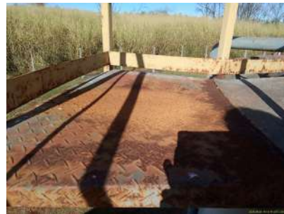
Foto 4 - Vista superior do UASB, com guarda-corpos e plataforma de acesso oxidados
