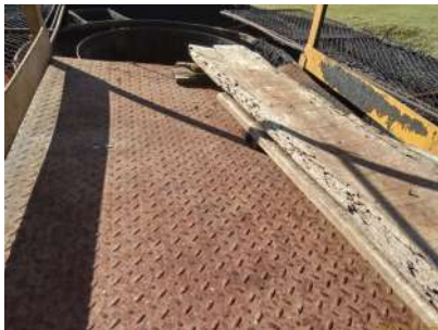
Foto 5 - Vista superior do biofiltro, com guarda-corpos e plataforma de acesso oxidados
