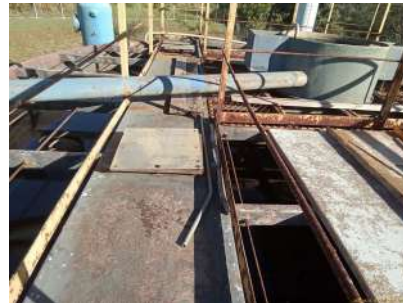
Foto 2 - Vista superior do UASB, com guarda-corpos e plataforma de acesso oxidados
