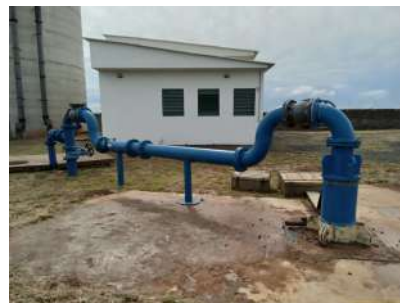
Foto 2 - Cavalete do poço
