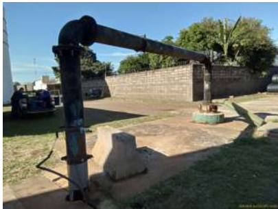
Foto 1 - Cavalete do poço Nova Instância
