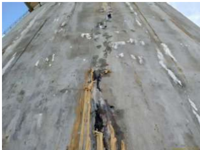
Foto 2 - Vazamentos na parede externa do reservatório
