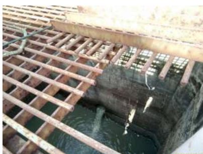
Foto 1 - Vista do poço de sucção
