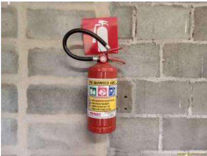
Foto 5 - Extintor de incêndio
