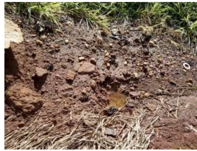
Foto 2 - Detalhe do vazamento aflorando 1
