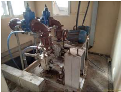
Foto 5 - Vista do interior da casa de bombas
