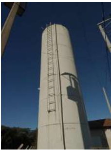
Foto 1 - Ausência de guarda-corpo na escada
