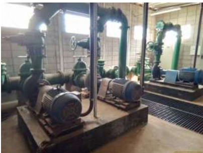
Foto 2 - Vista do interior da casa de bombas
