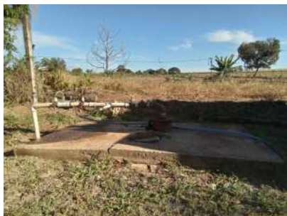
Foto 3 - Cavalete do poço portal do vale
