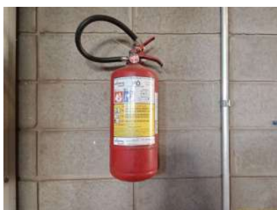
Foto 7 - Extintor de incêndio
