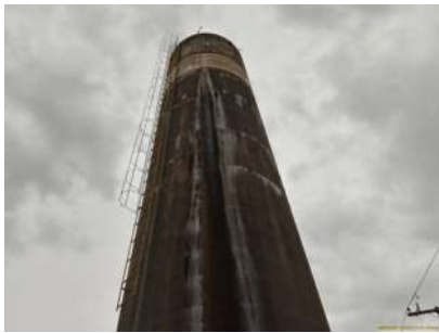
Foto 2 - Vazamento na parede externa do reservatório Jardim Alvorada.
