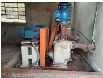
Foto 3 - Vista do interior da casa de bombas
