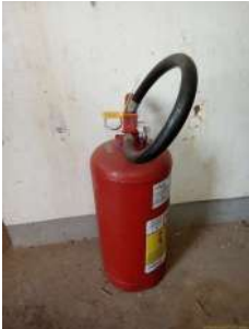
Foto 7 - Extintor de incêndio
