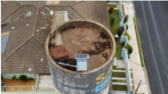
Foto 1 - Tampa de inspeção corroída
