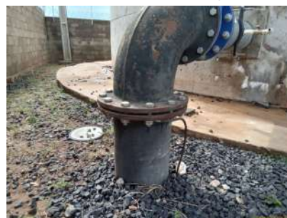
Foto 4 - Aterramento do SPDA
