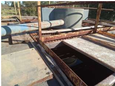
Foto 3 - Vista superior do UASB, com guarda-corpos e plataforma de acesso oxidados
