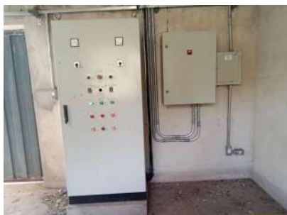
Foto 5 - Painel de comando e controle
