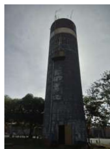
Foto 2 - Reservatório Santa Eudóxia
