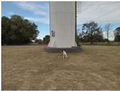
Foto 1 - Ausência de cercamento da área
