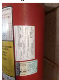
Foto 8 - Validade do extintor
