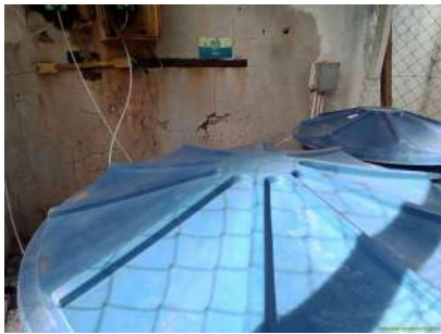
Foto 5 - Armazenamento e dosagem de cloro e flúor
