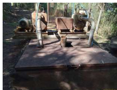
Foto 4 - Vista do interior da EEE. Novo Horizonte
