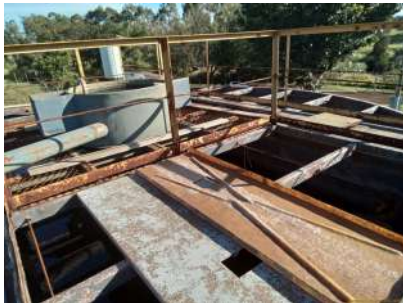
Foto 1 - Vista superior do UASB, com guarda-corpos e plataforma de acesso oxidados
