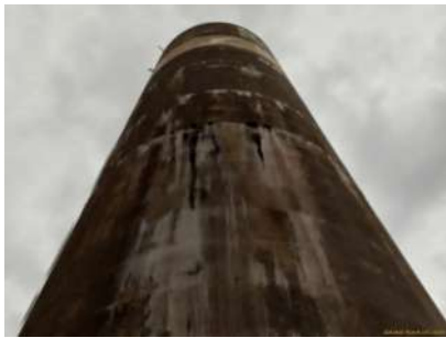
Foto 1 - Vazamento na parede externa do reservatório Jardim Alvorada.
