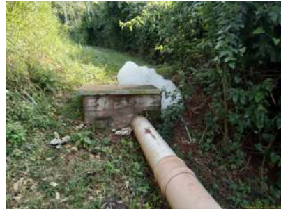
Foto 3 - Detalhe do vazamento aflorando 2
