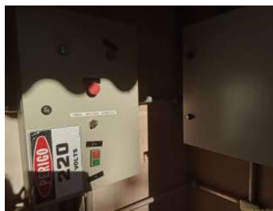
Foto 6 - Pannel de comando e controle
