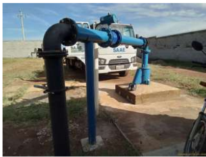
Foto 1 - Cavalete do poço Villeneuve
