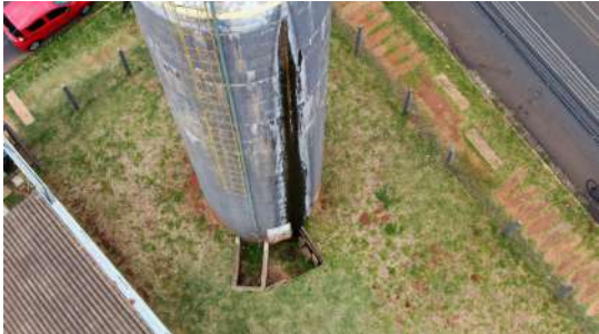
Foto 7 - Reservatório Jardim Alvorada (vazamento)
