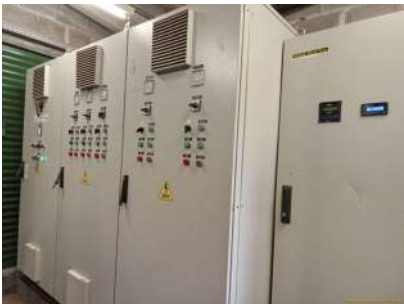
Foto 4 - Painel de comando e controle
