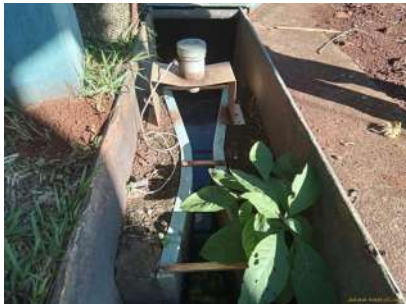
Foto 4 - Medidor de vazão tipo Parshall (entrada)
