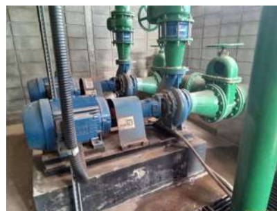
Foto 4 - Recalque para reservatório elevado
