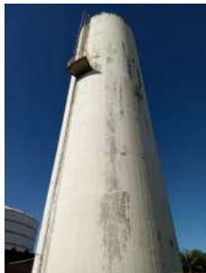
Foto 3 - Reservatório Nova Estância (elevado )
