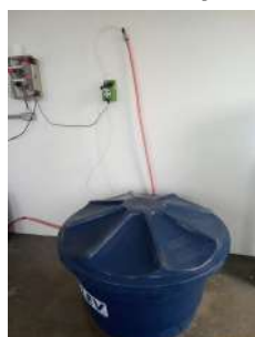
Foto 7 - Armazenamento e dosagem de cloro
